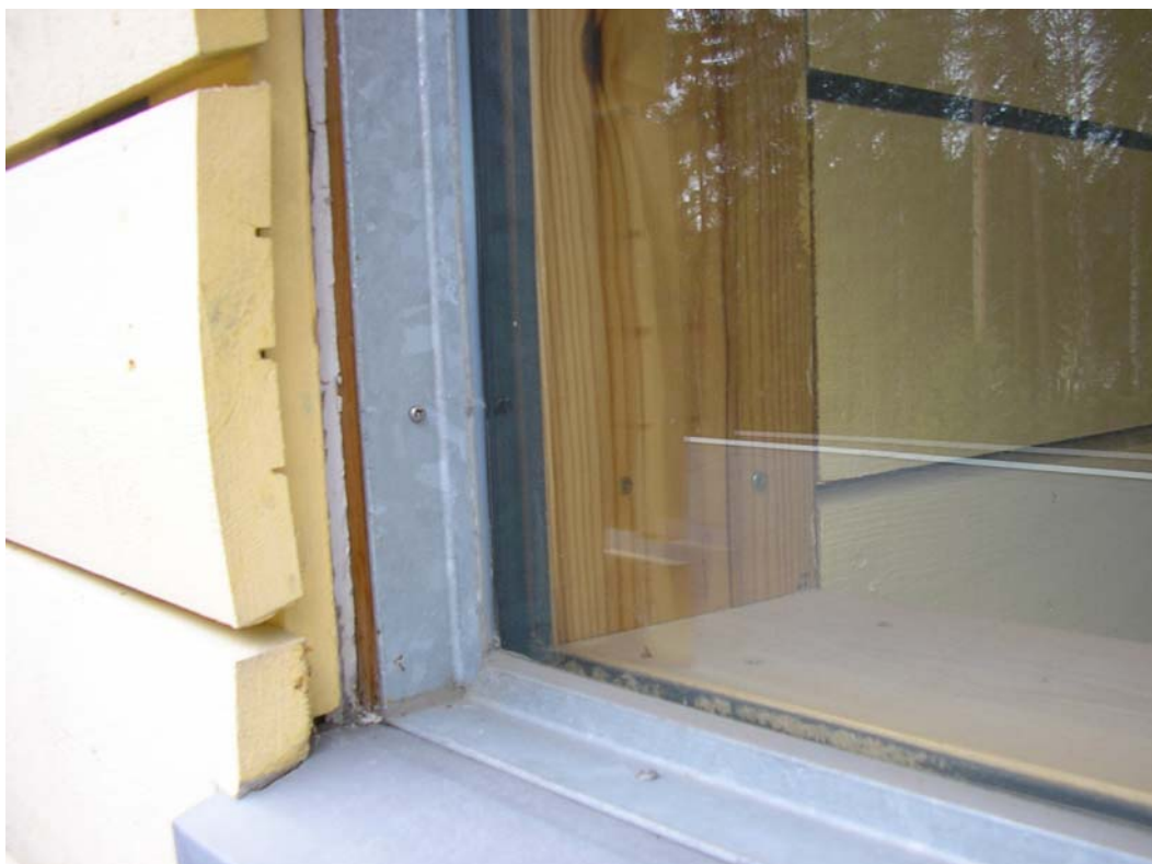
Kuva 10 Tyypillinen ikkunanpieli, josta puuttuu rakenteita suojaavat piellistat. Vesipellin kaltevuus on riittämätön, joten pellin ja teräslistan välistä imeytyy vettä ikkunarakenteisiin.
