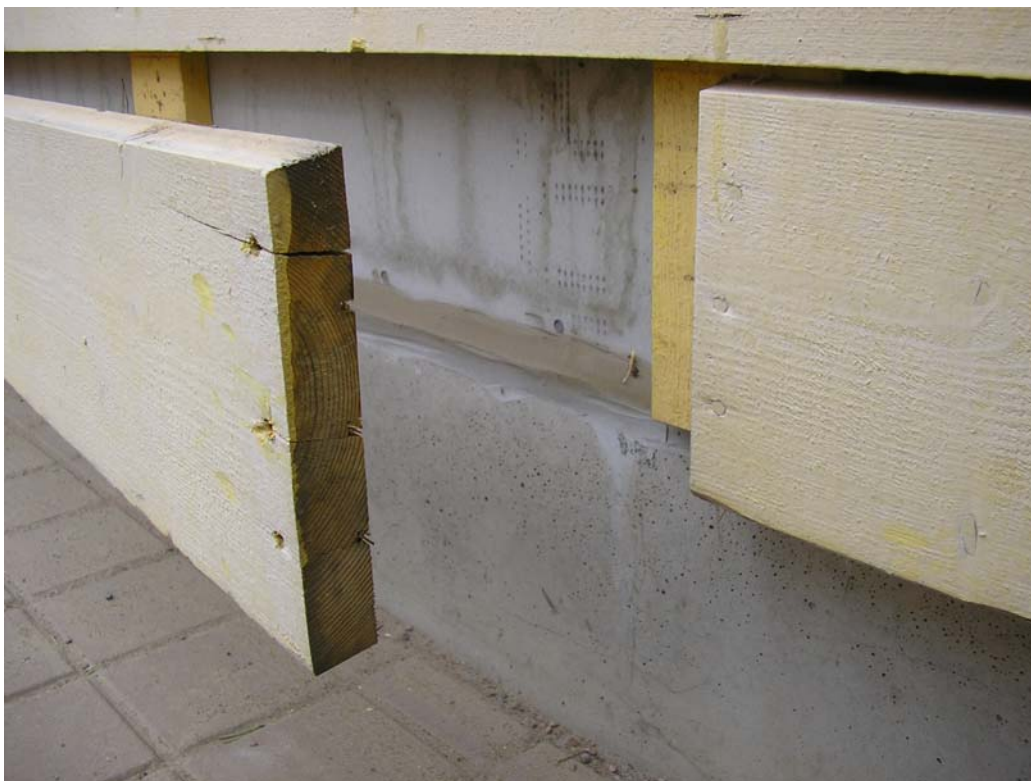
Kuva19 Ulkoseinälaudoituksen avauskohta päiväkodin eteläpäädyssä. Tuulensuojakipsilevyn alareunassa on elastinen kitti. Sokkelin ja kipsilevyn väliin ei ole asennettu tippapeltiä.
