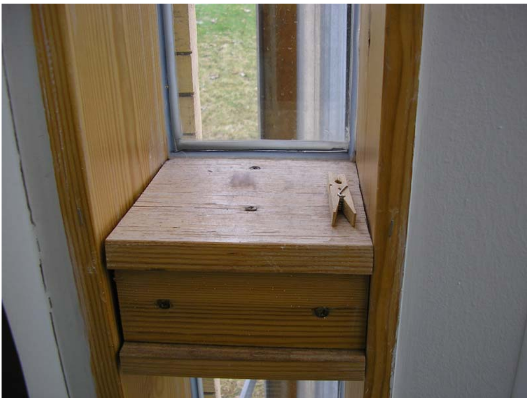
Kuva 26 LA4 -liittymäavauksen yläpuolella oleva välikarmin liitos on auennut ja laudan pinnassa on vesivuodoista johtuvia vaurioita.
