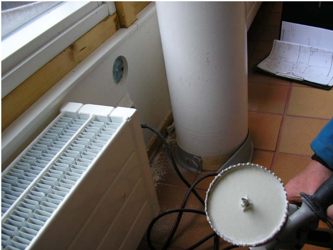
Kuva 23 Rasiaporareikäavaus RPA1 monitoimisalin ikkunan alta. Kipsilevyn taustapinta on kunnossa. Höyrysulun alla villa on tummunut.
