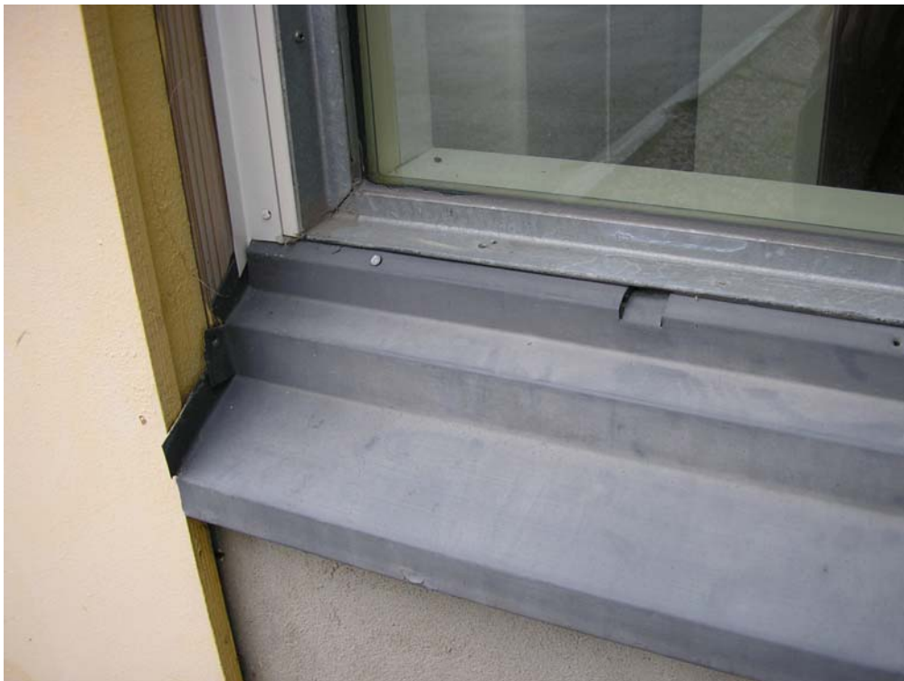
Kuva 14 Ruokasalin kiinteän ikkunan alareuna, jossa lasilistan ja vesipellin liittymässä pellin kallistus on riittämätön. Vesipellin liittymät eivät ole tiiviit ja kaksimetrisen pelti on kiinnitetty vain parilla naulalla.
