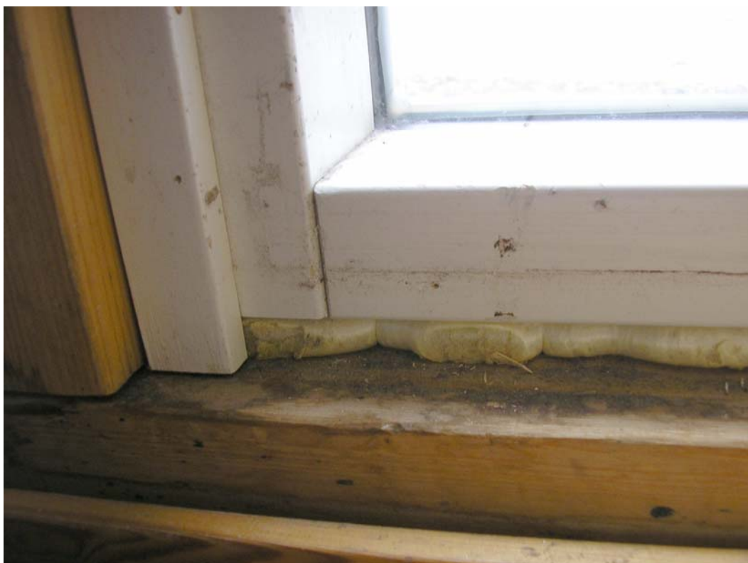
Kuva 28 Liittymäavauskohta LA6 yhdyskäytävällä, jossa karmin alla olevan ikkuna-aukon vaakarungossa on vuotojälkiä.
