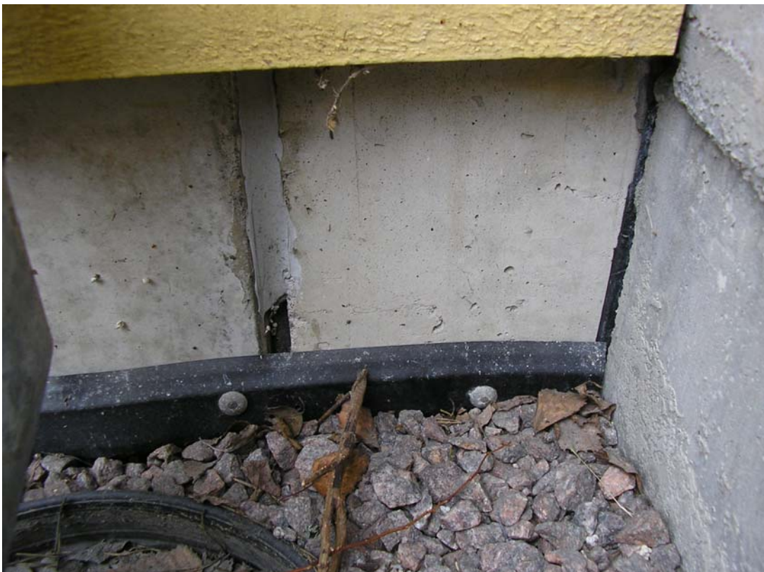
Kuva 22 Sokkelin saumaus ei ulotu riittävän alas.
