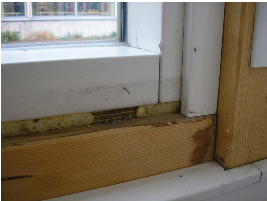
Kuva 24 Ikkunaliittymän listoituksen avaus LA1 monitoimisalin ikkunan alla, jossa rungon kehyspuussa on vesijälkiä.
