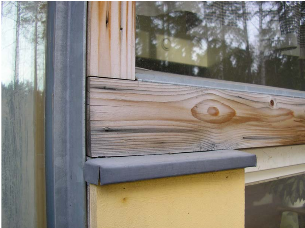
Kuva 7 Selviä rakoja teräslistojen ja puulistojen välissä. Puulista on kiinni vesipellissä, jossa ei ole riittävää kallistusta.
