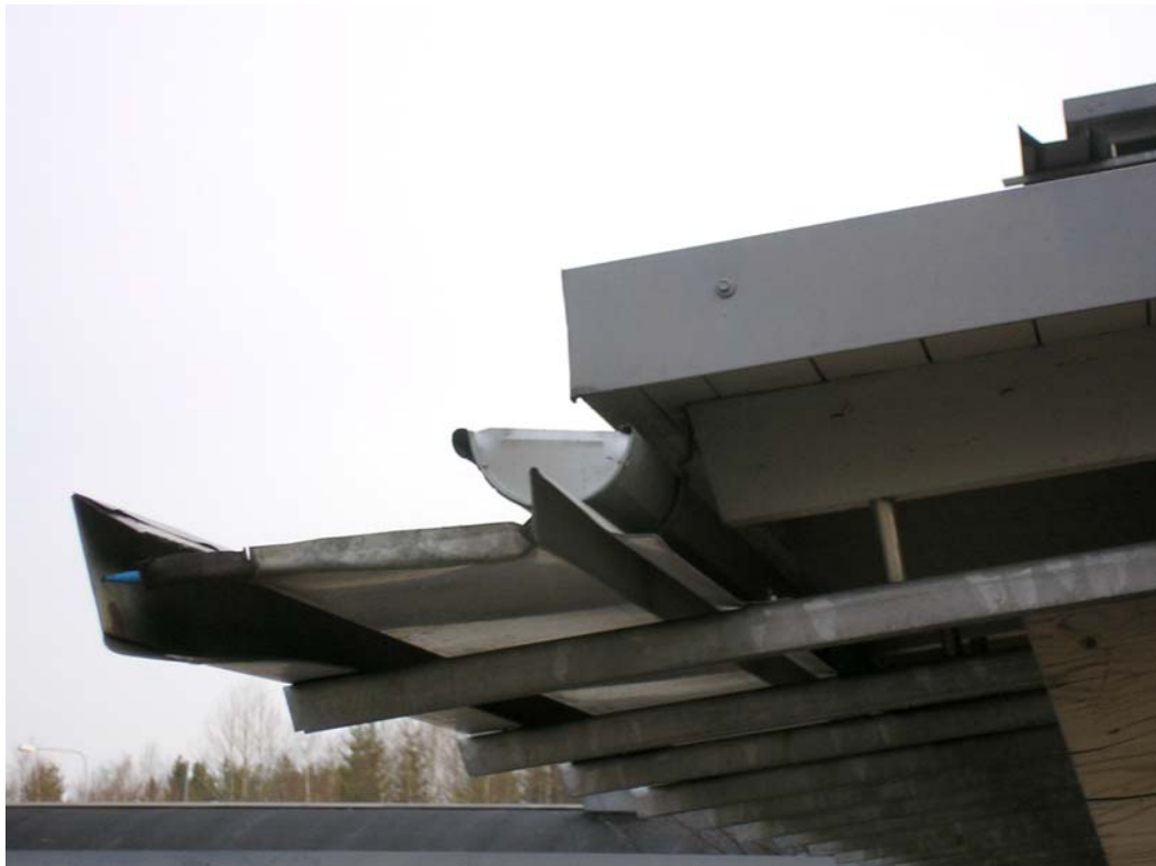
Kuva 17 Päiväkodin länsisivun räystäälle on lisätty räystäskouru varsinaisen räystäskourun päälle.
