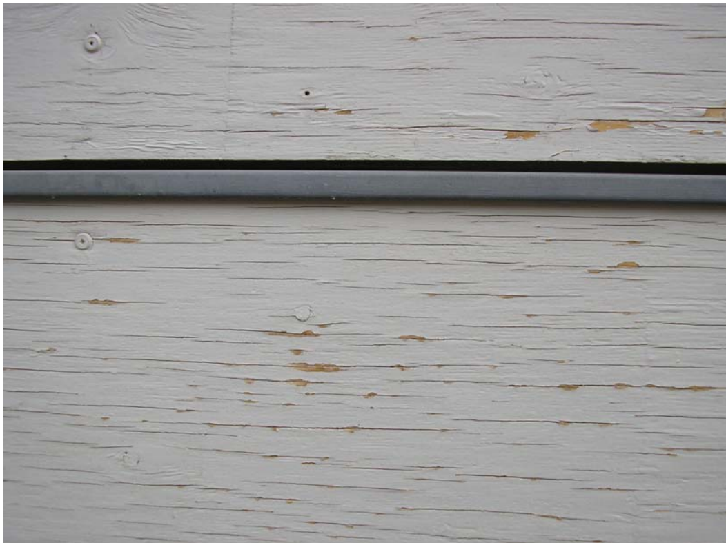
Kuva 9 Huonokuntoinen vaneri koulusiiven eteläpäädyssä. Levyn alareunassa ei ole kunnollista tuuletusrakoa.
