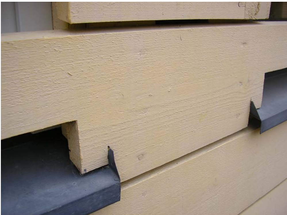
Kuva 6 Huonosti ratkaistu puuverhouksen ja vesipellityksen yksityiskohta, jossa puu voi lohjeta ja pellille tehty rako imee vettä. Laudan pinta on lähes pellissä kiinni. Ratkaisu on myös esteettisesti huono.
