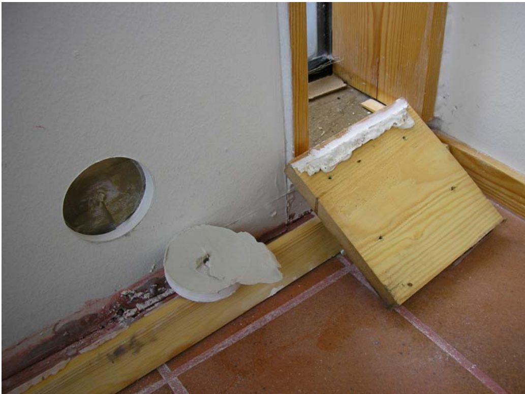
Kuva 27 Liittymäavaus LA5 koulusiiven eteläpäädyssä, jossa laudan tausta on kunnossa. Porareikäavauskohtassa RPA5 ovat kipsilevyn tausta ja eristeillä ovat kunnossa ja välissä on höyrynsulkumuovi.
