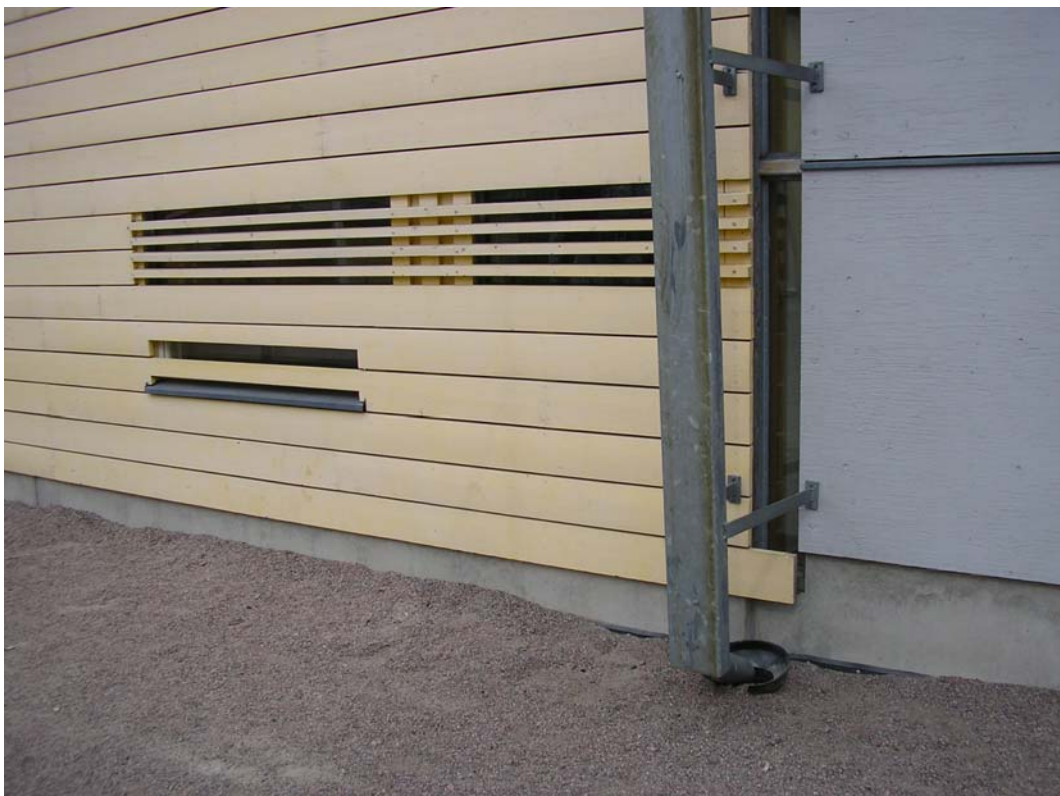
Kuva 4 Koulusiiven eteläpääty, jossa ikkunoiden eteen on tehty kiinteät ritilät. Syökytorvikaivoon on laitettu pihan hiekkaa.
