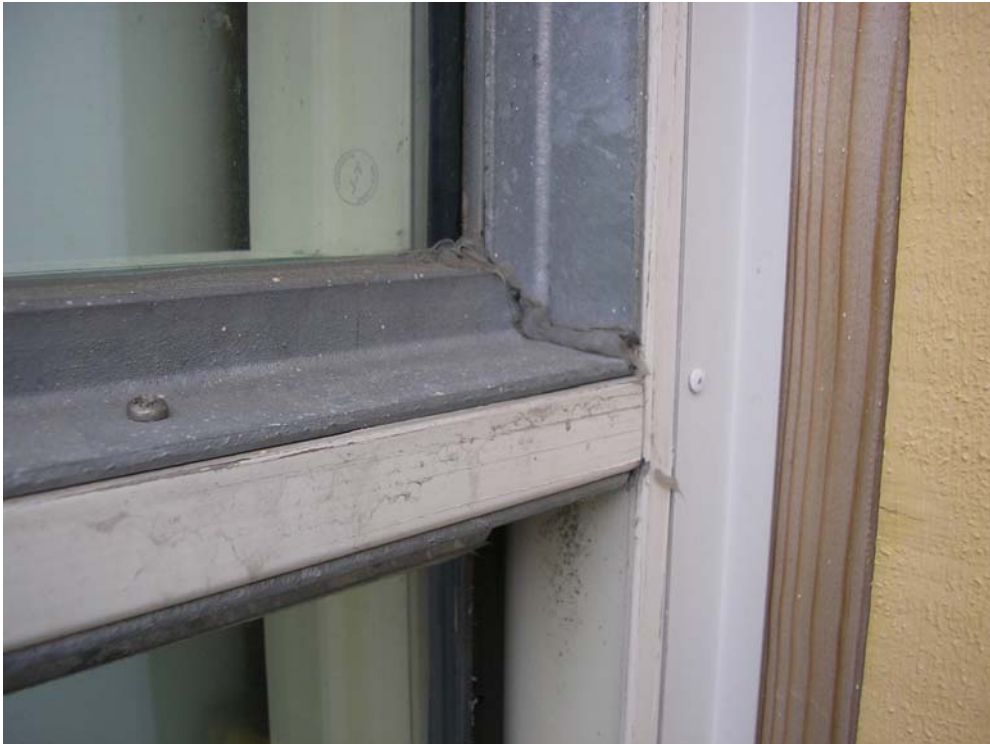
Kuva 13 Kiinteiden ikkunoiden lasilistana olevat sinkityt teräslistat eivät ulotu karmen ulkopintaan asti. Ikkunan sivupielessä on sekalaisia listoja.
