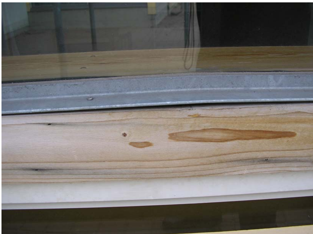
Kuva 18 Kiinteän ikkunan sinkitty teräslista on noussut kaarelle ja raosta pääsee vettä.
