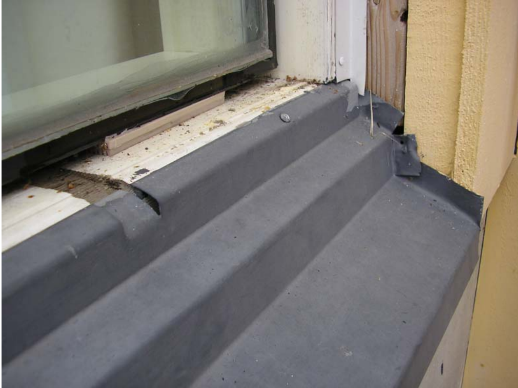
Kuva15 Ruokasalin kiinteän ikkunan kohdalta tehtiin avaus. Teräslista ja vesipelti ovat vain n. 5 mm limittäin. Teräslistan ja lasielementin välissä on siliikonikittaus. Vesipellissä on koloja, joista pääsee vesi. Umpiolasielementin ja karmin välissä ei ole tiivistyskittausta.
