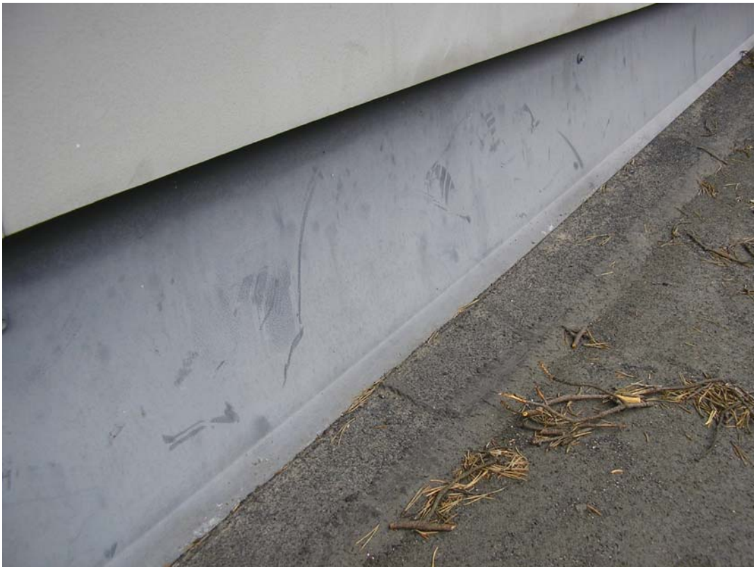
Kuva 21 Päiväkodin vesikatolla olevan kattolyhdyn ulkoseinän kohdalla on juurinoston pelti painunut pintahuopaan.
