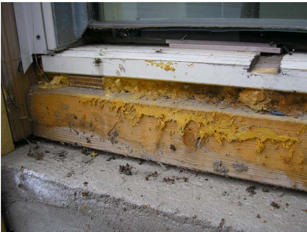
Kuva 16 Ruokasali ikkunan avauskohdalla on karmin ja vaakaprofiilin välissä polyuretaanivahto. Puun ja betoni välissä ei ole bitumikermiä.
