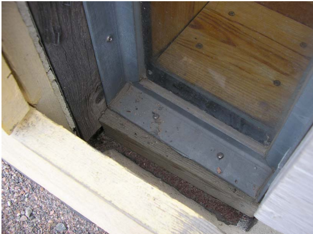
Kuva 11 Koulusiiven eteläpäädyn ikkunan alareunasta puuttuu vesipelti.
