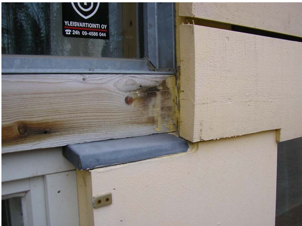
Kuva 8 Kiinteän ikkunan ja avattavan ikkunan liittymä, jossa vesipelti ei yllä edes vanerin ulkopintaan asti. Puulista on kiinni vesipellissä ja liittymässä on useita rakoja, joista vesi pääsee.
