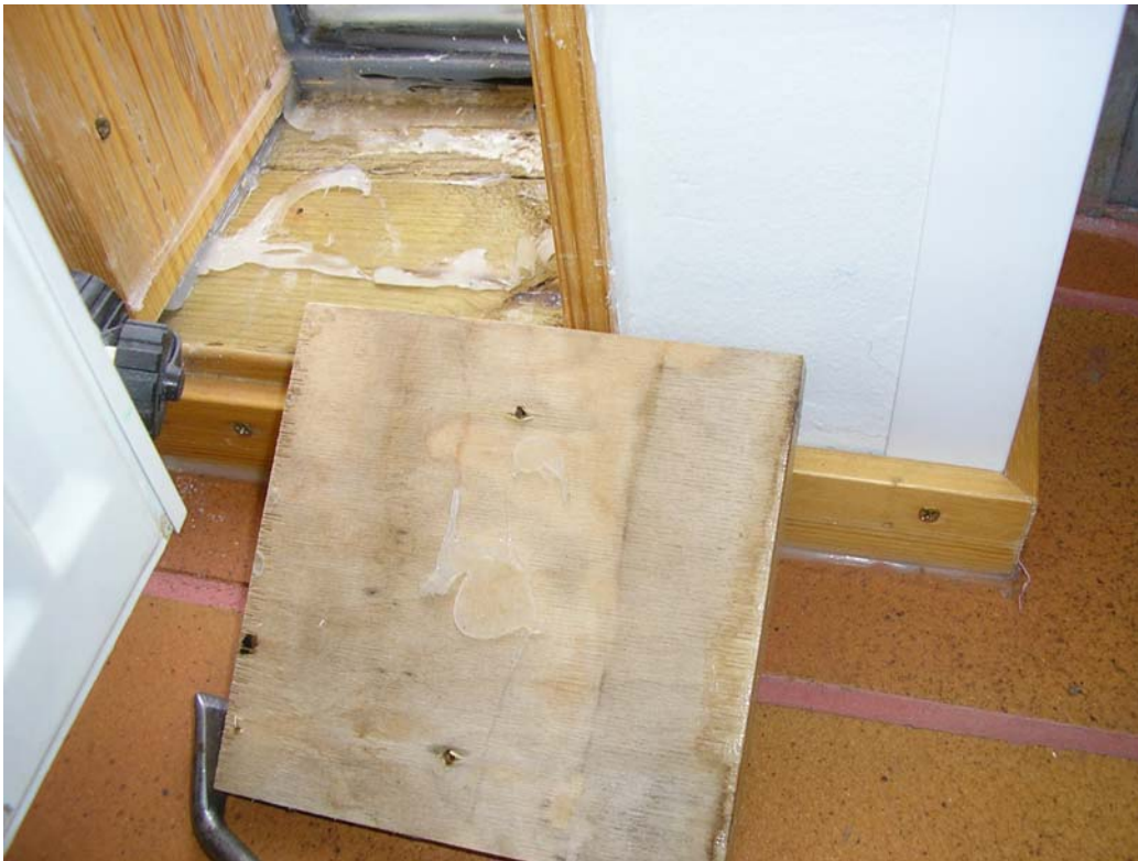
Kuva 25 Liittymäavaus LA4 koulusiiven pohjoispään pienryhmätilan ikkunan kohdalta. Alakarmia ei ole ja vanerin taustapinnassa on vesivuotojälkiä.
