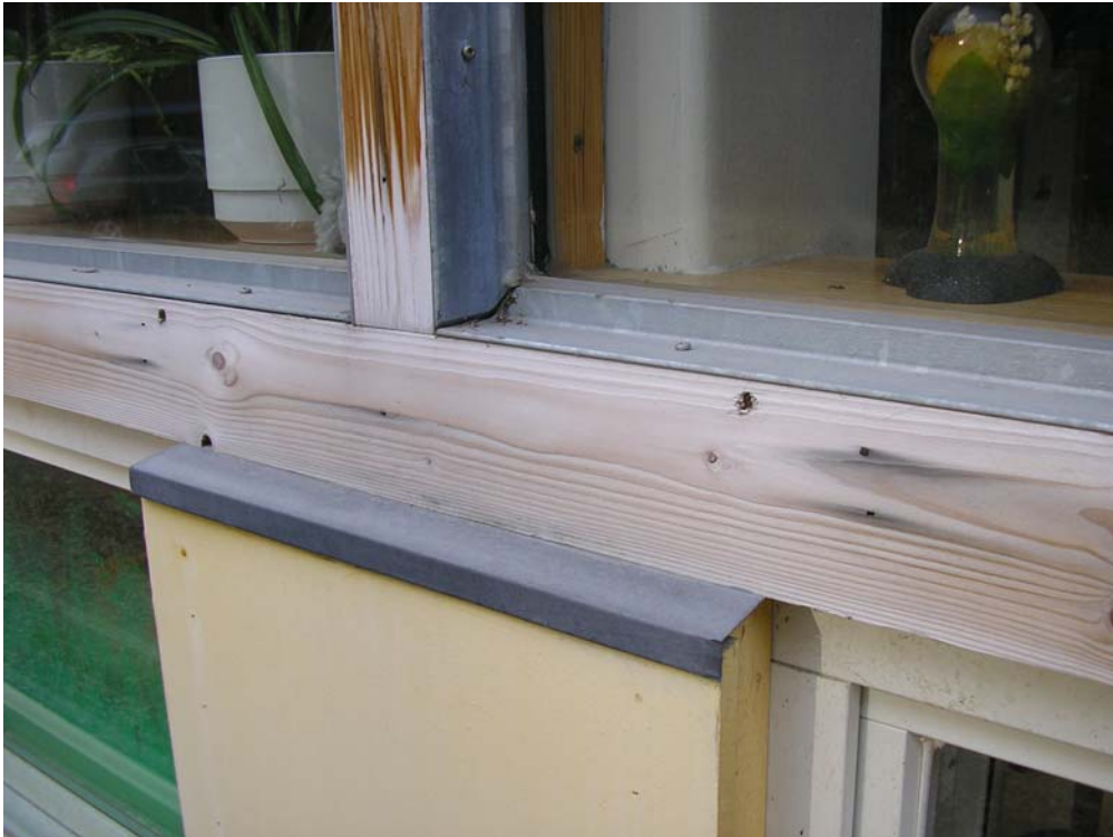
Kuva 5 Kiinteän ikkunan ja avattavan ikkunan liittymä. Välikarmin puulista on vasten vesipeltiä. Vesipellin kaltevuus on riittämätön ja pellissä ei ole päätaitteita. Puulistat ovat kärsineet säärasituksesta ja vedestä.
