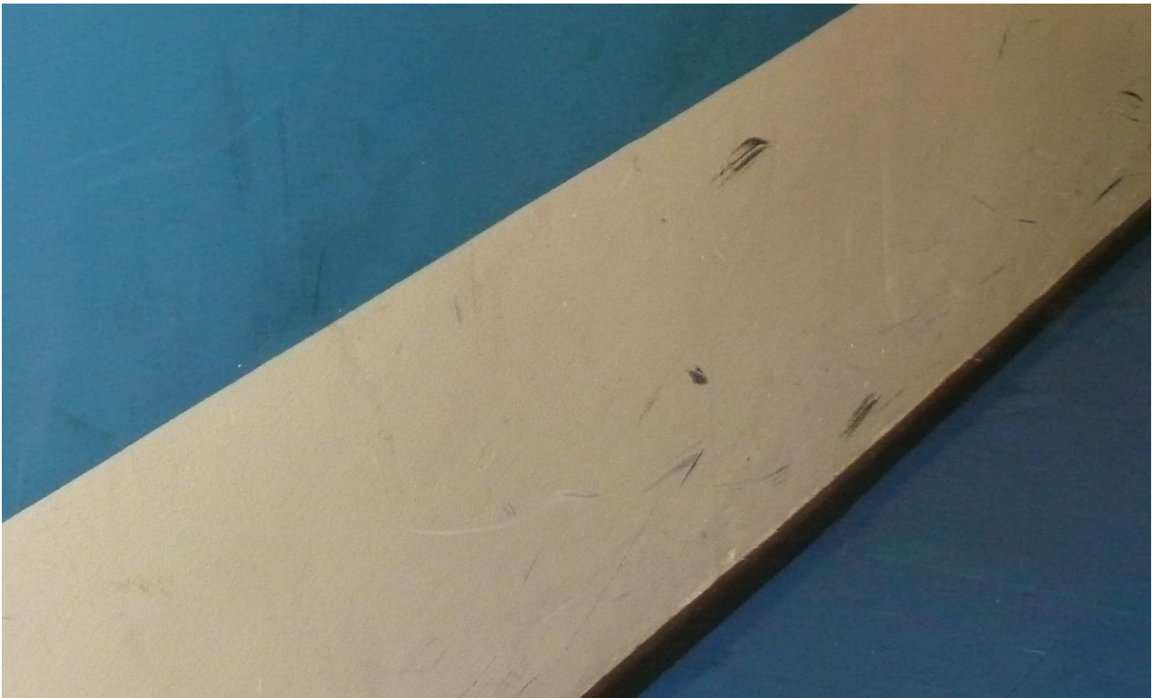
RAK- kuva 16. Seinissä esiintyy käytöstä aiheutuneita kulumia.
