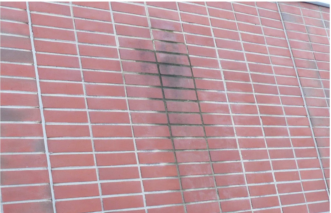
RAK- kuva 8. Pohjoispäädystä todettiin muutamissa paikoissa mikrobikasvuston aiheuttamia vaurioita.
