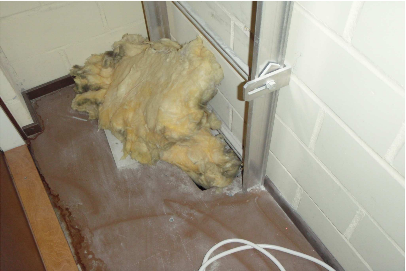
S- kuva 12. Puutteellinen kaapeliläpivienni.
