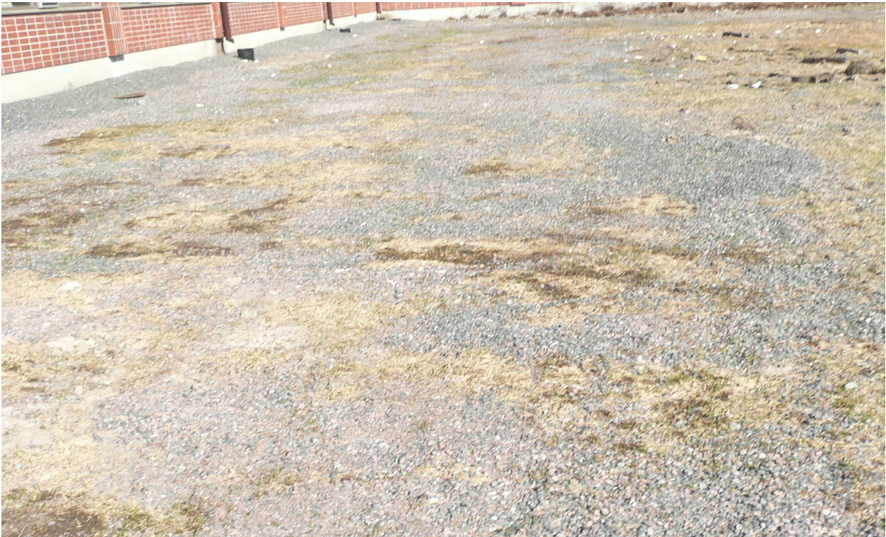
RAK- kuva 1. Nurmialueet ovat vaurioituneen salaojitustyön yhteydessä.
