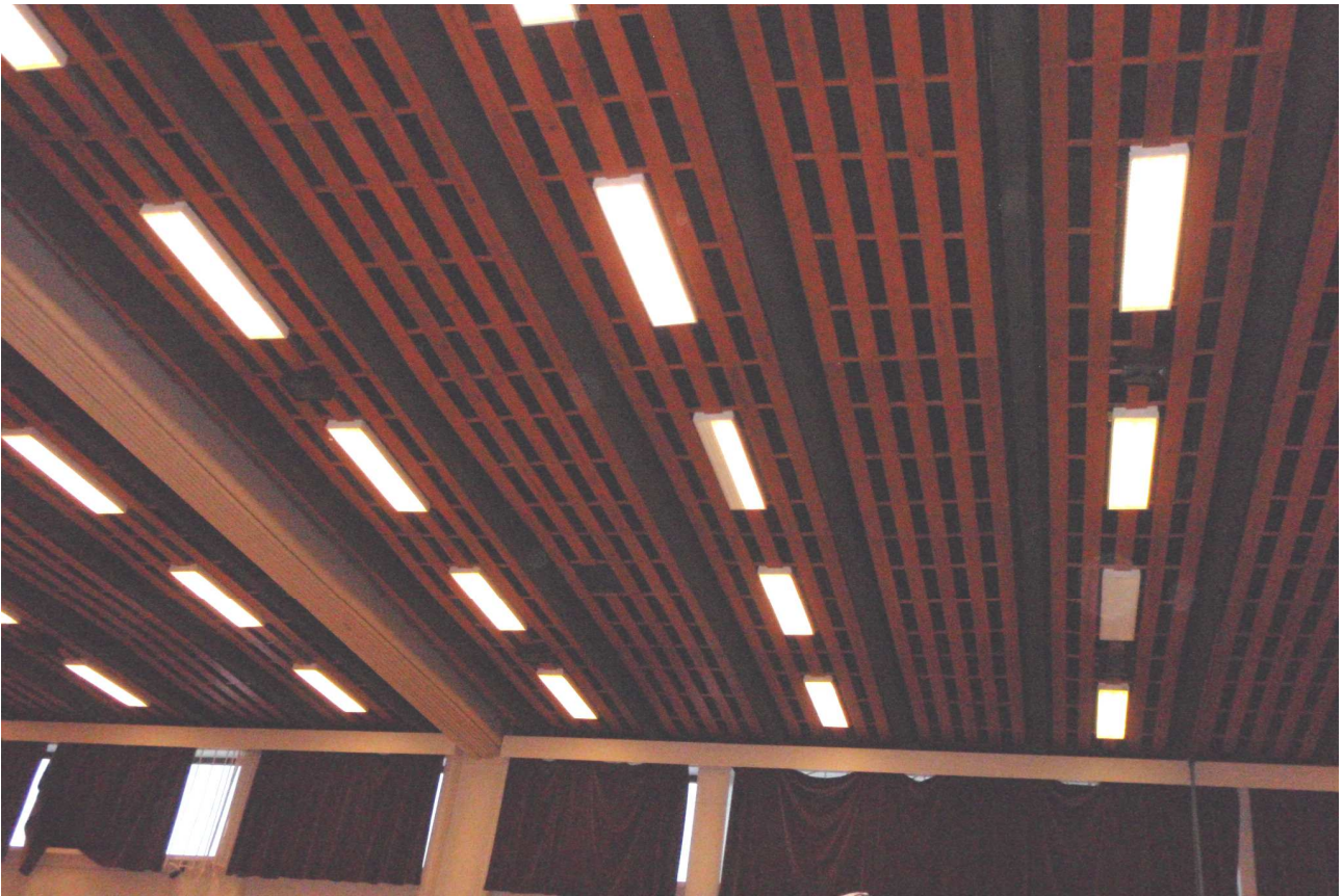
S-kuva 18. Liikuntasalin valaistus.
