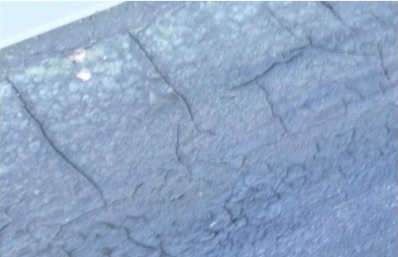
RAK- kuva 11. Auringon uv-säteily on aiheuttanut halkeamia huopakattoon.
