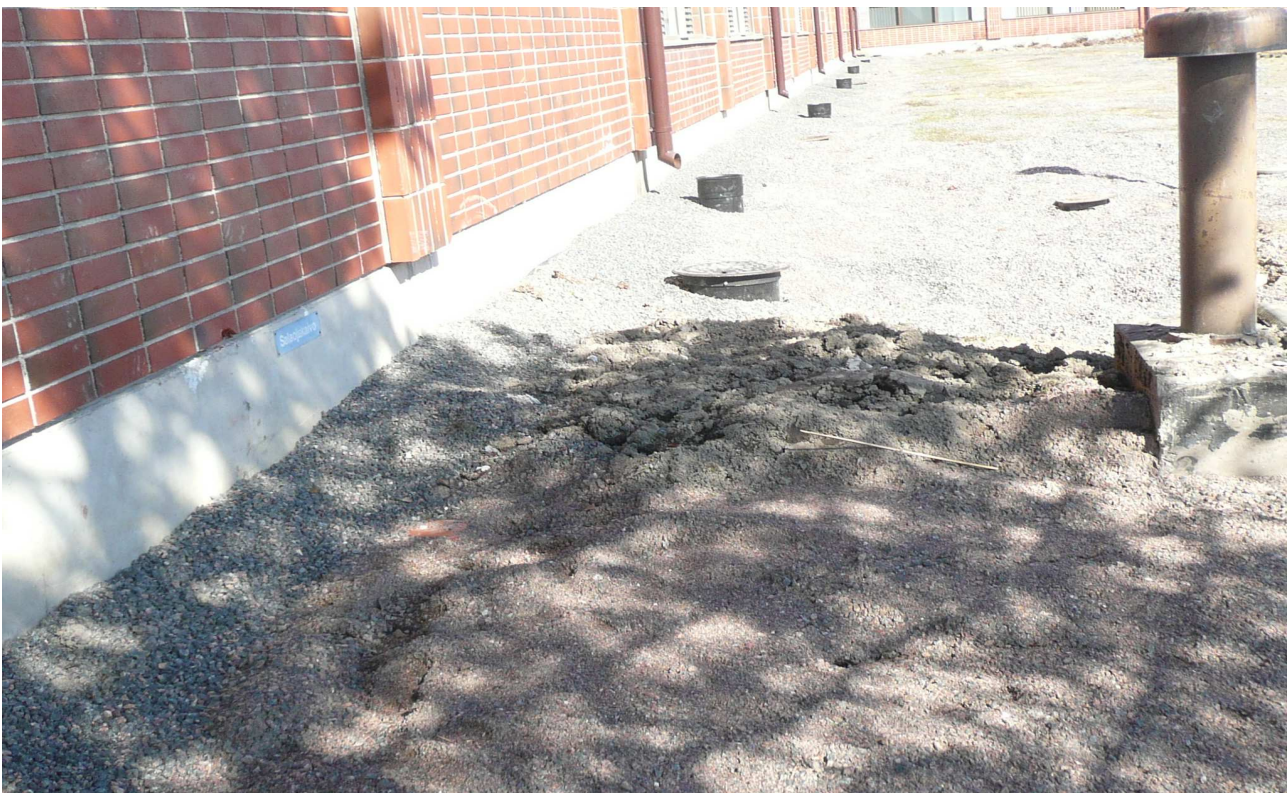
RAK- kuva 2. Nurmialueet ovat vaurioituneen salaojitustyön yhteydessä.
