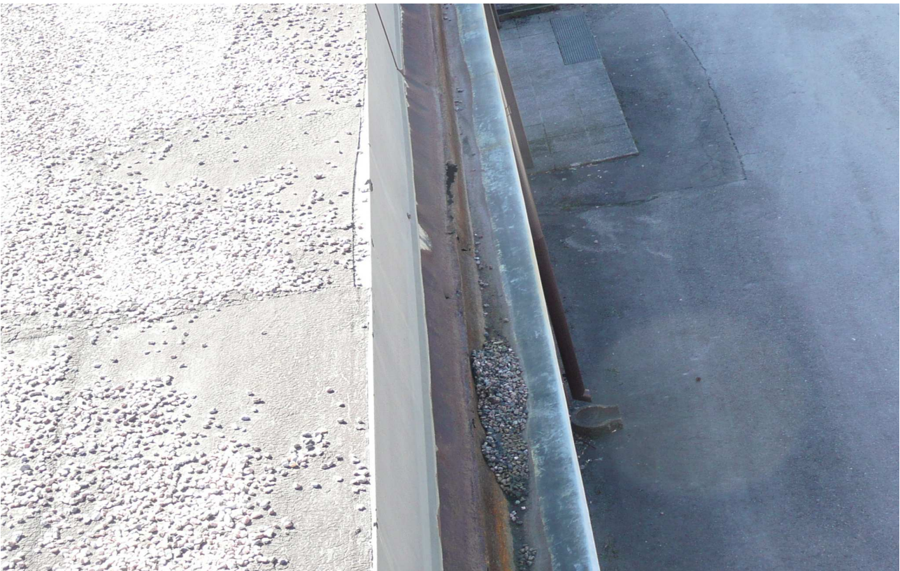
RAK- kuva 12. Räystäskourut ovat vaurioituneet massiivisten jääpuikkojen johdosta.
