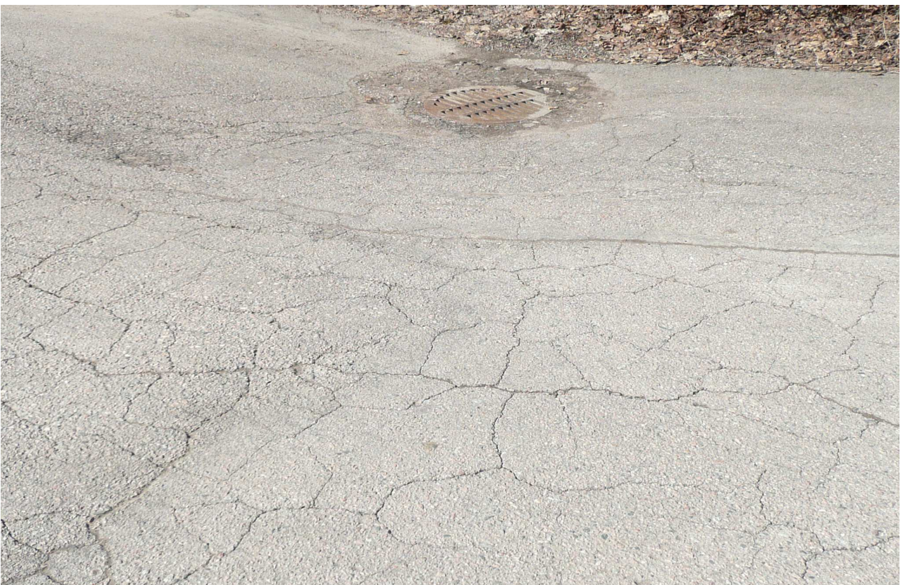
RAK- kuva 4. Asfalttialueissa esiintyy melko lailla painaumuksia.
