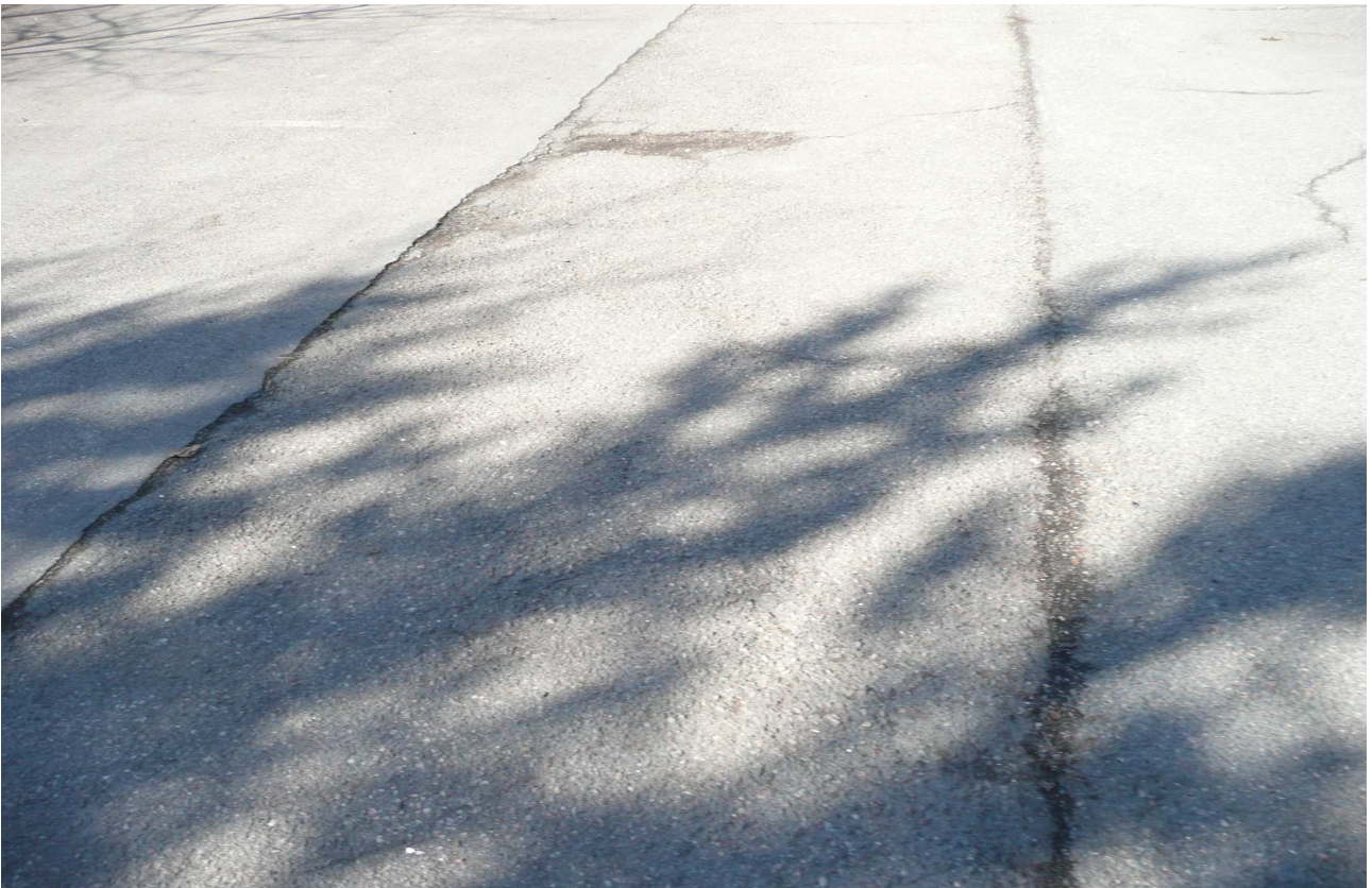
RAK- kuva 3. Asfalttialueissa esiintyy melko lailla painaumuksia ja halkeamia.
