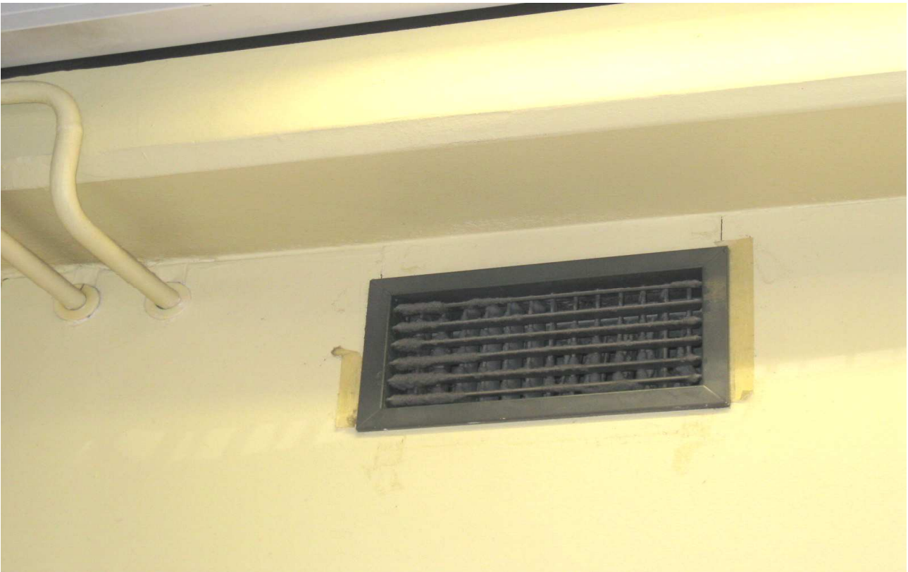
LVI- kuva 11. Yleiskuva pölyisestä pääte-elimestä.
