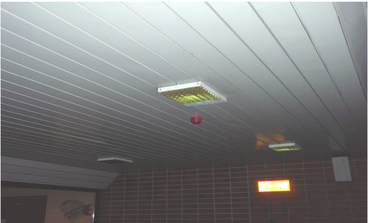
S- kuva 1. Sisäänkäynnin valaistus.
