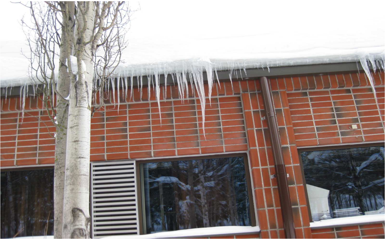
RAK- kuva 13. Yläpohjatiloissa on lämpövuotoja, koska räystäälle muodostuu jäätä.
