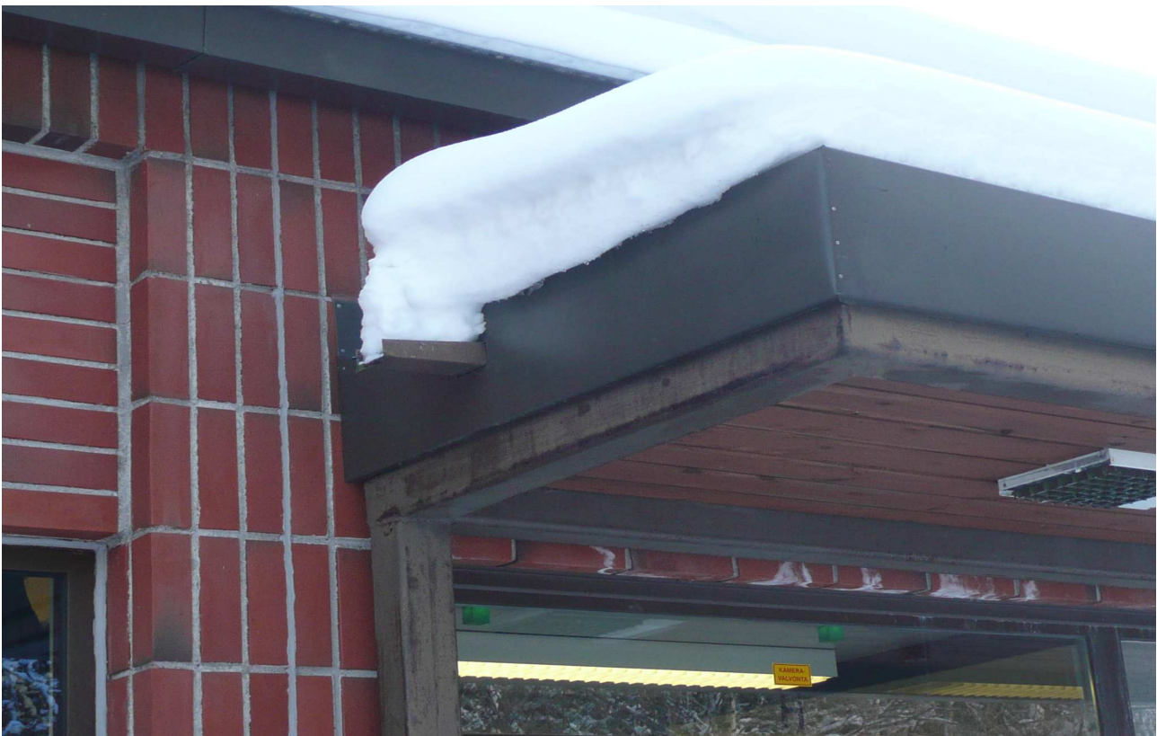
RAK- kuva 6. Alakattoverhoilun pinta on kulunut.
