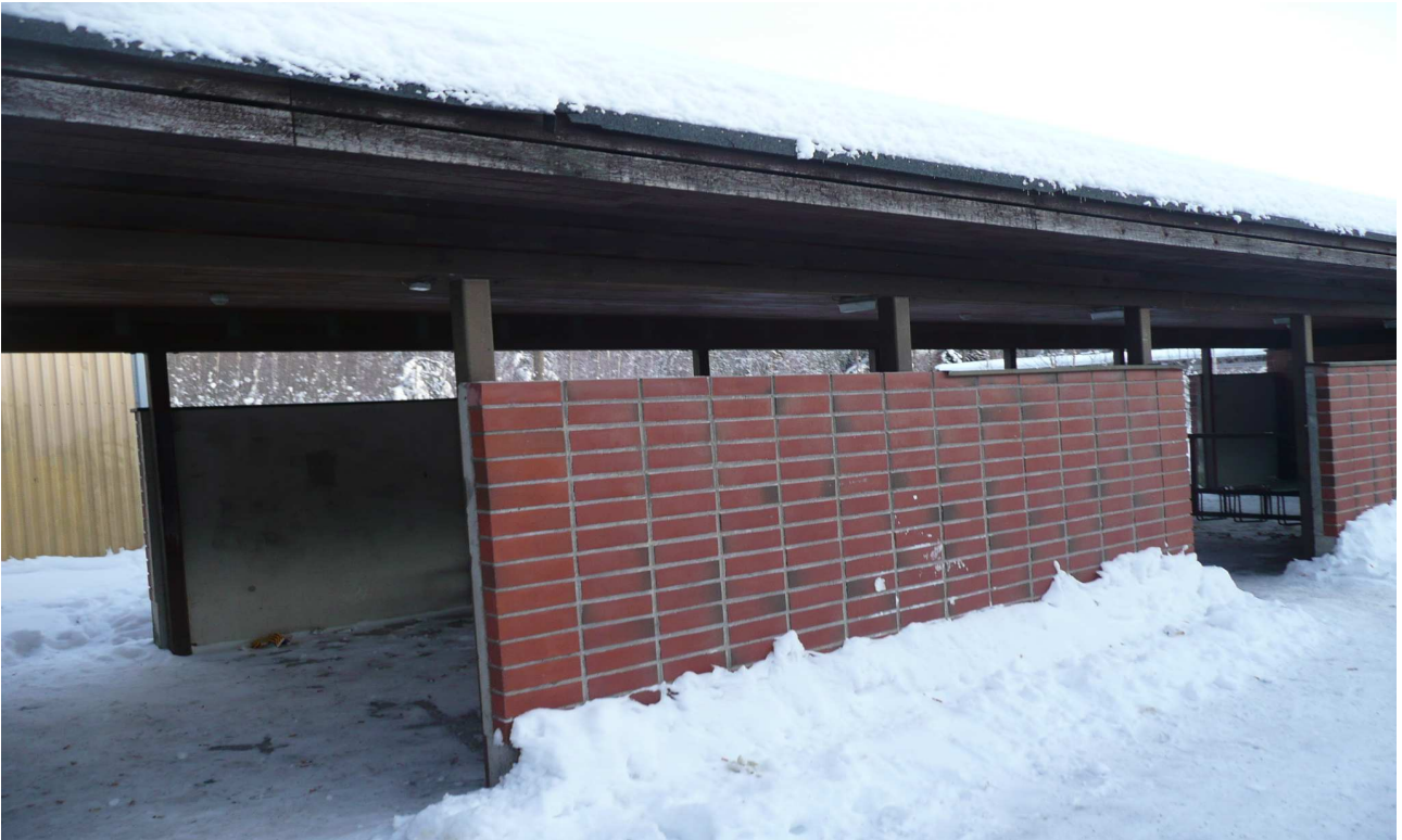
RAK- kuva 7. Varastojen puosissa esiintyy kulumia.
