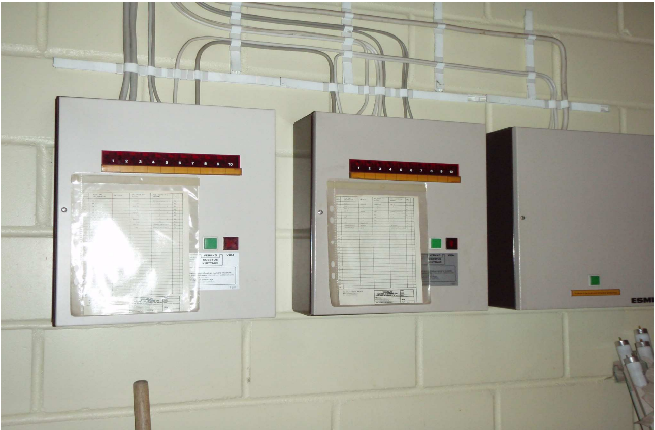
S- kuva 26. LVI- hälytyskeskukset lämmönjaossa.
