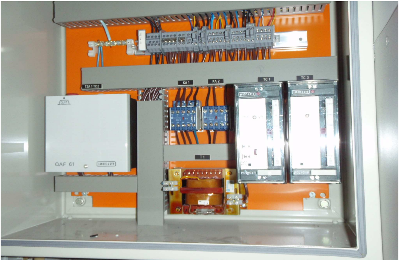
S-kuva 28. Koneikkokohtainen yksikkösäädin.
