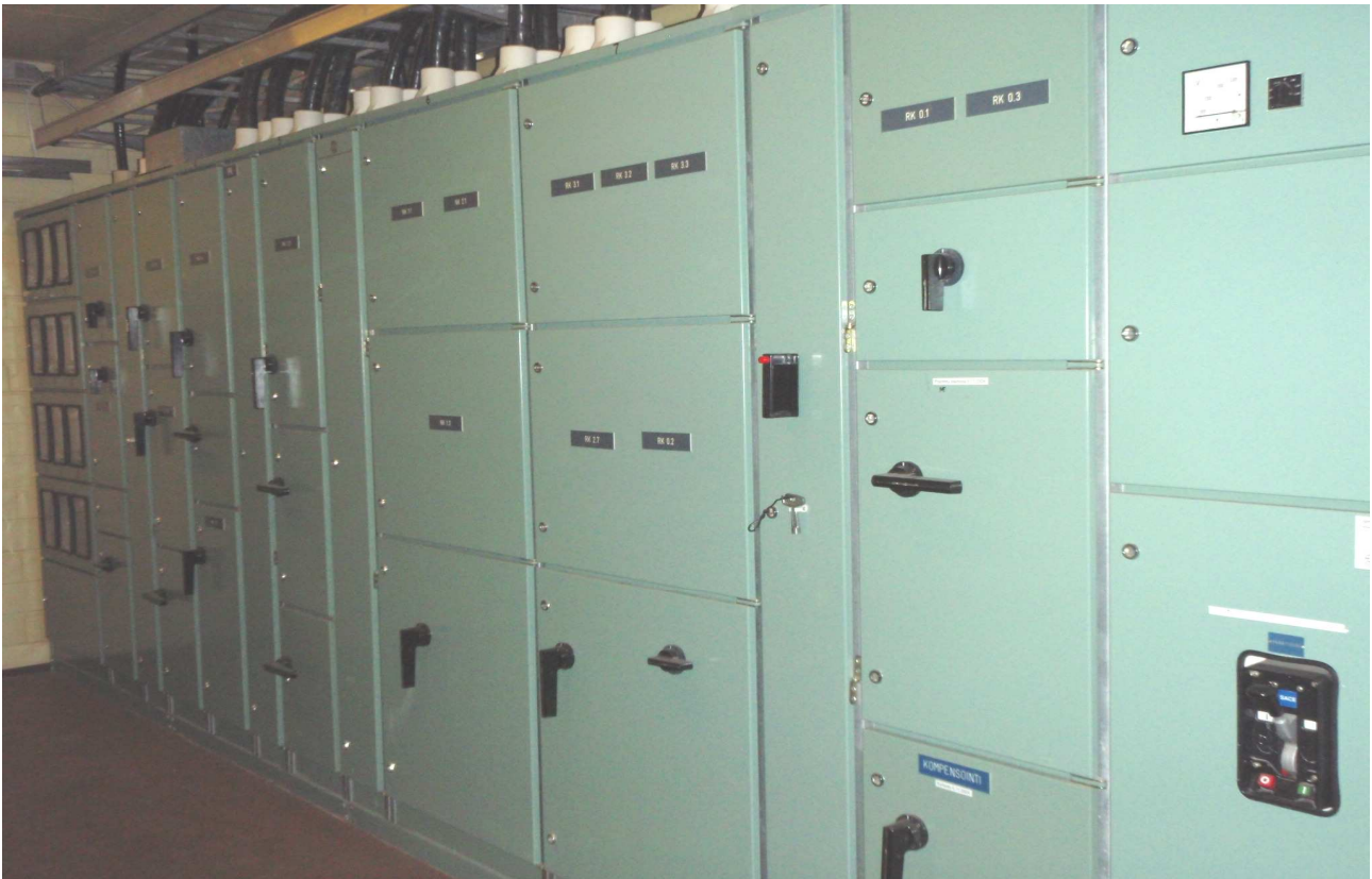
S- kuva 4. Sähköpääkeskus.
