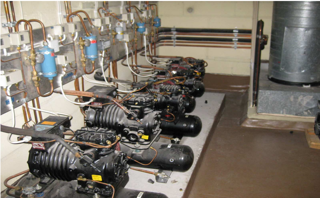
LVI- kuva 13. Yleiskuva keittiön vanhoista kylmäkoneista.
