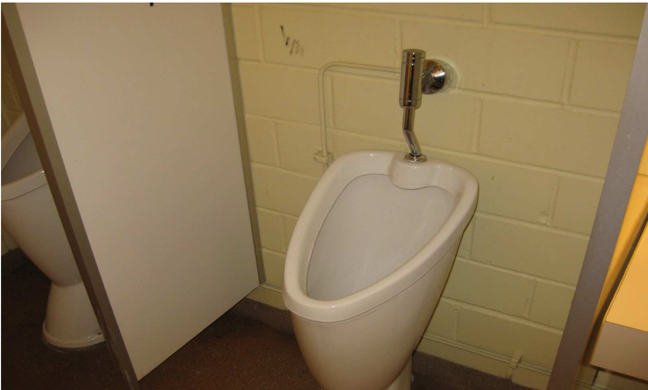
LVI- kuva 8. Yleiskuva koulun vesikalusteista.
