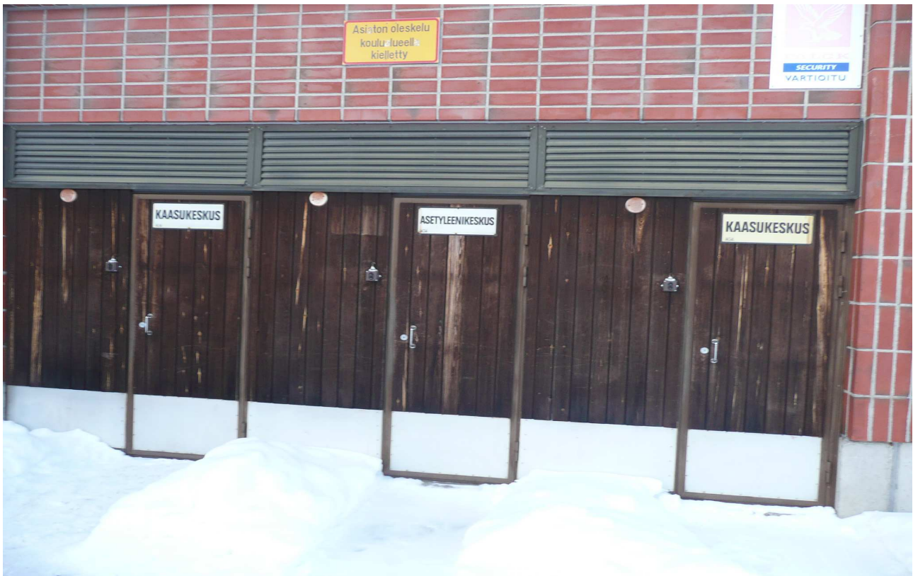
RAK- kuva 9. Paneelipintaisissa ovissa esiintyy pinnan kulumia.
