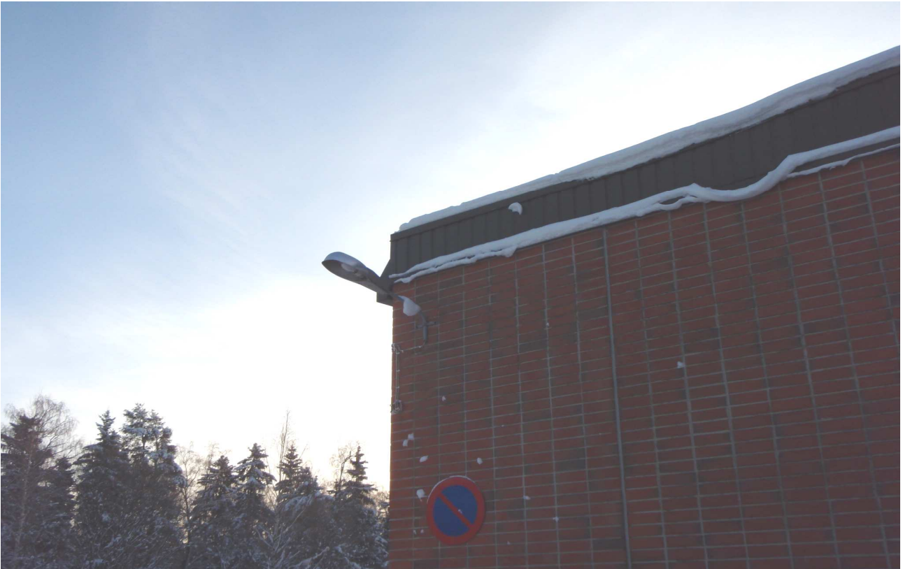
S-kuva 2. Rakennuksen seinään on asennettu HQL-valonheittimiä.
