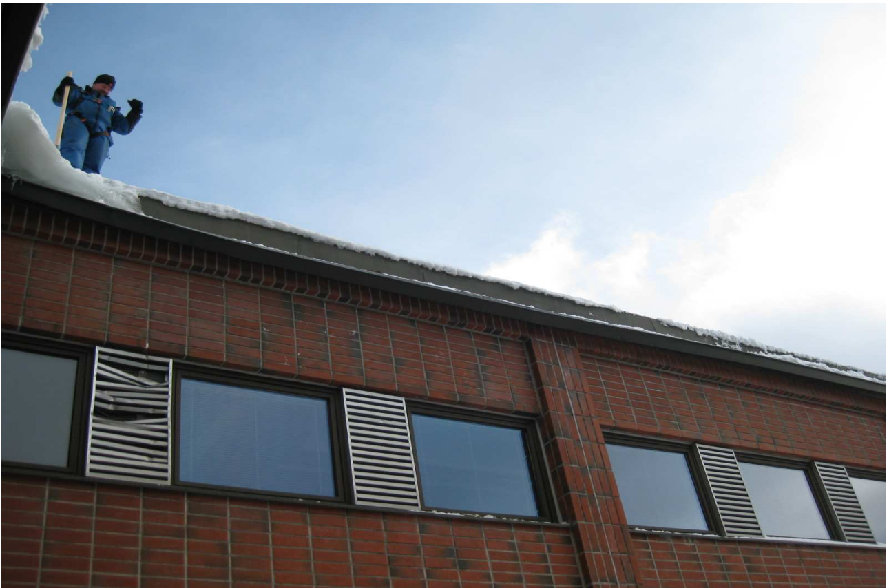
RAK- kuva 14. Yläpohjatiloissa on lämpövuotoja, koska räystäälle muodostuu jäätä.
