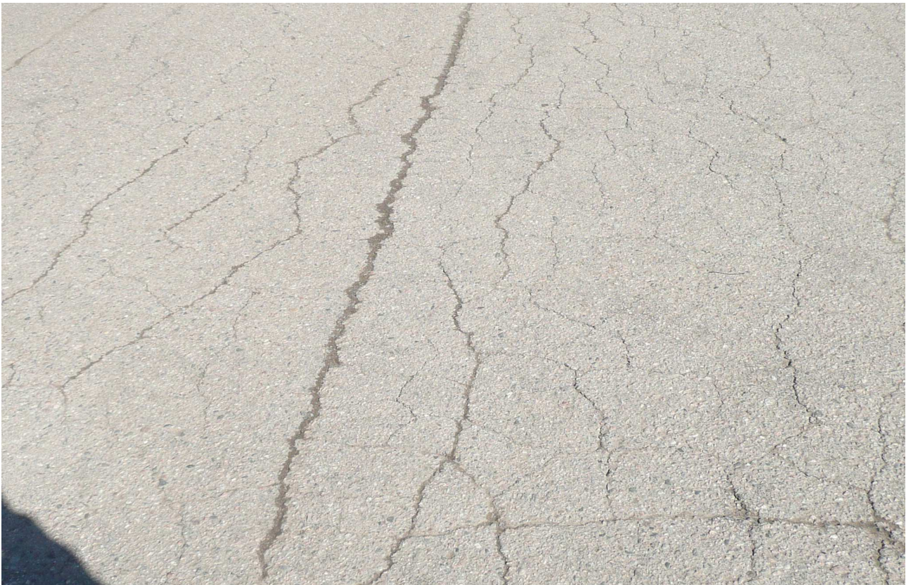
RAK- kuva 5. Asfalttialueissa esiintyy melko lailla halkeamia.
