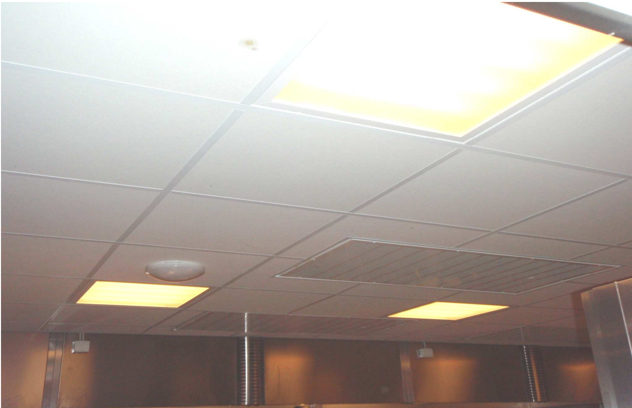
S-kuva 16. Suurkeittiön uusittu valaistus.
