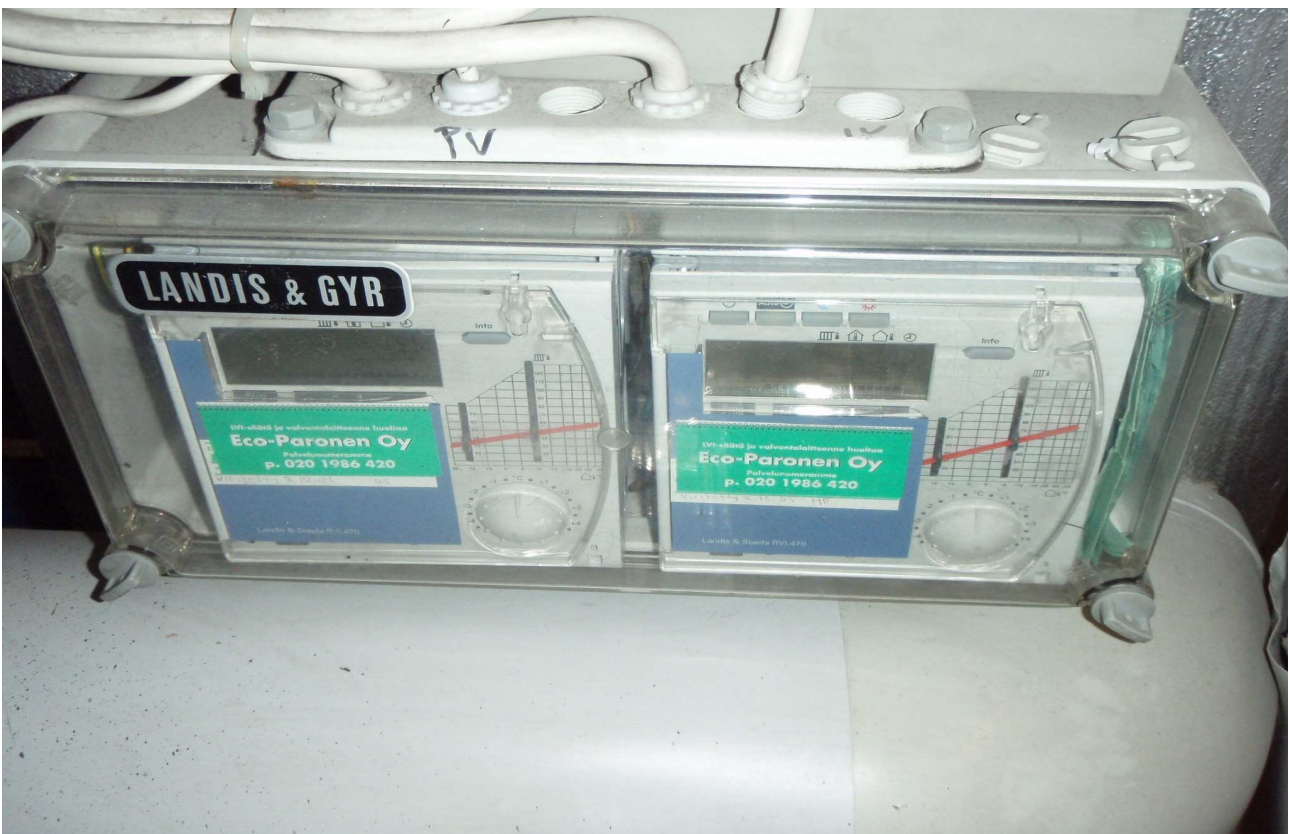
S- kuva 27. Lämmönjaon yksikkösäätimet.
