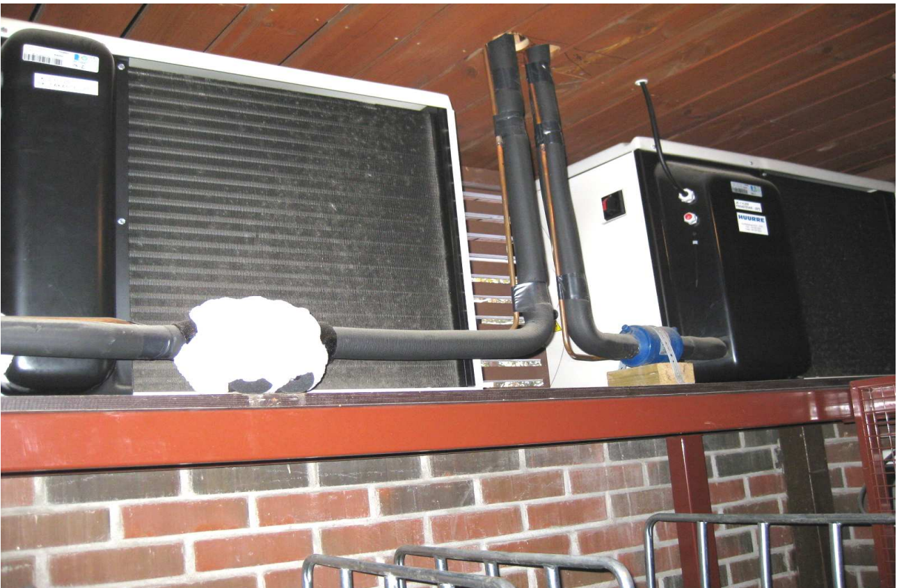
LVI- kuva 12. Yleiskuva keittiön uusituista kylmäkoneista.
