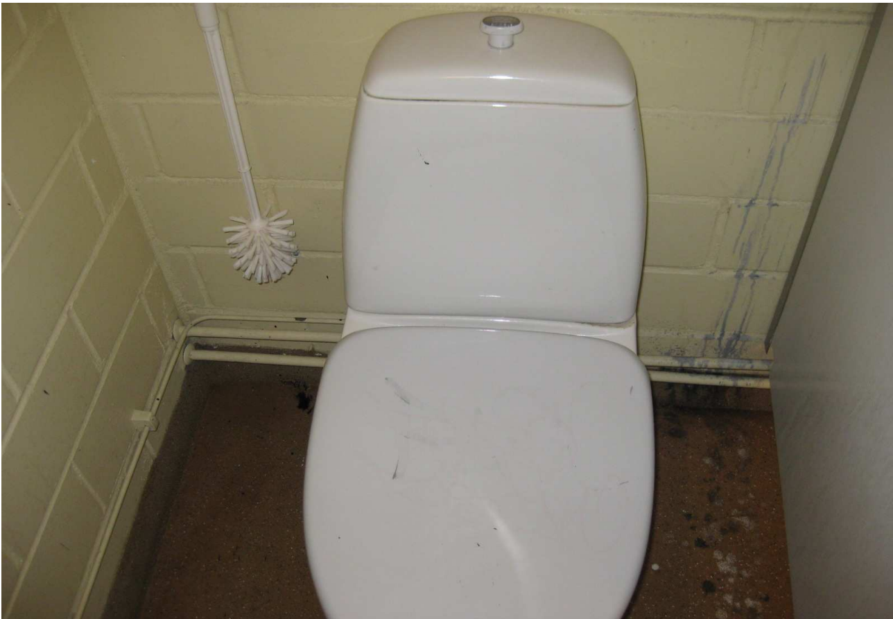
LVI- kuva 7. Yleiskuva koulun vesikalusteista.
