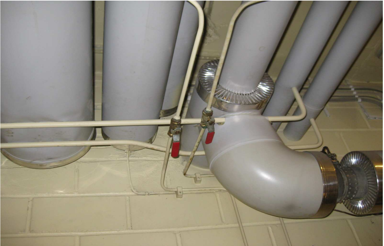
LVI- kuva 5. Yleiskuva käyttövesiverkoston venttiileistä.
