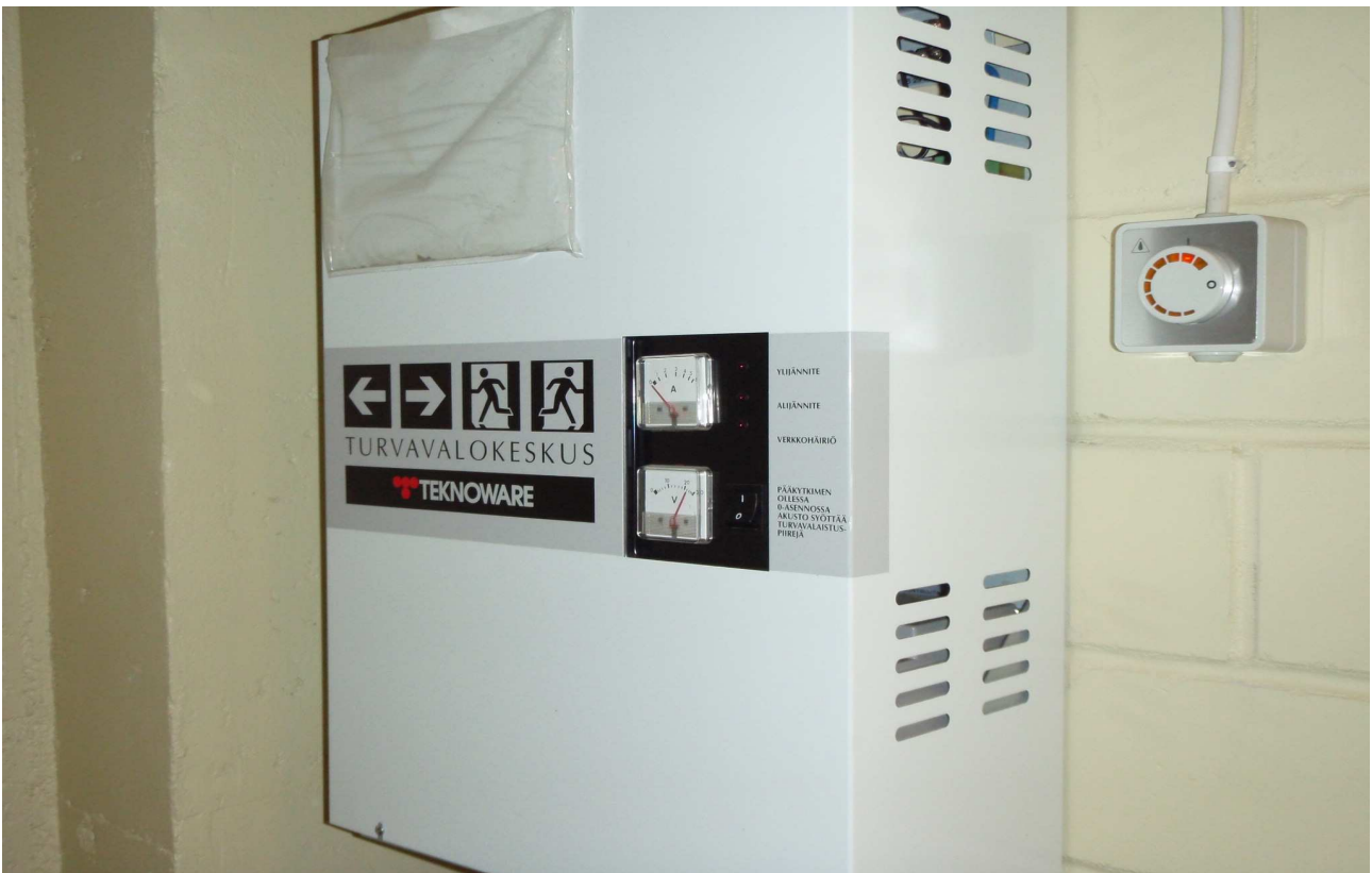
S-kuva 25. Turva- ja ovimerkkivalaistusjärjestelmän keskus.
