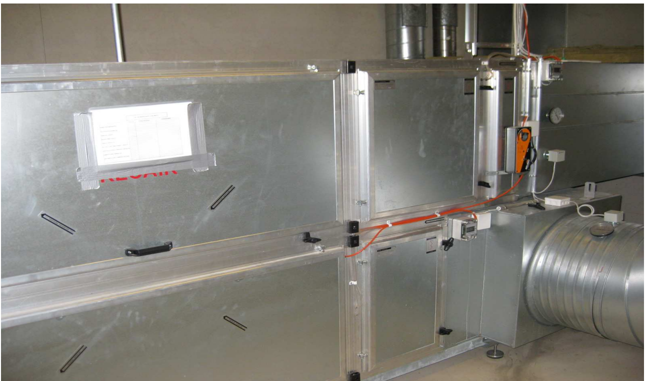
LVI- kuva 10. Yleiskuva koulun uusitusta tuloilmakoneesta.
