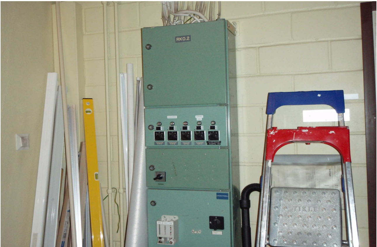
S- kuva 6. Lämmönjaon keskus.
