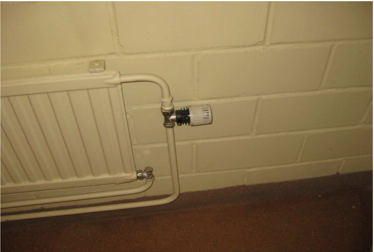
LVI- kuva 3. Yleiskuva patteriventtiilistä.
