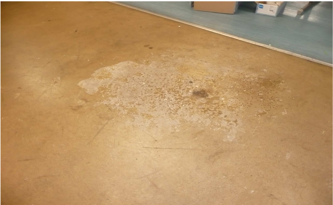
RAK- kuva 18. Opetushallien lattian pinta on rikki.
