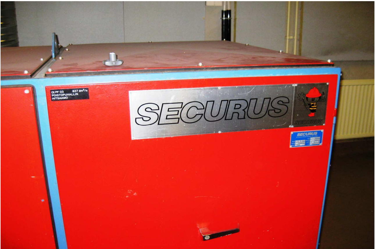
LVI- kuva 17. Koulun työpajan hitsauspaikkojen poistopuhallin.
