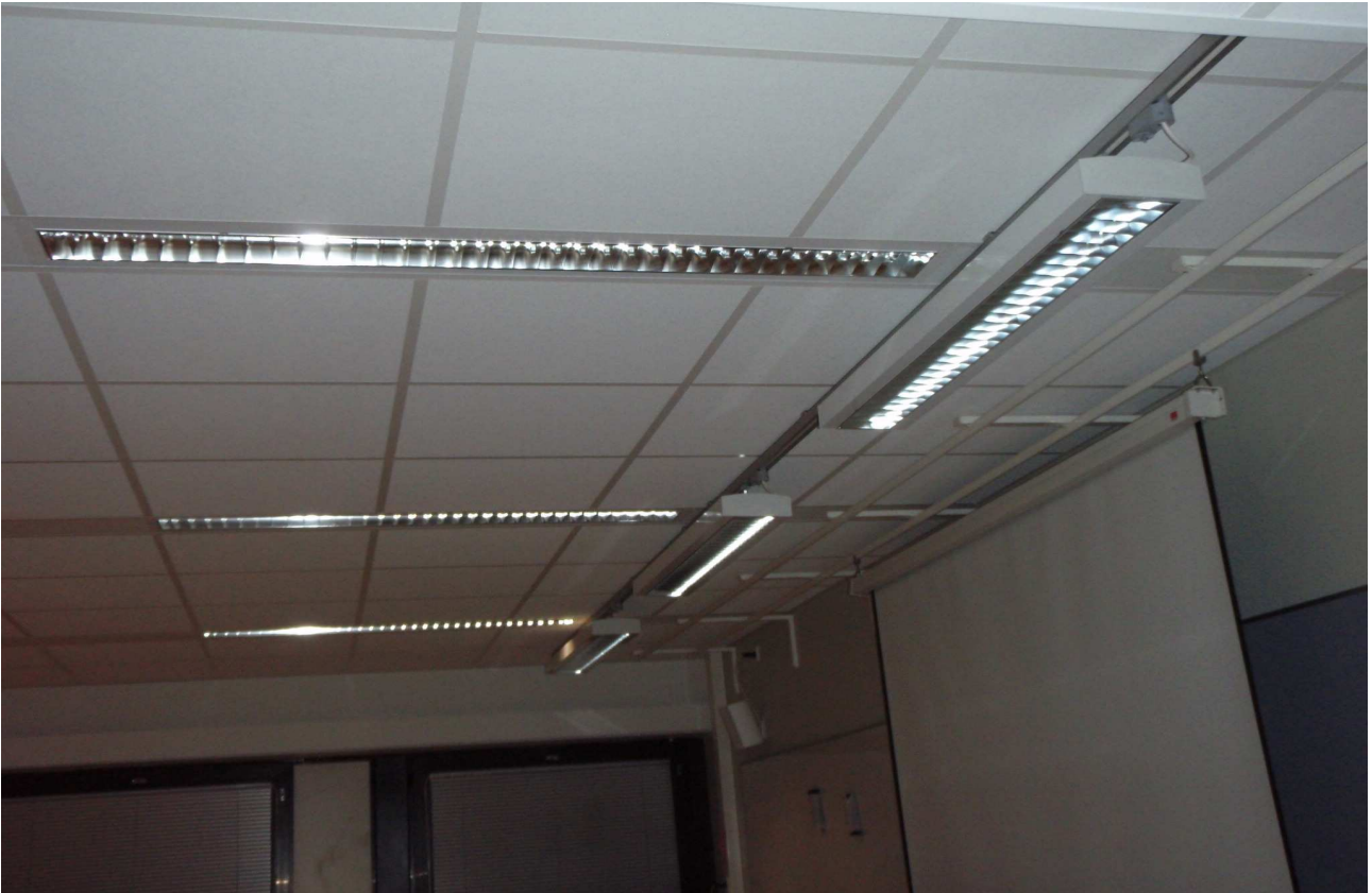
S-kuva 14. Luokkahuoneen valaistus.
