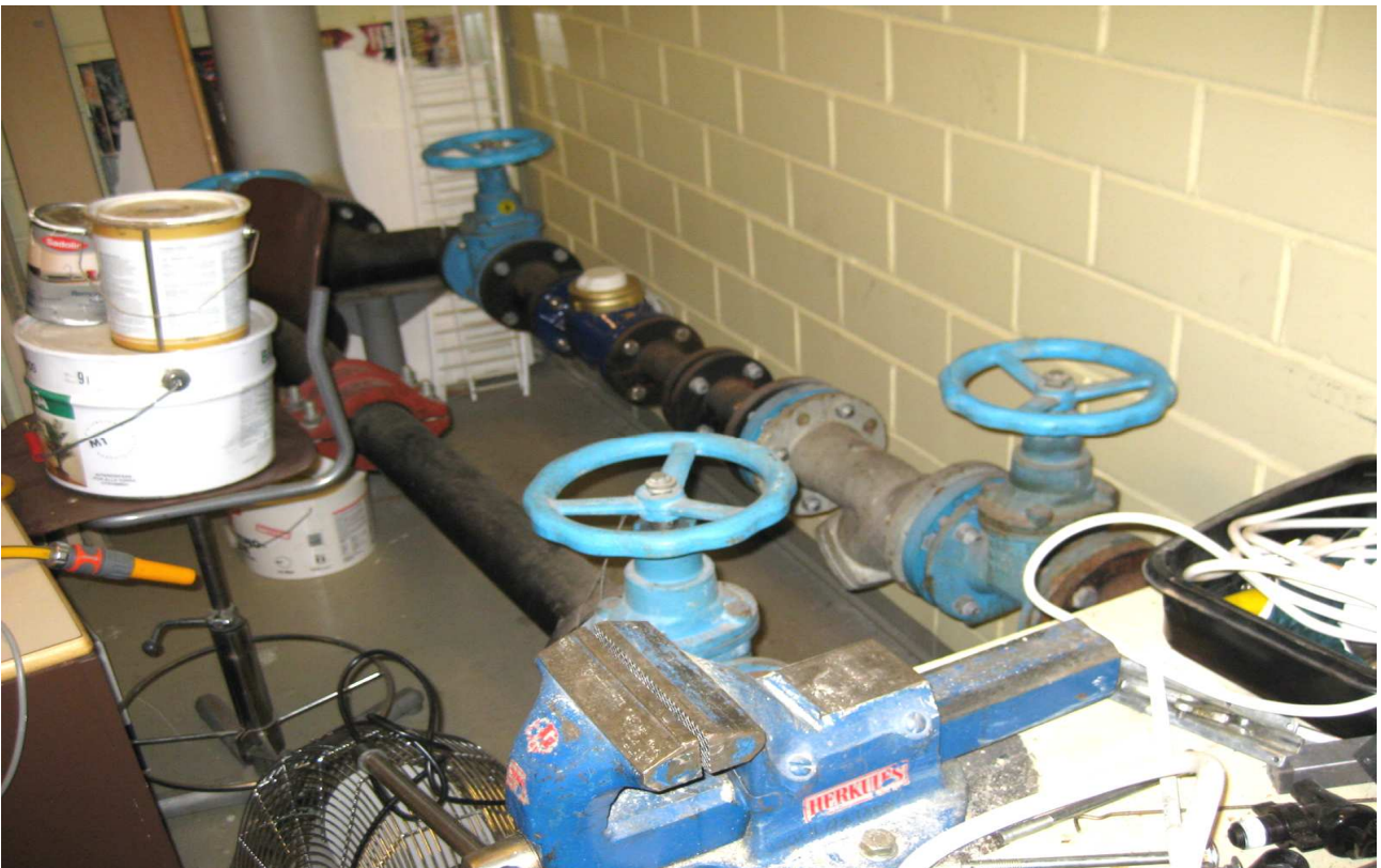
LVI- kuva 4. Yleiskuva vesimittarista ja pääsuluista.
