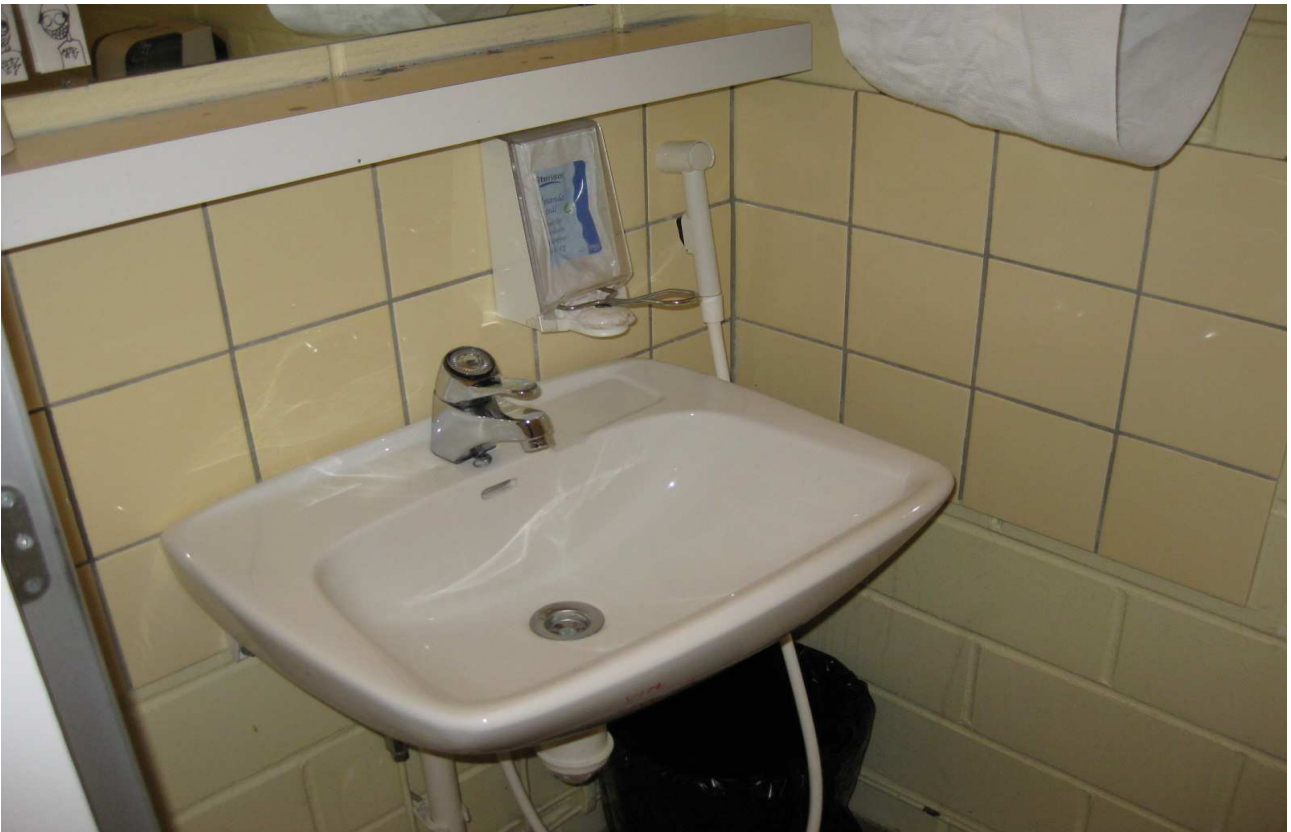
LVI- kuva 6. Yleiskuva koulun vesikalusteista.
