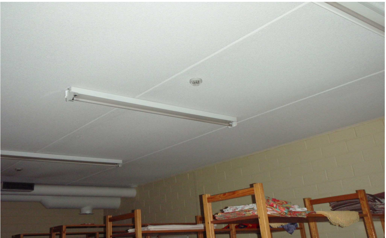
S-kuva 19. Teknisten tilojen valaistus.
