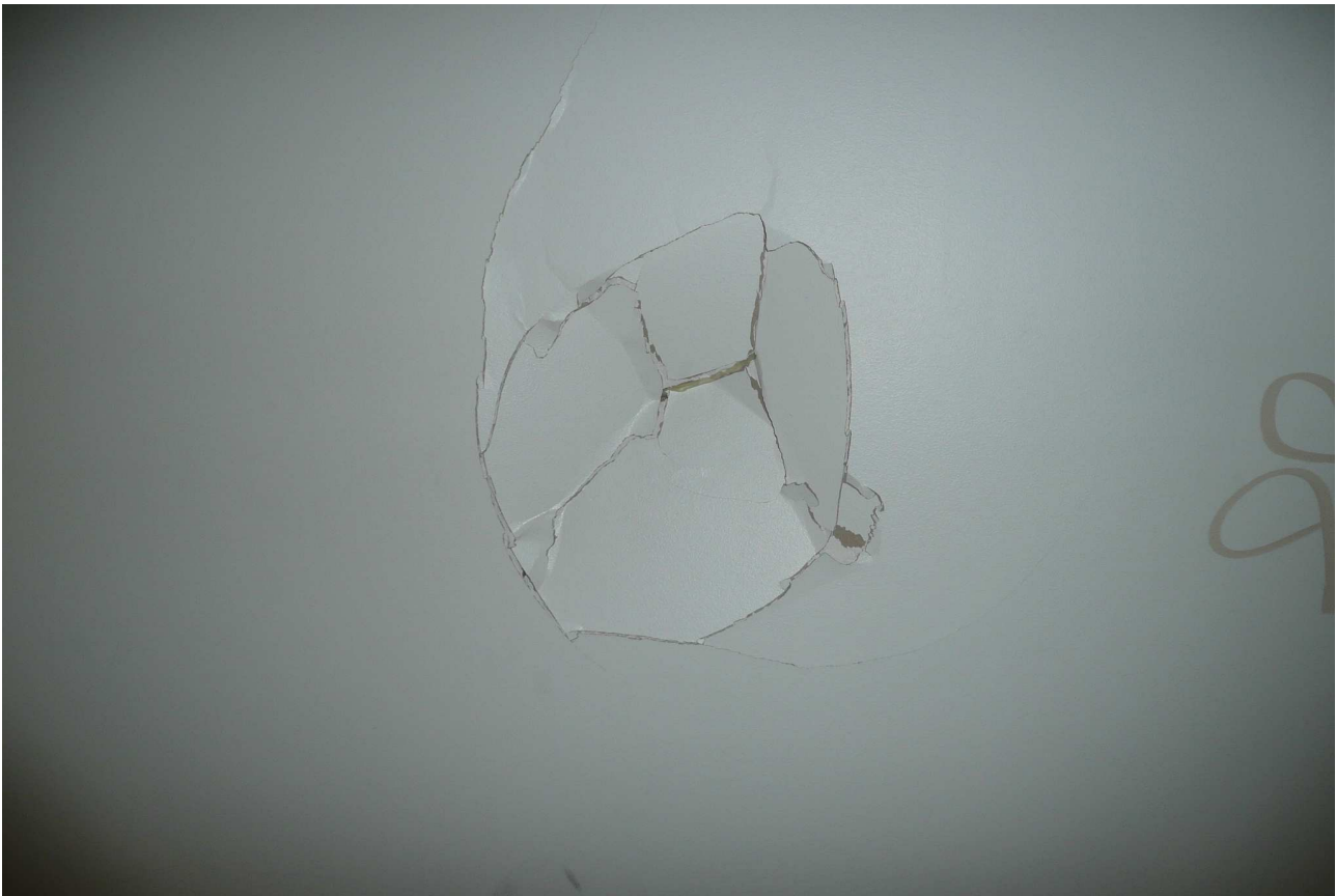
RAK- kuva 17. Seinissä esiintyy käytöstä aiheutuneita kolhuja.
