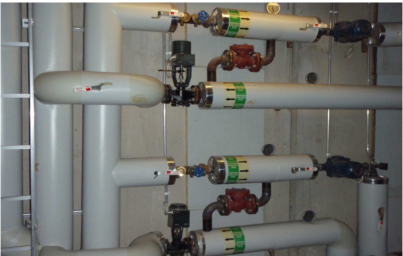
S-kuva 29. Rakennusautomaatiojärjestelmän kentälaitteet.
