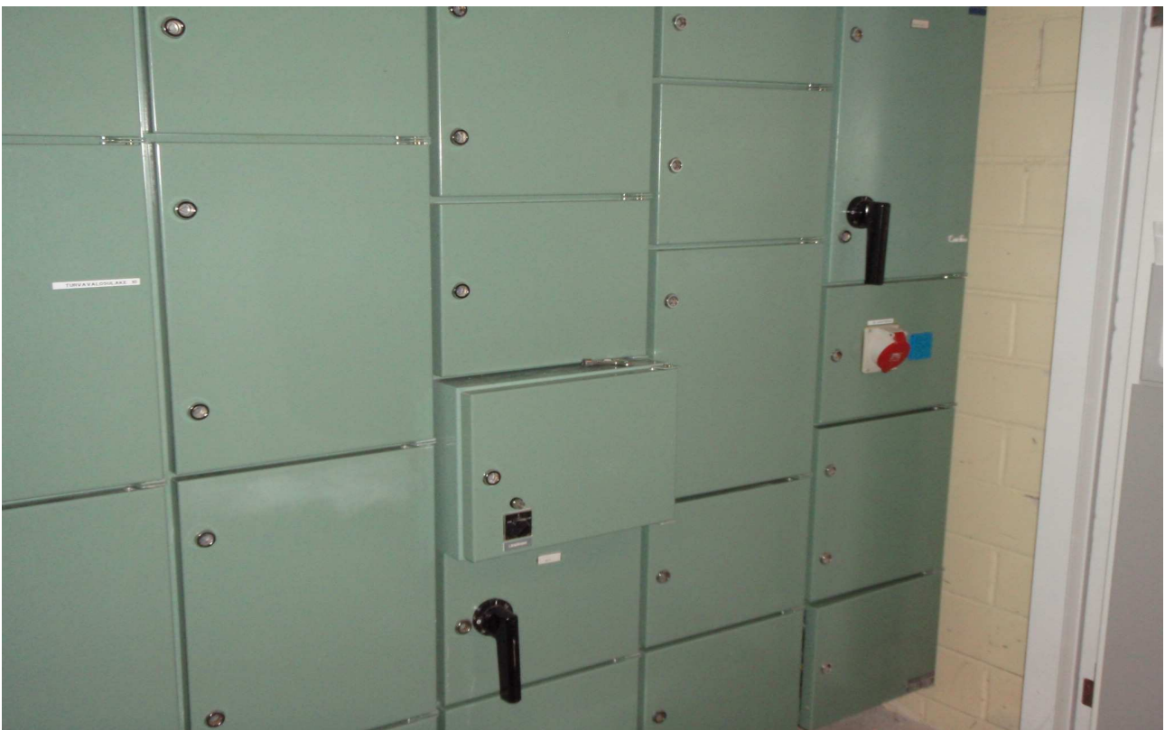
S- kuva 7. Suurkeittiön keskus.
