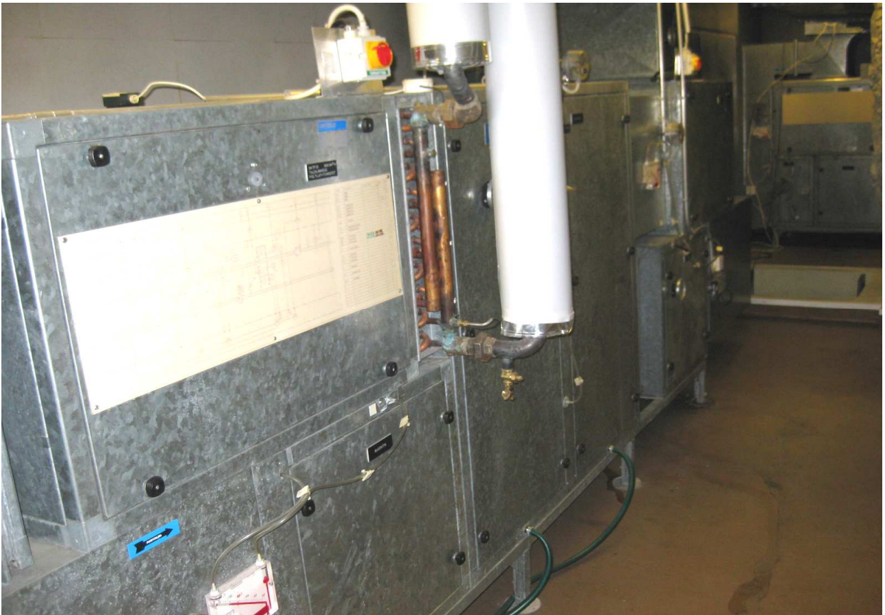
LVI- kuva 9. Yleiskuva koulun alkuperäisestä tuloilmakoneesta.
