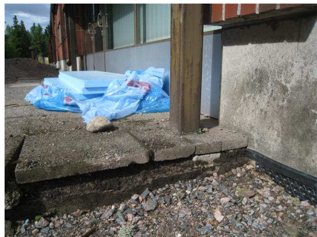
Kuva 40 Sisäänkäyntitason pohjalaatan reunoisissa on betonivaurioita.
