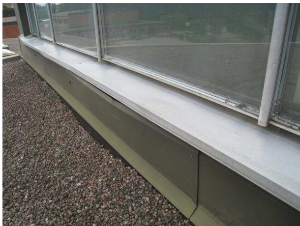
Kuva 53 Kattolyhdyn juuripellityksen reunan ja vesipelin välistä pääsee sadevesi.
