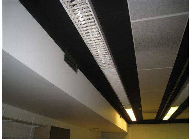
Kuva 32 Ilmanvaihdon tuloventtiilien kohdalla on yleisesti likaa akustiikkalevyissä.
