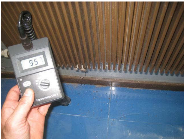
Kuva 57 Kohonnut kosteus ulkoseinän vieressä ja muurahaista tilassa 013 aula.
