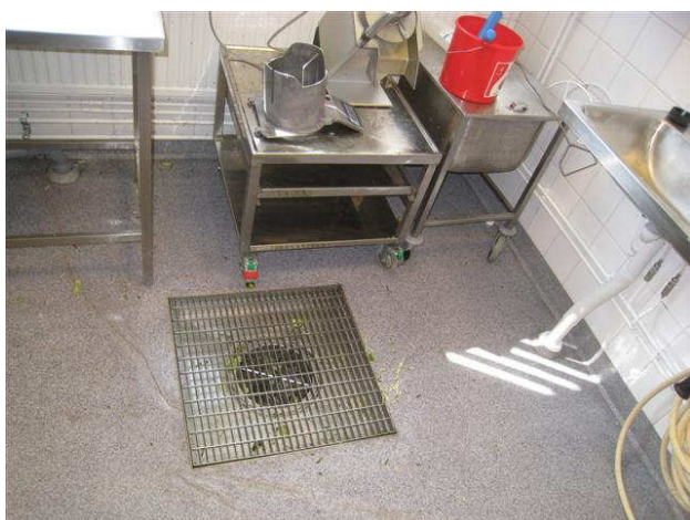
Kuva 29 Ruokalan kunnostetun keittiön 211 lattiassa on halkeilua.
