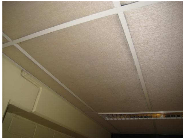
Kuva 27 Alakattolevyissä vanhoja vuotojälkiä porrasaulassa 229.
