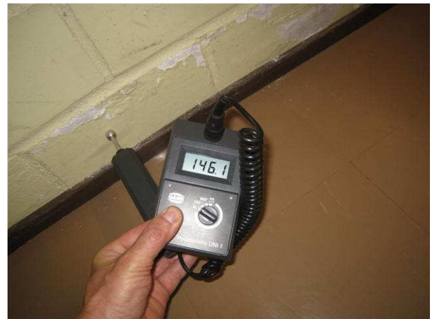
Kuva 22 Selvästi kohonnut kosteusarvo käytävän puolella tilan 297 perkaus kohdalla.
