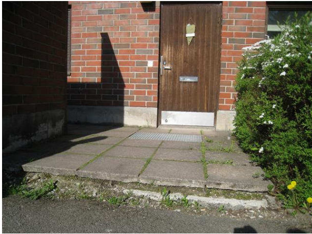
Kuva 67 Pääsisäänkäyntien pohjalaattojen reunoissa on betonivaurioita.
