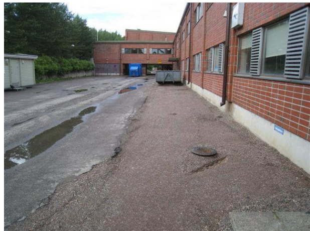
Kuva 2 Länsisivun asfaltin painanteita, sokkeli- vieret ovat kesken salaojatyön jäljiltä.
