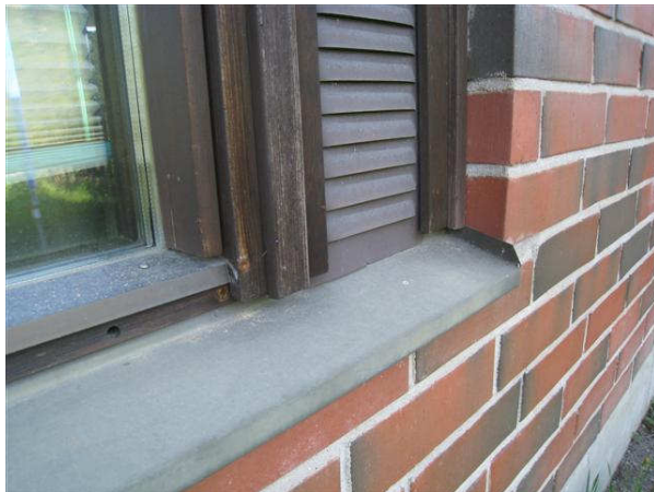
Kuva 69 Ikkunoiden ulkopinnat ovat kuluneet.
