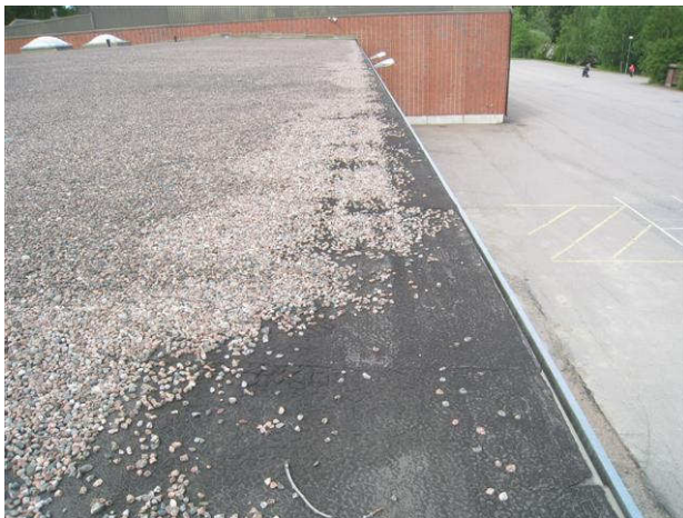
Kuva 45 Sivuräystäällä singeli on lähtenyt veden mukana ja kermi on pahoin halkeillut.
