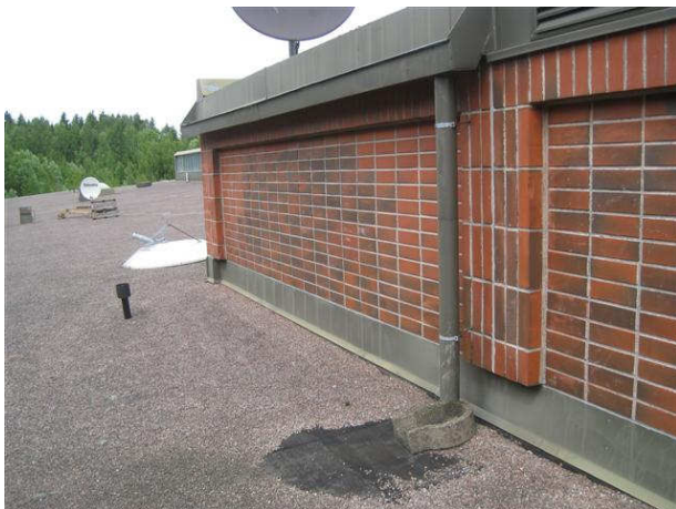
Kuva 51 Ylemmän vesikaton vedet ovat isirtäneet suoja-singelin, huopa on halkeillut.
