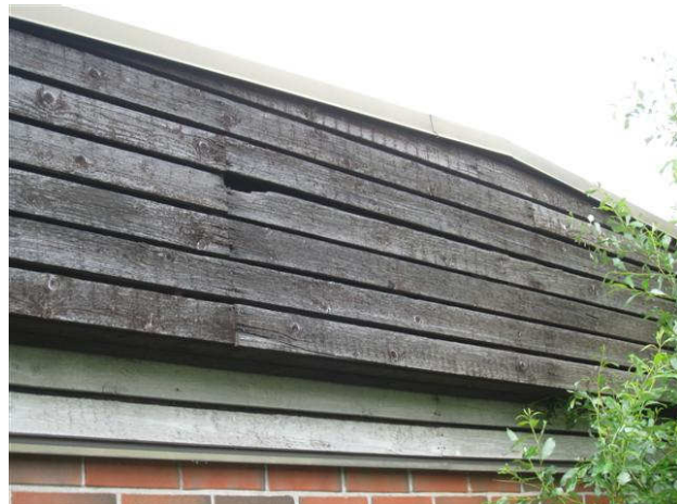
Kuva 64 Eteläpäädyn otsalautoitus on huonokuntoinen.
