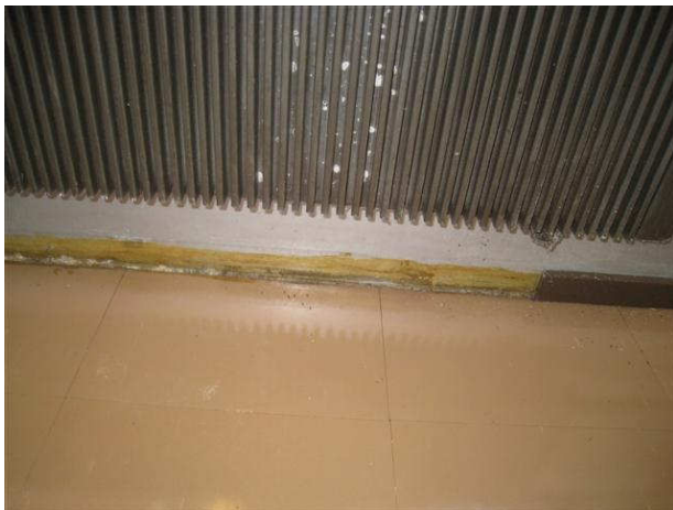
Kuva 15 Koulun 1. krs:n aulan 303 lattiasa havaittiin kohonnutta kosteutta.
