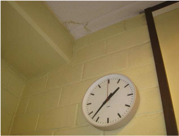
Kuva 31 Vuotojälkiä 2. kerroksen yläpohjassa rephuoneessa 428.
