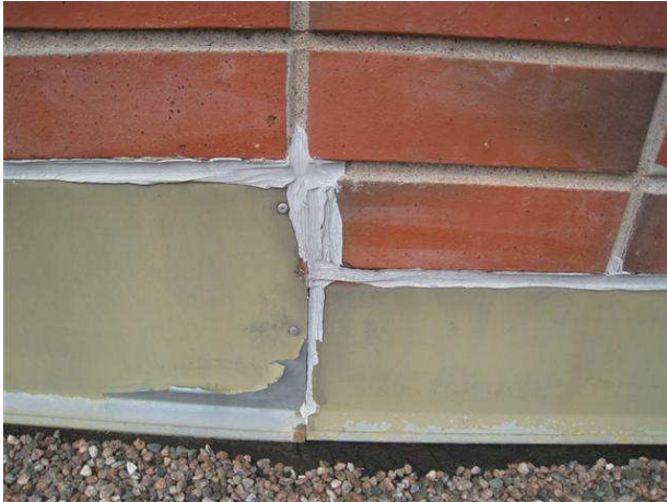
Kuva 49 Vesikaton juurinosopellityksen pinta on kulunut, tiivistysmassa on huonokuntoinen.
