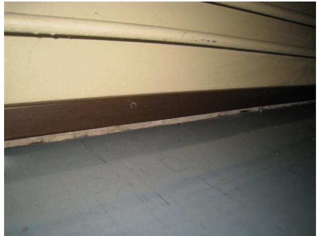
Kuva 56 Lattia on painunut ammattiluokka 058 kohdalla ulkoseinällä, lisäksi muurahaisia ja kohonnut kosteus, "oireilua".
