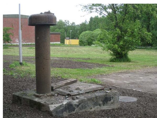
Kuva 6 Väestönsuoja 320:n varaulospääsyn betonirakenne on huonokuntoinen.
