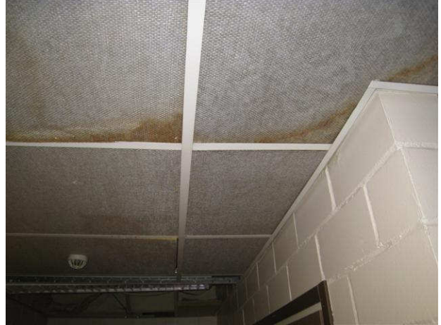
Kuva 26 Selviä vuotojälkiä liikuntasalin käytävällä 185 korkean ja matalan osan rajalla.
