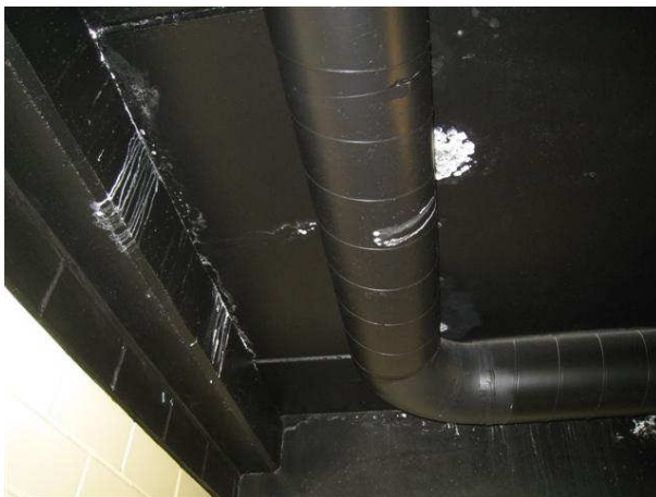
Kuva 59 Katon vuotojälkiä ja kosteusvaurioita tilassa pukuhuone 106.
