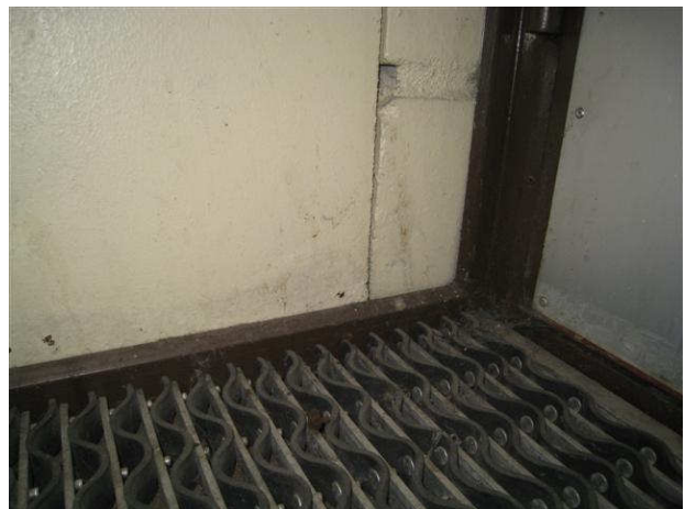
Kuva 58 Alareunastaan turvonnut lastulevy pohjoispäädyn tilassa TK 011.
