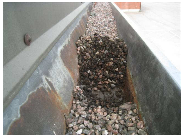
Kuva 46 Ränneissä oli paksu kerros singeliä, rännipellit ovat osin ruosteessa.
