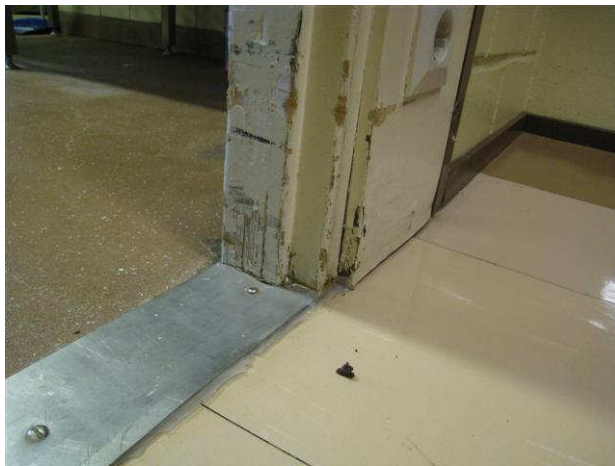
Kuva 21 Kulunut keittiön ovi, levypielessä on kosteusvaurio, epätiivis kynns.
