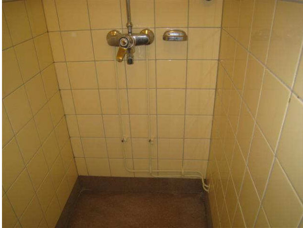
Kuva 25 Oppilaiden suihkutila 306, alkuperäinen massapintalattia.
