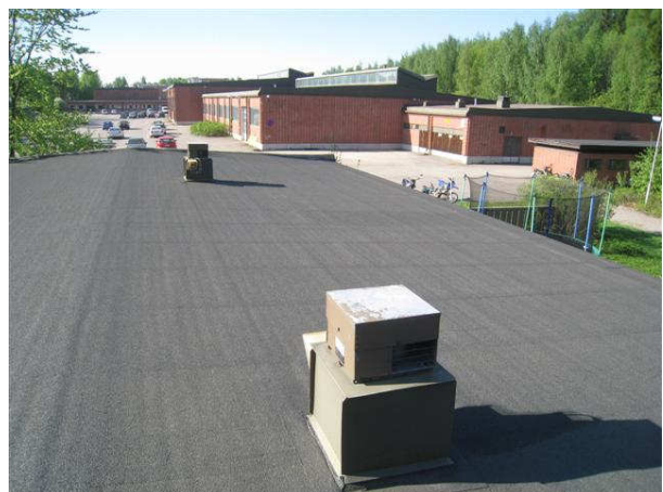
Kuva 72 Yleiskuva vesikatolta, alapuoliseen onteloon ei ollut pääsyä, kate vaikutti uusittulta. Musta kate ikääntyy auringossa vaaleaa nopeammin.
