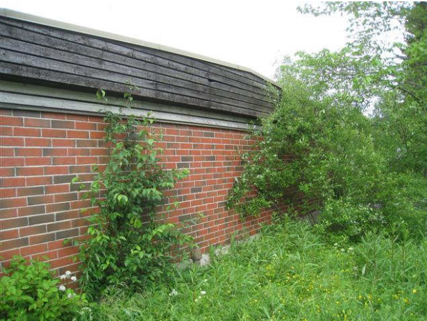
Kuva 63 Eteläpäädyssä maanpinta on tasainen ja turhan ylhäällä lattia-/ alapohjarakenteisiin nähden.
