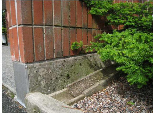
Kuva 8 Koulurakennuksen 2. kerroksen pääsisäänkäynnin viereinen istutusallas.
