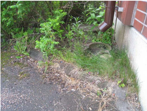
Kuva 39 Itäsivulla rännivesiä on vuotanut sokkelin viereen.
