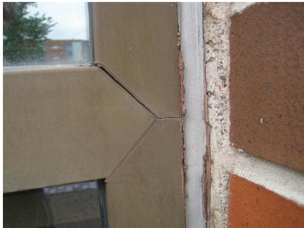
Kuva 9 Kiinteän muovi-ikkunan jiirit ovat auki, tiivistysmassaus on tehty vanhan massan päälle, liittymä ei ole tiivis.
