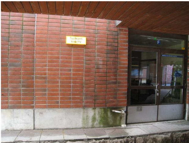
Kuva 37 Työpajarakennuksen eteläpäädyn tiilipinnan vesijälkiä + sammalta.
