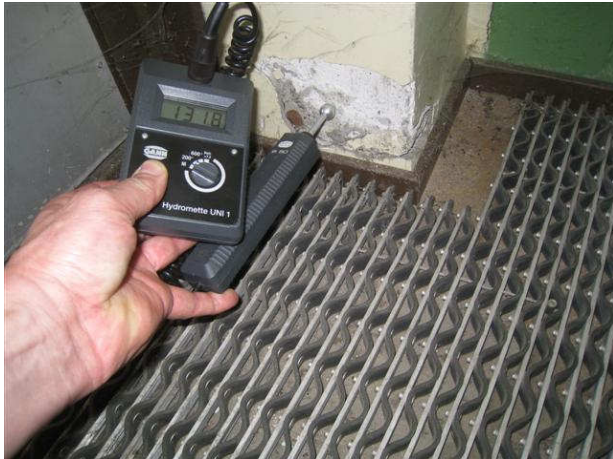
Kuva 55 Kohonnut pilarin juuren kosteus länsisivulla TK 101 ulkoseinällä.
