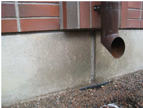
Kuva 3 Syöksytorvivedet ovat kuluttaneet sokkeleita.
