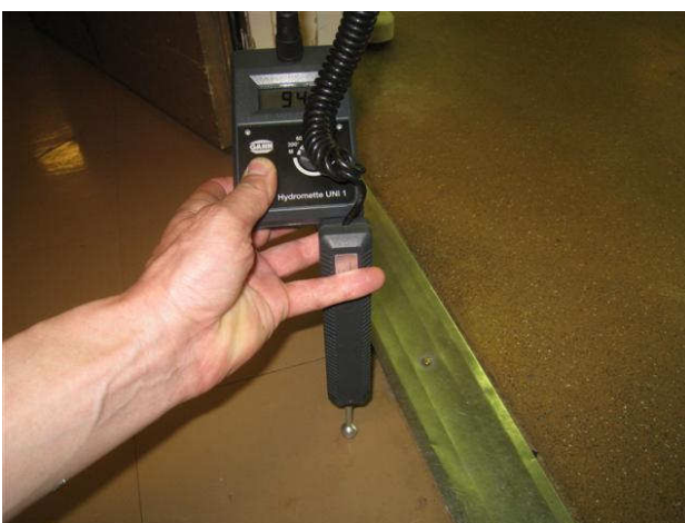
Kuva 17 Käytävällä 230 oli kosteus koholla opetuskeittiön 274 ovikynnyksen vieressä, josta vesi pääsee käytävälle.
