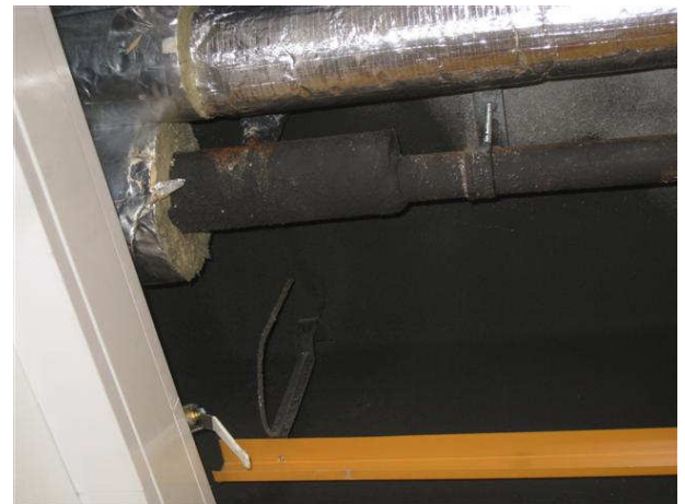
Kuva 28 Porrasaulan 229 alakaton vuotojälkien kohdalla on putkia alakattotilassa.
