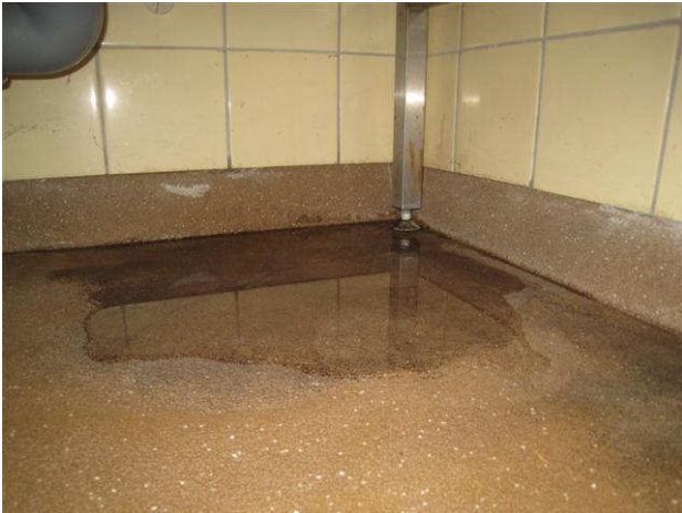
Kuva 19 Työsali 292 nurkassa lattiakaatoa ei ollut.
