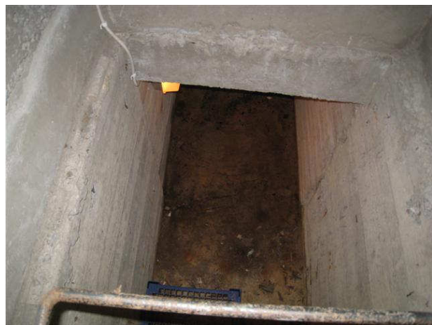
Kuva 16 Koulun väestönsuoja 320:n poistustunnelissa oli kosteutta ja vesijälkiä.
