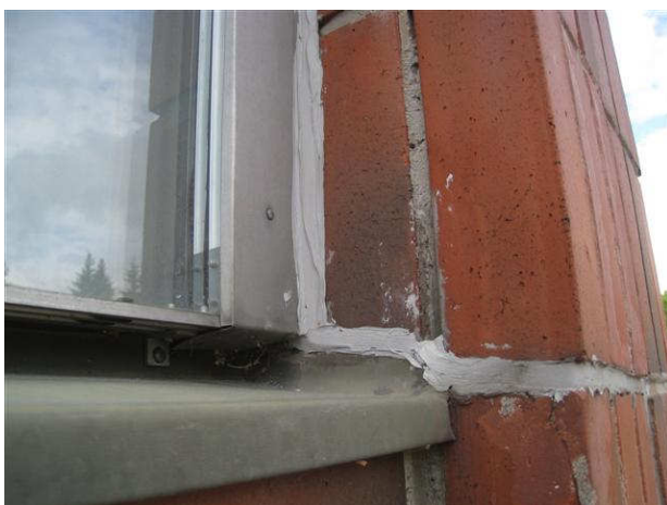
Kuva 41 Työpajarakennuksen itäsivun työsalin ikkuna, jonka alareuna ei ole eristeen kohdalla.
