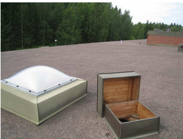
Kuva 47 Vesikaton pellitykset ovat haalistuneet. Kulkuluukku eteläosan yläpohjaonteloon.
