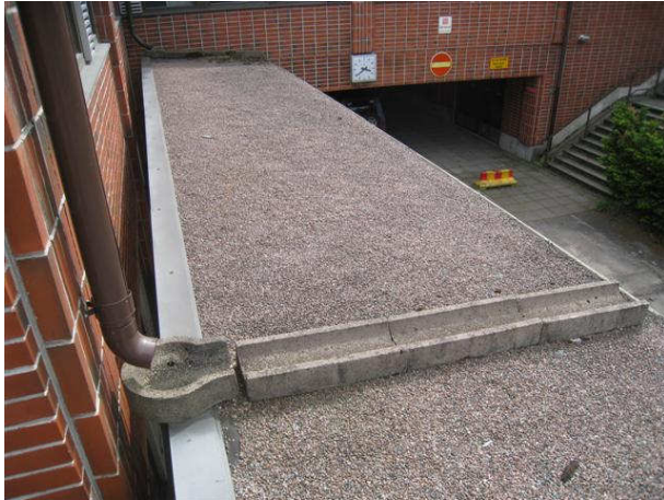
Kuva 13 Koulun länsisivun katoksen yli on johdettu 2. krs:n vesikaton sadevesiä.
