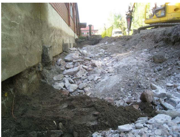
Kuva 35 Länsisivulla kalliota on poistettu, sokkelissa ei ole alun perin kosteussuo-
