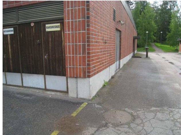
Kuva 38 Työpajarakennuksen pohjoispääty, itäsivun puuovet ovat huonokuntoiset.
