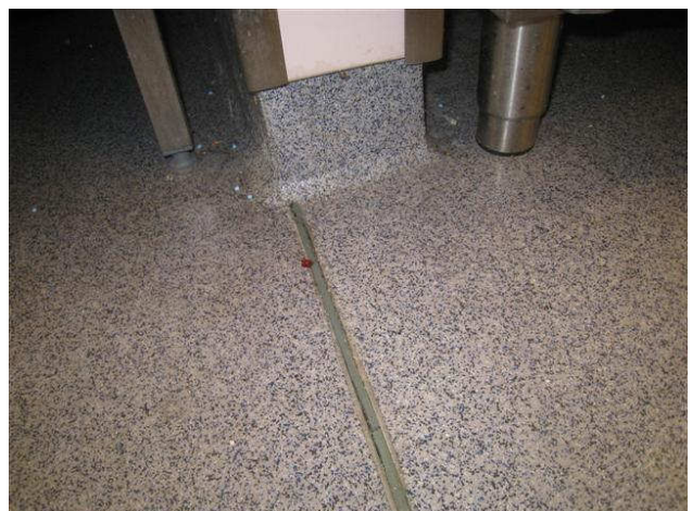
Kuva 30 Ruokalan keittiön 211 liikuntasauaman tiivistyskitti on halki.
