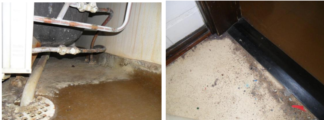
Kuva 1 ja 2. Ammeen alla likaa sekä keittiön kynnykslistan vieressä..
