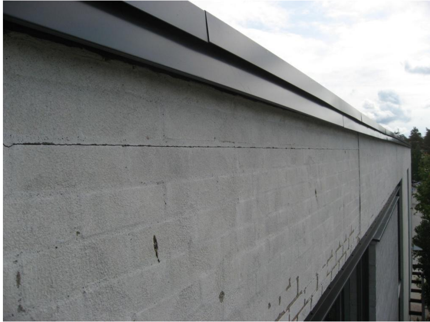
Kuva 5. Näytteenottokohdan T2 yläpuolella on pitkä halkeama vaakasauman ja tiilen rajapinnassa. Silmämääräisesti näyttää siltä, että kymmenkunta alinta tiiliriviä on painunut hieman alaspäin.
