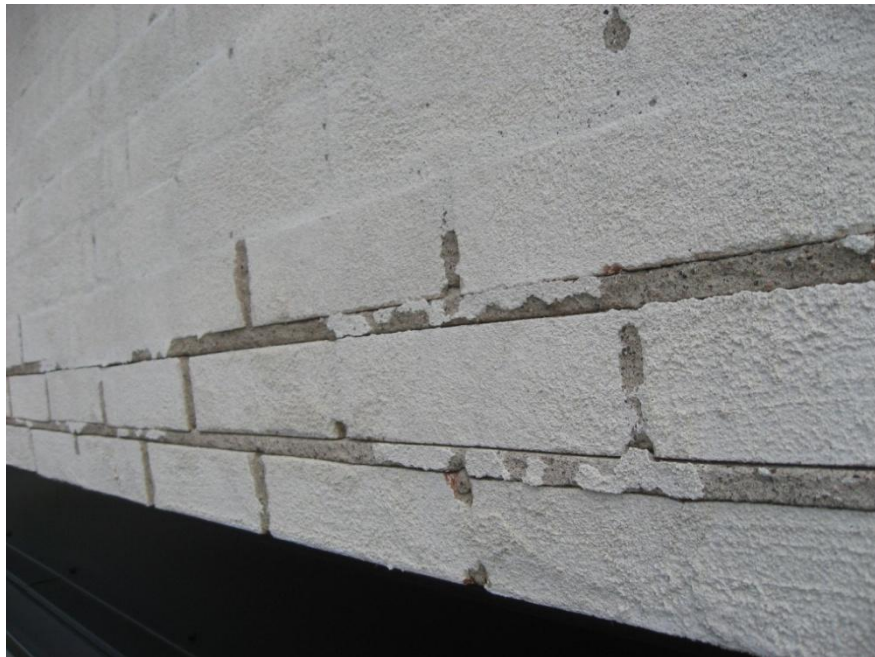
Kuva 4. Näytteenottokohdan T2 alapuolelta kuultorappaus on irronnut saumoista. Vaakasaumojen laasti on irronnut tiilestä. Silmämääräisesti näyttää siltä, että 2 alinta tiiliriviä on painunut hieman alaspäin.
