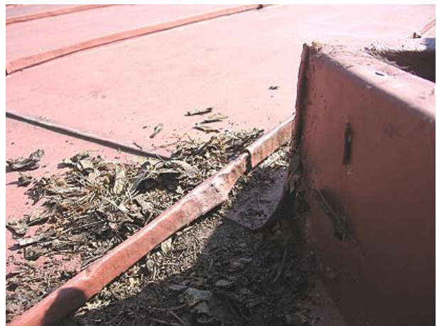
Kuva 10 Kattoluukkujen kohdilla havunneulasia, lehtiä yms. läjittyneenä. Em. kohdissa oli havaittavissa alkavaa ruostumista.
