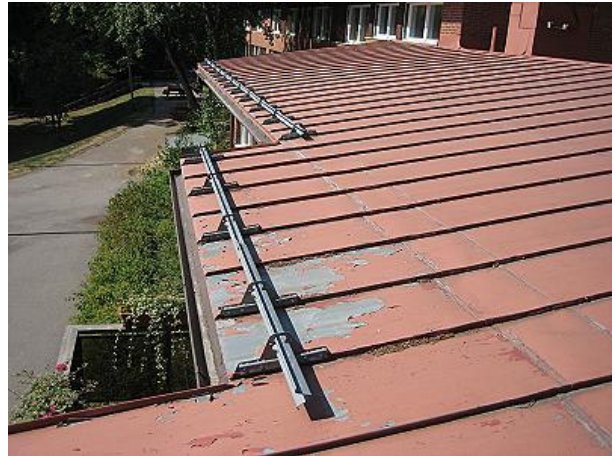
Kuva 2 Maalia irronnut tien puoleisen terassin kohdalta.
