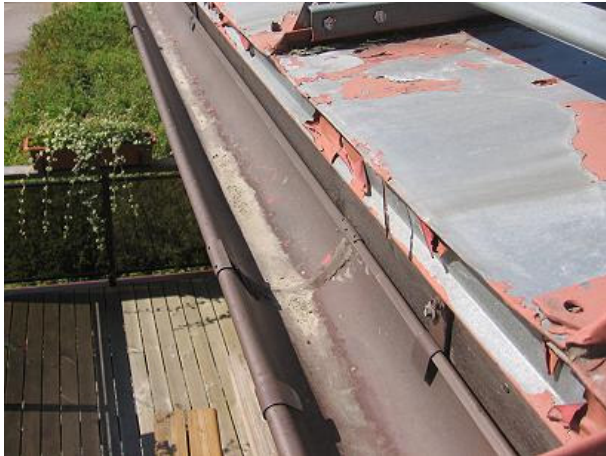
Kuva 3 Tien puoleisella sivustalla rännin sijoitus räystääseen nähden oli puutteellinen ja räystäään suojapelti (riippupelti) puuttui kokonaan
