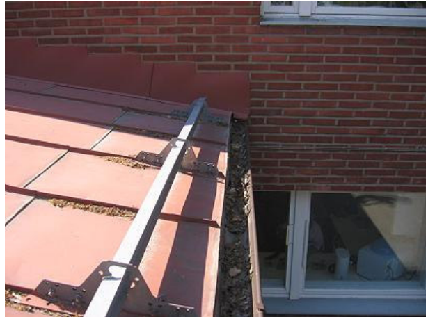
Kuva 4 Räystäskouruissa oli runsaasti havunneulasia, lehtiä yms. Syöksytorvet olivat paikoin tukossa. Rintataite päätetty tiilien väliin. Peitetty laastilla.
