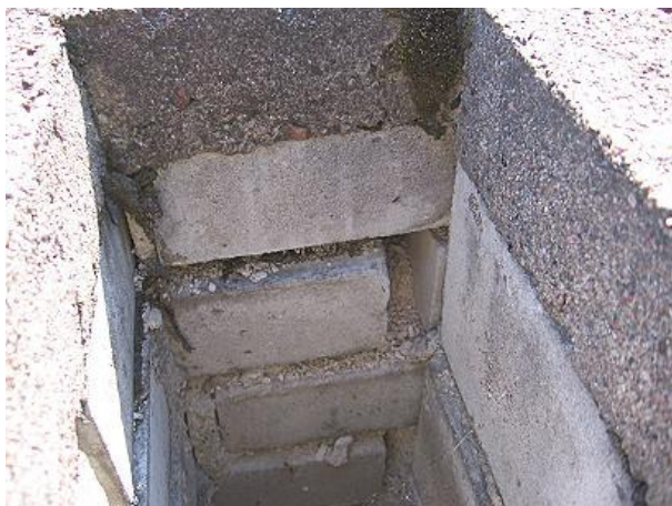
Kuva 11 Hormien sisäpuoliset muurauslaastit olivat rapautuneet pahoin.
