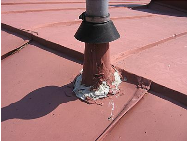
Kuva 13 Antenniläpiviennin tiivistys vaikutti puutteelliselta.
