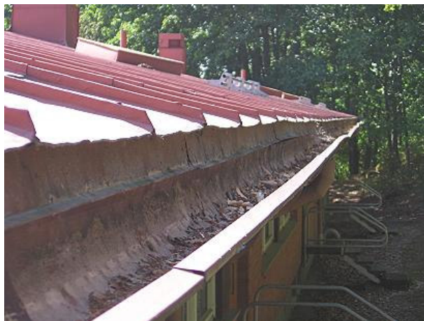
Kuva 9 Räystäskouruissa oli runsaasti lehtiä yms.
