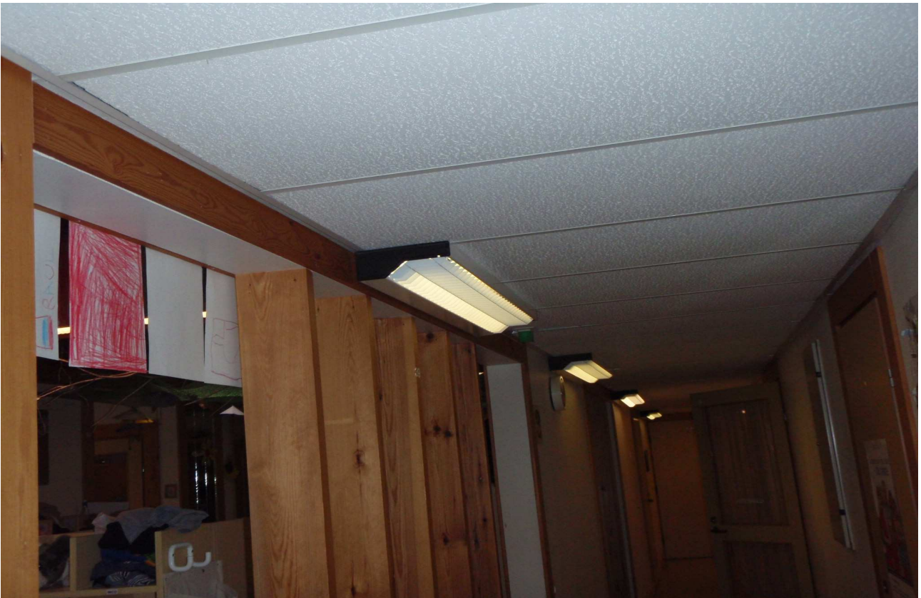
S- kuva 7. Käytävän valaistus.
