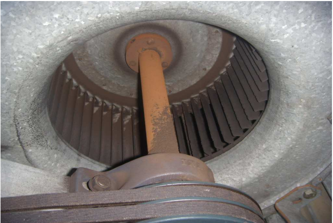
LVI- kuva 11. Tuloilmapuhallin on nokinen ja pölyinen.
