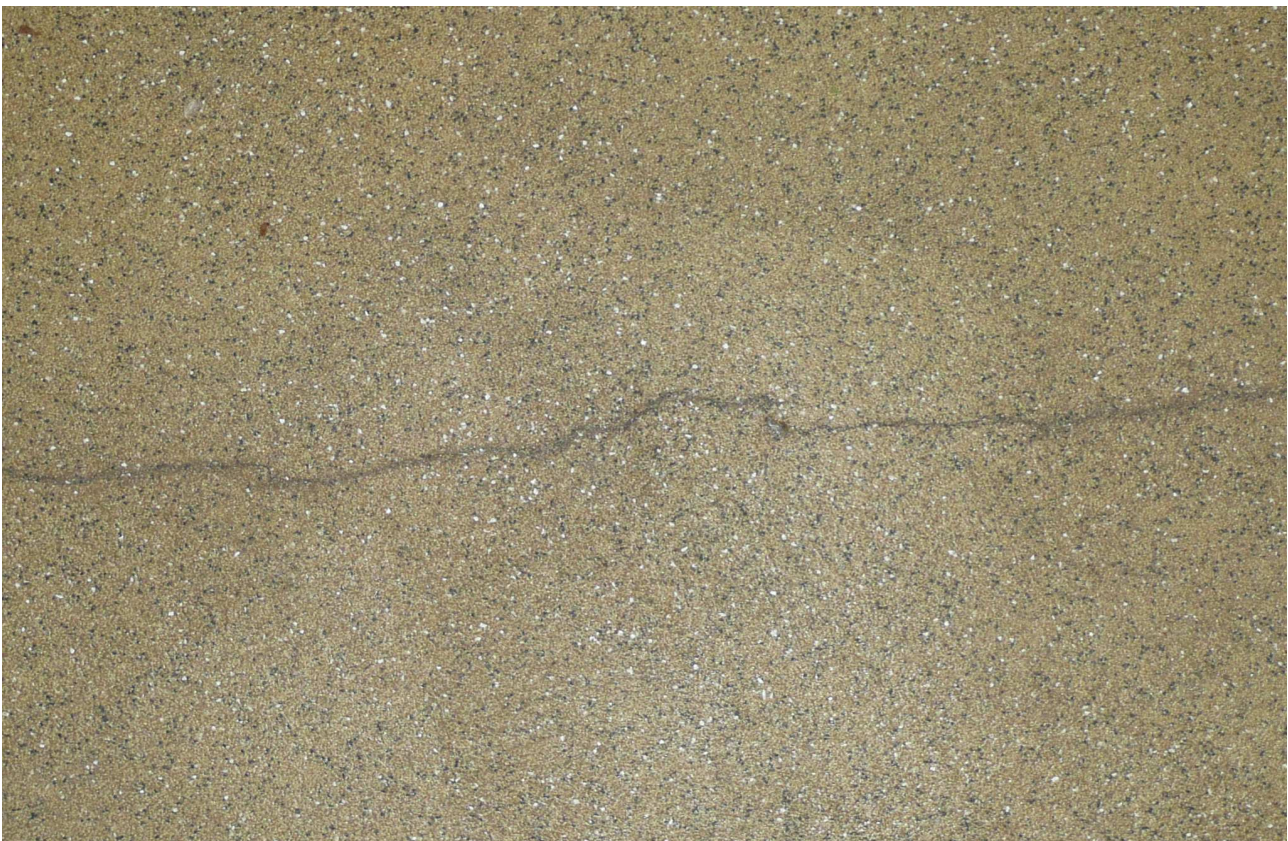
RAK- kuva 12. Keittiön lattiassa on halkeamia.
