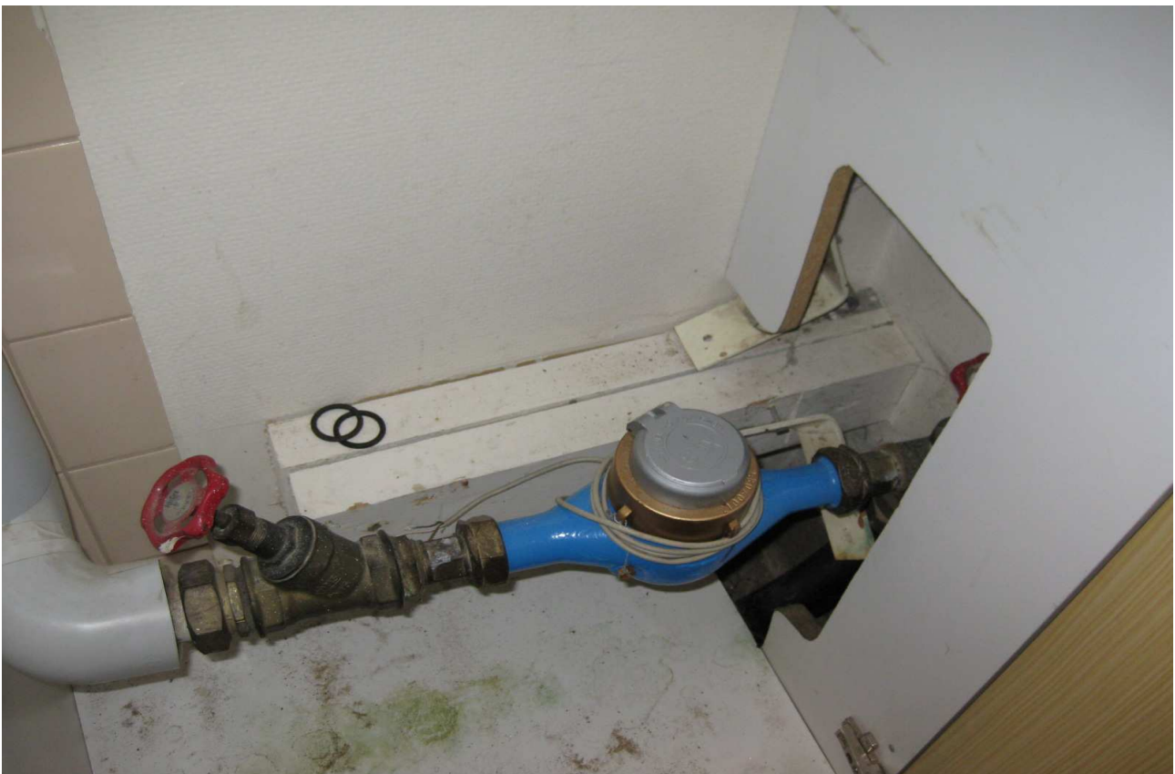
LVI- kuva 4. Yleiskuva vesimittarista ja pääsuluista.
