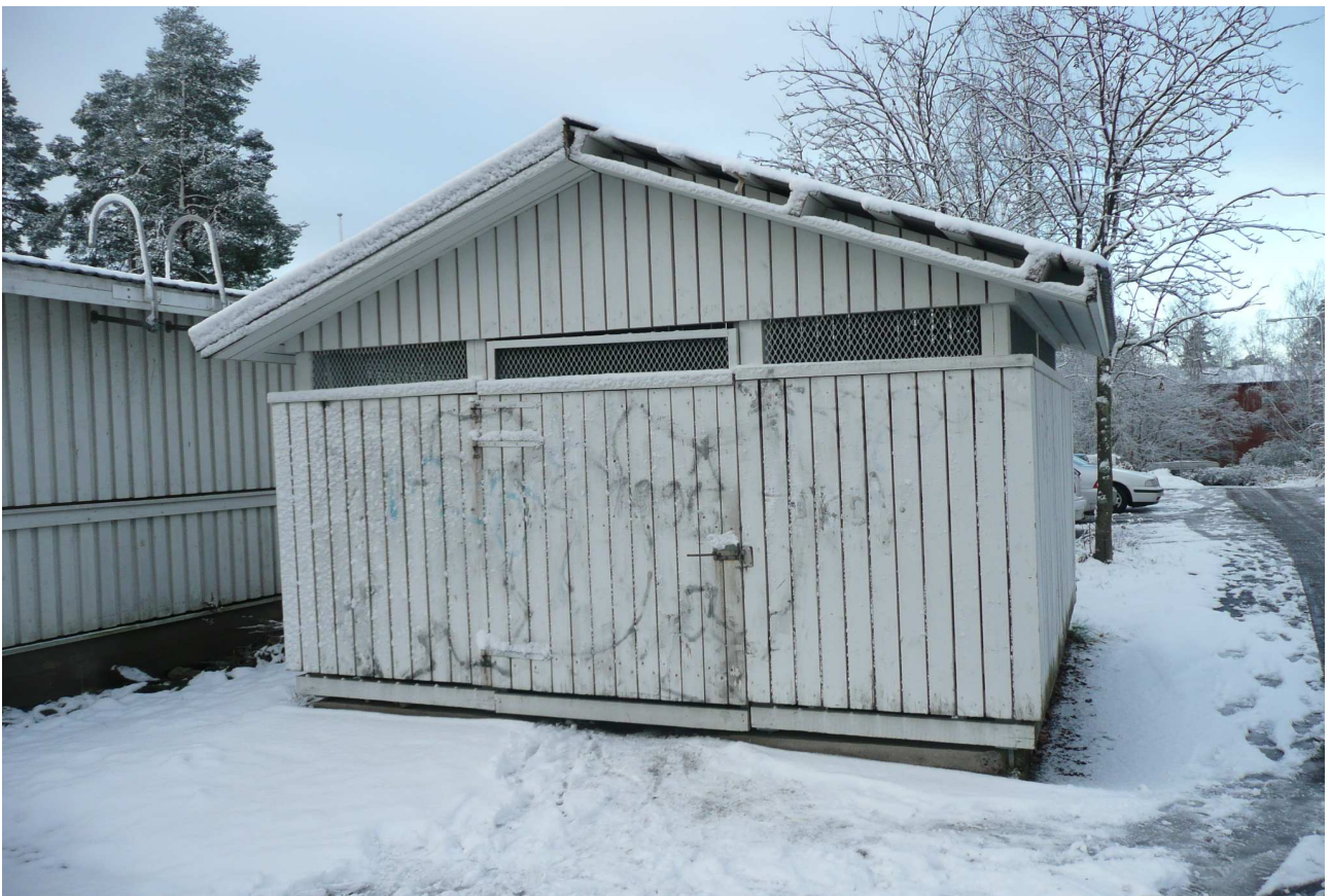
RAK- kuva 4. Katoksen julkisivussa esiintyy värvaihteluja ja pinnan tummumista sekä katoksen maalipintaa on sotkettu.
