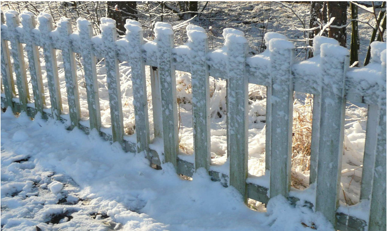
RAK- kuva 3. Aidan maalipinnassa esiintyy pinnan tummumista.
