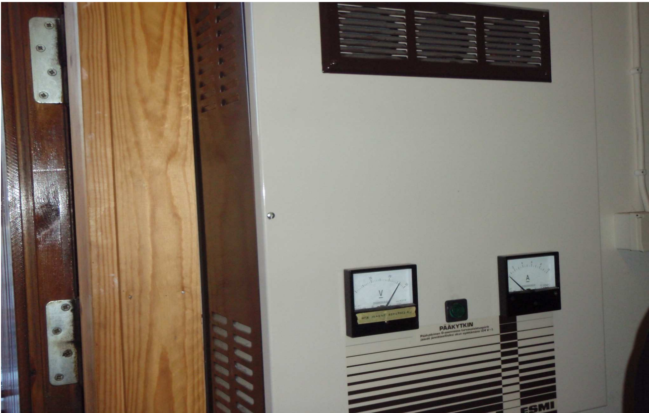
S- kuva 13. Ovimerkkivalaistusjärjestelmän keskus.
