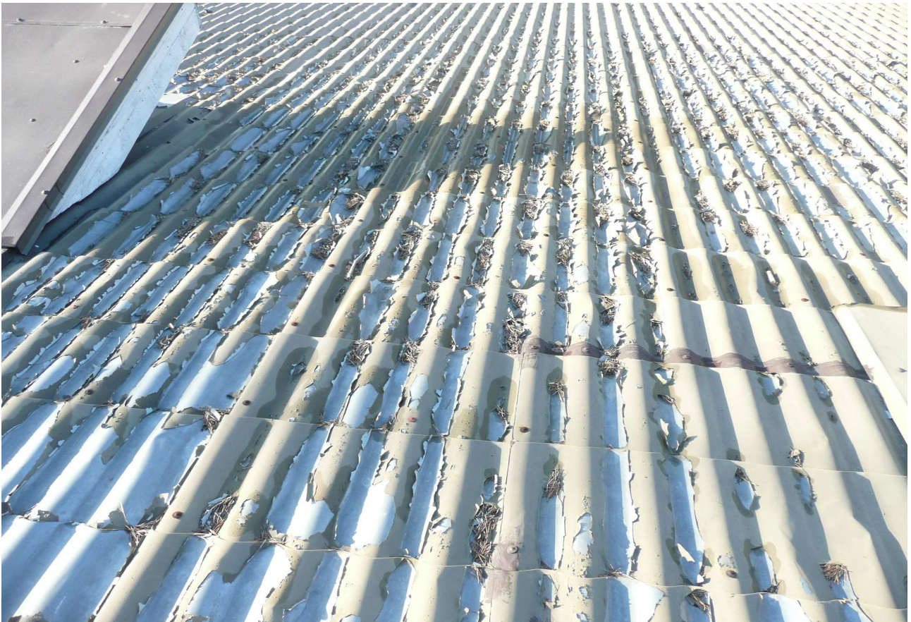
RAK- kuva 9. Vesikaton maalipinta hilseilee voimakkaasti.
