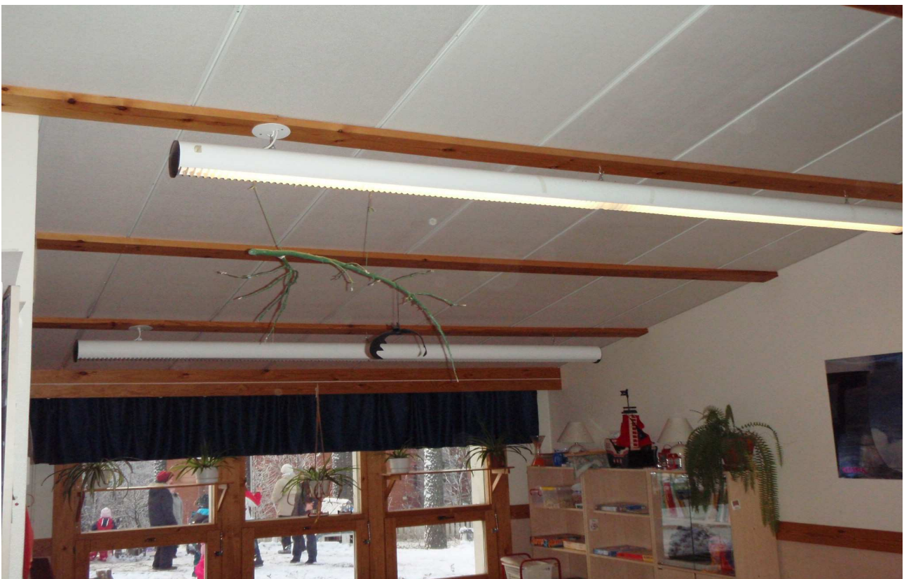
S- kuva 6. Huoneiden valaisimet.
