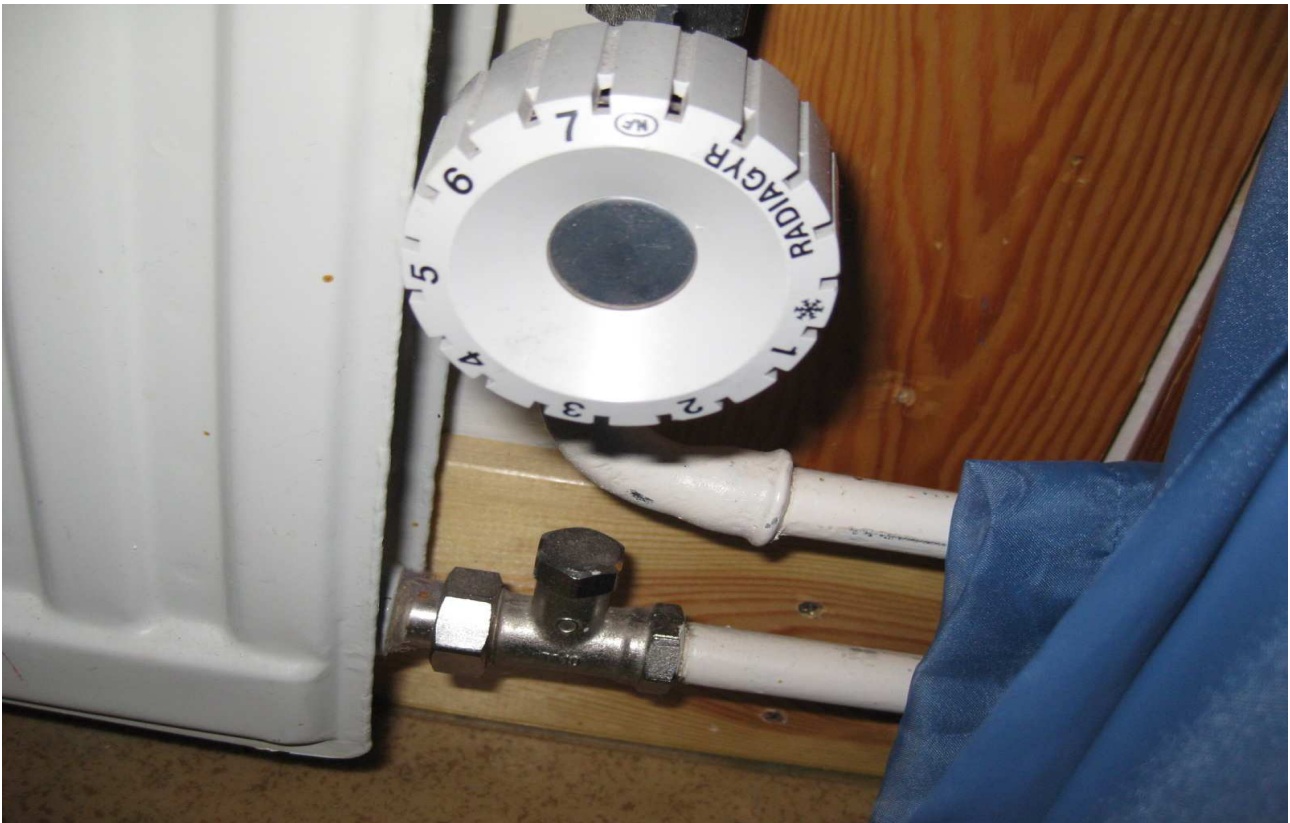
LVI- kuva 3. Yleiskuva patteriventtiilistä.
