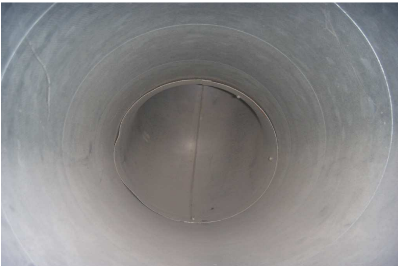
LVI- kuva 14. Yleiskuva poistoilmakanavasta.
