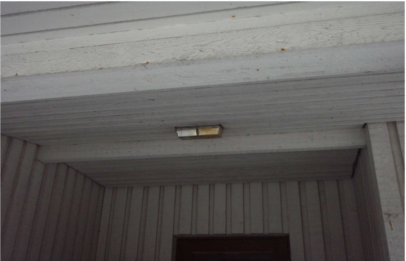
S- kuva 1. Sisäänkäynnin valaistus.
