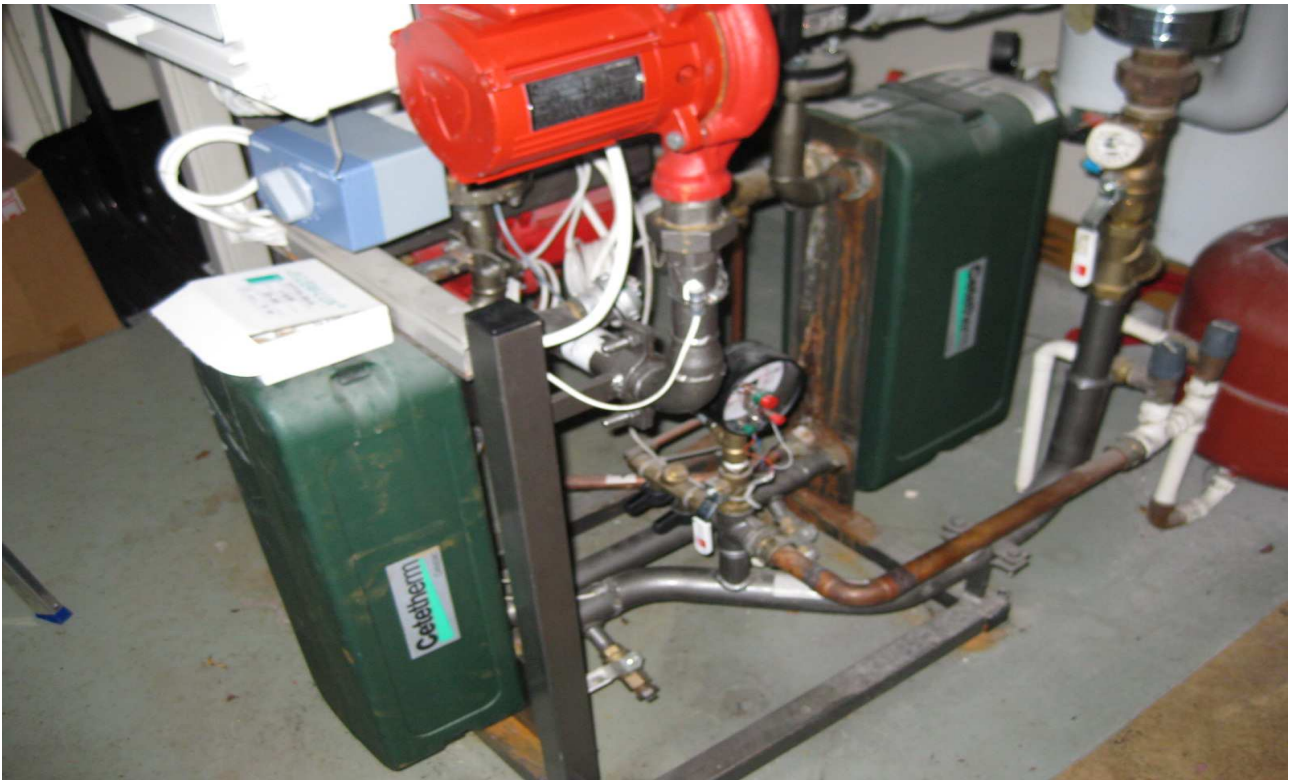
LVI- kuva 1. Yleiskuva lämmönjakohuoneesta.
