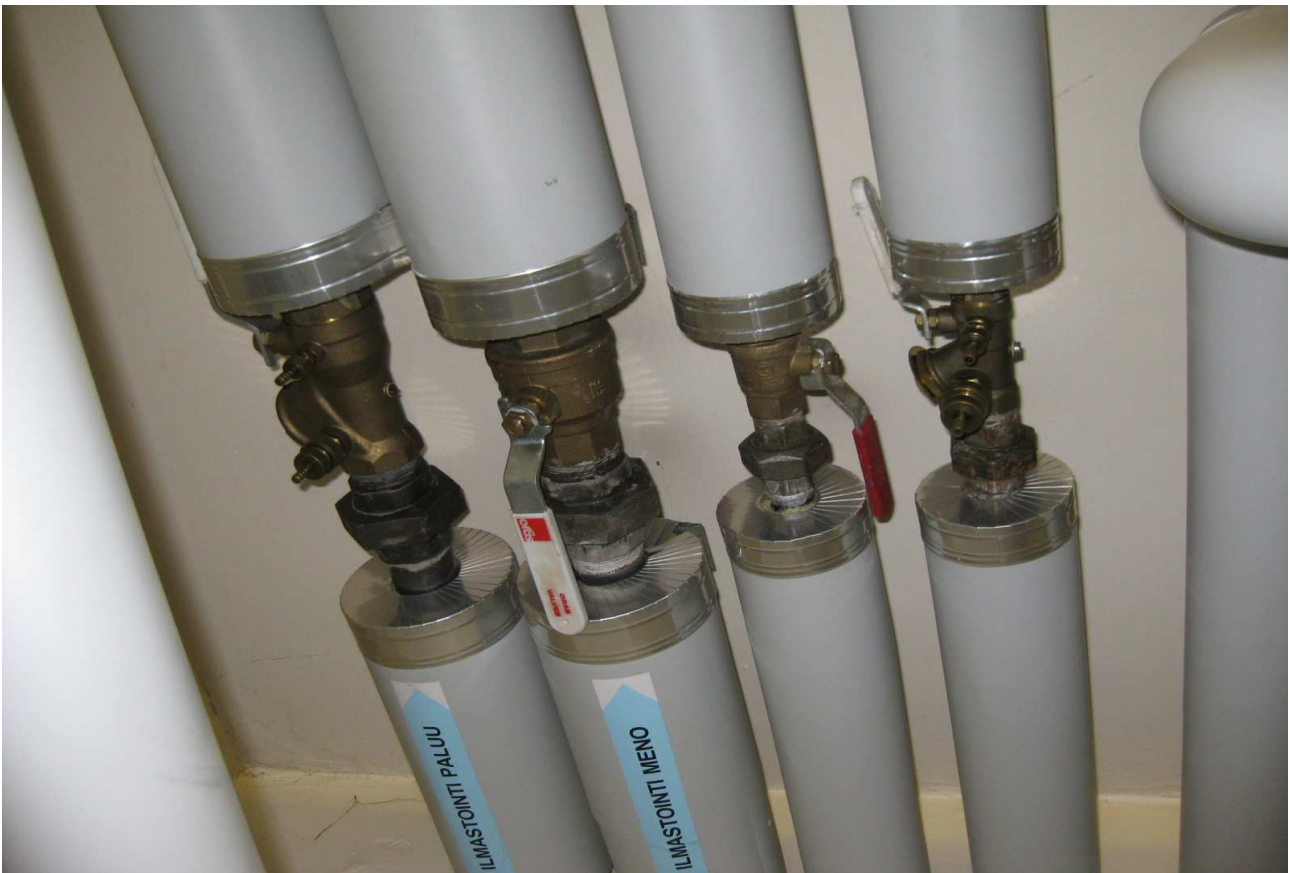
LVI- kuva 2. Yleiskuva lämpöjohtoverkoston venttiileistä.
