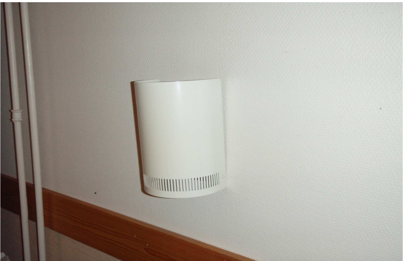
S- kuva 8. Seinävalaisin.
