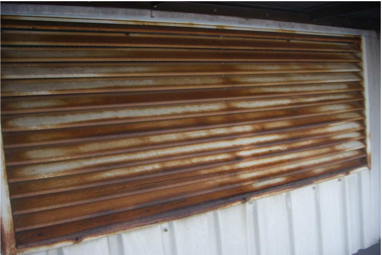
LVI- kuva 9. Tuloilmakoneen ulkosäleiköt ovat ruosteessa.
