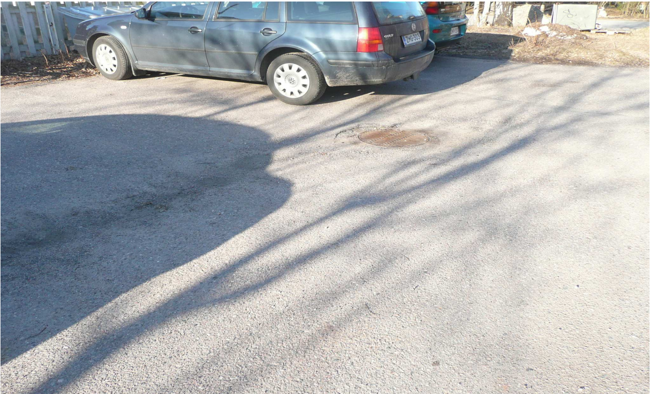
RAK- kuva 1. Asfaltissa esiintyy halkeamia ja painaumia.
