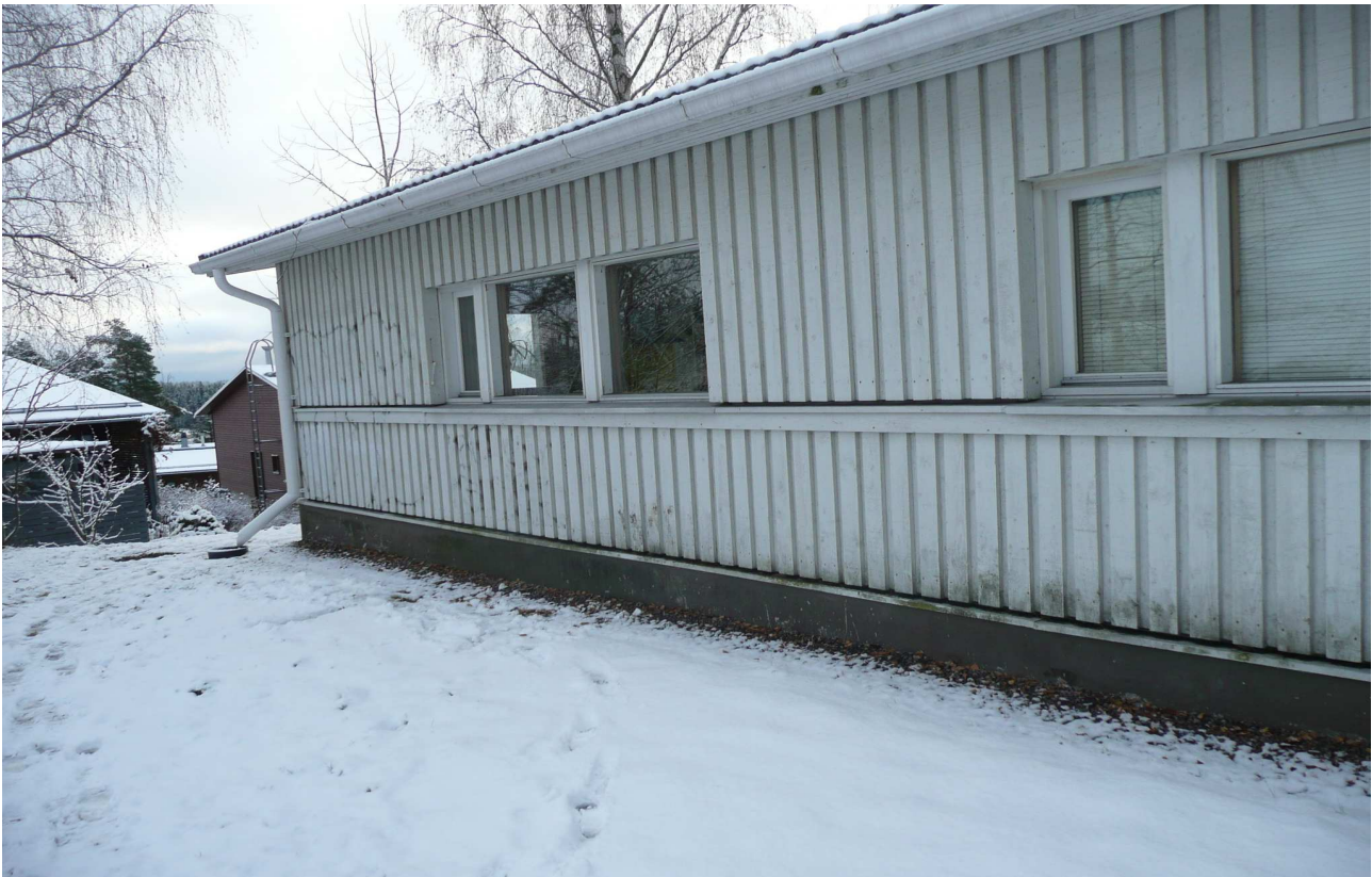
RAK- kuva 7. Rakennusten puujulkisivujen maalipinnassa esiintyy säännöllisesti pinnan tummumista.
