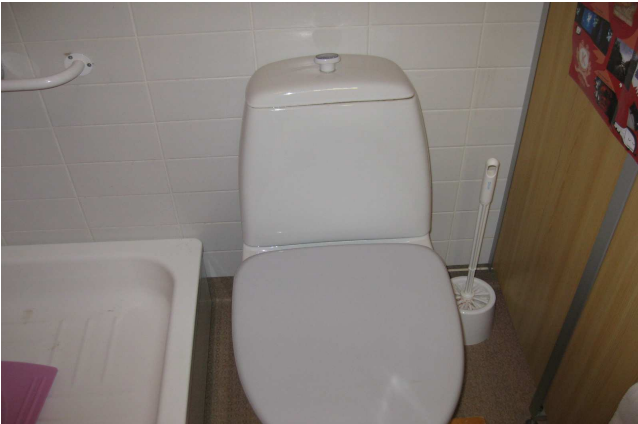
LVI- kuva 7. Yleiskuva vesikalusteista.
