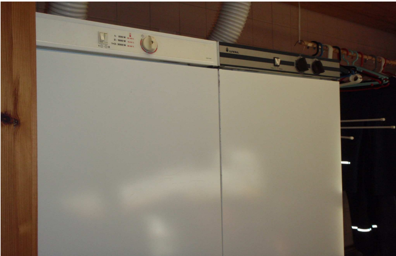
S- kuva 10. Kuivauskaapit.
