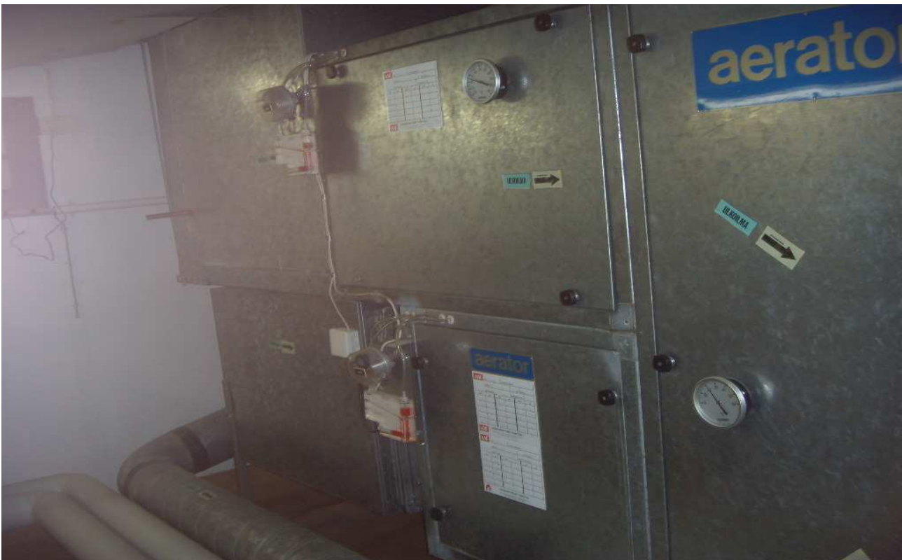
LVI- kuva 8. Yleiskuva IV- konehuoneesta.
