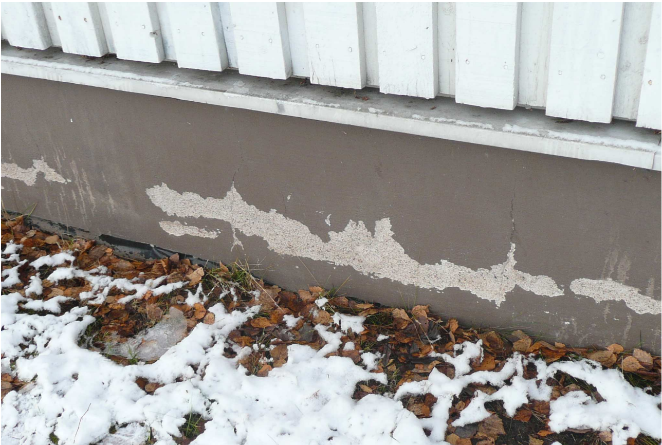
RAK- kuva 5. Sokkeleiden maalipinta hilseilee irti.
