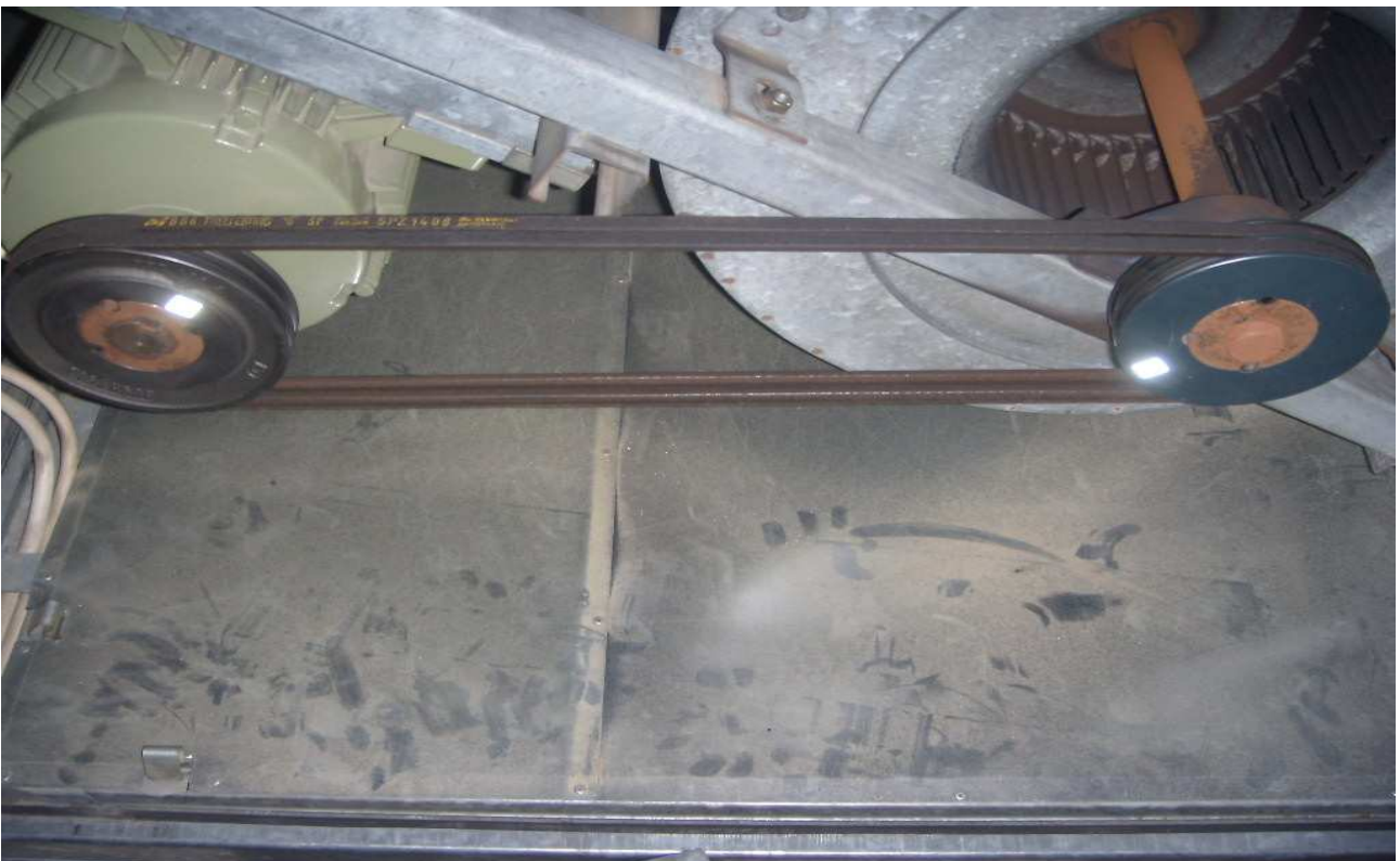
LVI- kuva 10. Tuloilmakoneen puhallinkammiot ovat pölyiset.
