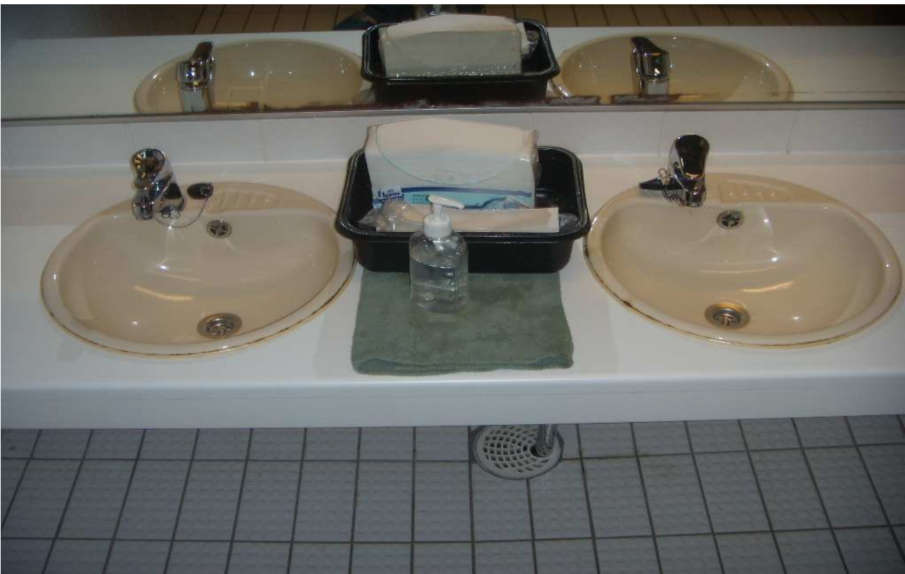
LVI- kuva 6. Yleiskuva vesikalusteista.
