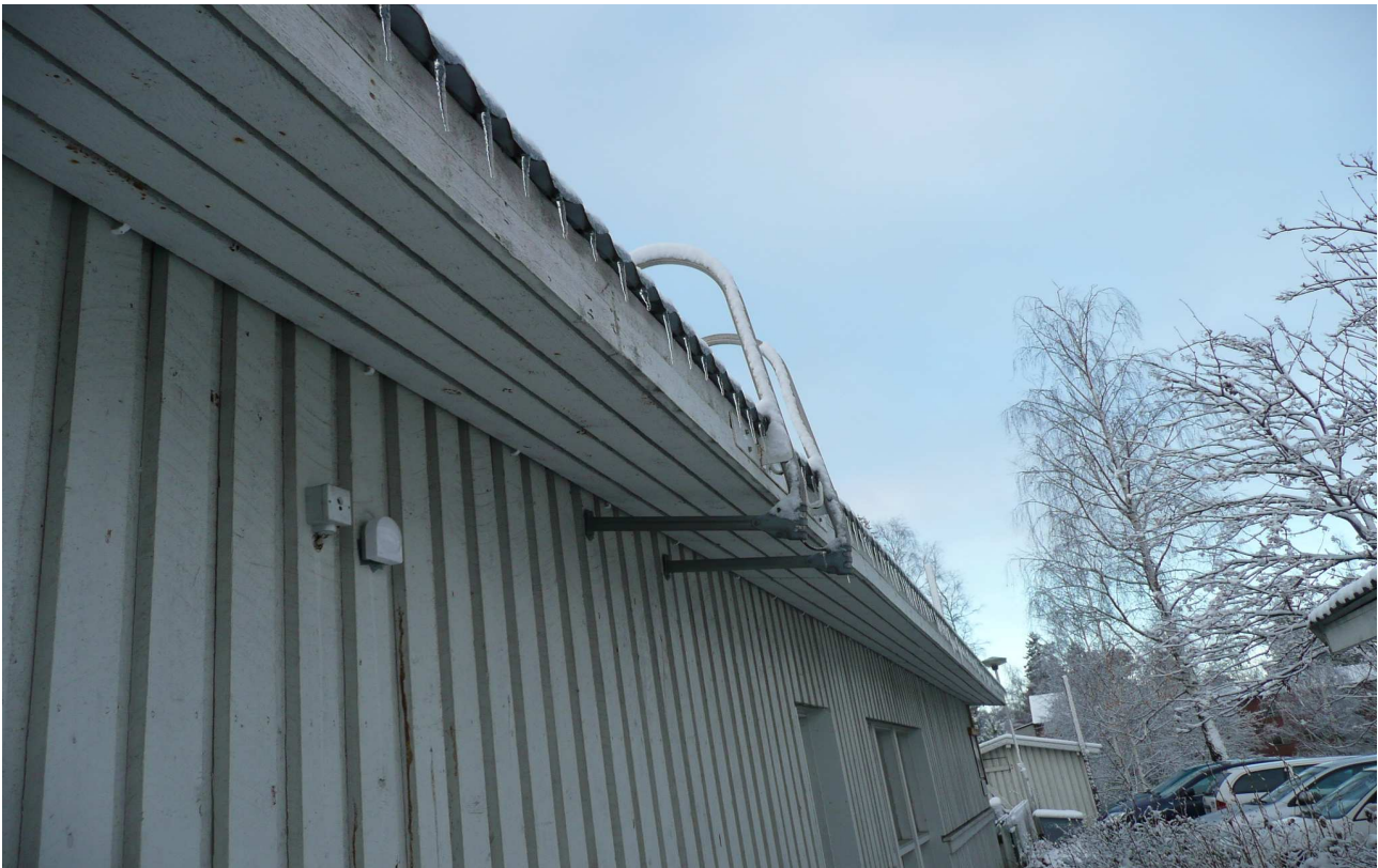
RAK- kuva 11. Itäsivun räystäältä puuttuvat räystäskourut ja syöksytorvet.
