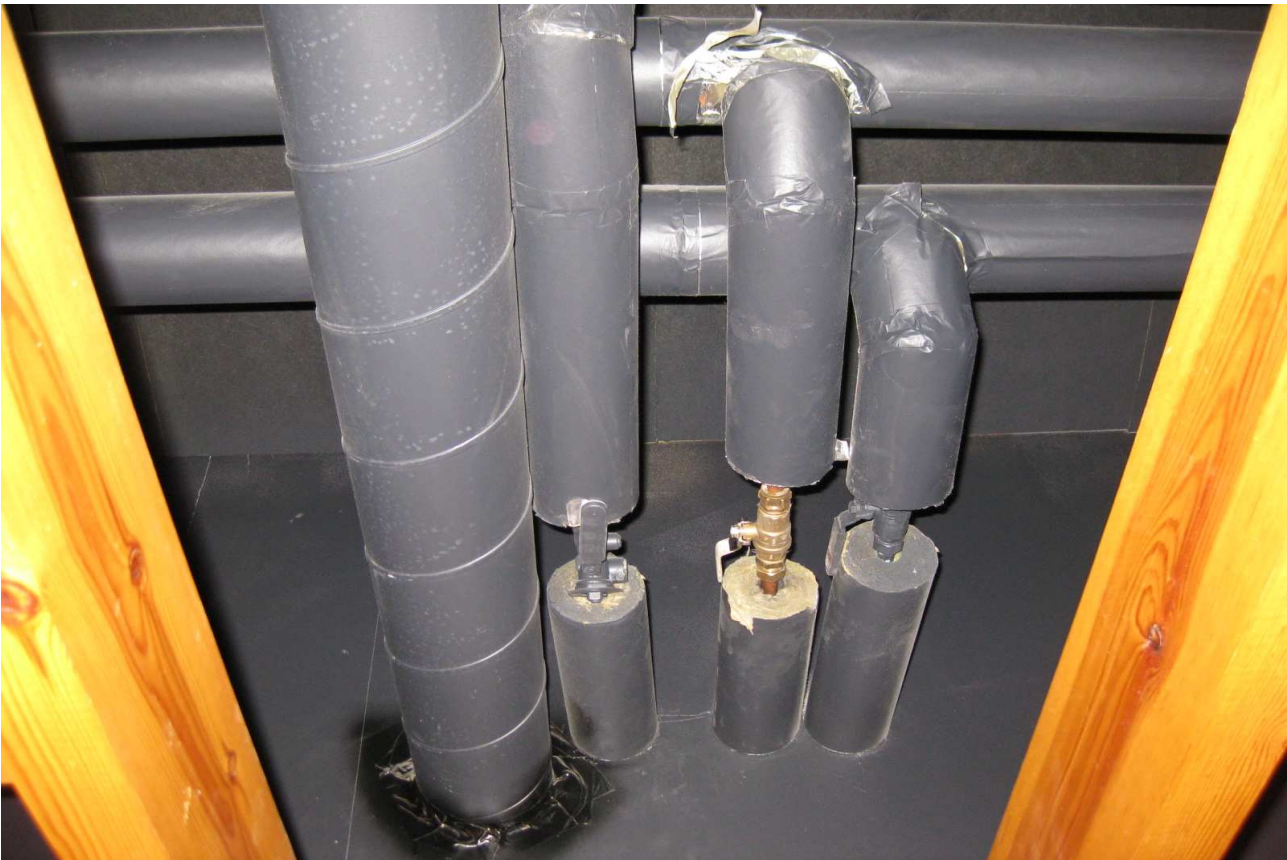
LVI- kuva 5. Yleiskuva käyttöveden sulkuventtiileistä.
