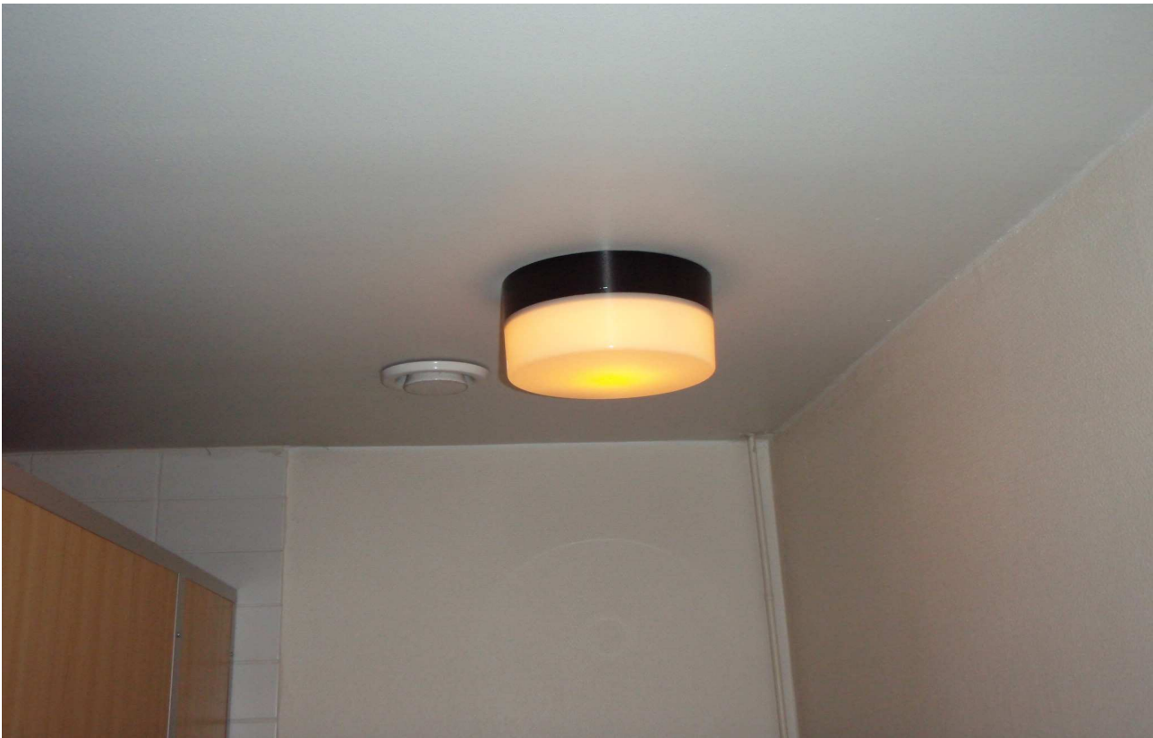
S- kuva 9. WC- tilojen valaistus.
