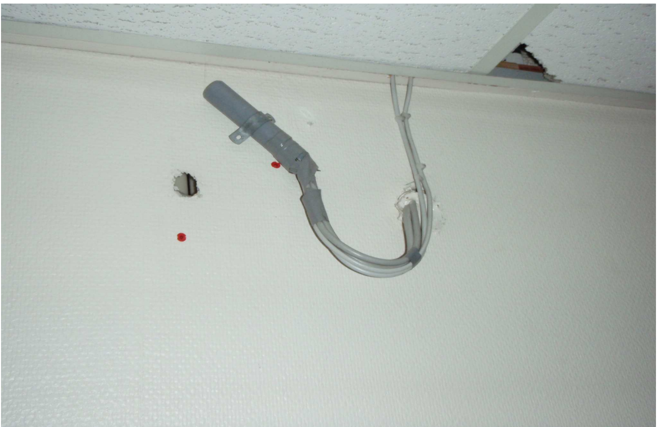
S- kuva 12. Käytävän seinällä on irrallinen heikkovirtatuppi.
