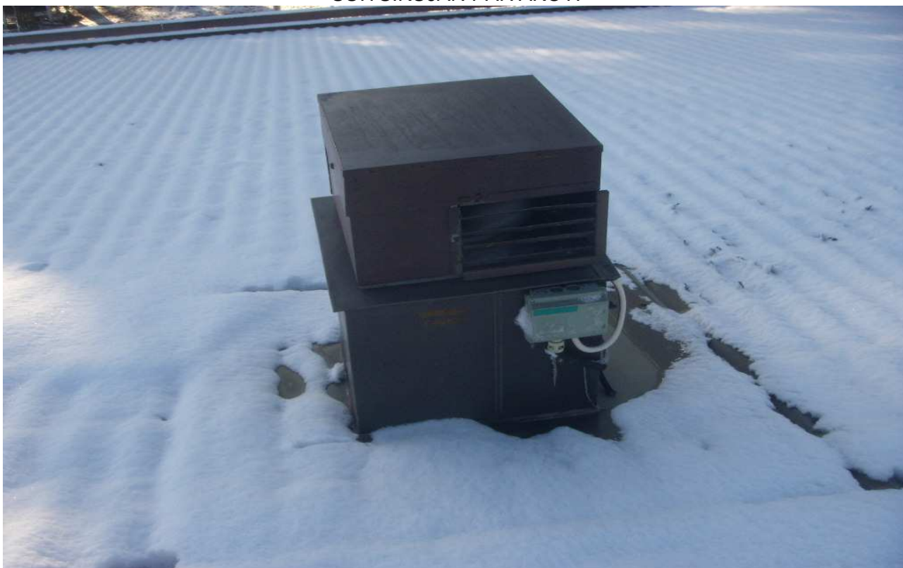
LVI- kuva 13. Yleiskuva vesikatolla olevasta huippuimurista.
