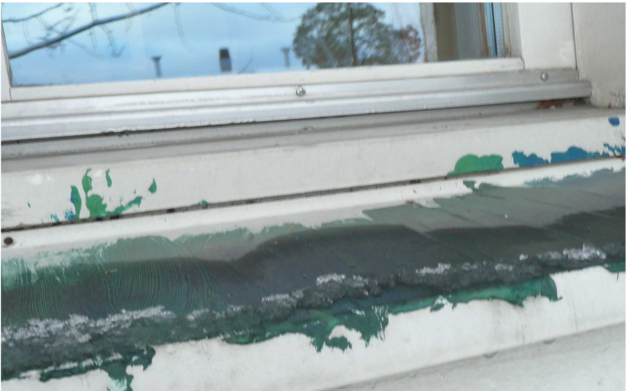
RAK- kuva 6. Ikkunoiden vesipeltien maalipinta irtoilee.
