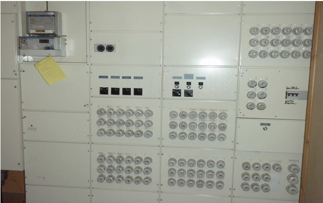
S- kuva 3. Sähköpääkeskus.
