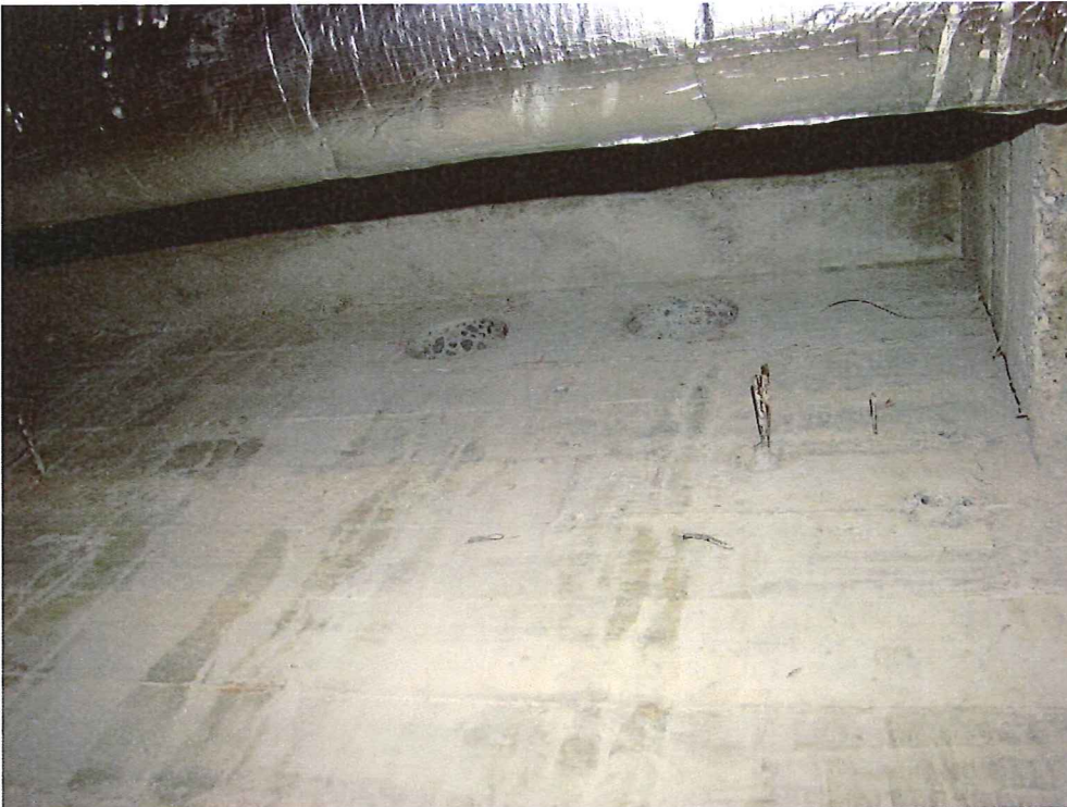
Kuva 2. Kuvassa 1 oleva läpivienti alustatilan 140 puolelta
