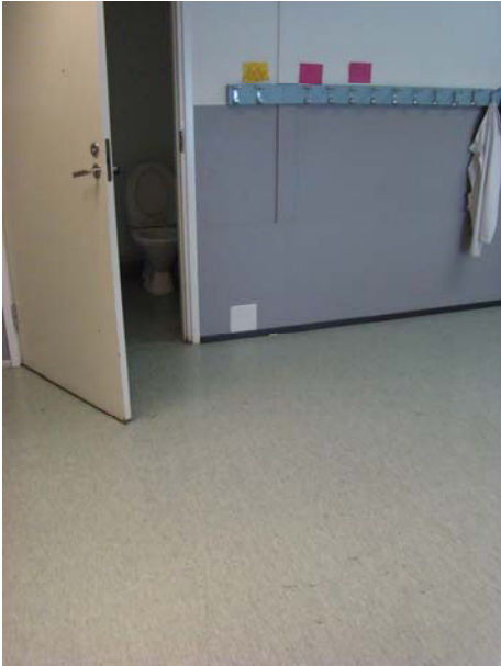
Kuva 3. Eteisaulan ja käytävän kohdalla seinärakenteen alapinta on uudelleen levytettyä.
