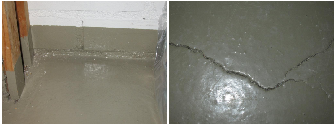
Kuva 6 a ja b. Kuvassa a lattian ja maanvastaisen ulkoseinän liittymä. Kuvassa b halkeama lattiassa. Halkeaman leveys on arviolta 1-2 mm.
