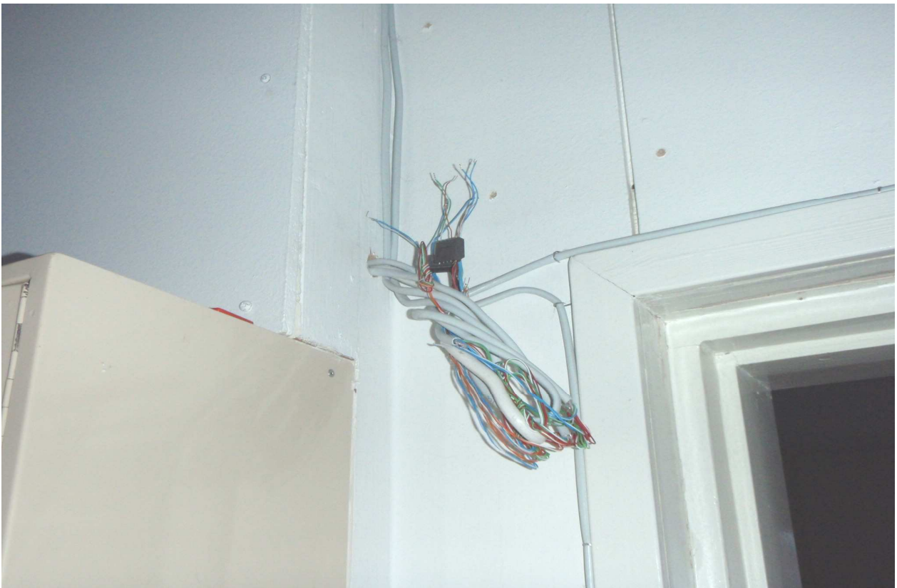
S-kuva 17. Huonokuntoinen palovaroittimien kaapeleiden kytkentä.
