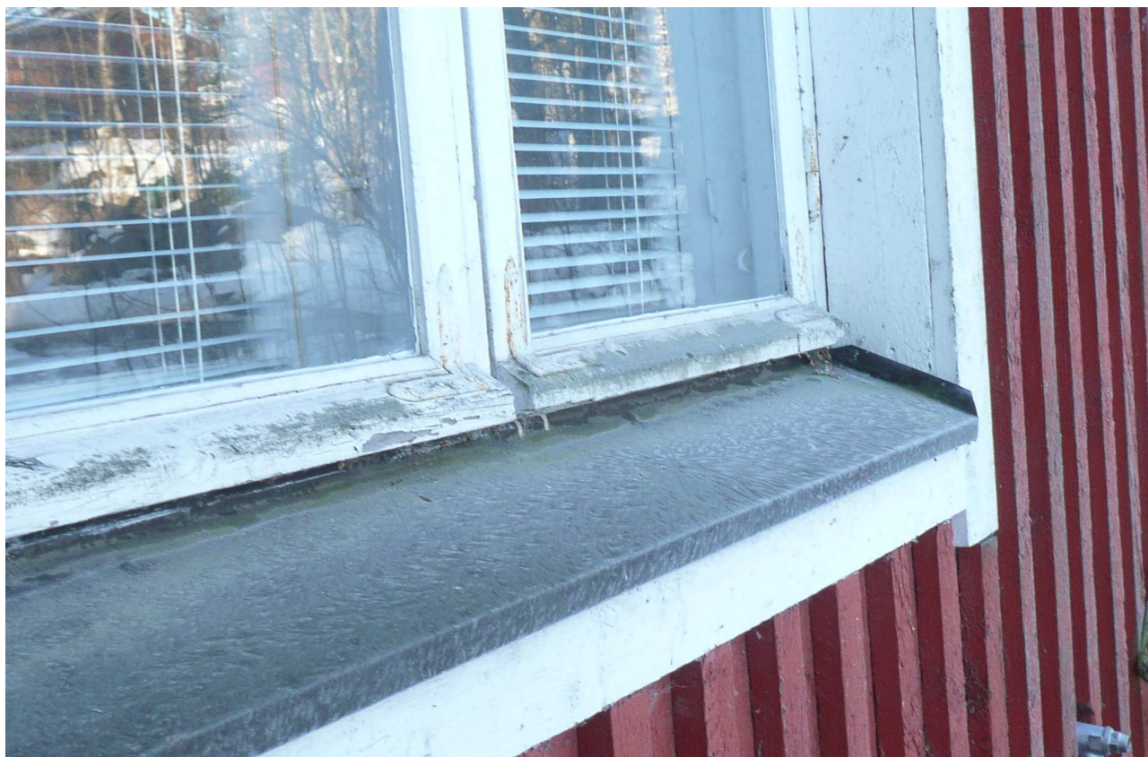
R-kuva 5. Puuikkunan ulkopuitteen vaurioita.
