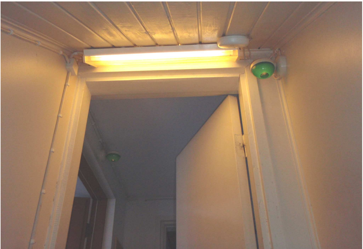
S-kuva 9. Porrashuoneen valaistus.
