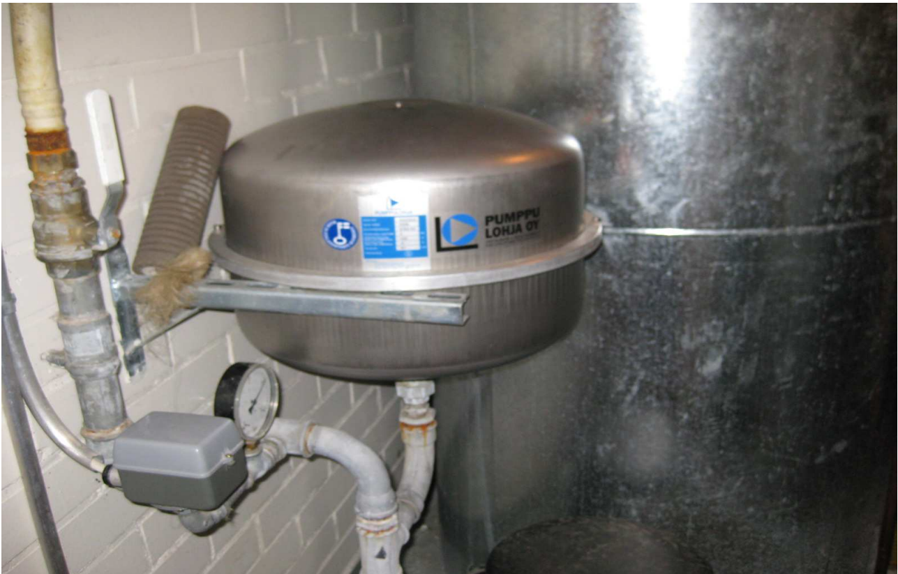
LVI-kuva 6. Yleiskuva käyttövesiverkoston venttiilistä.
