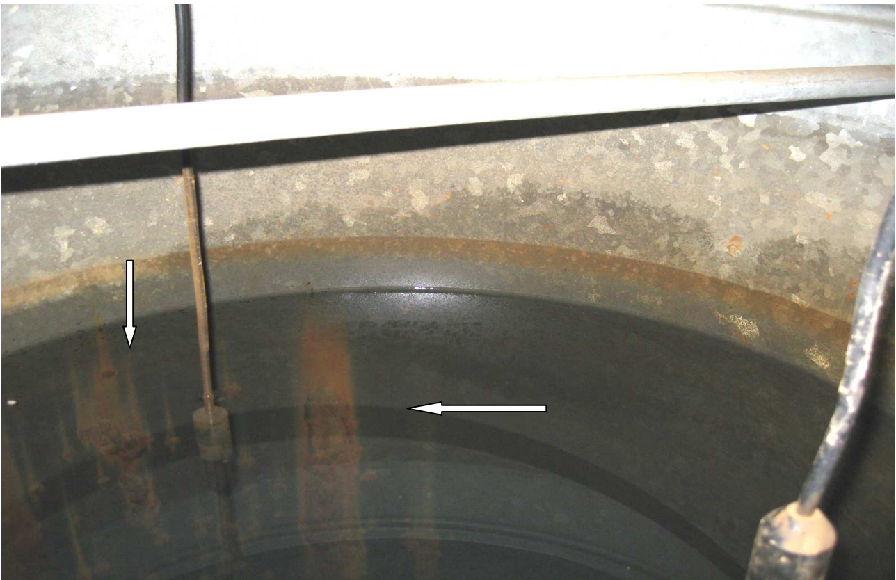
LVI-kuva 5. Yleiskuva käyttöveden varaajasäiliön sisältä.
