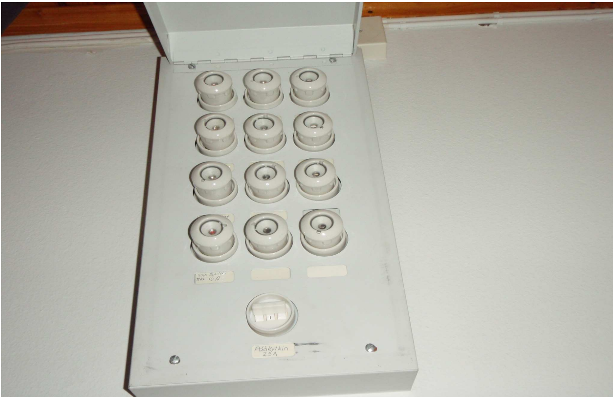
S-kuva 4. 2 krs. sähkökeskus.
