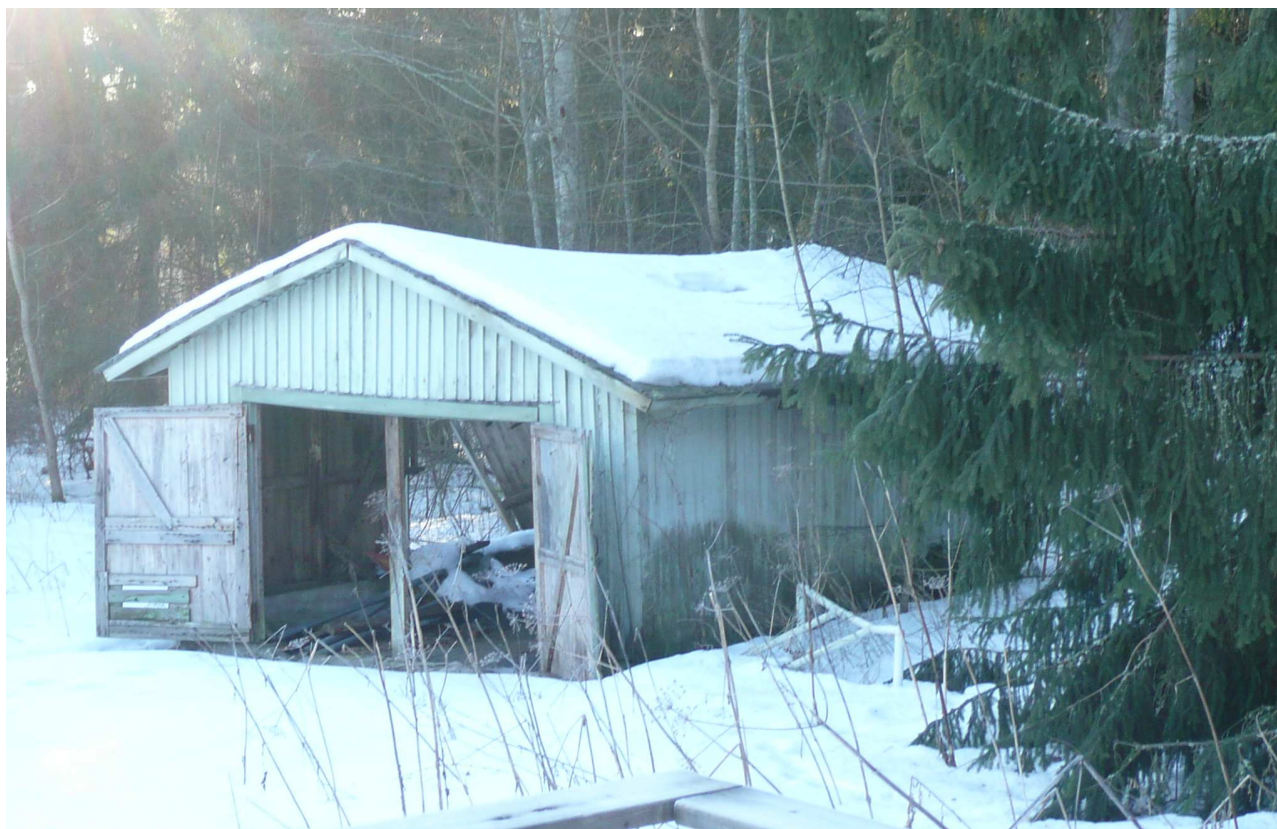
R-kuva 3. Ulkovarasto on huonossa kunnossa.
