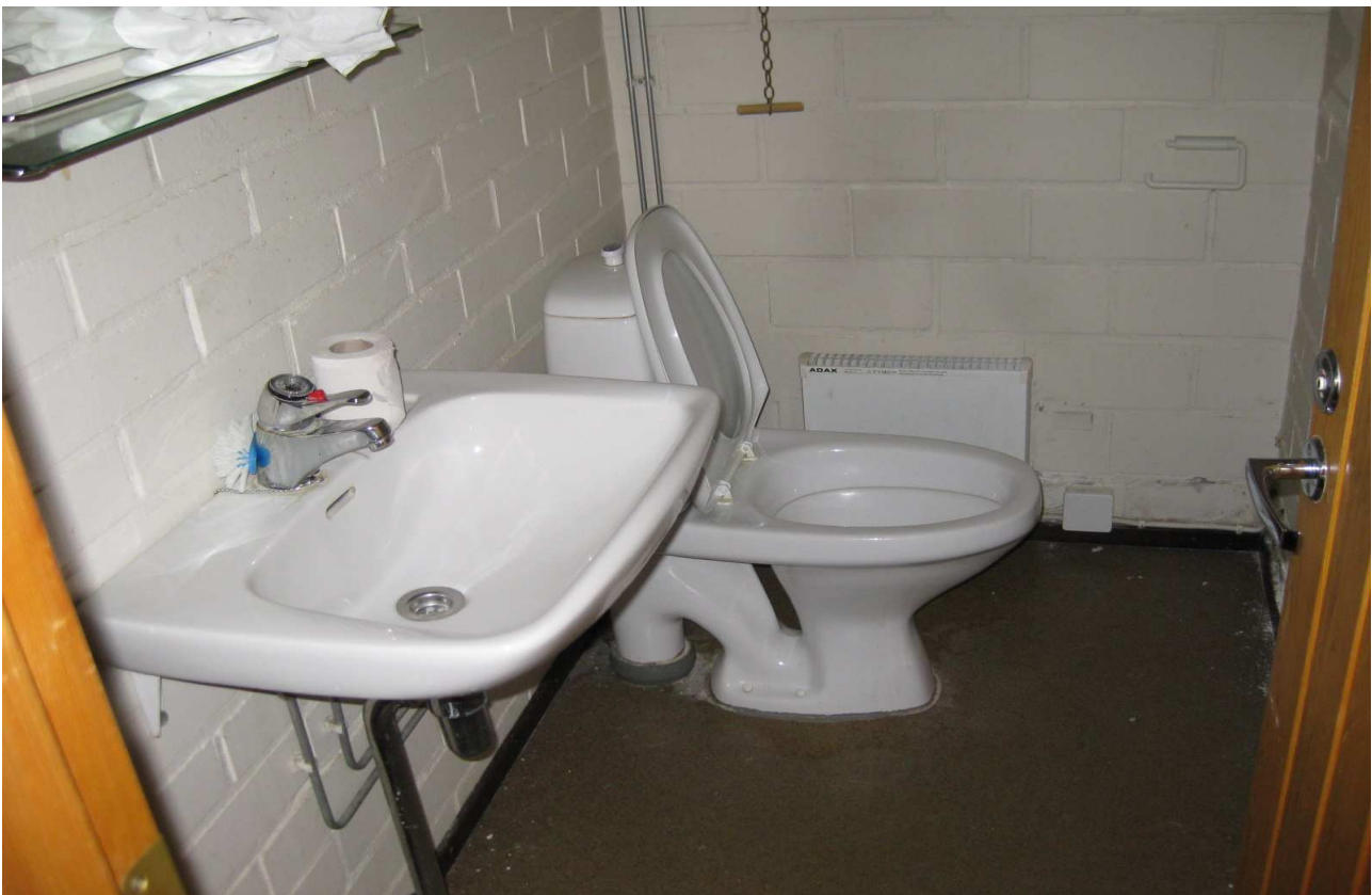
LVI-kuva 7. Yleiskuva vesikalusteista.
