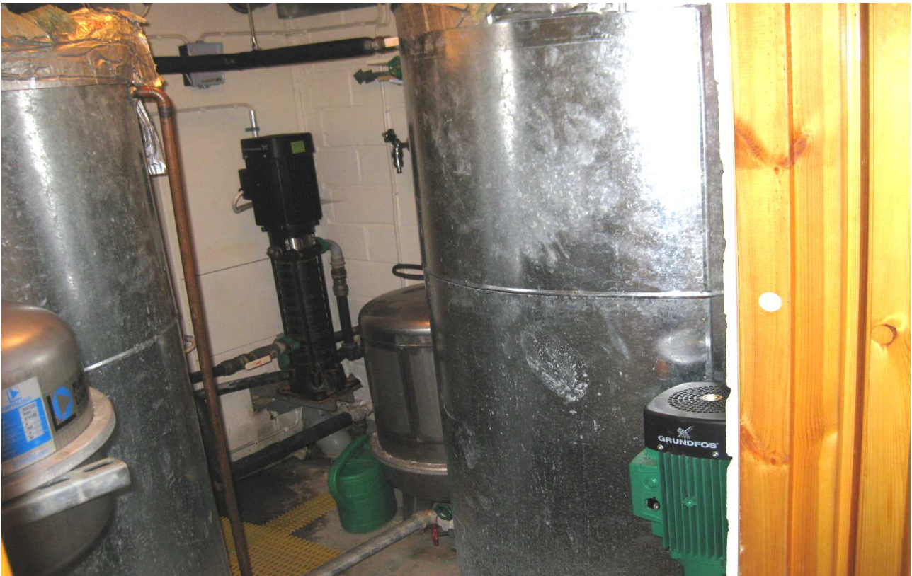
LVI-kuva 2. Yleiskuva kellarikerroksen pumppuhuoneesta.
