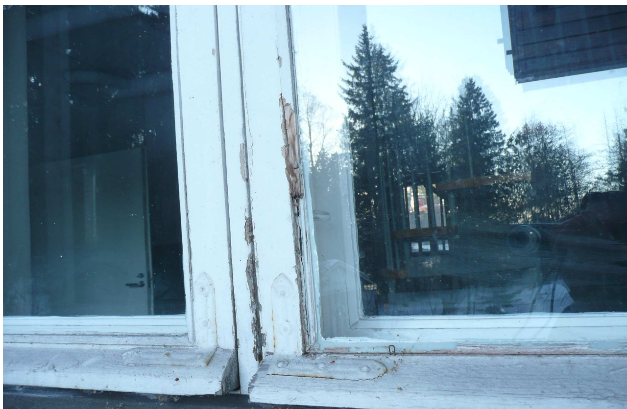
R-kuva 6. Puuikkunan ulkopuitteen vaurioita.
