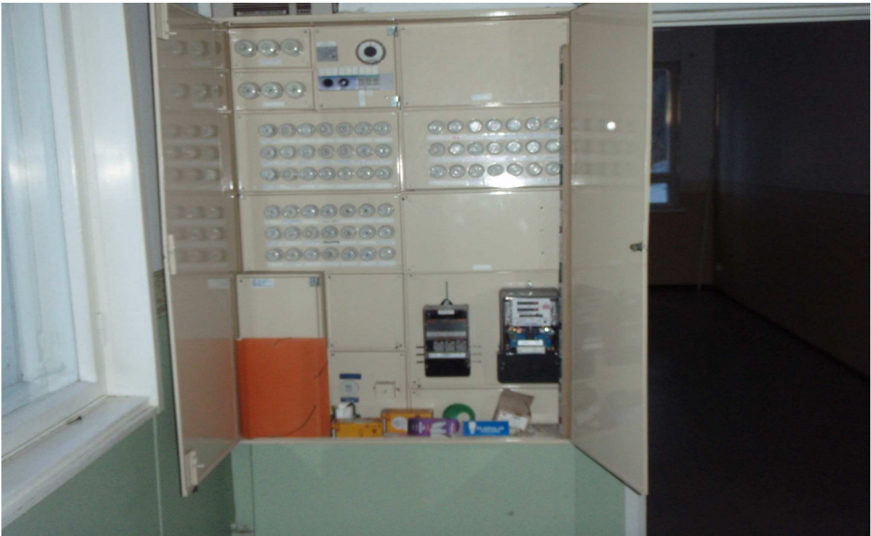
S-kuva 2. Sähköpääkeskus JK 2.
