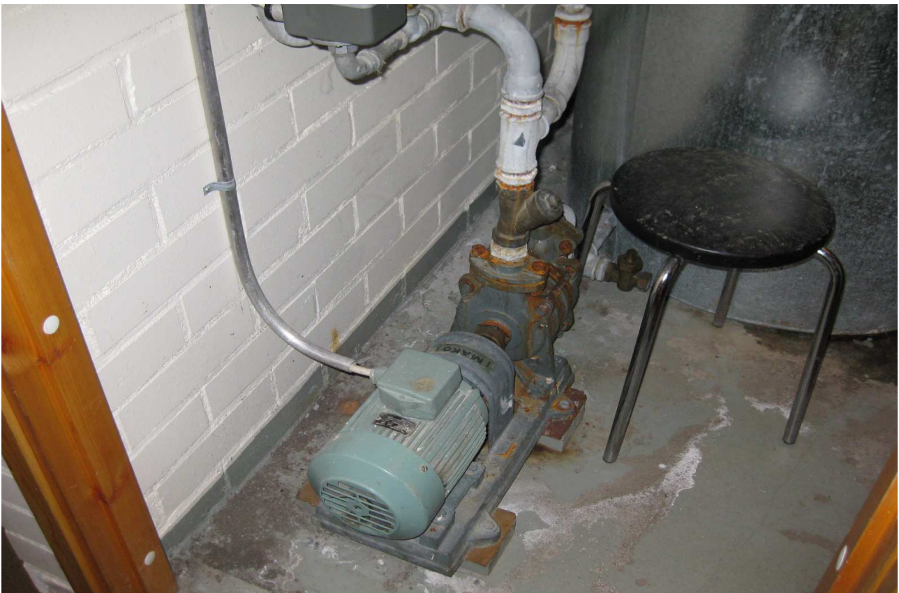
LVI-kuva 3. Yleiskuva paineenkorotuspumpusta.
