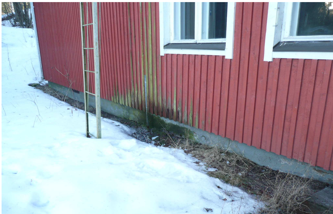
R-kuva 4. Roiskevedet ovat aiheuttaneet vaurioita sokkeleille ja julkisivurakenteelle.
