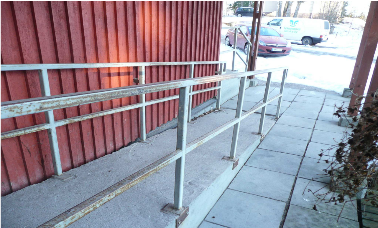
R-kuva 2. Luisikan metallikaiteessa on ruostevaurioita.
