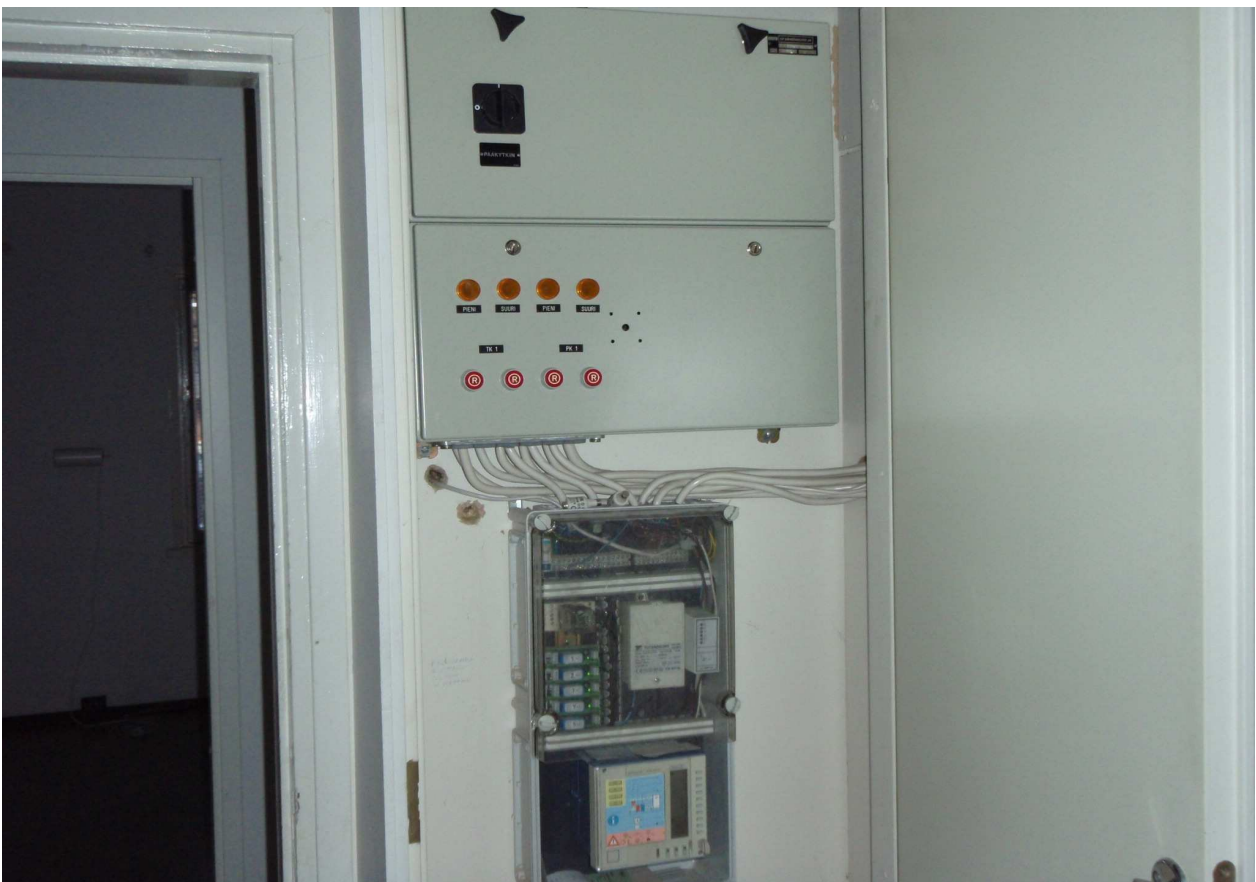
S-kuva 3. IV- koneikon sähkökeskus ja säätölaitekeskus.
