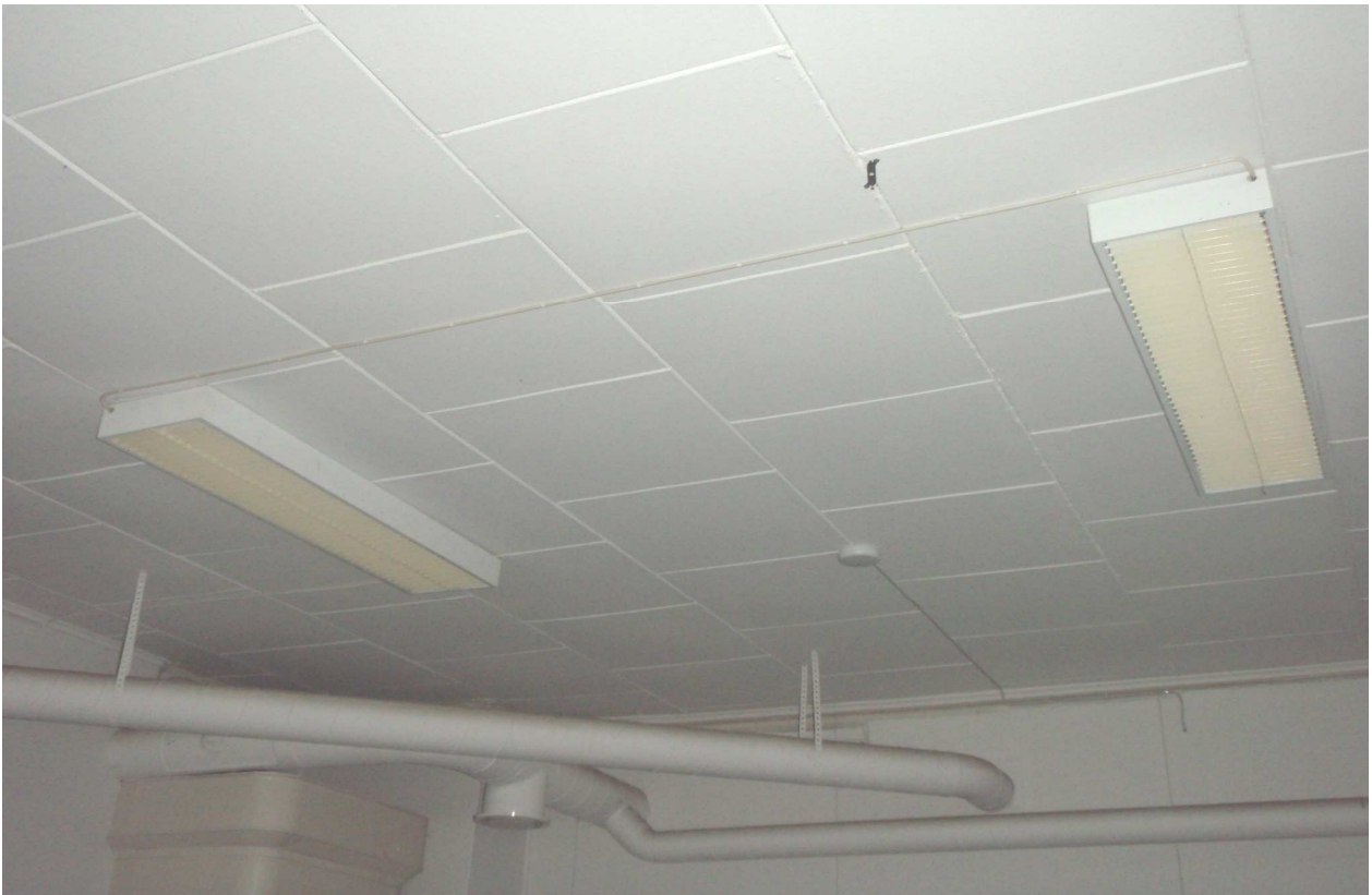
S-kuva 16. Palovaroitin ja huoneen loistelamppuvalaisimet.
