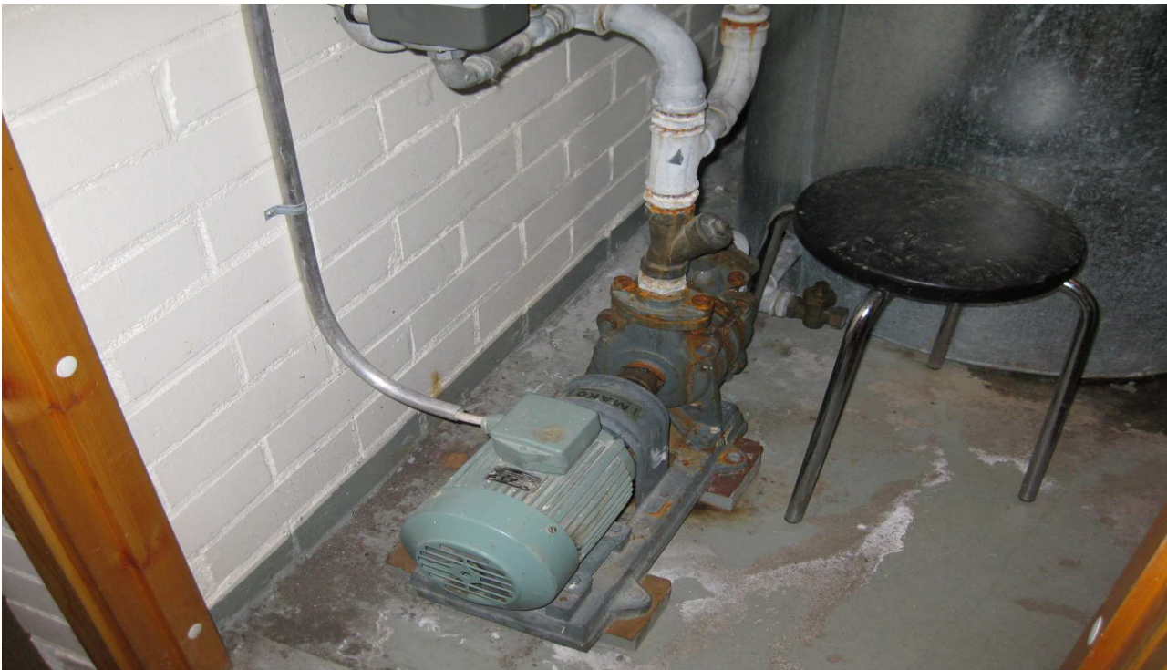
LVI-kuva 5. Yleiskuva paineenkorotuspumpusta, joka on Seutulán ent. nuorisotalossa.
