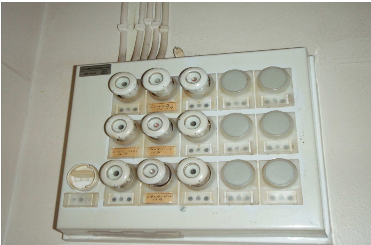
S-kuva 3. 1 krs. huoneiston sähkökeskus.
