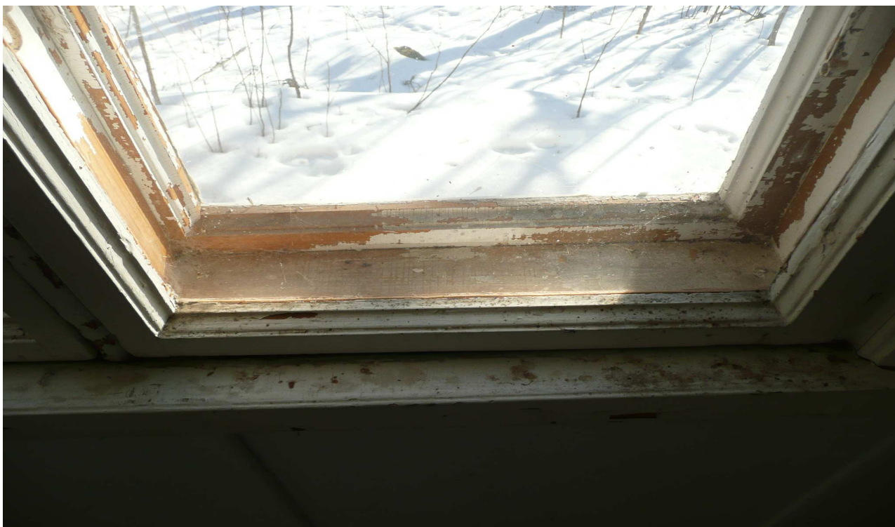
R-kuva 2. Puuikkunoiden vaurioita.
