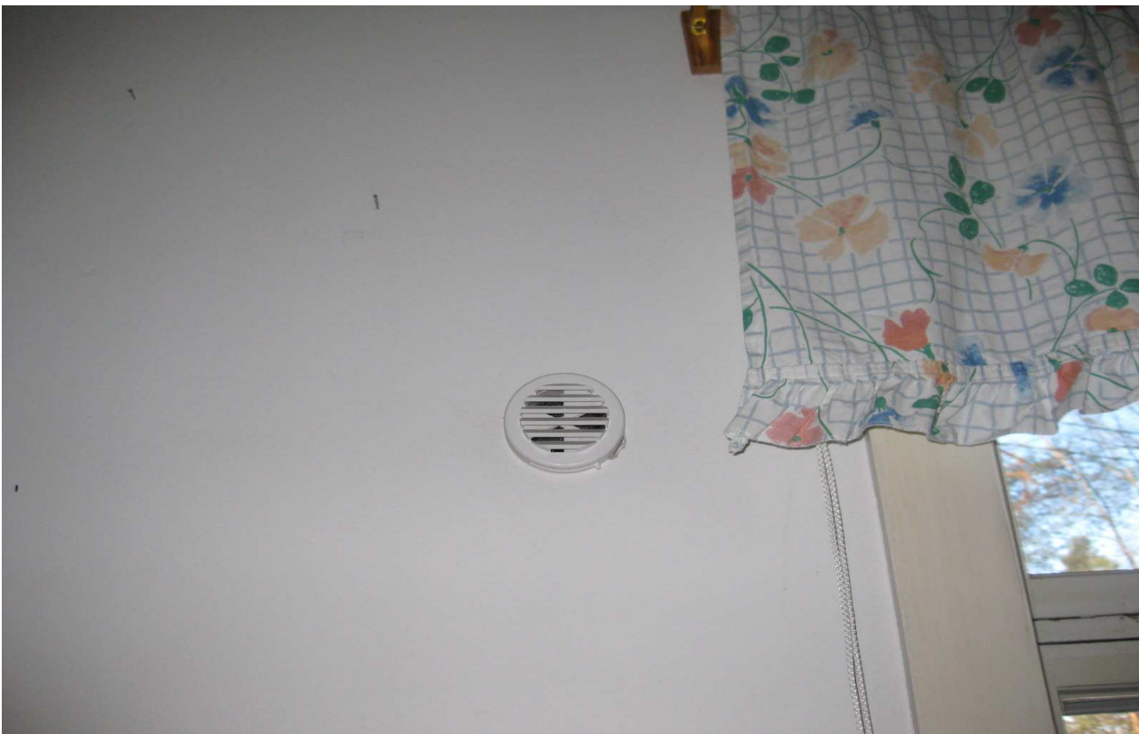
LVI-kuva 9. Yleiskuva korvausilmaventtiilistä.
