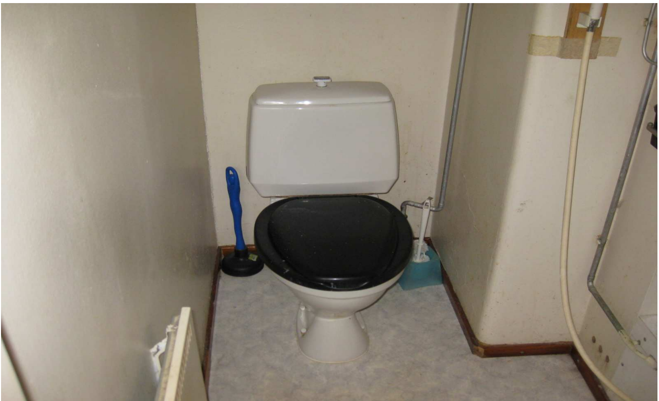
LVI-kuva 7. Yleiskuva vesikalusteista.
