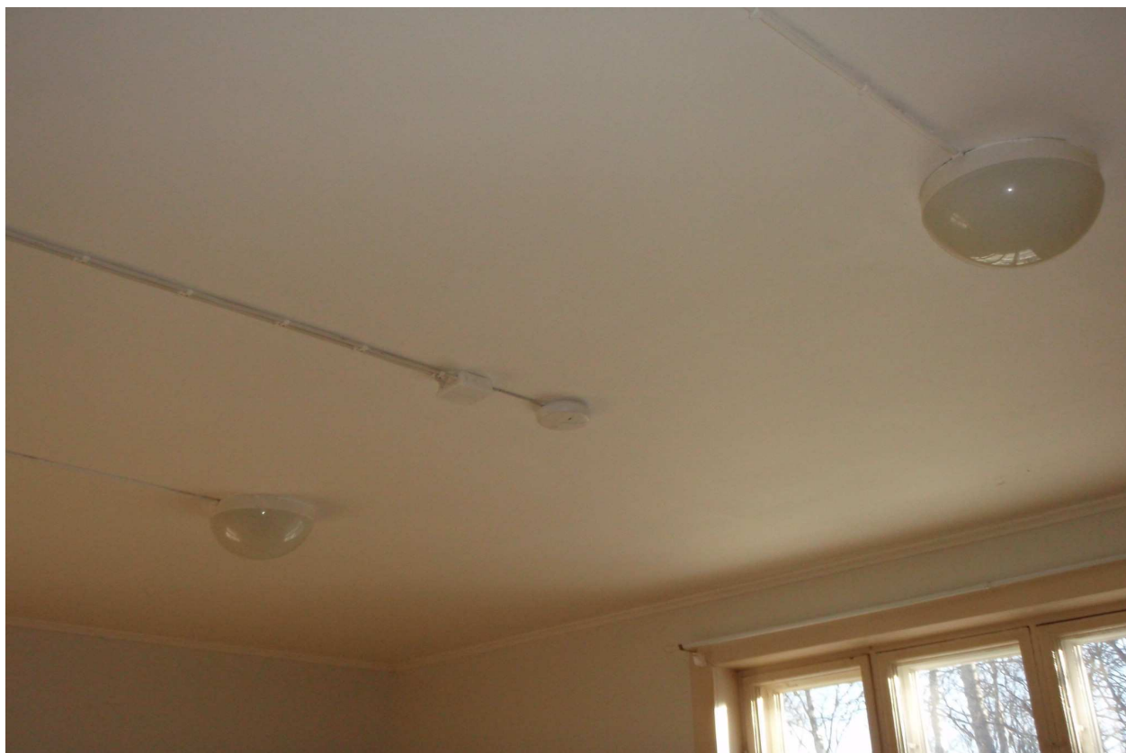
S-kuva 5. Huoneen valaistus.
