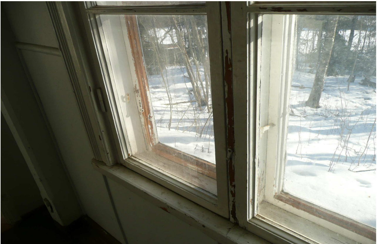
R-kuva 3. Puuikkunoiden vaurioita.
