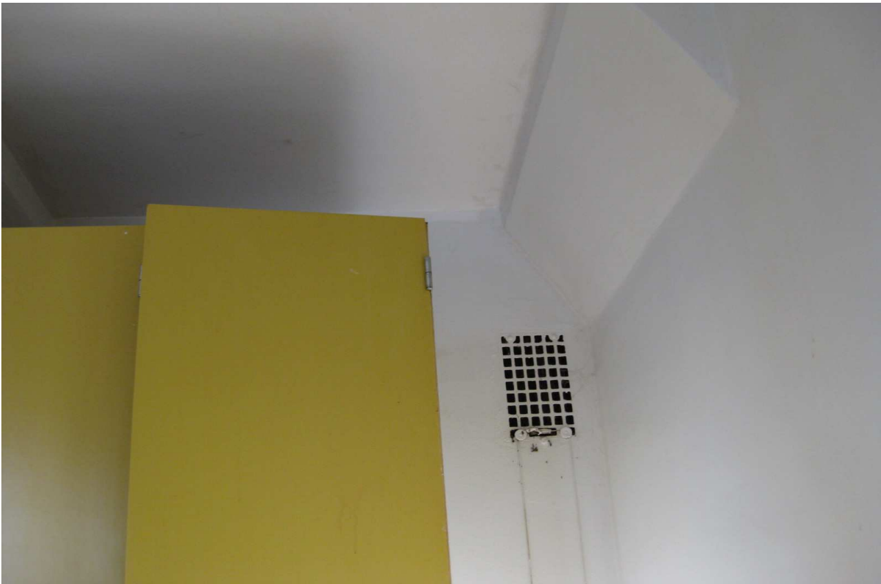
LVI-kuva 8. Yleiskuva poistoilmaritilästä.
