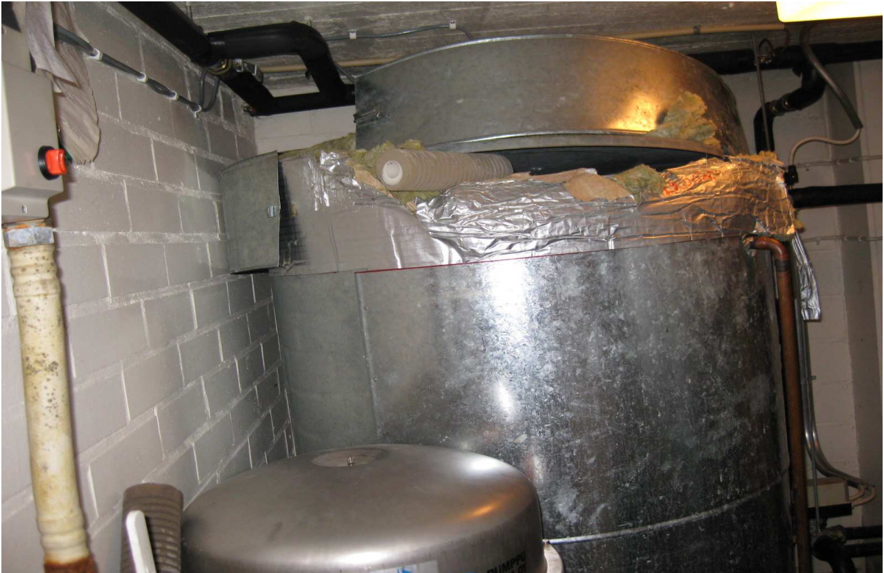
LVI-kuva 4. Yleiskuva käyttöveden varaaajasäiliöistä.
