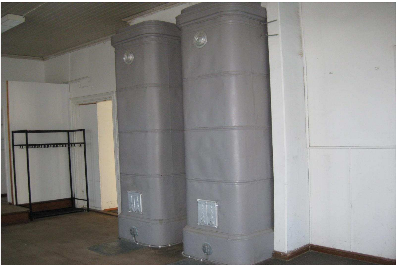
LVI-kuva 1. Yleiskuva pystyuuneista, joissa on vastukset.
