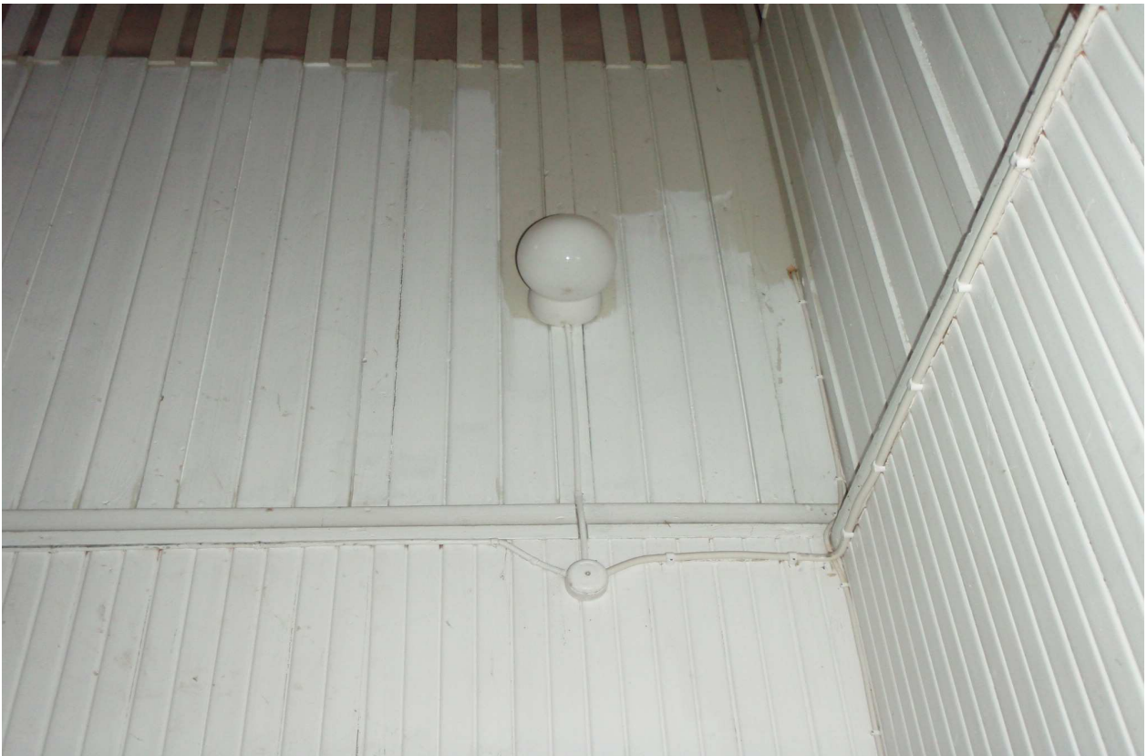
S-kuva 8. Porrashuoneen valaistus.
