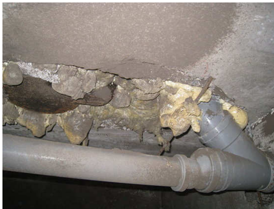
Kuva 8 Tiivistämätön läpivienti ja kaivon pohja.
