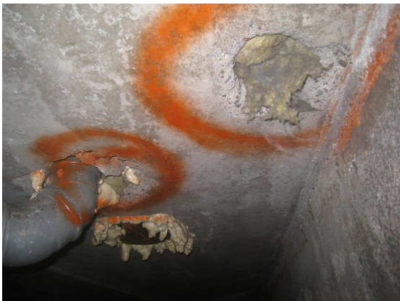
Kuva 7 Tiivistämättömiä viemäri- yms. läpivientejä.
