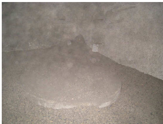
Kuva 10 Alustatilassa olevaa betonikantta ei saatu avattua.
