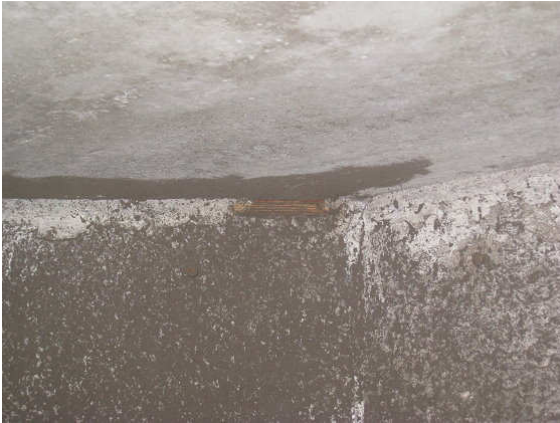
Kuva 1 Perustuspalkin ja ontelolaatan välissä vanerilevyä.
