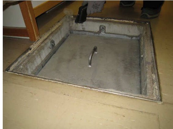
Kuva 2 Luukku alustatilaan varastotilan 29 lattias- assa.
