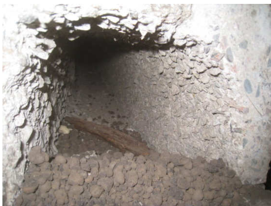
Kuva 5 Perustuspalkin ontelotilassa lahonnut- ta puuta.
