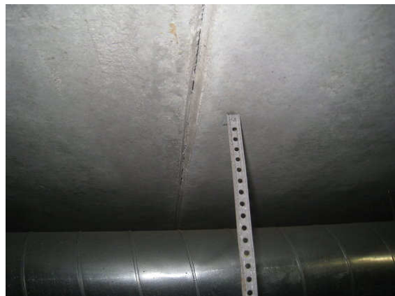
Kuva 4 Ontelolaattojen välissä rakoja.
