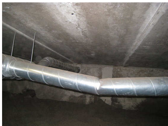
Kuva 6 Ilmanvaihtokanava on vääntynyt.
