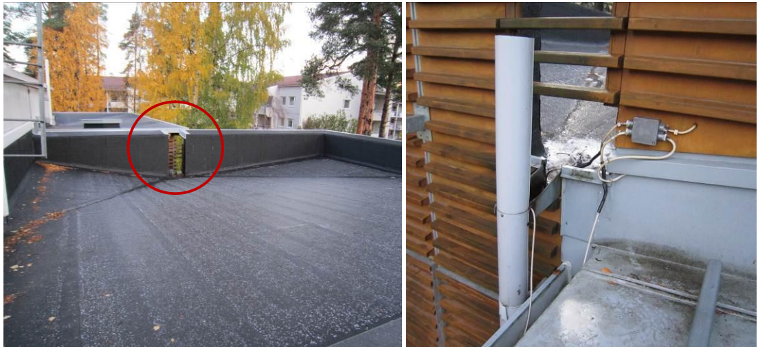
Kuva 5a ja 5b. Bitumikermikaton vedenpoisto ei toimi suunnitellusti, sillä vesi lammikoituu katolla ja osa vedestä valuu julkisivua pitkin, osa ulkoseinä- ja ikkunarakenteen sisälle.
