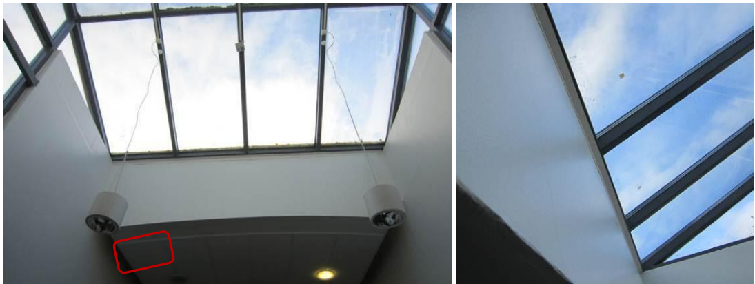
Kuvat 4a ja 4b. Lasikatto 2 sisäpuolelta. Alakattorakennetta avattiin kummankin lasikaton kohdalla kuvaan punaisella merkitystä paikasta. Vesi valuu sateella sekä kipsilevyn molemmin puolin. Lasielementeissä ei ole kondenssivedenohjausta.
