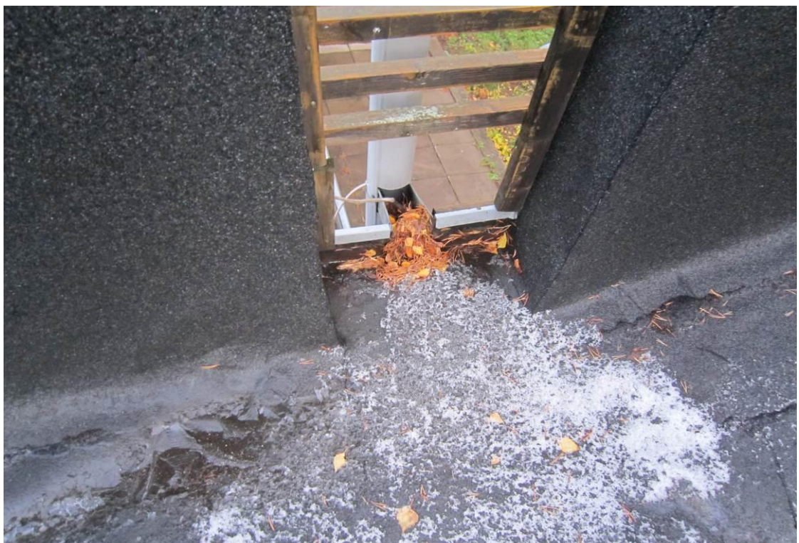
Kuva 6. Vedenpoiston eteen lammikoituu vettä, ulosheittäjä ja syöksytorvi ovat osittain tukkeutuneet. Vesi lammikoituu ja jäätyy bitumikermikatteen päälle.
