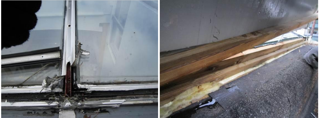
Kuva 3a ja 3b. Rakenneavaus, lasikatto 1. Vasemmalla on lasielementtien karmien liitoskohta, jossa vesi ohjautuu ruuvinreikien ja listoituksessa olevien aukkojen kautta rakenteeseen. Oikealla pellityksen alla bitumikermikate ei liity tiiviisti ikkunarakenteisiin, kohdassa on osittain polyuretaanivaahdolla täytetty 20...30 mm rako.
