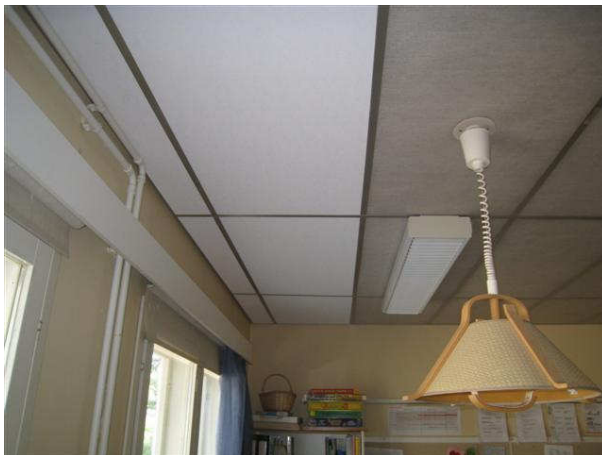
Kuva 29 Vesivuotojen takia uusittuja akustiikkalevyjä ryhmähuone 21 katossa.
