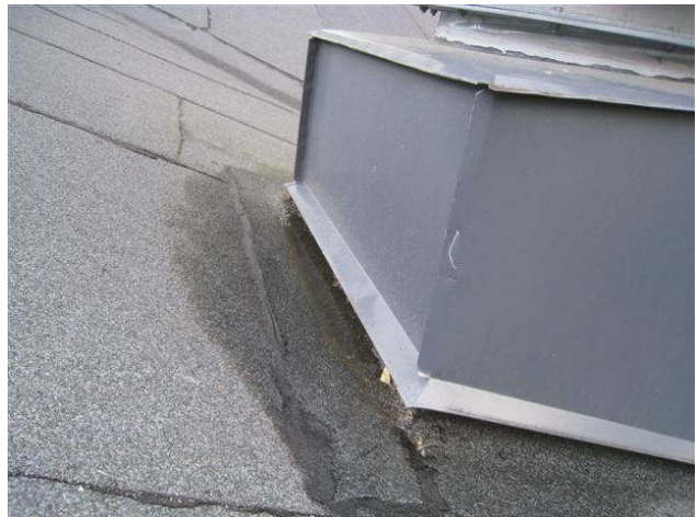
Kuva 64 Vuotoriski IV-piipun yläliittymässä, koska ei ole kallistusta.
