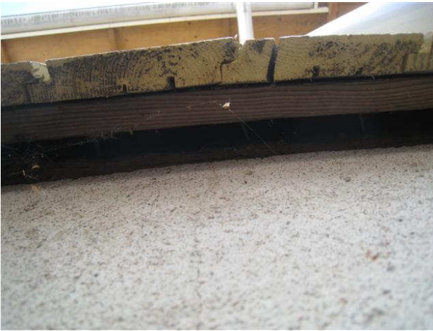
Kuva 57 Ulkuvuorauslautojen alapää on maa- laamatta.
