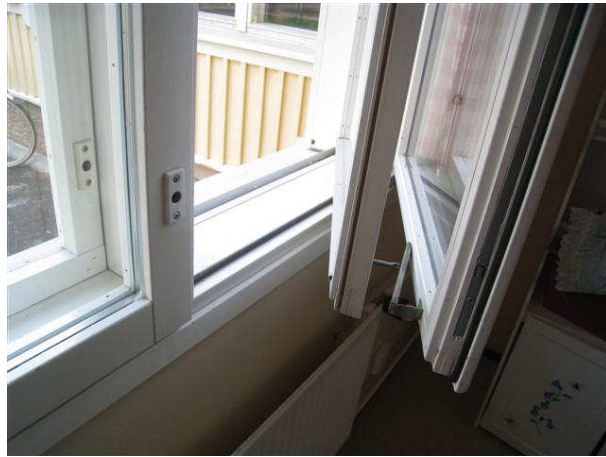
Kuva 15 MSE -ikkunat toimivat hyvin, sisäpinnat ovat vielä pääosin hyväkuntoiset.
