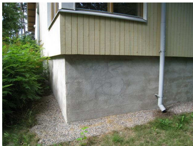
Kuva 50 Itäisivun osin tukkeutunut rännikaivo ja istutuksia liian lähellä ulkoseinää.
