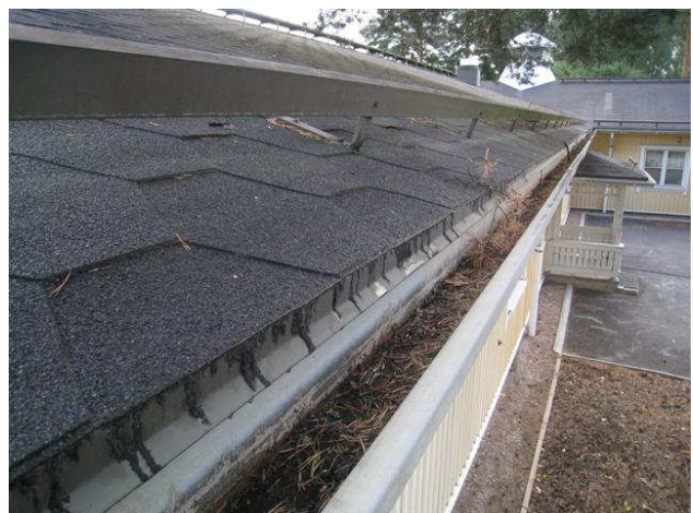
Kuva 18 Räystäällä on ao. reunapelti. Ränneissä on kasvijätettä ja pohja ruostunut.
