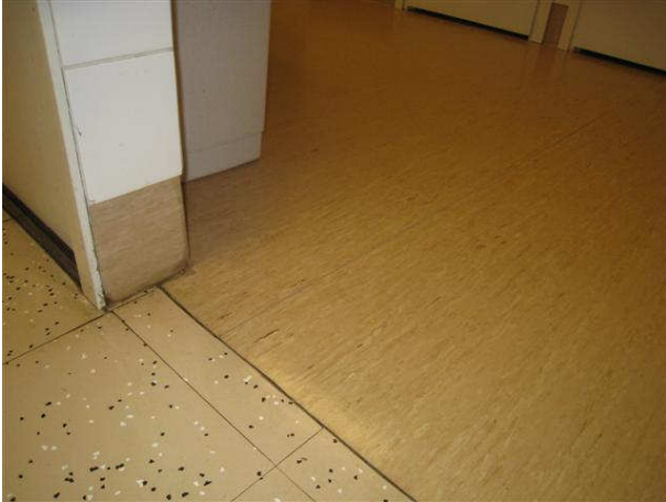
Kuva 37 Pesutilojen ja käytävän välissä ei ole korokekynnystä.
