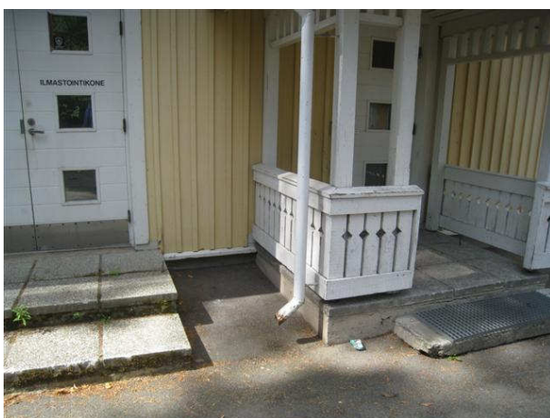
Kuva 11 Kulunut katos ja sisäänkäyntien tasot, joissa laatoitusväleissä on sammalta.
