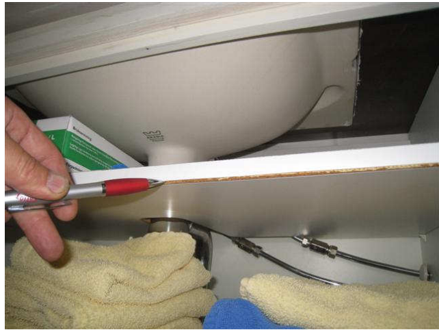
Kuva 40 Pieni kosteusvaurio pesualtaan alakaa- pissa.
