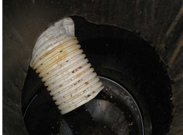
Kuva 56 Salaojat ovat peltosalaojaa, vaikka suunnitelmissa on nk. tuplaputket.
