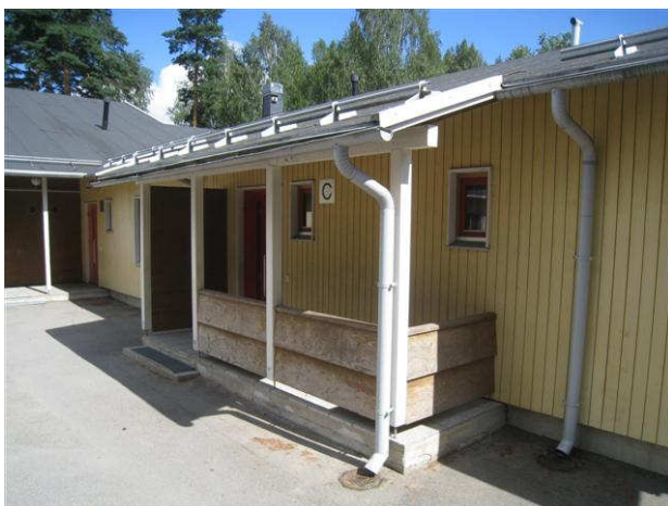
Kuva 59 Julkisivujen vaneriosien pinnat ovat kuluneet.
