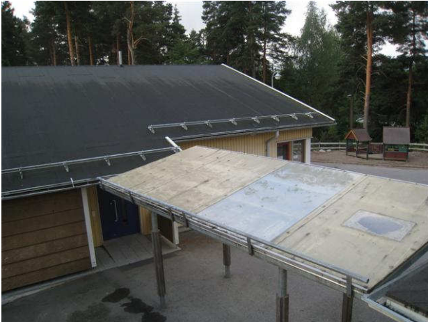
Kuva 61 Valokatosta on jo korjattu.
