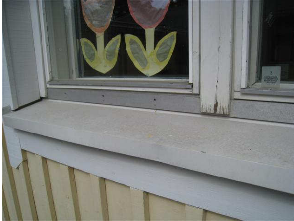
Kuva 13 Tyypillinen ikkunaliittymä, ikkunan alaosan maalipinnat ovat kuluneet.
