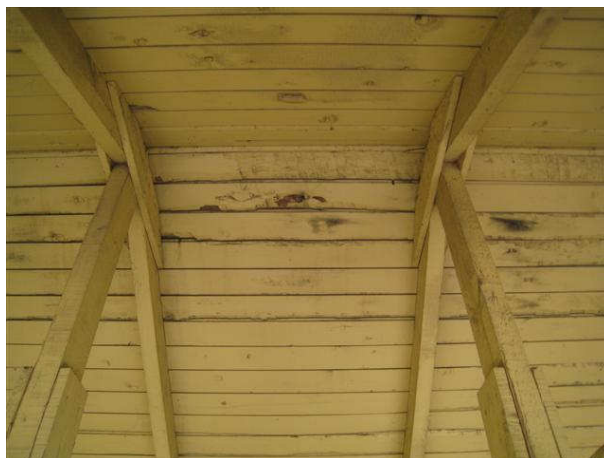
Kuva 6 Leikkihän katoksen katto on jo lahonnut vesivuotojen takia.
