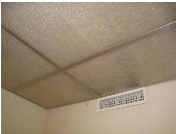
Kuva 45 Kattojen akustiikkalevyt ovat likaantuneet.
