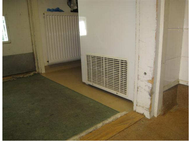
Kuva 32 Keittiön kulunut ovipieli.
