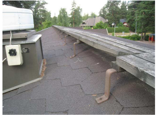
Kuva 22 Kulkusillat ovat jo kuluneet, kiinnitys on vesikatteen läpi.
