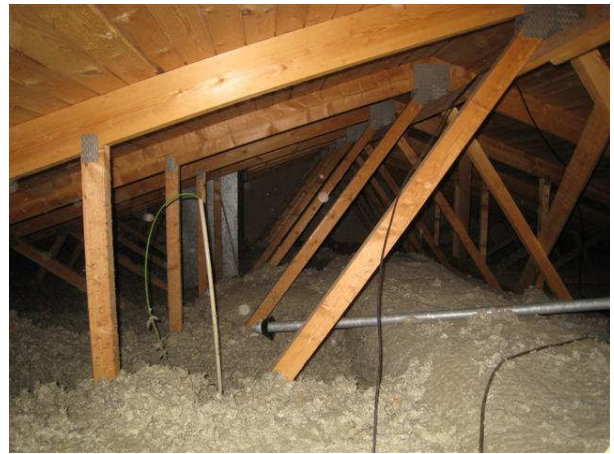
Kuva 26 Kulkusiltoja ei juuri ole yläpohjassa
