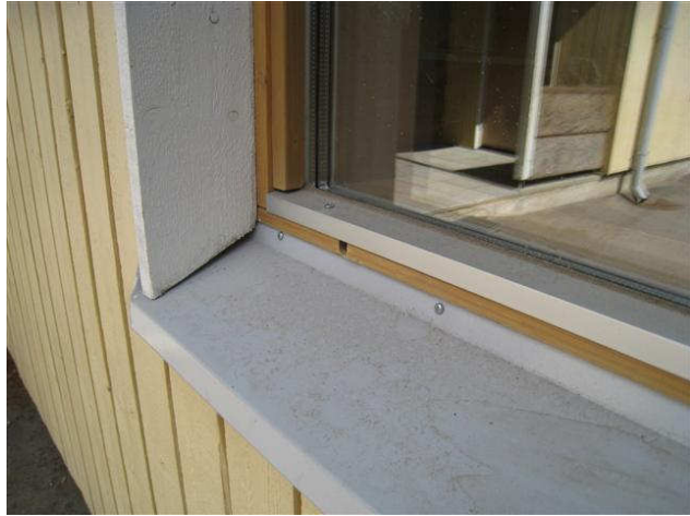
Kuva 58 Pielilaudan sahauskulma on väärä, ik- kunan ulkopinnat ovat vielä kunnossa.
