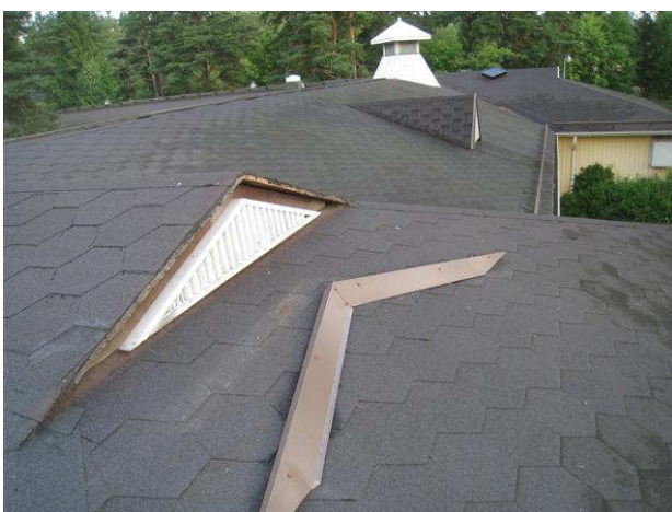
Kuva 23 Irronnut räystäspeltti rakennuksen eteläsiiven itälappeella.
