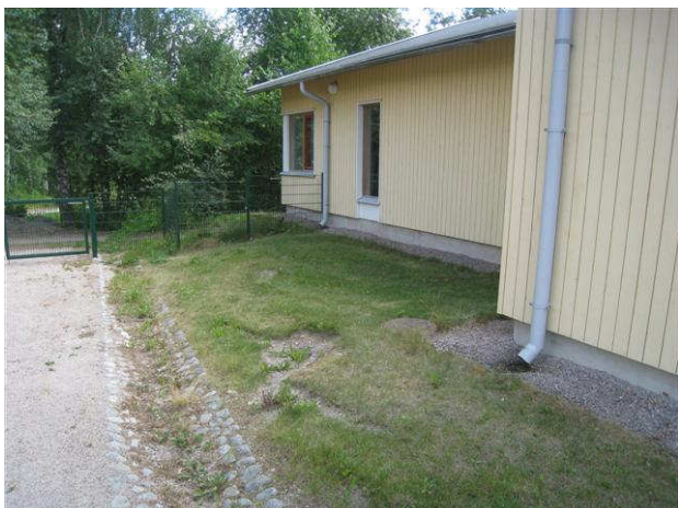
Kuva 49 Pohjoispuhan kulunut nurmialue, rännivedet aiheuttavat kulumista.
