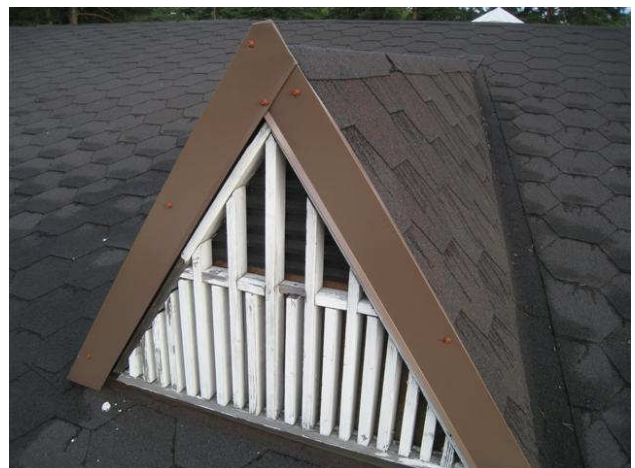
Kuva 24 Kattolyhtyjen puosat ovat kuluneet, yläosassa on tuuletusventtiili.
