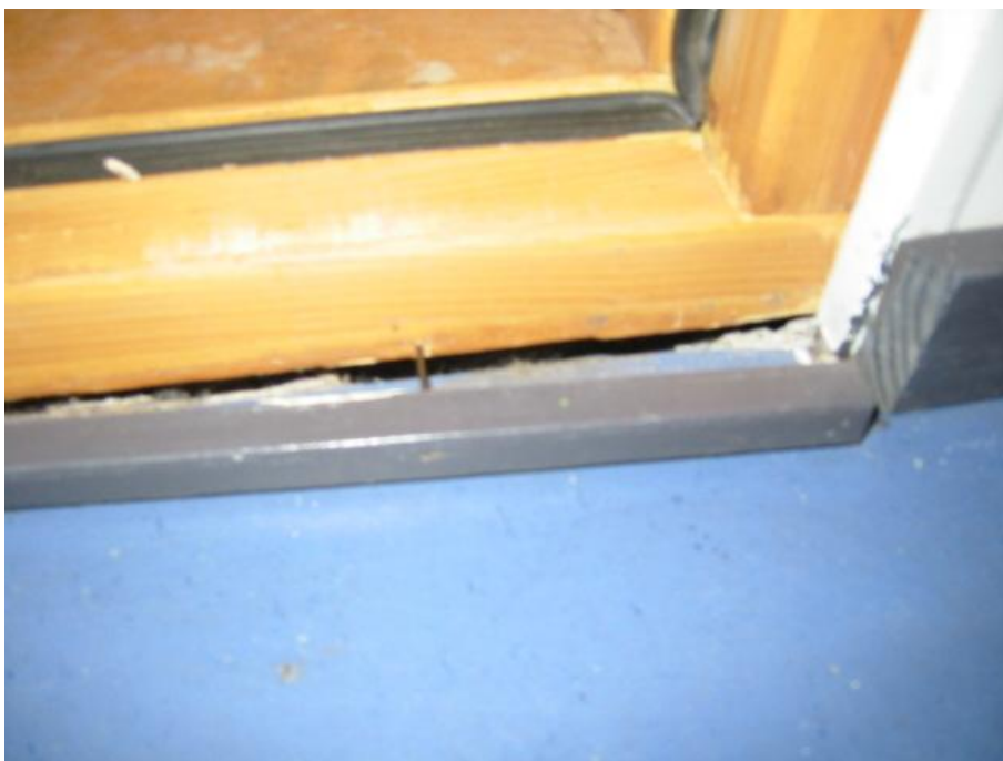
Kuva 9 Ovikynnyksen alla eristämätön ja tiivistämätön onkalotila (vrt. kuva 8).
