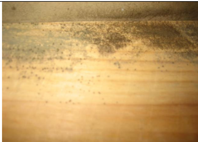
Kuva 5. Siivouhuone. Tummaa kasvustoa väliseinän runkopuissa, sekä kipsilevyssä.
