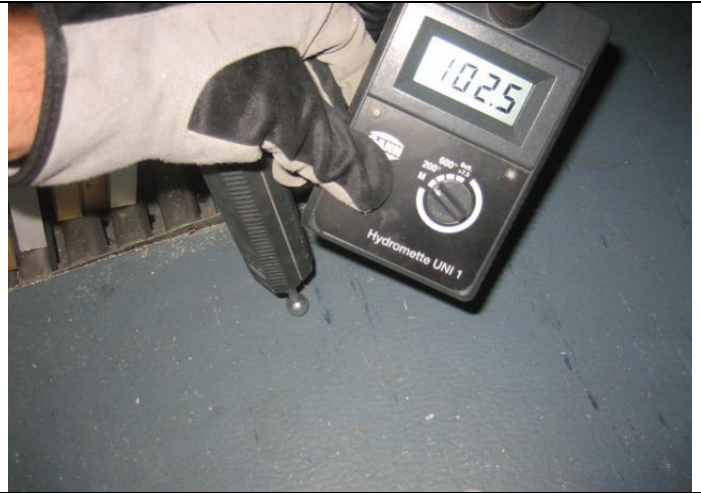
Kuva 8. Siivoussuone. lattiakaivon ympärystä muovimatto irti alustastaan ja kohonneita lukemia.
