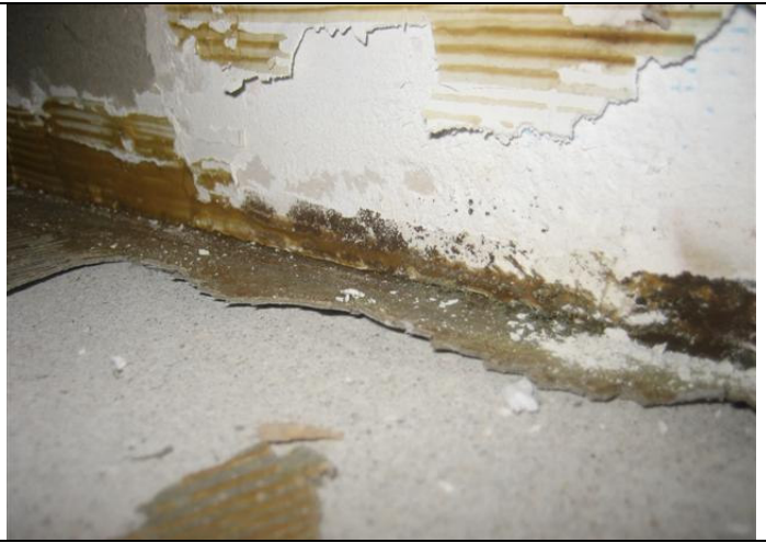
Kuva 2. Siivouhuone. Tummaa kasvustoa väliseinän kipsilevyssä.
