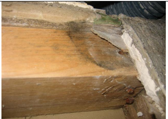
Kuva 6. Siivouhuone. Tummaa kasvustoa väliseinän runkopuissa, sekä kipsilevyssä.
