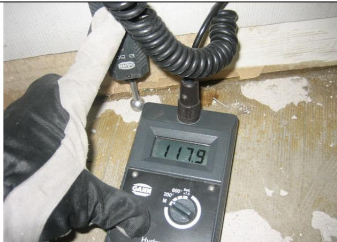
Kuva 3. Siivouhuone. Korkeita pintakosteuslukemia betonissa.
