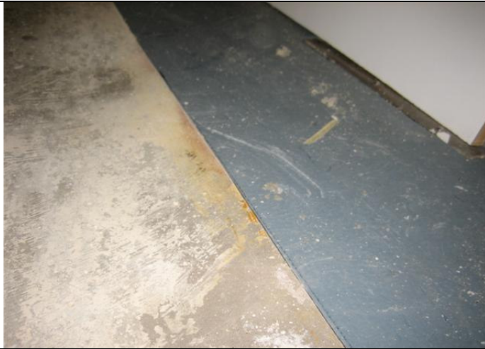
Kuva 7. Siivoussuone. Lattiamaton liima saippuoitunut.
