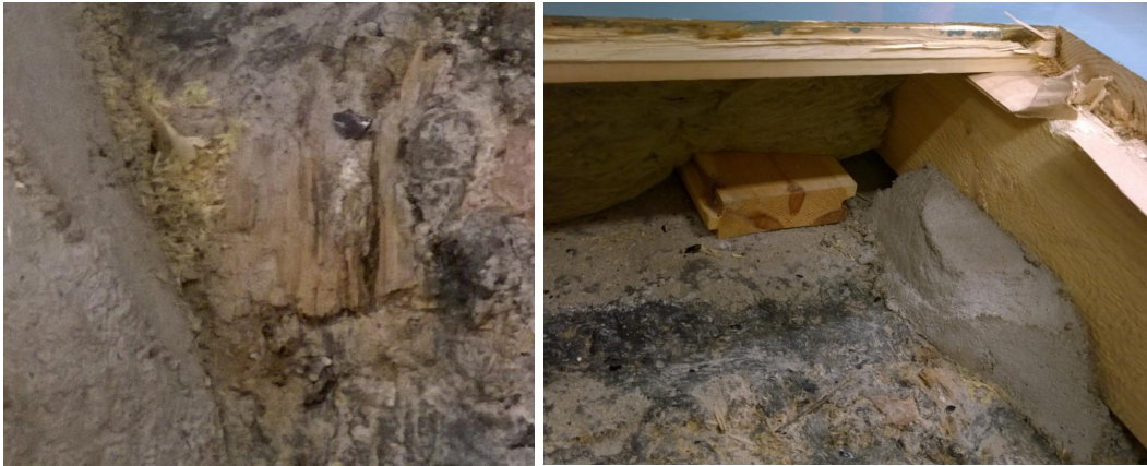
Kuva 6. Tervasiveilyssä on kiinni osittain lahonnutta puuainesta. Puuaines lienee peräisin vanhasta puretusta rakenteesta. Eristetilassa on myös rakennusjätettä kuten purua ja laudankappaleita.
