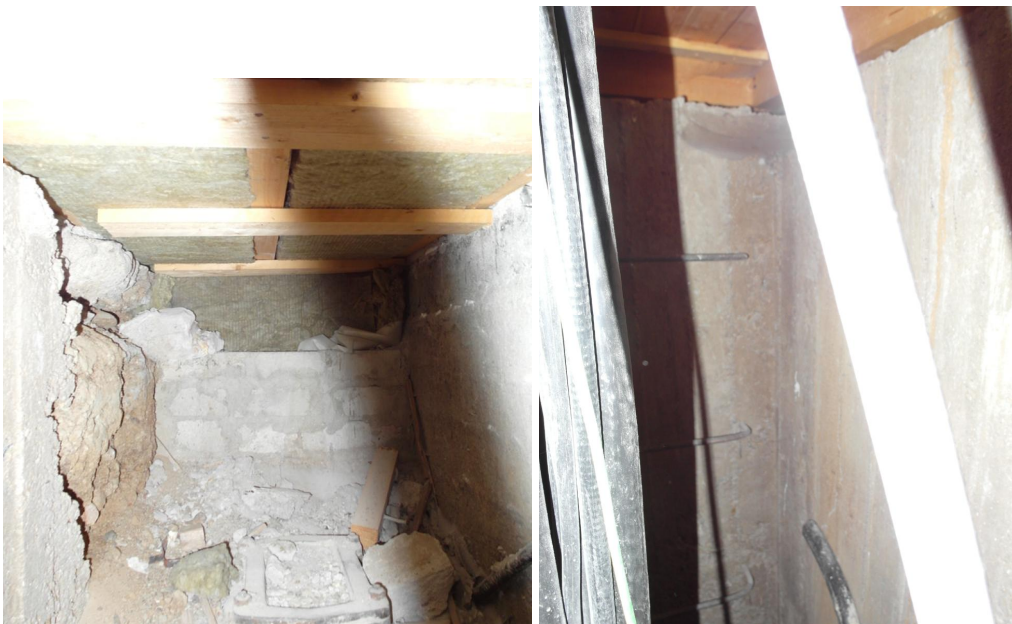
Kuvat 3 ja 4. Kuvassa 3 on kanaalin kohta. Kanaali pääty on suljettu muurauksella ja mineraalivillalla. Kanaali pohjalla on rakennusjätettä. Alapohjan rakenne ei ole ilmatiivis. Kuvassa 4 on kuilun kattoa. Kuilun takaseinässä on valuu upotetut tikkaat. Kuilun seinämien liittymissä alapohjaan on suuria rakoja.
