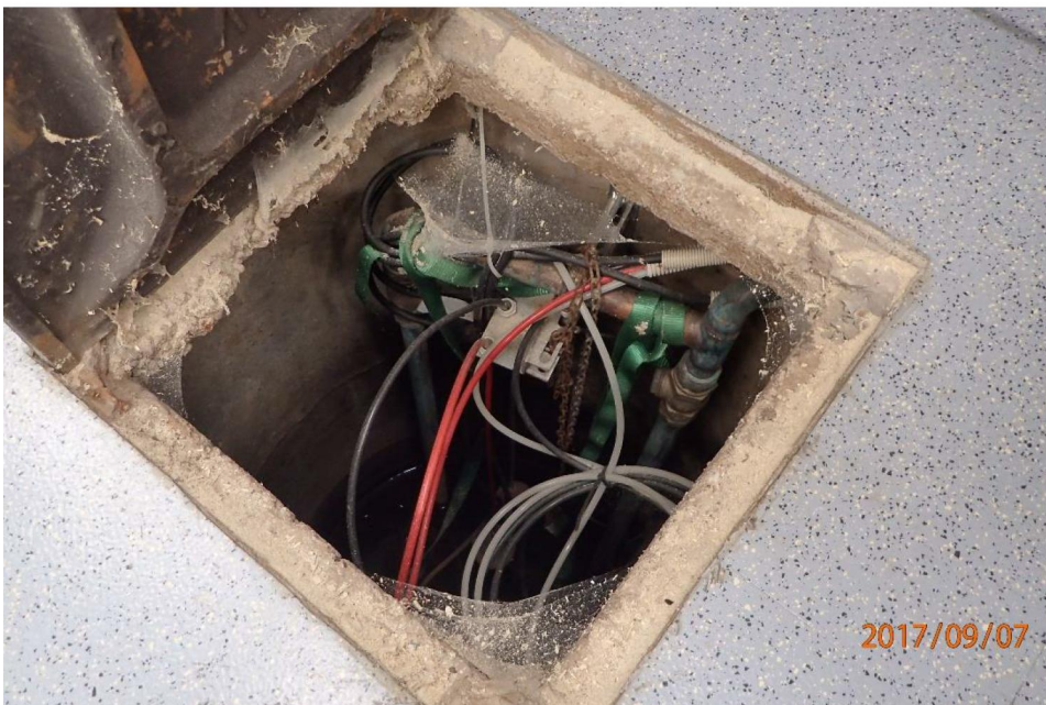
Kuva 16. Pohjakerroksessa oleva kaivo ja pumppu.
