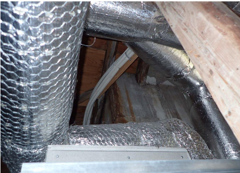
Kuva 14. Savupiipun yläosaa pitkin on valunut vettä, kuva ullakolta.
