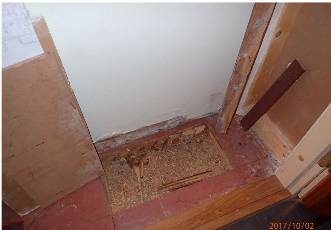
Kuva 2. Ryhmäkeskus 125, lattian ja kipsilevyväliseinän rakenneavaus. Purueristeessä ja jalkalistoissa on näkyvää mikrobikasvustoa, kuva 3 .
