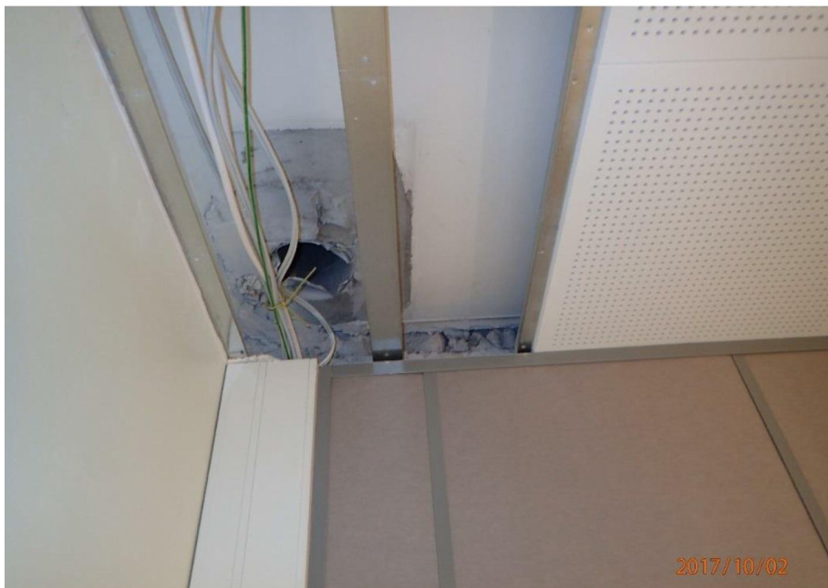
Kuva 9. Luokka 214. Akustiikkalevyjen yläpuolella on yläpohjarakenne, jossa on vanhoja, ilmeisesti avoimia läpivientejä.
