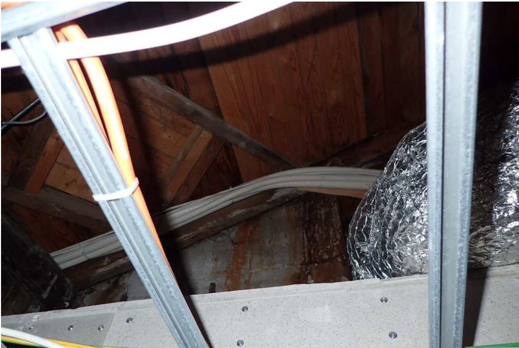
Kuva 13. Savupiipun yläosaa pitkin on valunut vettä, kuva ullakolta.
