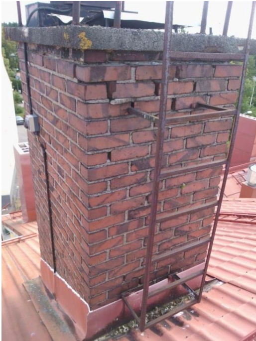
Kuva 12. Savupiipun yläosa on pakkausrapautunut. Pellitykset eivät ole vesitiiviitä.
