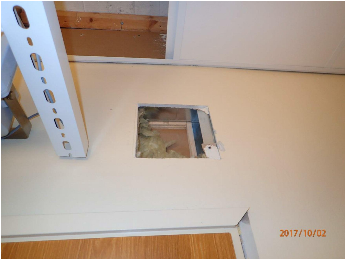
Kuva 7. Varasto 031. Oven yläpuolella oleva kipsilevyseinä on aistinvaraisesti arvioiden kuiva.
