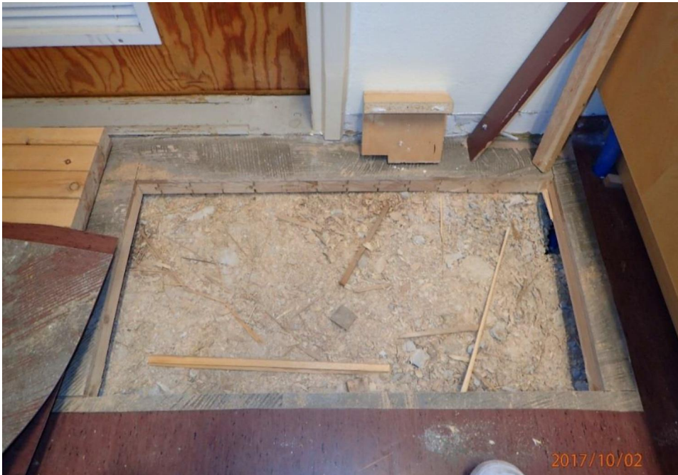
Kuva 5. Monistushuone 118, lattian rakenneavaus. Rakenne on kuiva. Rakenteessa on lievästi tunkkainen haju, ja käyttäjä kertoi tilassa olleen aamulla maakellarimainen haju.
