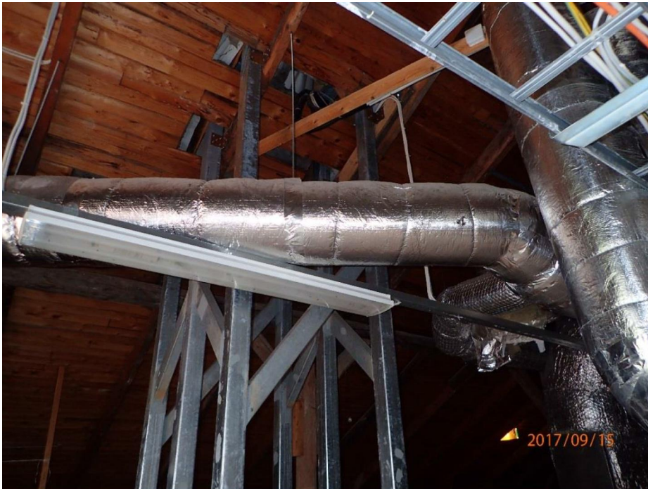
Kuva 15. Ullakolle oleva tukirakenne. Aluskate ei ole tukirakenteen kohdalla yhtenäinen.
