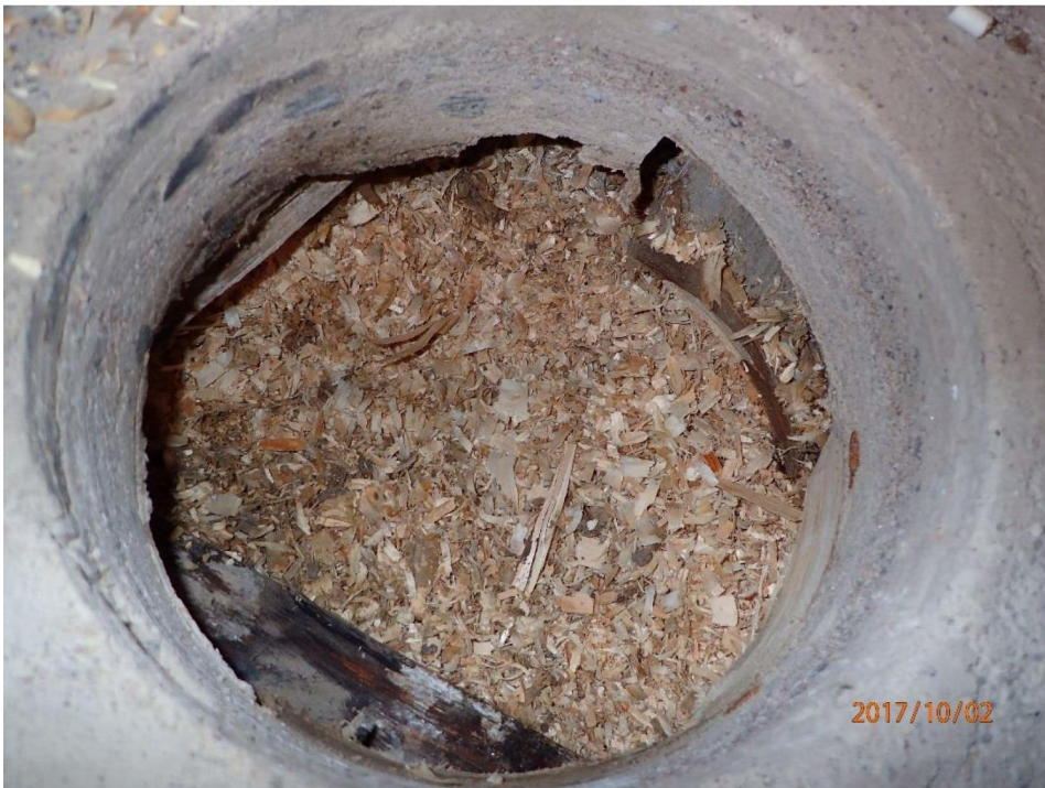
Kuva 11. Yläpohjan betonilaatan alla on osittain lahovaurioitunut puukoolaus.
