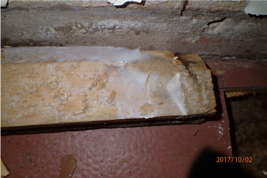
Kuva 3. Ryhmäkeskus 125, kuvassa 2 esitetty rakenneavaus. Purueristeessä ja jalkalistoissa on näkyvää mikrobikasvustoa.
