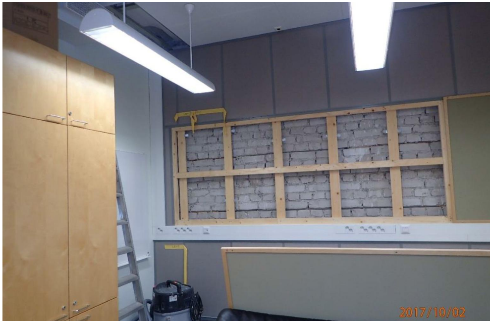
Kuva 8. Luokka 214. Ulkoseinän pintarakenteiden takana on tasoittamaton tiilimuraus.
