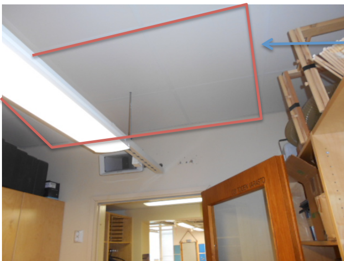
Alakerran katon vaurioaluetta
