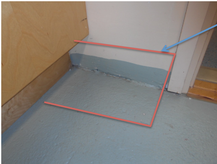
Lattian ja seinän vaurioaluetta
