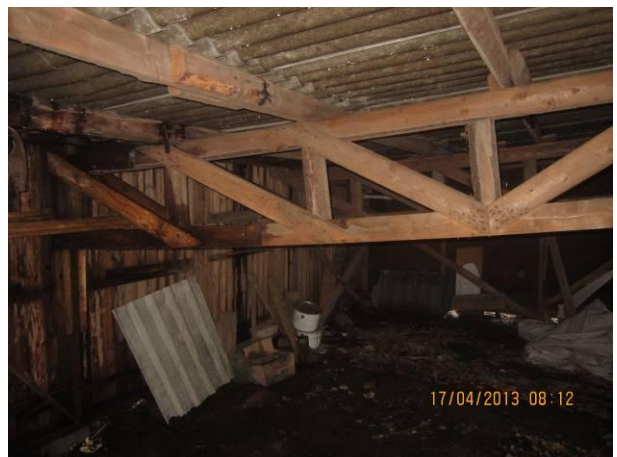
Kuva 6 Autotallin runkorakenteet ovat vaarassa sortua.
