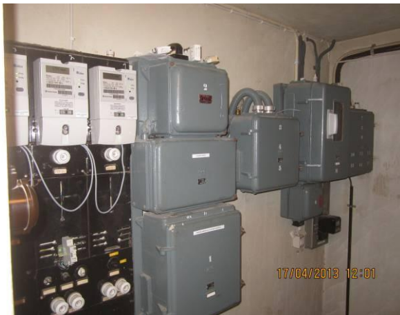
Kuva 1 Yleiskuva alkuperäisestä sähkökeskuksesta, mittarit on uusittu etäluett.
