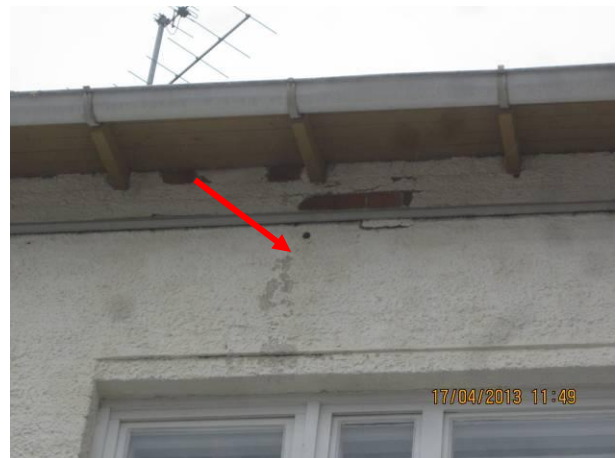
Kuva 10 Räystäään vesikatevuodon takia rappaus- ta on irronnut ulkoseinästä.
