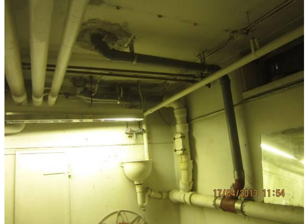
Kuva 2 Lämmönjakuhuoneen muoviviemärien palokatkot välip.läpi on tarkistettava.
