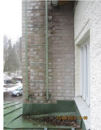
Kuva 14 Piippu on huonokuntoinen.
