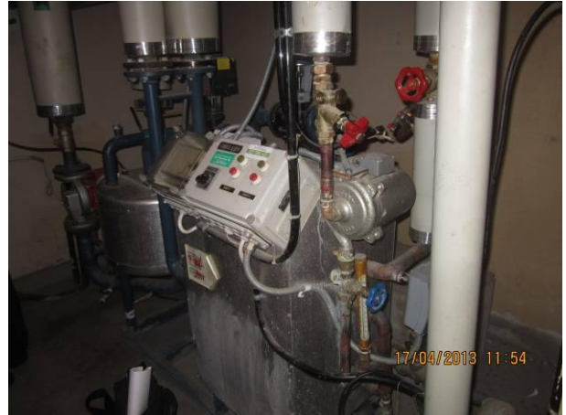
Kuva 4 Yleiskuva v. 1980 lämmönvaihtimesta.
