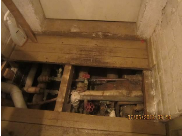
Kuva 1 Putkikanaalin kellarikäytävän puulattian alla, putket ovat vanhoja.
