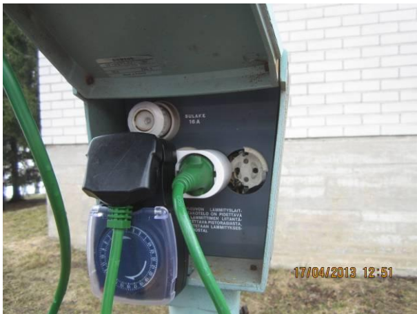
Kuva 3 Autolämmityspistorasia oli lukitsematta, rikkinäinen pistorasia.
