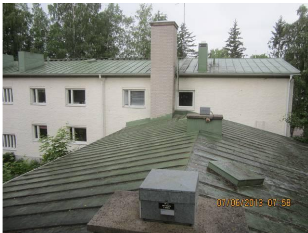
Kuva 5 Matalan osan vesikatolla on kaksi poistopuhallinta tiilihormien päissä.
