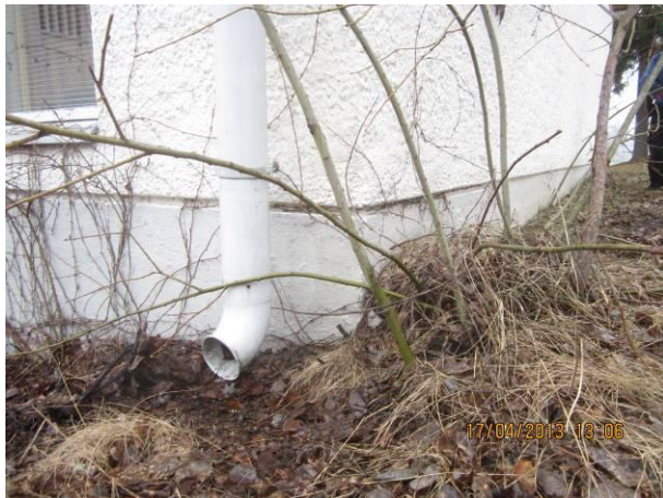
Kuva 3 Sokkelivierillä on painumia, kattovedet jäävät talon viereen.
