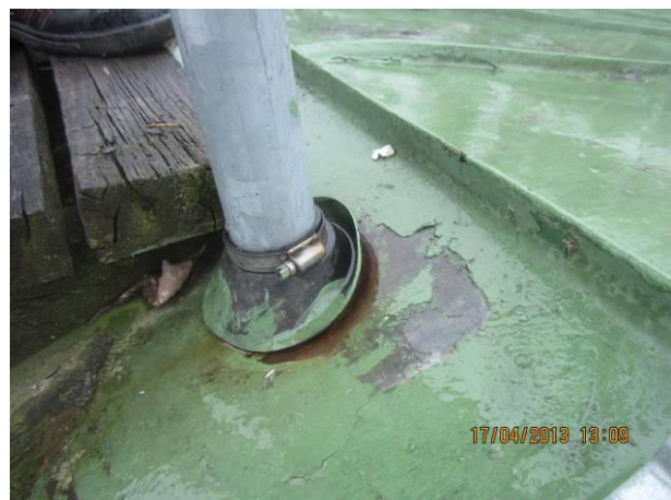
Kuva 6 Vuotava antenniputken läpivienti korkean osan katolla.
