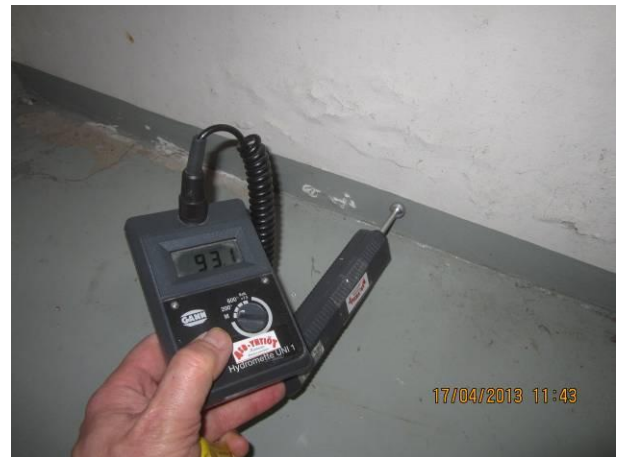
Kuva 28 Kosteusmittaus pukuhuoneen ja pesuhuoneen välisestä seinästä.
