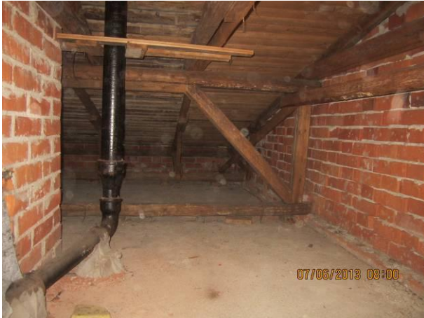
Kuva 3 Eristämätön tuuletusviemäri yläpohjantelossa.
