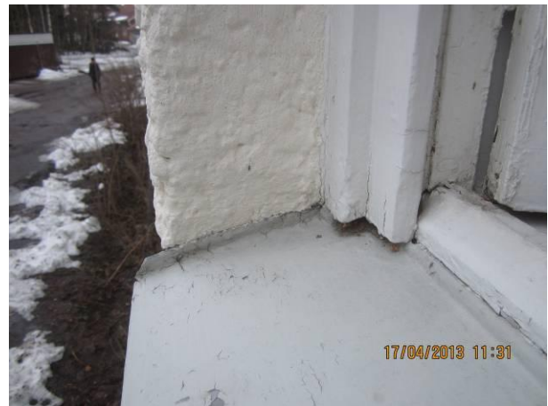
Kuva 12 Loiva vesipelti, ikkunan alaosan puu halkeilee.
