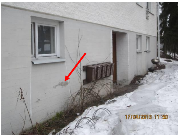
Kuva 9 Korkean betonisokkelin pinnassa maali on paikoin kulunut.
