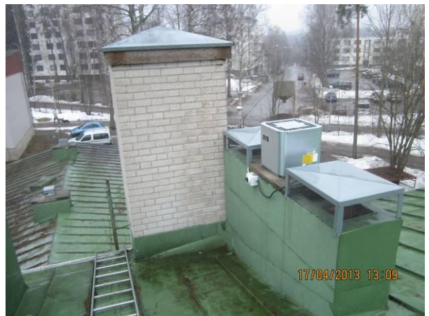
Kuva 6 Korkean osan vesikatolla on yksi poistopuhallin. Sisällä on kanavapuhaltimia mm. wc-tiloissa.
