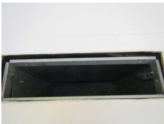
Kuva 46. Puutteellisesti asennettu asennuskehys luokkahuoneessa.
