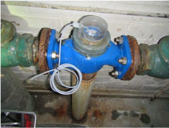
Kuva 17. Vesimittarin kaukoluenta ei ole kytketty.
