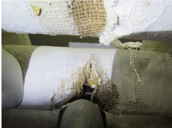
Kuva 21. Pintavaurioita alkuperäisissä eristeissä.
