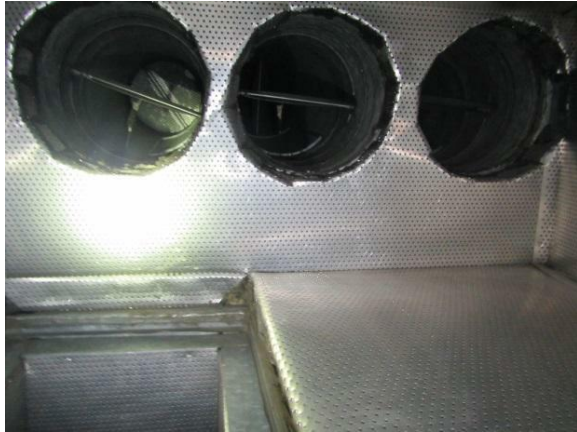
Kuva 44. Reikäpeltiä tuloilman jakolaatikossa TIK-4.
