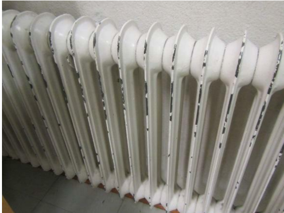
Kuva 11. Maalivaurioita alkuperäisessä luokahuoneen patterissa.
