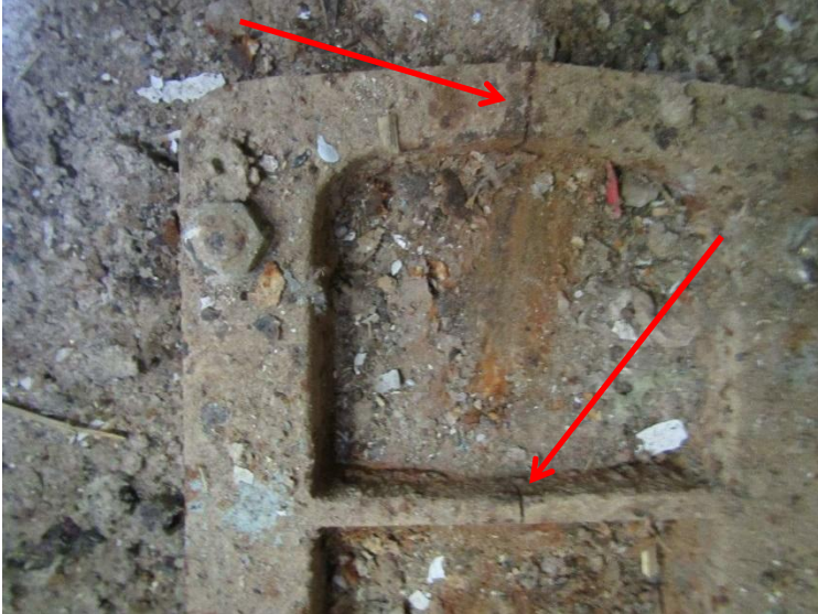
Kuva 34. Puhdistusluukun kannessa on halkeama.
