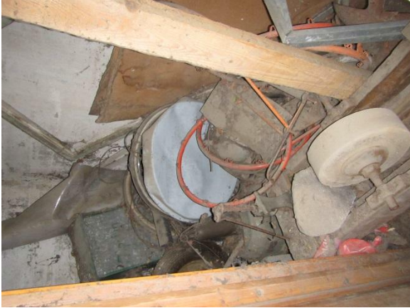
Kuva 39. Ulkoilmakammio on täynnä rojua.
