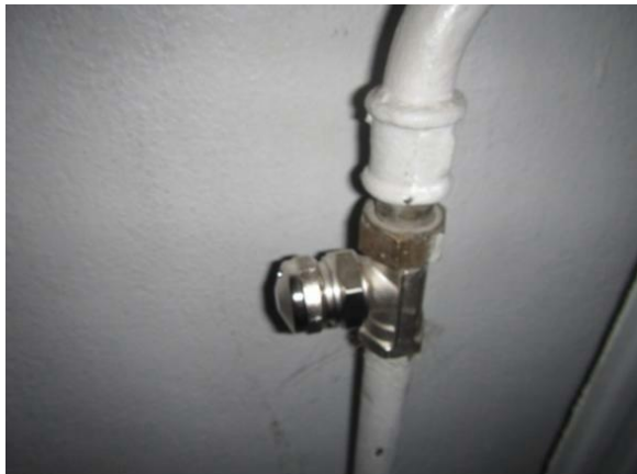
Kuva 14. Käytävien pattereissa on uusitut käsisäätöpyörät.
