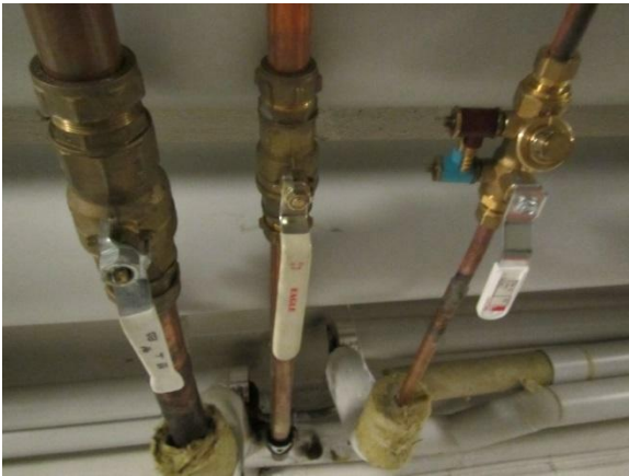
Kuva 19. Venttiilit ovat pääosin uusittuja palloventtiileitä.
