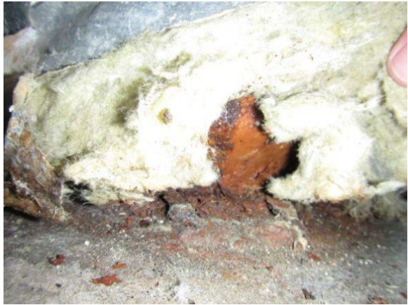
Kuva 18. Tonttivesijohdon ulkopinta on ruostunut.
