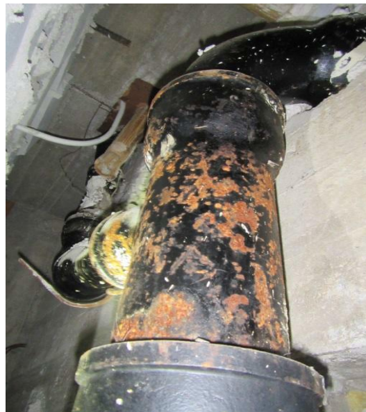
Kuva 33. Pystyviemärissä on ulkopuolista korroosiota.
