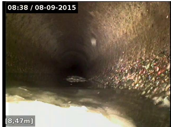
Kuva 31. Tonttviemärissä (betoni) on painumaa/ padotusta.
