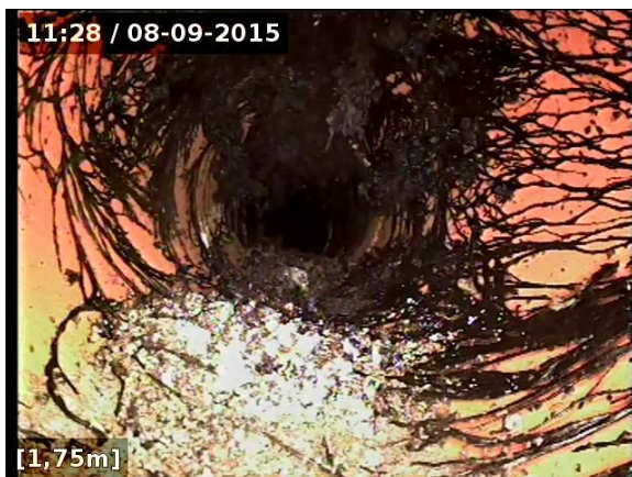
Kuva 4. Etupihan laatan alla käytettyä viemäriputkea jossa juuria (TV15_SO).
