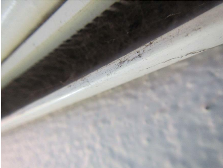
Kuva 47. Karmiventtiili on osin tukossa neuvotteluhuoneessa.
