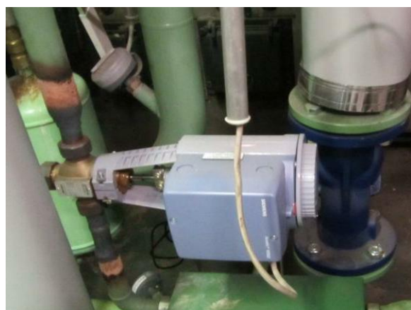
Kuva 54. Siemensin säätöventtiili ja toimilaite (Ijh).
