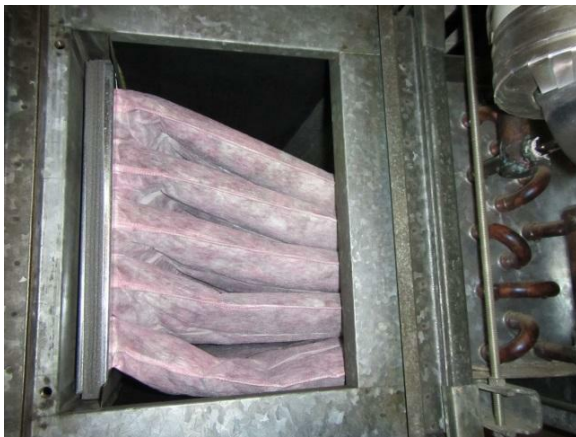
Kuva 37. Vaakatasoon asennettu pussisuodatin.
