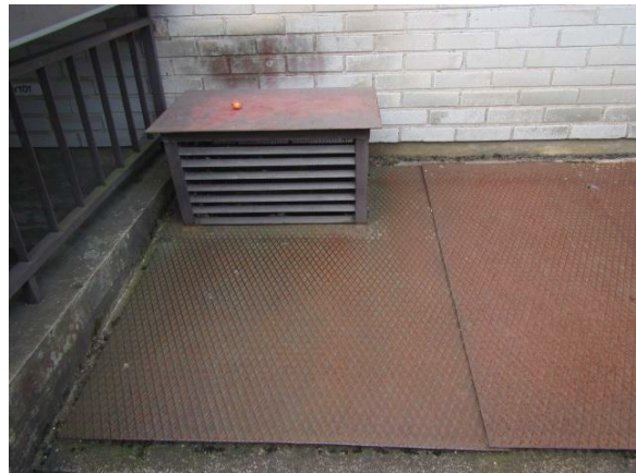
Kuva 36. Ulkoilmasäleikkö (TIK3/TK5) etupihalla.
