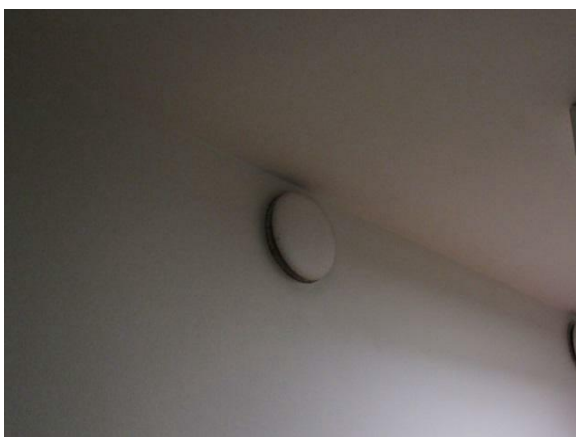
Kuva 45. Vanha poistoilman lautasventtiili opettajienhuoneessa.
