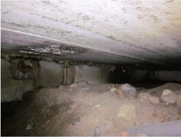
Kuva 13 Koillisen puoleisessa päädyssä kondenssia tuuletusputkien edustoilla.
