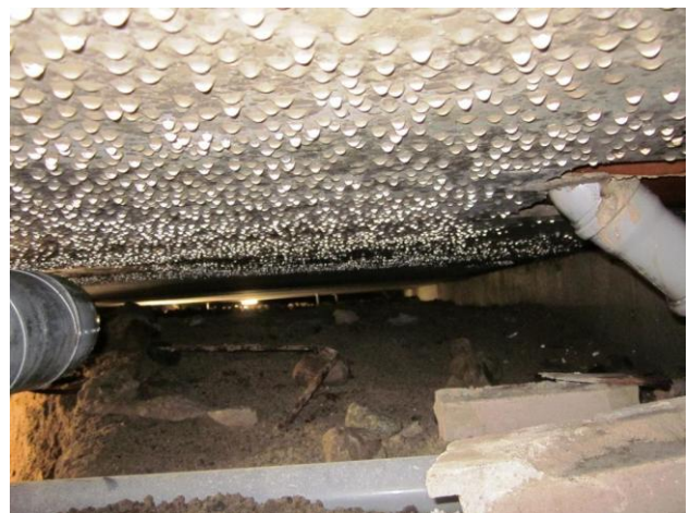
Kuva 12 Käyntiluukun lähellä sokkelipalkin vierustalla voimakasta kondenssia. Erittäin matalaa.
