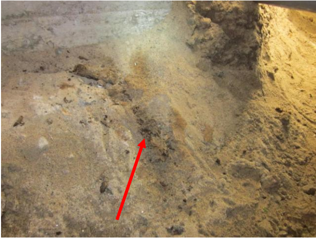
Kuva 17 Käyntiluukun kohdalla täyttökerroksessa lahonneita puun kappaleita.
