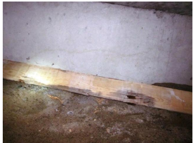
Kuva 16 Pohjoisen puoleisessa sivulohkossa muutama irtolaudan pätkä.
