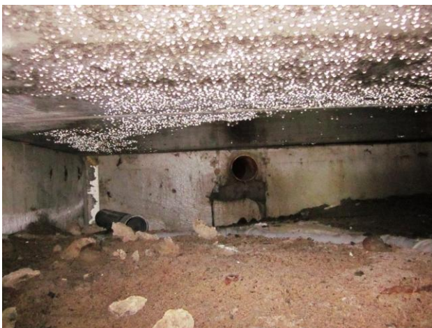
Kuva 11 Pohjoisen puoleisessa sivulohkossa lounaan puoleisella päätyosalla voimakasta kondenssia.
