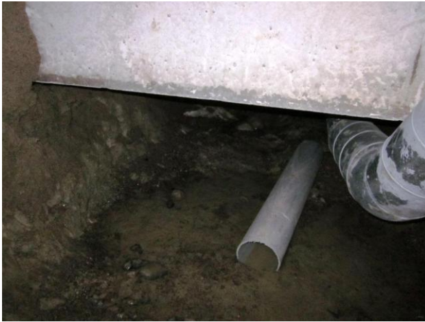
Kuva 9 Perustuspalkin alituskohdalla on vettä.
