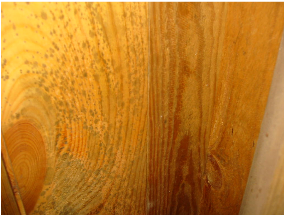
Kuva 4. Räystäsrakenne ulospäin kuvattuna. Kuvan puurakenteisiin liittyvä räystäspellitys (ks. kuva 3) on liitetty kiinteästi ulkoseinän peltikasettiin niin, ettei rakenteessa ole tuuletusrakoa ulkoilmaan.
