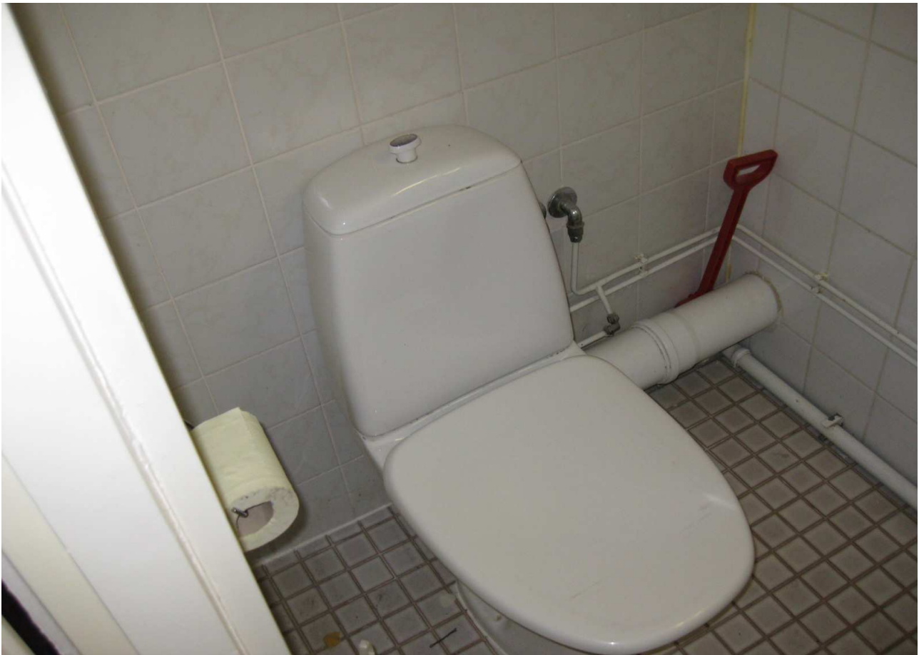
LVI-kuva 10. Yleiskuva vesikalusteista.
