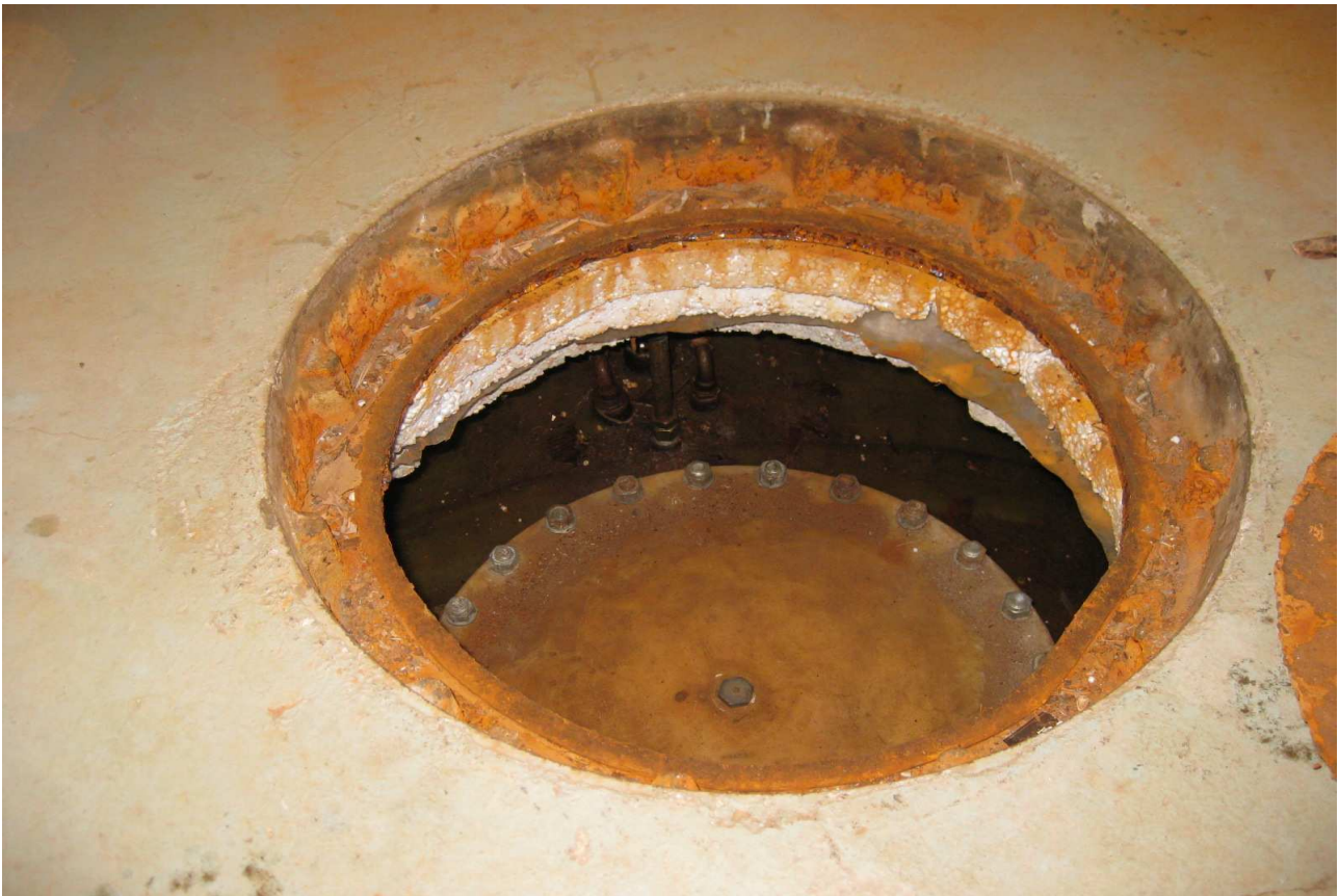
LVI-kuva 2. Yleiskuva öljysäiliön huoltoluukusta.
