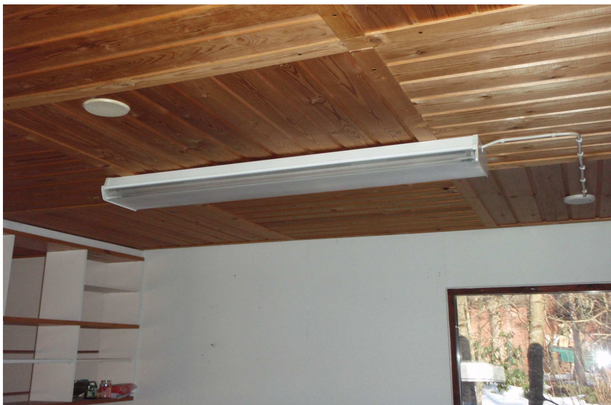
S-kuva 7. Yleiskuva valaistuksesta.
