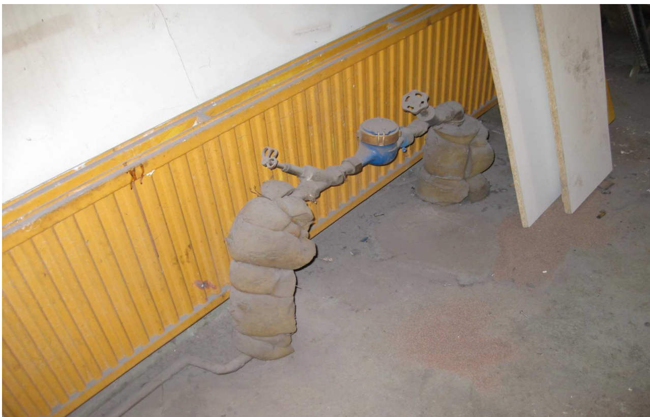
LVI-kuva 8. Yleiskuva vesimittarista.
