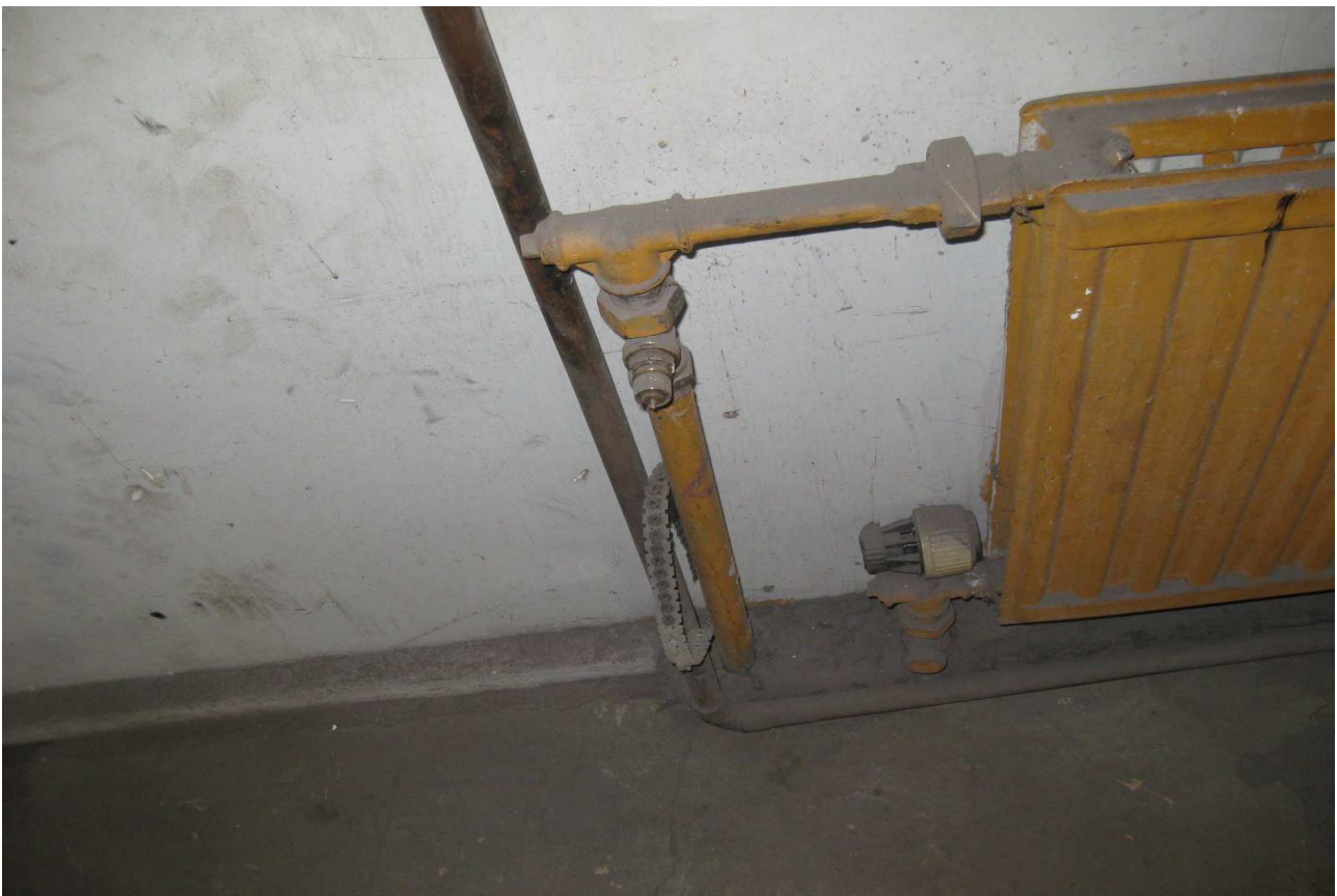
LVI-kuva 7. Yleiskuva rikkonaisesta patteriventtiilistä.
