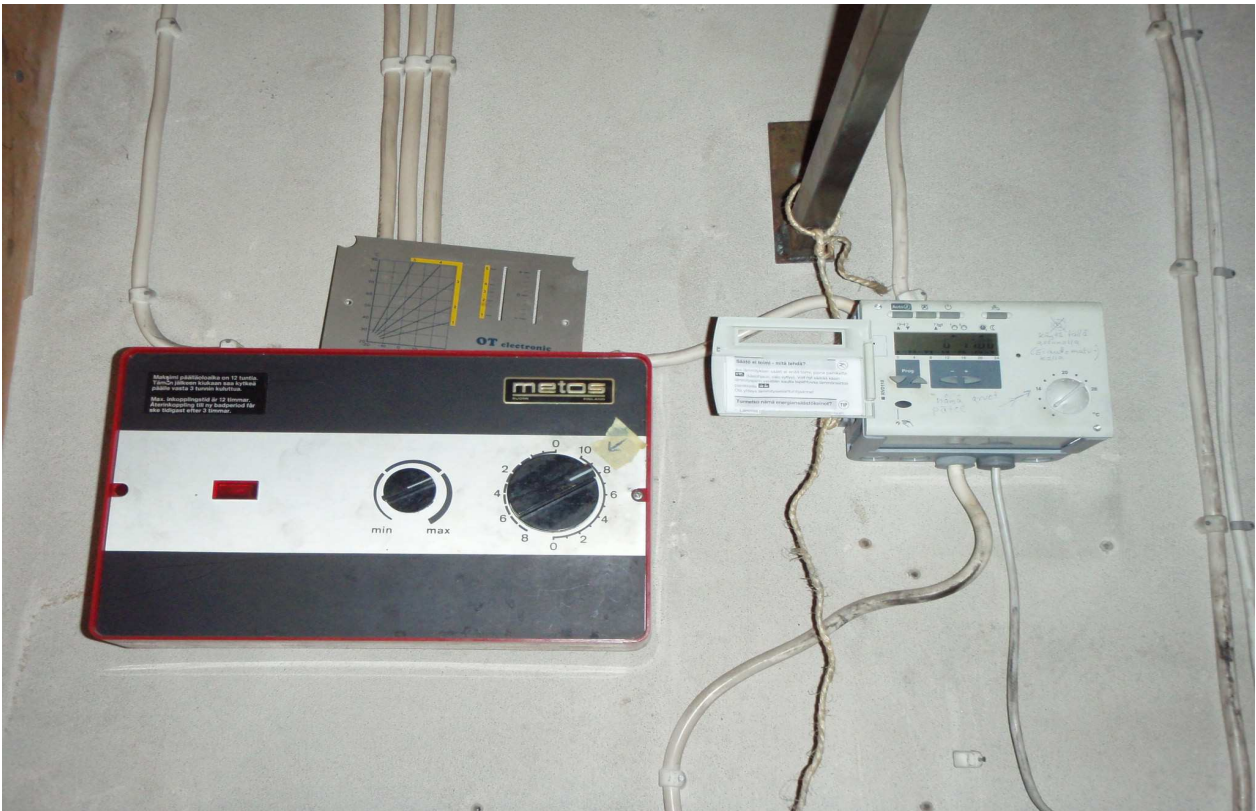
S-kuva 15. Rakennusautomaatiojärjestelmän yksikkösäädin ja kiukaan ohjauskeskus.
