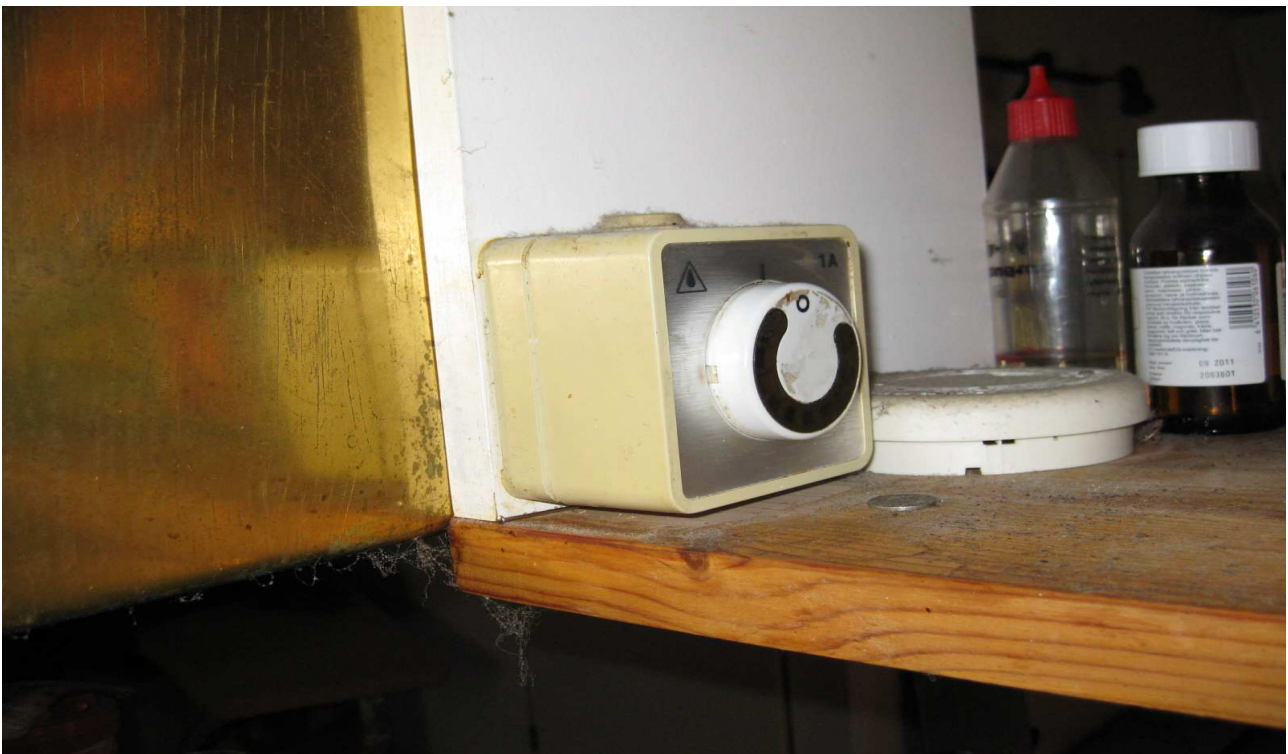
LVI-kuva 11. Yleiskuva liesikuvun ohjauksesta.
