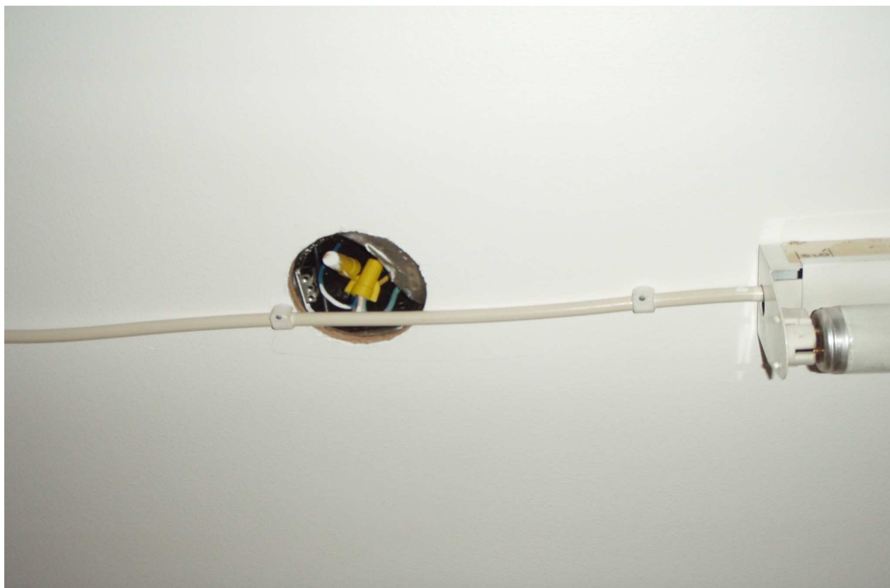
S-kuva 6. Vaatehuoneen jakorasian kansi puuttuu.
