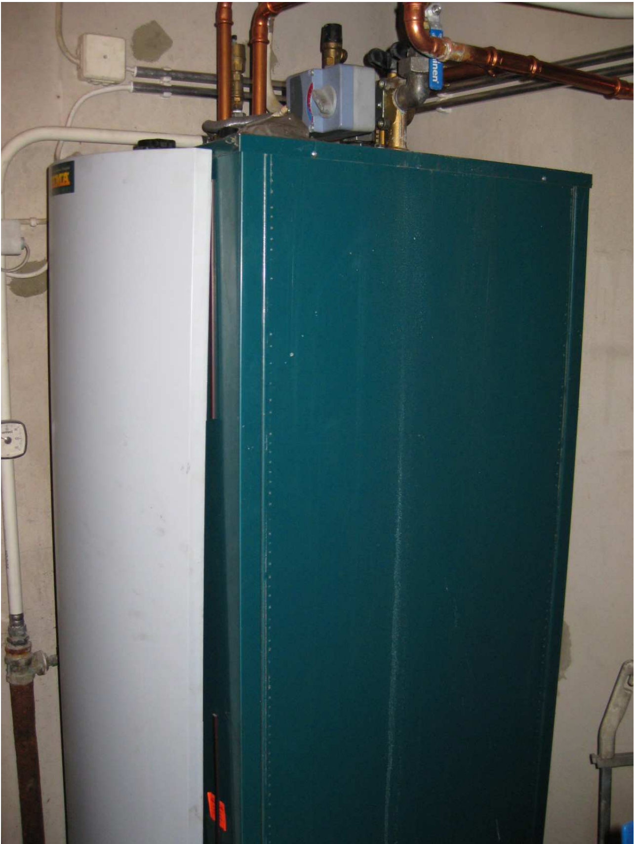
LVI-kuva 1. Yleiskuva pannuhuoneesta.
