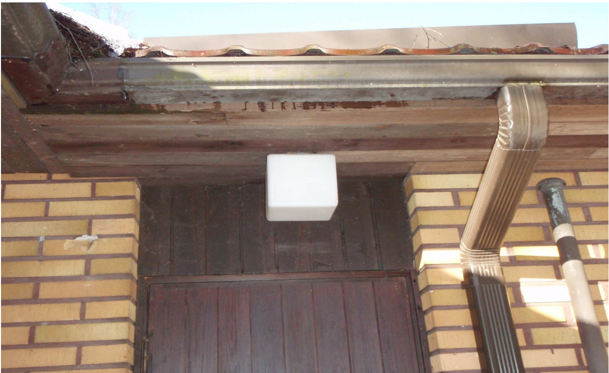
S-kuva 1. Sisäänkäynnin valaistus.
