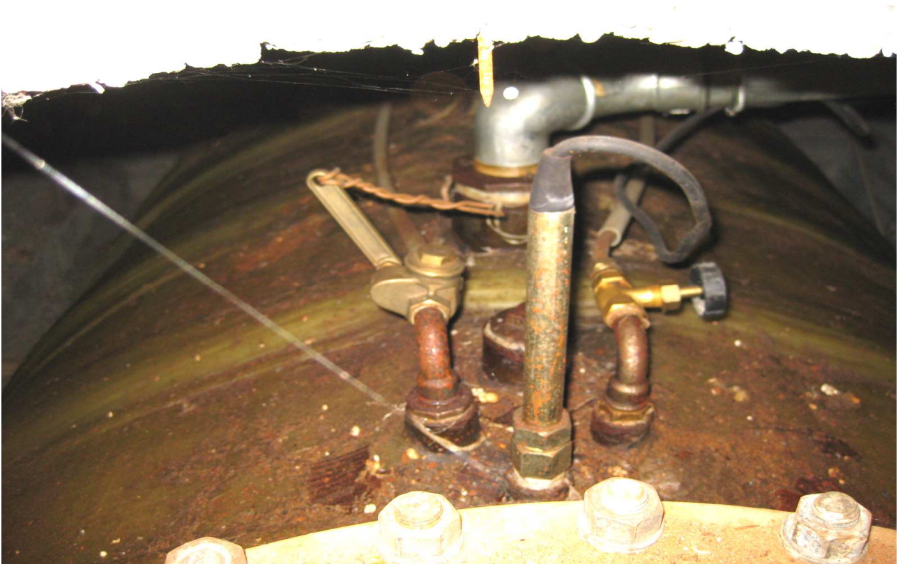
LVI-kuva 3. Yleiskuva öljysäiliöstä.
