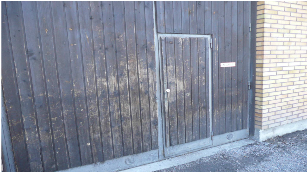
R-kuva 1. Puuovien kulumia.
