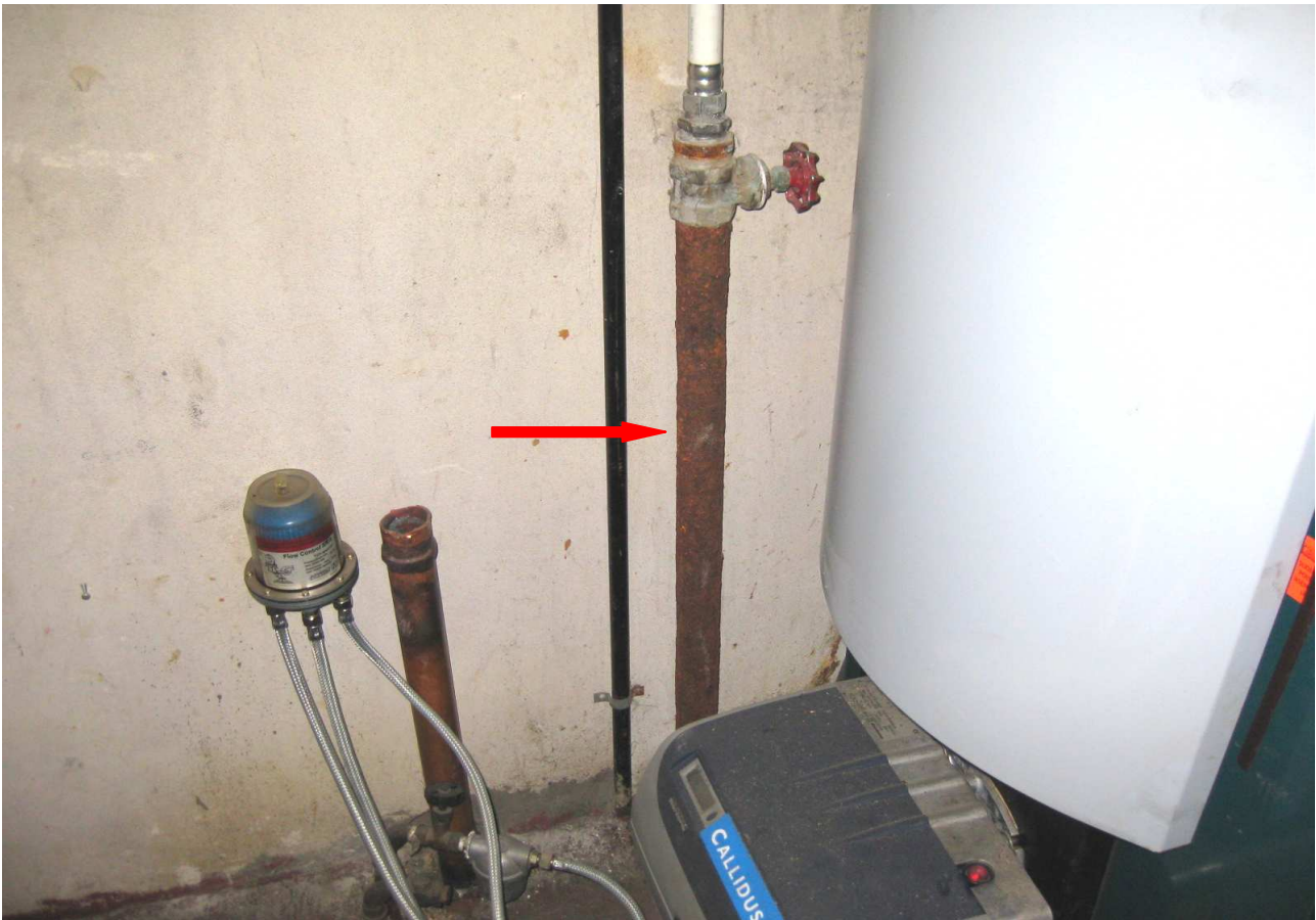
LVI-kuva 4. Yleiskuva syöpyneestä lämpöputkesta.
