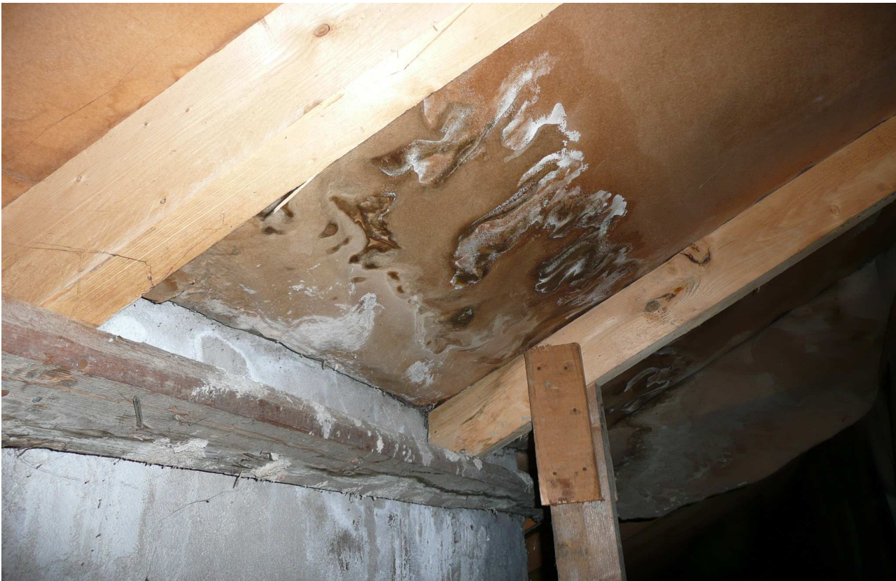
R-kuva 3. Piipun läpiviennin kosteusvaurio.
