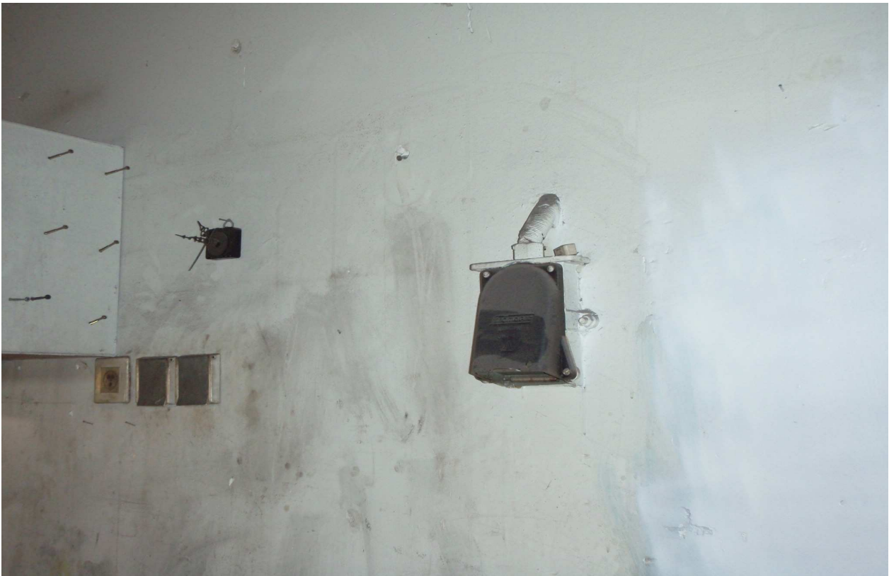
S-kuva 4. Autotallin huonokuntoinen voimapistorasia.
