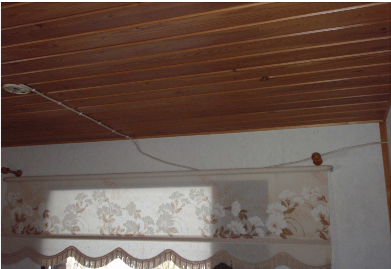
S-kuva 5. Lisäasennuksen irrallinen kaapeli.
