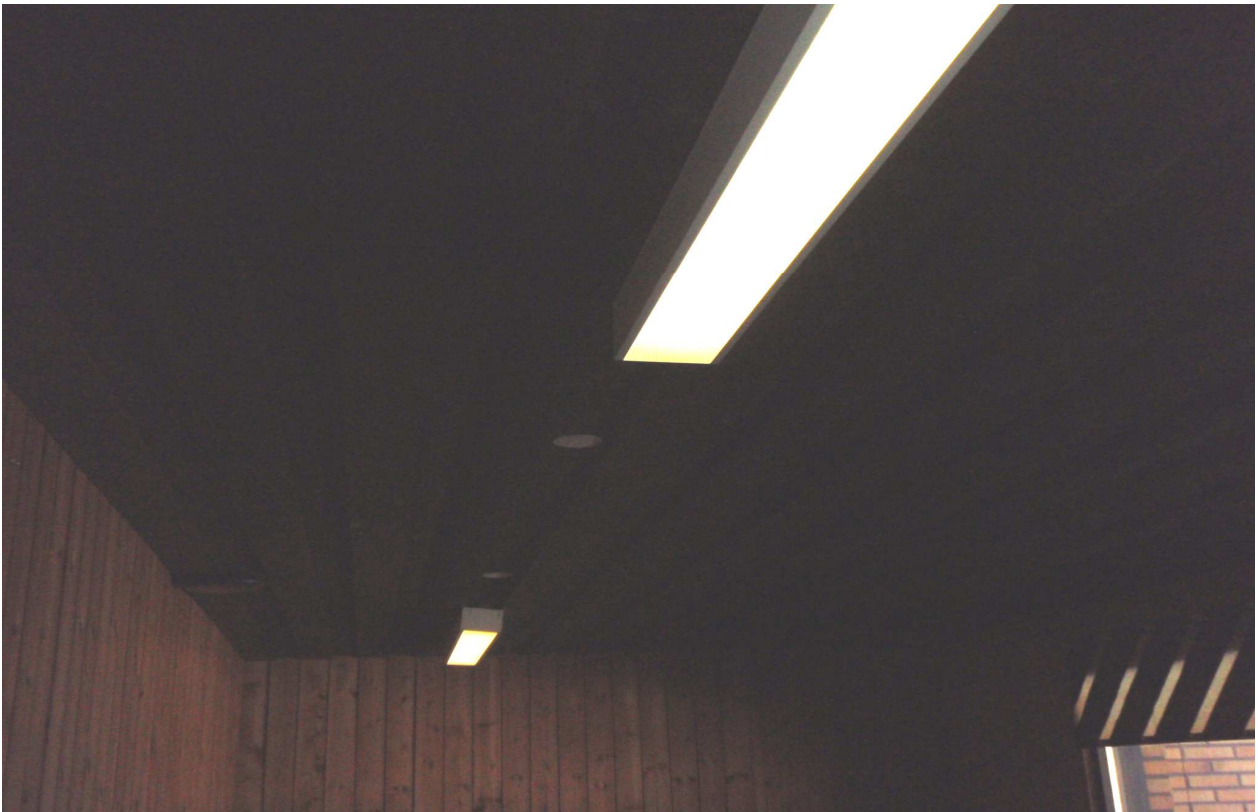
S-kuva 10. Yleiskuva allashuoneen valaistuksesta.
