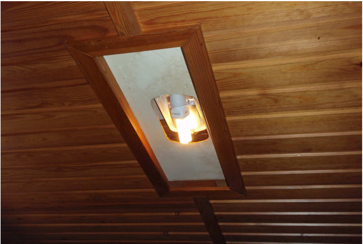
S-kuva 12. Pesuhuoneen valaisimesta puuttuu kupu.
