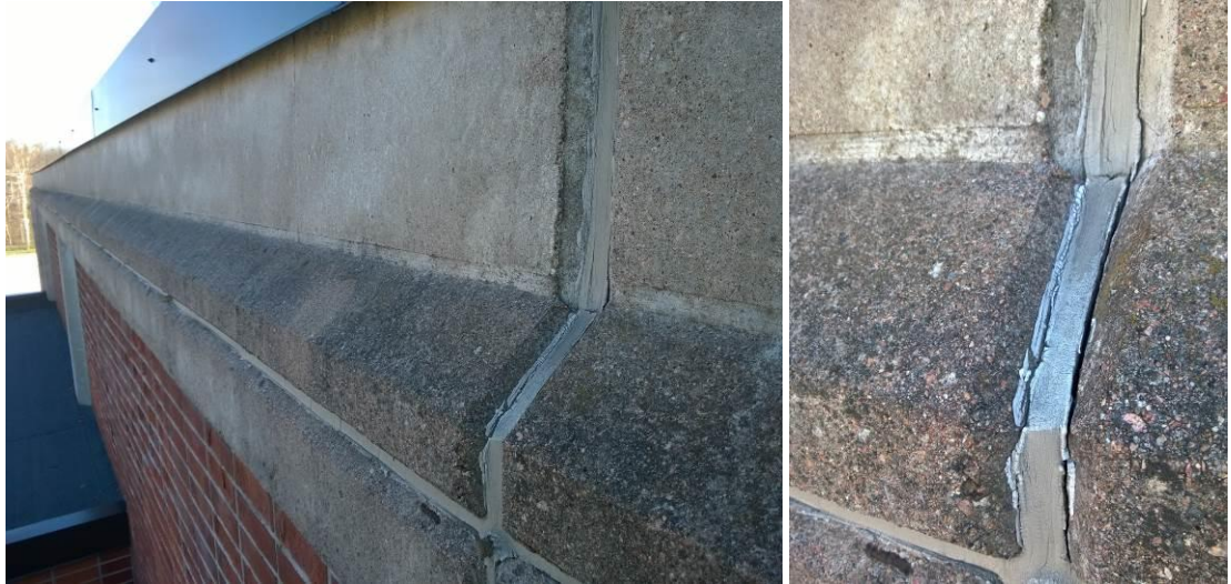
Kuvat 7 ja 8. Elementtisaumat ovat etenkin rasetetuilla alueilla heikossa kunnossa. Profiloitujen elementtien viistoilla osilla sijaitsevat saumat ovat erityisen heikossa kunnossa
