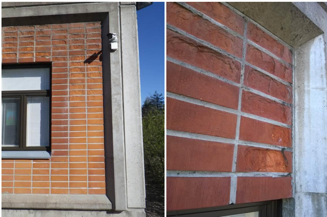
Kuvat 3 ja 4. Tiililaattojen ulkopinnan rapautumista, esimerkkejä. Vauriot esiintyvät pääosin kosteusrasitettujen elementtien yläosissa, joihin elementin profiili todennäköisesti johtaa vettä yläpuolelta.
