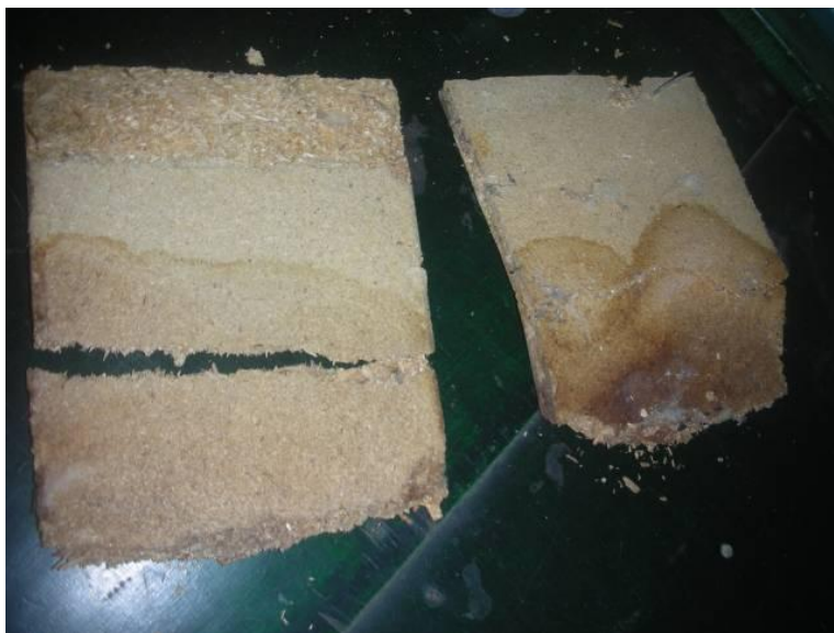
Kuva 10. Kosteusjälkiä irrotetuissa sisäverhouslevyissä.
