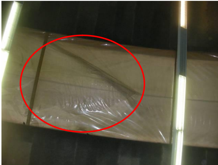
Kuva 9. Aluskate (muovikalvo) revennyt ja tippunut höyrynsulkumuovin päälle.
