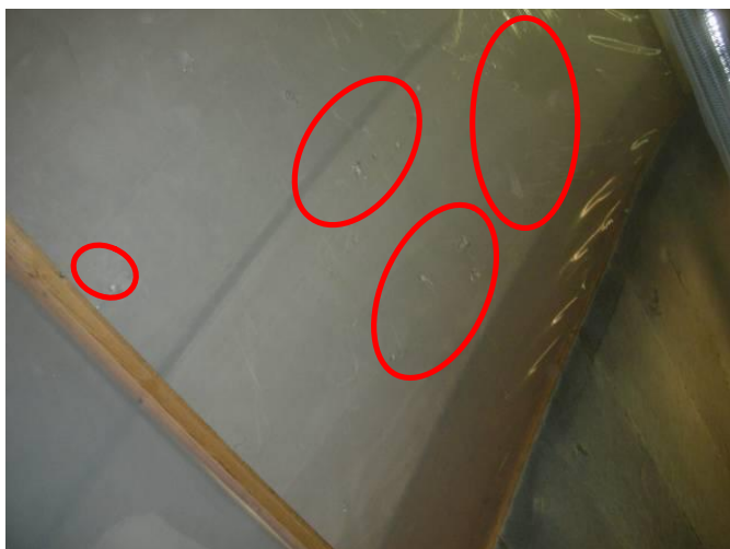
Kuva 8. Repeämiä ja reikiä höyrynsulkukalvossa.
