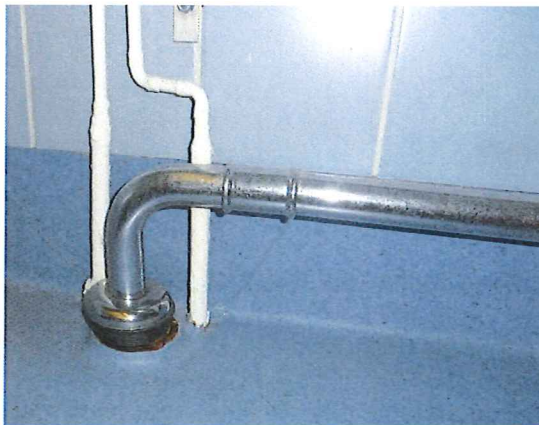
Kuva 1. Tilan 130 teräksisen pesualltaan viemäriiliitos ei ole tiivis.
