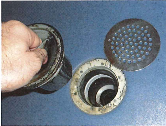
Kuva 3. WC-tilan 134 vesilukko on irrotettavissa puhdistusta varten.
