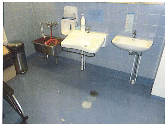
Kuva 2. Vesi tulvi lattialle tilassa 130, koska lattiakaivon vesilukko on tukossa.
