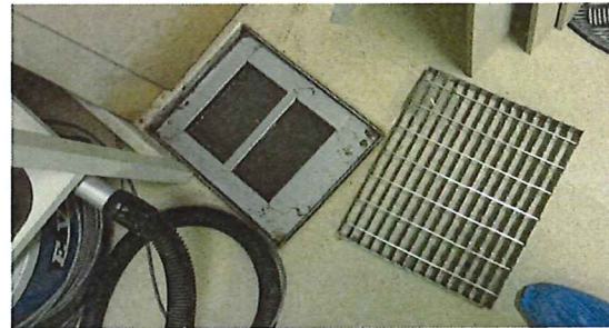
Kuva 6. Lattiakaivon vesilukko täynnä vettä.
