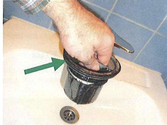
Kuva 4. Irrotettu lattiakaivon vesilukko. Kumitiiviste, joka estää veden virtauksen vesilukon sivuilta ja viemärikaasujen pääsyn huoneeseen, on osoitettu nuolella.
