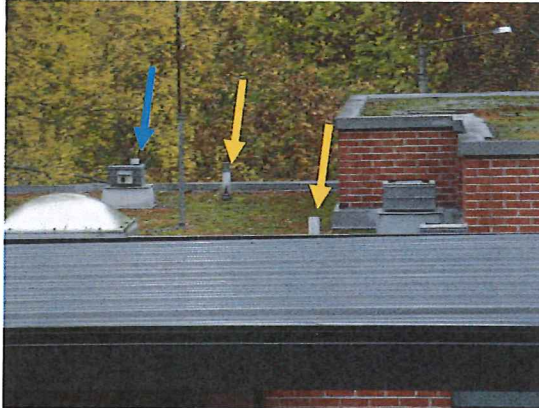
Kuva 8. Käytössä olevia (oranssit nuolet) ja käytöstä poistettuja (sininen nuoli) tuuletusviemäreitä.
