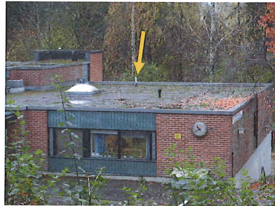
Kuva 9. Käytössä oleva tuuletusviemäri.
