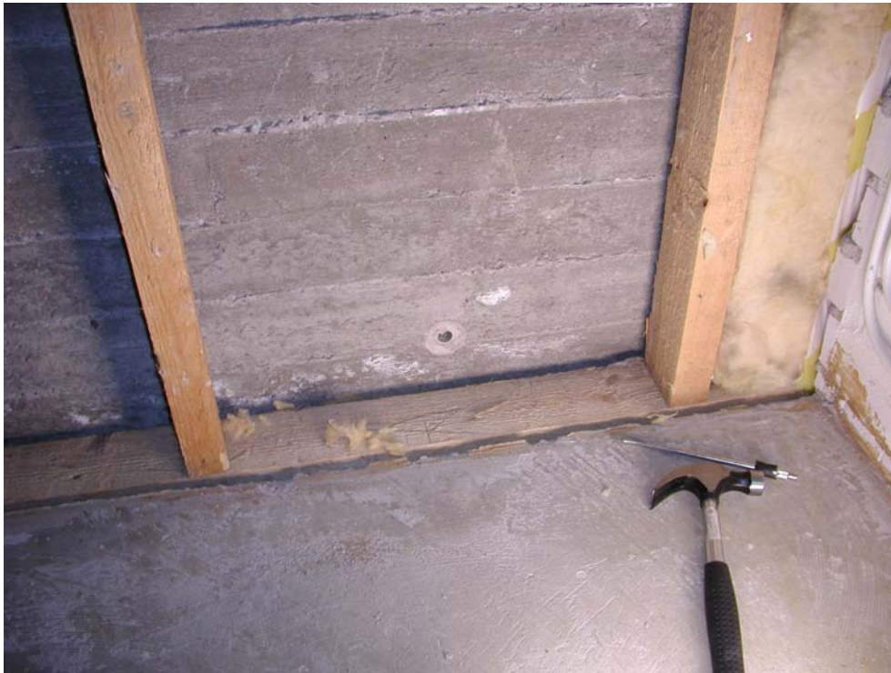
Kuva 3. WC-tilassa 005 seinän alalankku on lattiapinnan alapuolella. Kohonneita kosteusarvoja tai hajua ei havaittu.
