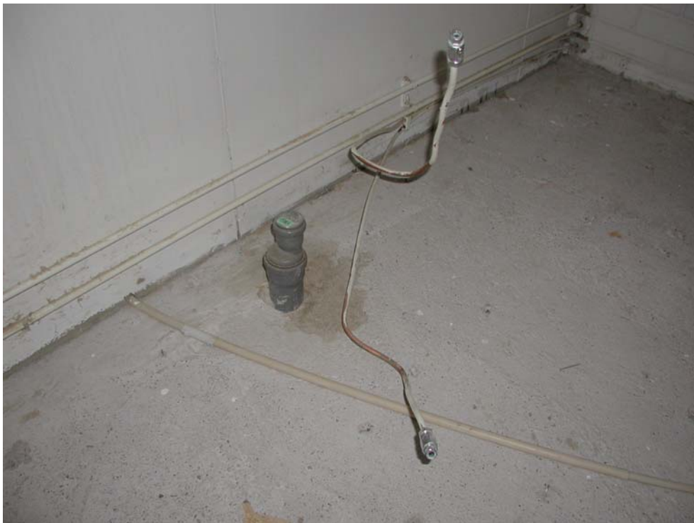
Kuva 2. Tilassa 002, vesipisteen viemäroinnin ympärillä on kosteusjälkiä. Mittaushetkellä lattia oli kuiva.
