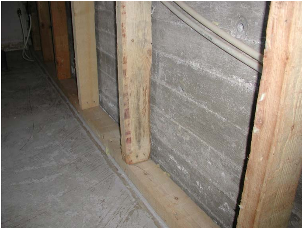
Kuva 1. Tilan 002 seinän pystysuuntaisissa puurakenteissa on vähäisiä tummentumia. Alalankku on kiinni lattiapinnassa. Puurakenteet olivat kovia eikä niissä havaittu kohonneita kosteusarvoja.
