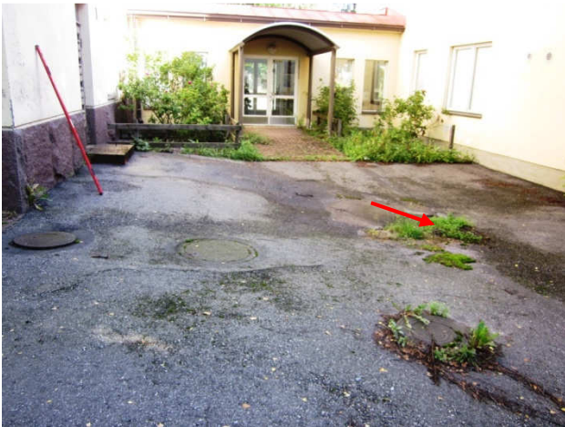
Kuva 10 Asfaltissa routavaurioita. Nuolen kohdalla sadevesikaivo.
