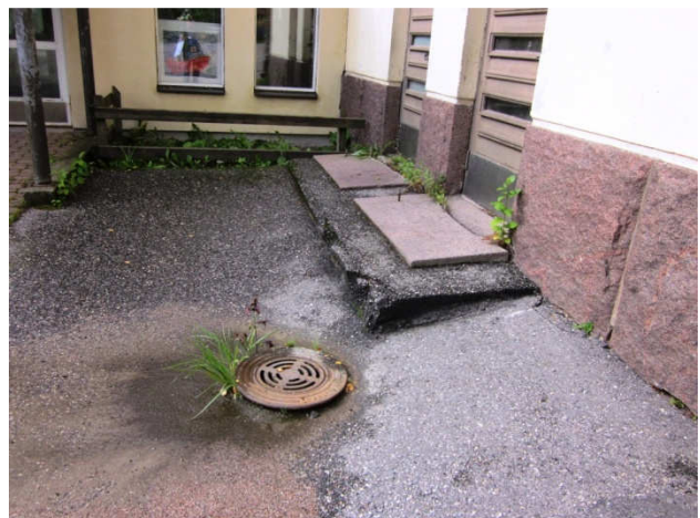
Kuva 13 Sadevesikaivon kansiosa asfaltin pintaa ylempänä.
