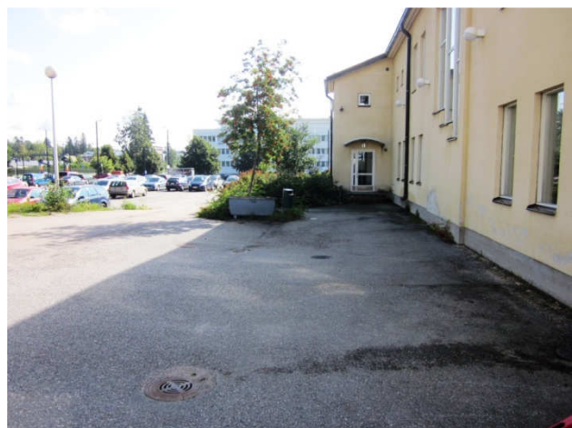
Kuva 17 Sadevesikaivoja. Pinta viettää Orvokkitien suuntaan.
