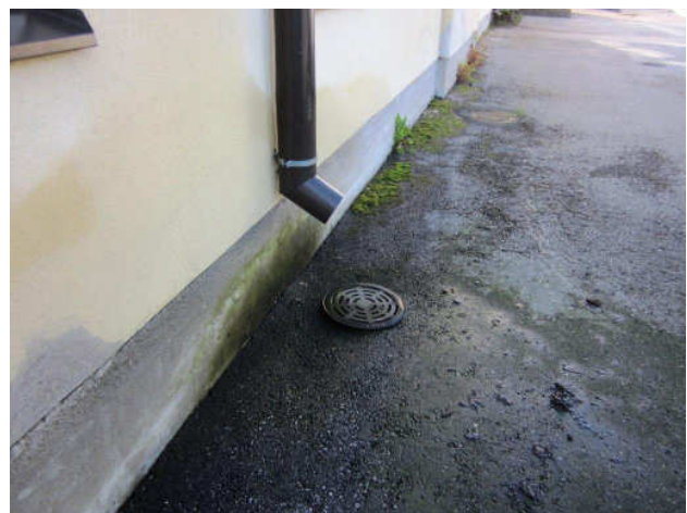
Kuva 33 Kattoveden ohjauksessa puutteita. Kansiosa asfaltin pintaa ylempänä.
