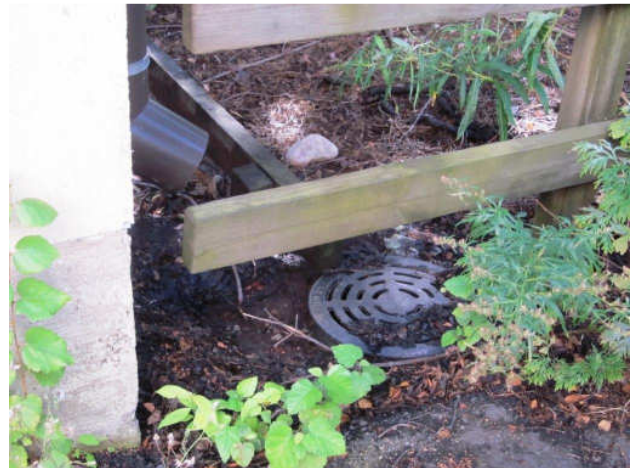
Kuva 31 Kattovesi ei ohjaudu sadevesikaivoon.
