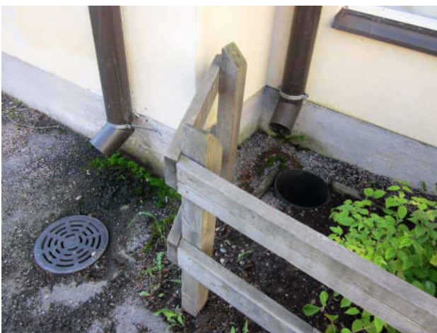
Kuva 32 Kattoveden ohjauksessa puutteita.
