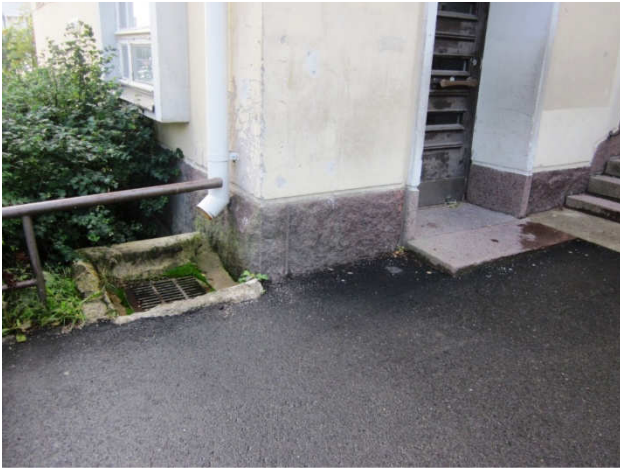
Kuva 3 Yläosalla asfalttia pääsisäänkäynnin edustalla.
