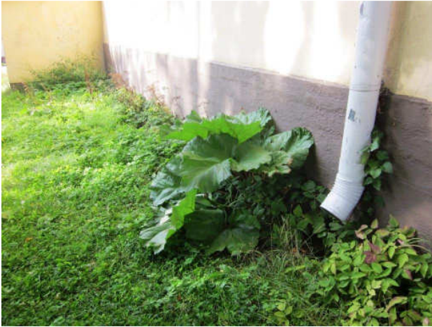
Kuva 34 Veden ohjaus puutteellinen
