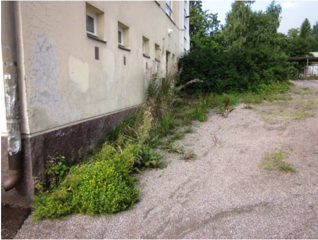
Kuva 1 Rakennuksen vierellä heinittynyttä soraa.
