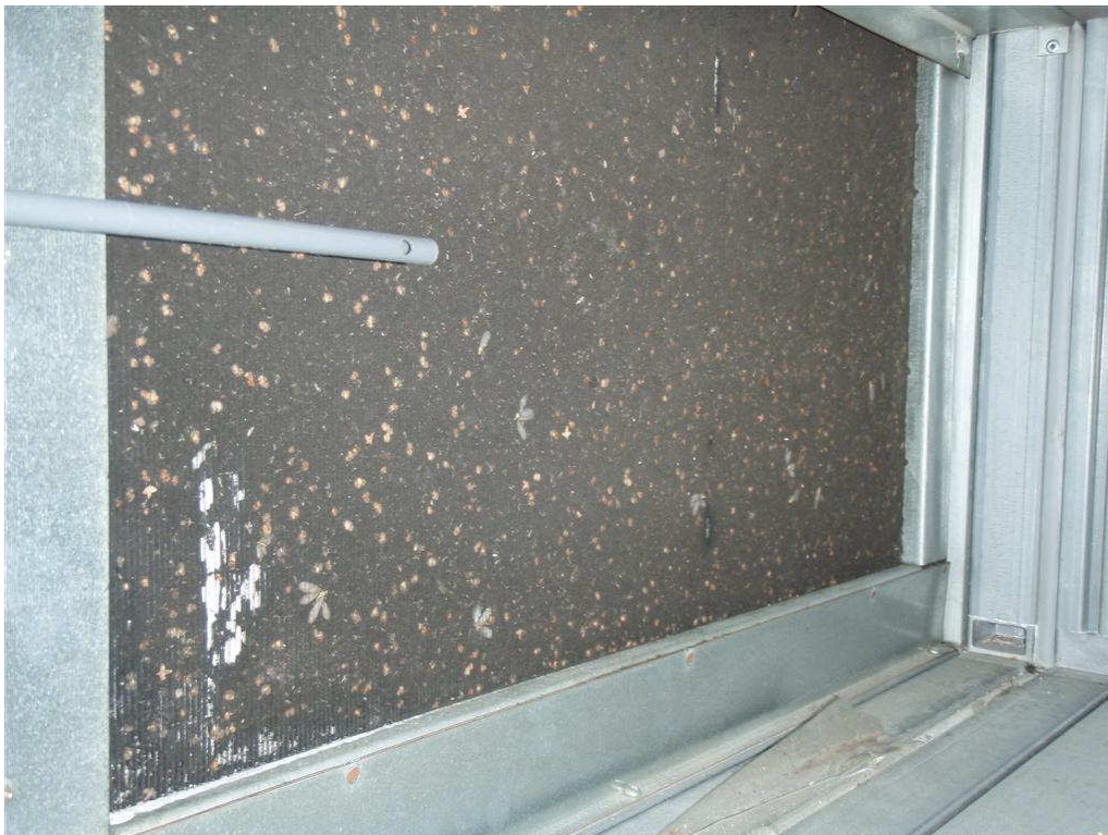
KUVA 2. Tuloilmakoneen TK11 TF01 likainen lämmityspatteri
