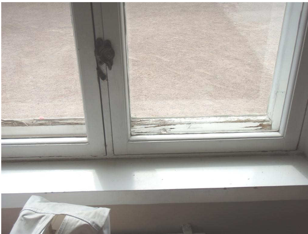
KUVA 4. Huone 1:krs OT 110 käsityöluokka, tilassa on kostevaurioita kärsineitä ikkunoita.
