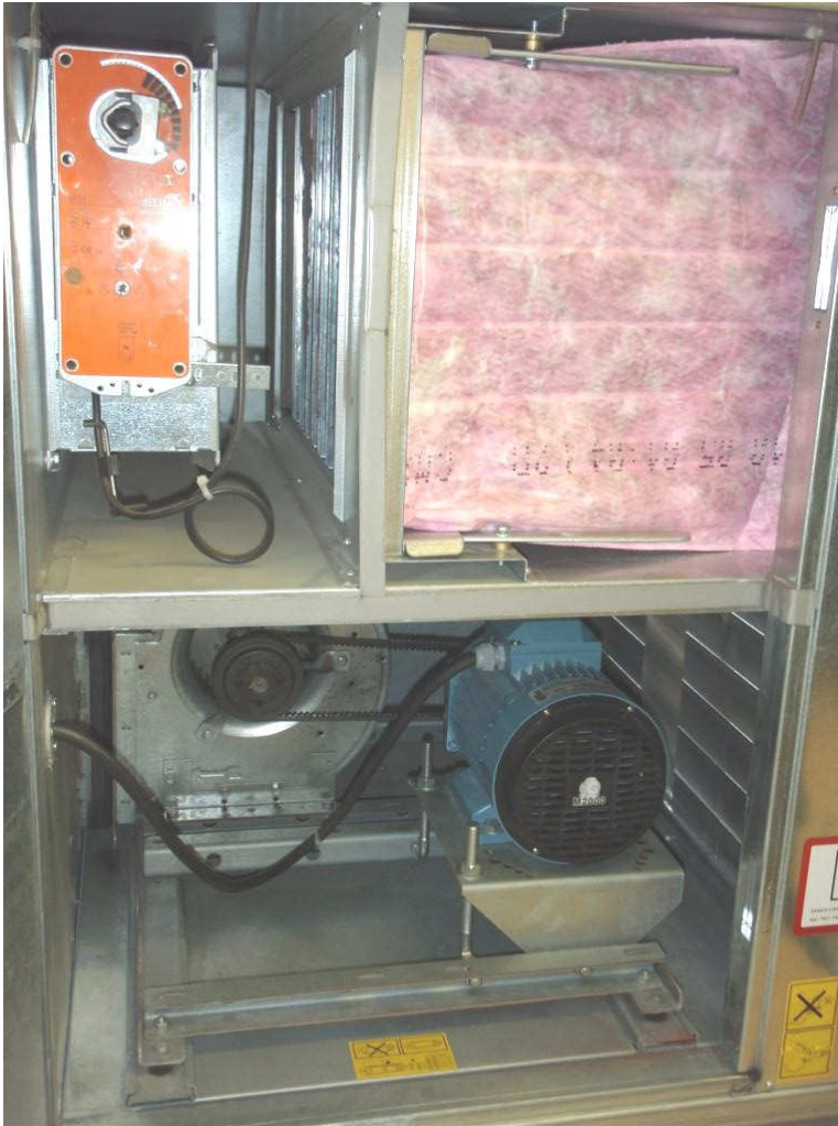
KUVA 1. Tuloilmakone TK11 TF01 (ääntää)
