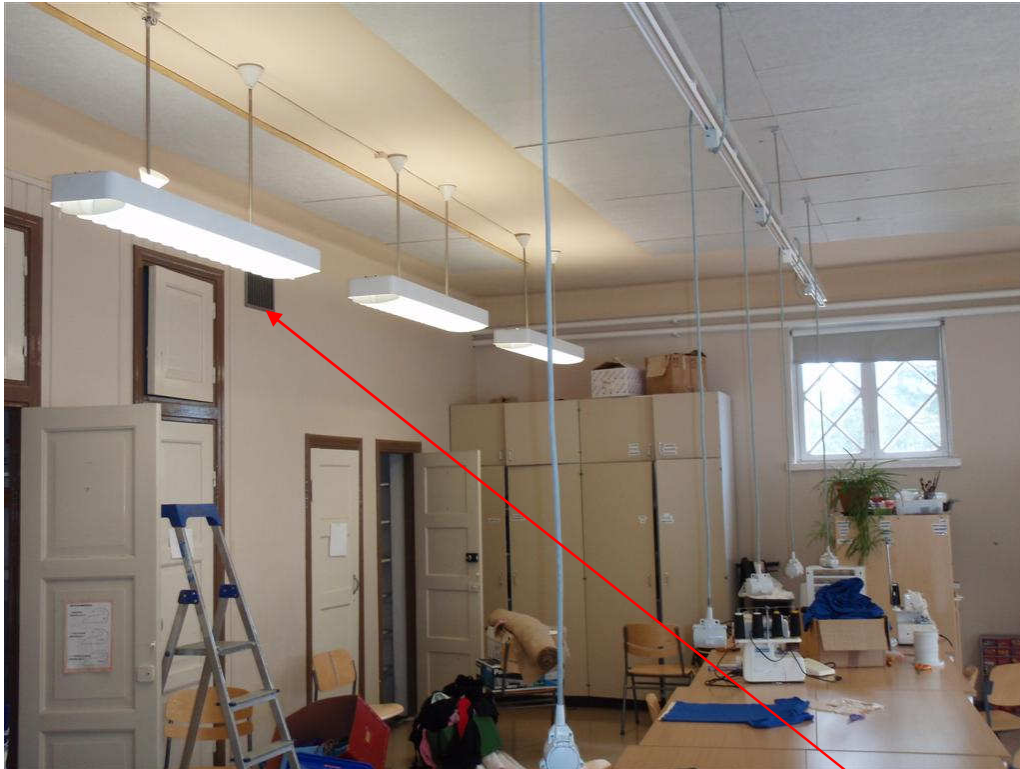
KUVA 3. Huone 1:krs OT 110 käsityöluokan ainut poistoilmasäleikkö
