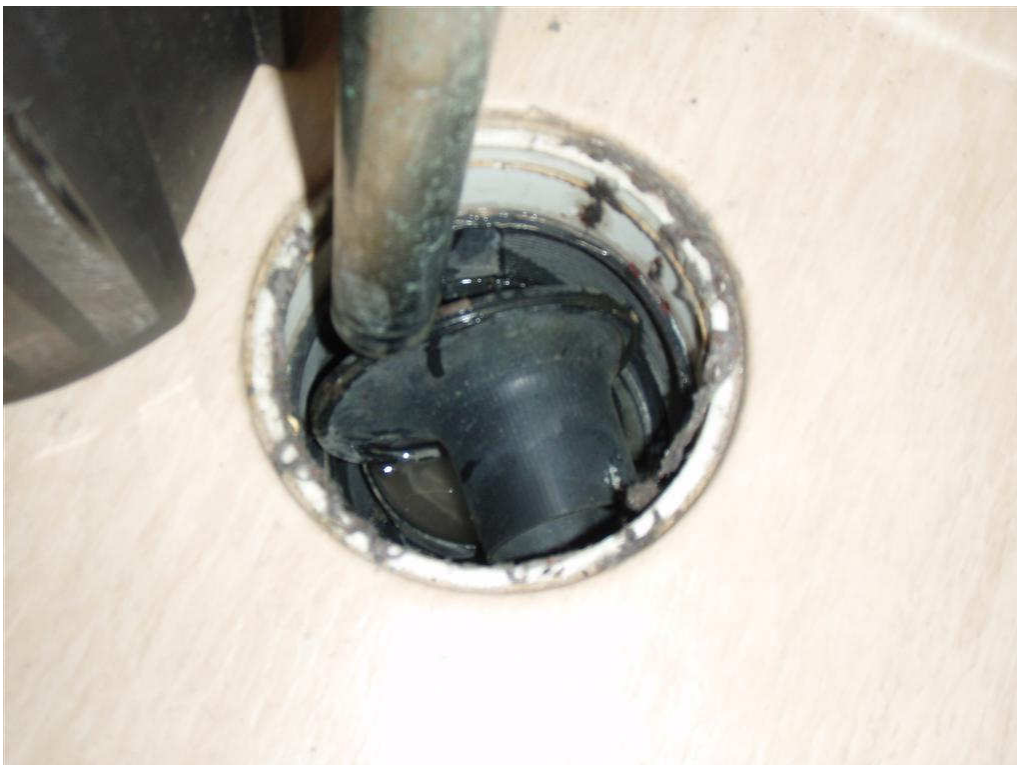
KUVA 8. Henkilökunnan Wc.no:208 2.krs. Lattiakaivon hajulukko osa pois paikoiltaan
