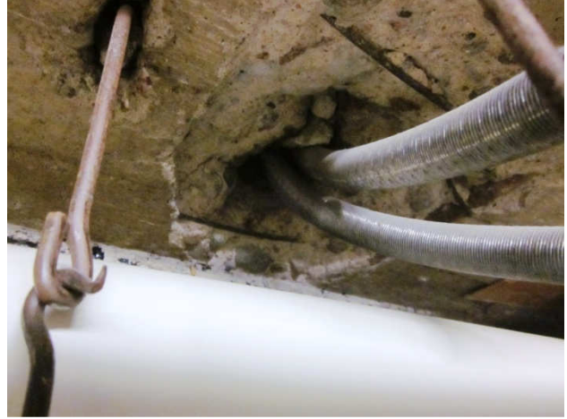
Kuva 6 Tiivistämätön sähkökaapeleiden läpivienti.
