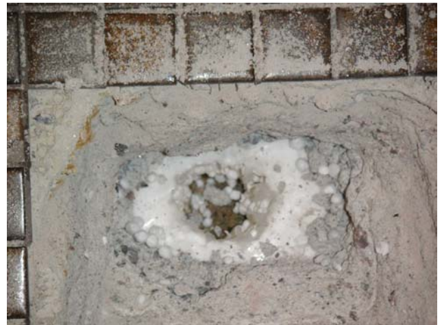
Kuva 5. Lattian rakenne, vesieriste näkyy ruskeana betonissa
