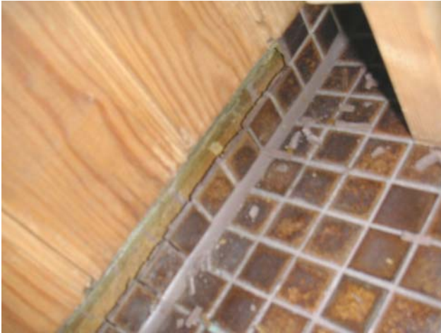
Kuva 1. Laatat irtoavat seinän alaosasta saunassa
