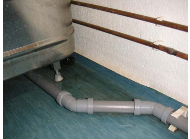
Kuva 4. WC:n tapetti irtoamassa
