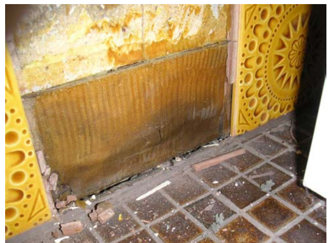
Kuva 6. Lastu- ja kovalevyn vaurioita ulkoseinässä, ei vesieristeitä
