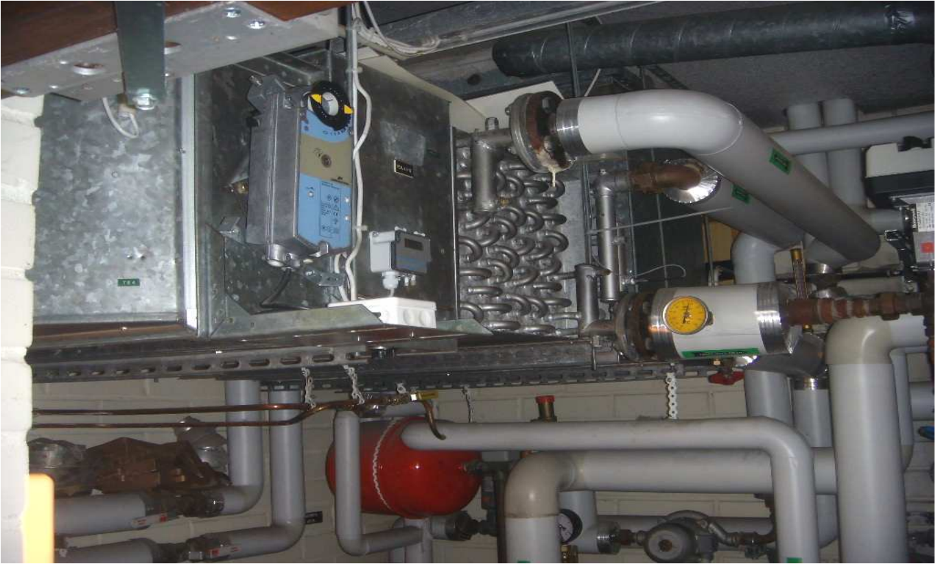
KUVA 1. Yleiskuva IV- konehuoneesta.
