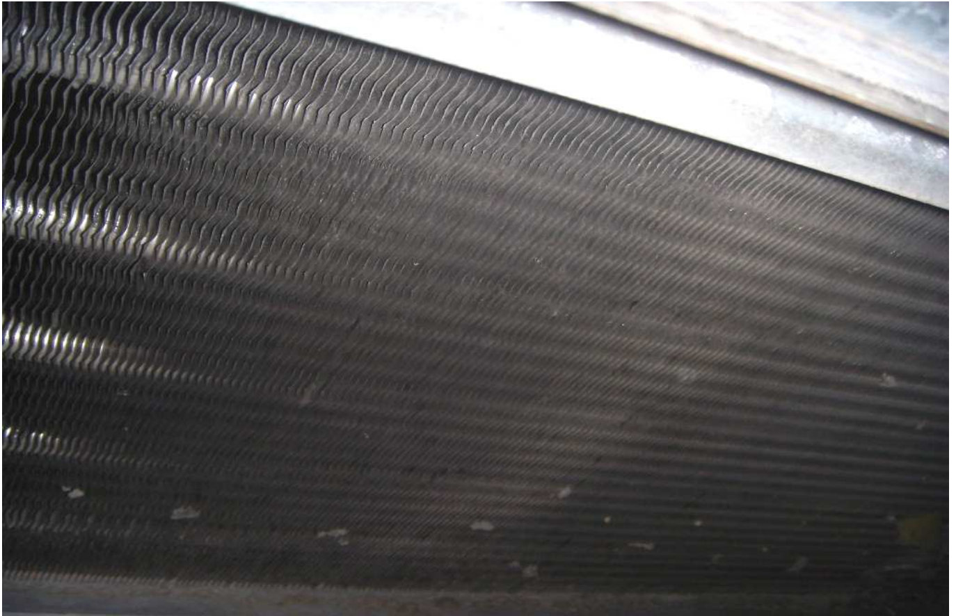
KUVA 5. LTO- patteri on pölyinen poistoilmakoneessa.
