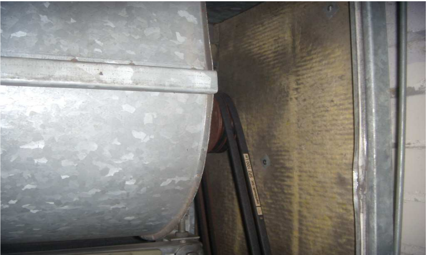
KUVA 4. Tuloilmakoneen kammiot ovat eristetty mineraalivillalla, kammiot ovat pölyiset.
