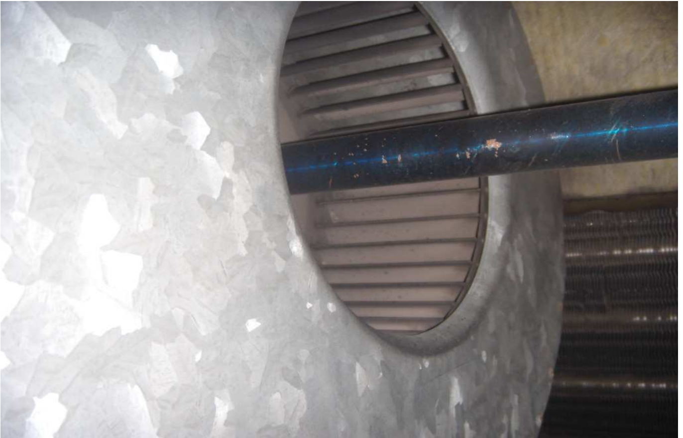
KUVA 3. Tuloilmapuhallin on pölyinen ja nokinen.
