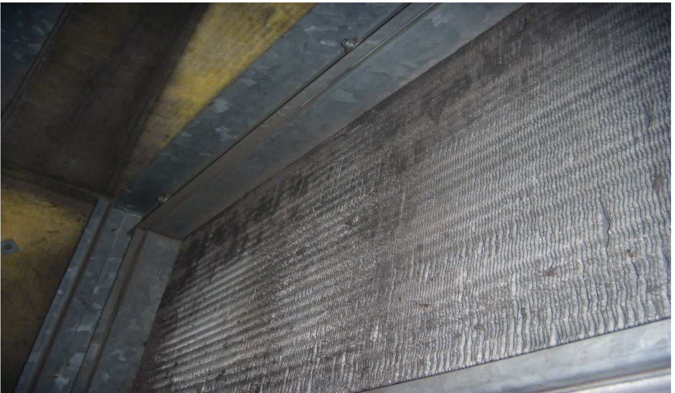
KUVA 2. LTO- ja lämmityspatterit ovat pölyiset ja roskaiset.
