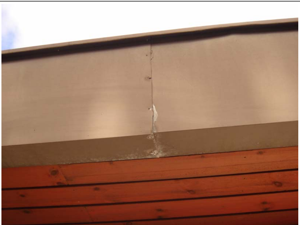
KUVA 110 Räystäskourut vuotavat ja maalit karisseet paikoin
