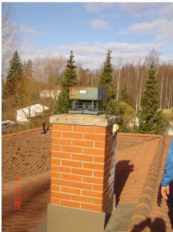
KUVA 304 Huippumurin turvakytkimeltä puuttuu lumilippa
