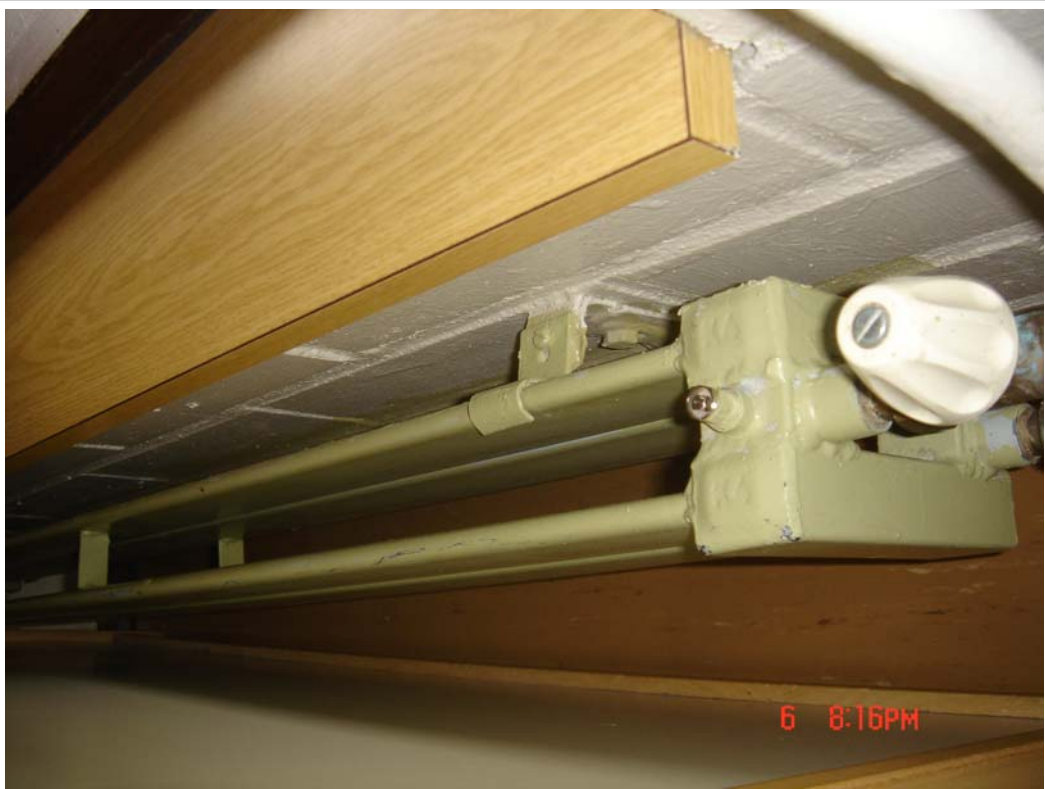
KUVA 203 Teräslevypatterit ja paikoin ilman termostaattia
