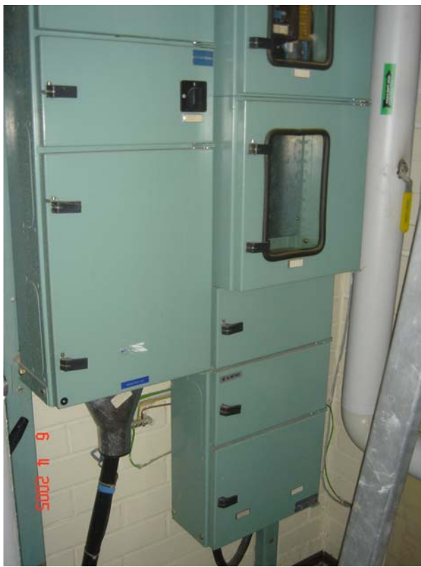
KUVA 301 Lämmönjakohuoneessa koteloitu pääkeskus
