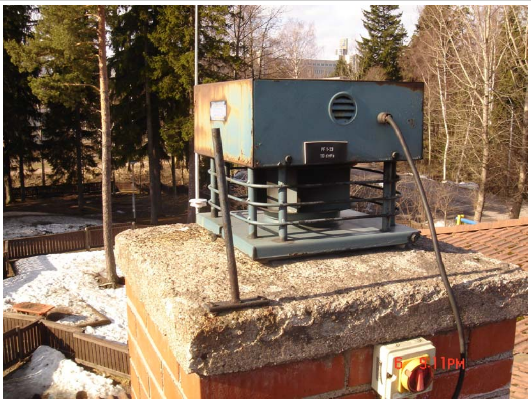
KUVA 205 Takkaimuri jo vähän ulkoisesti ruosteessa.
