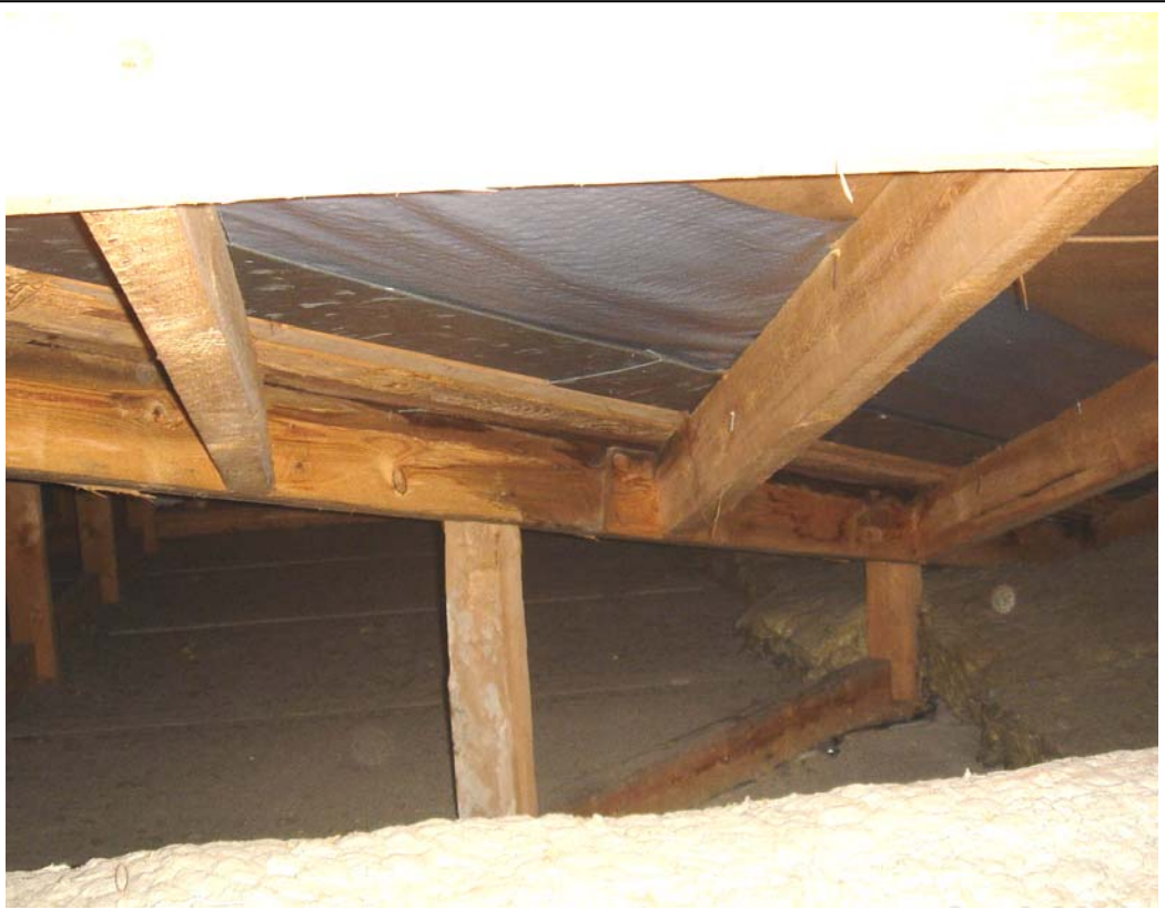
KUVA 109 Jiirin vuotokohta ja yläpohjan puurakenteita
