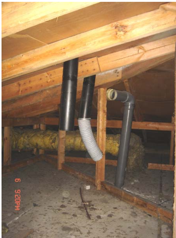
KUVA 204 Viemärin tuuletusputki on irti yläpohjassa
