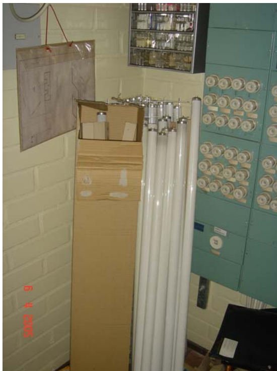
KUVA 302 Ryhmäkeskushuoneeseen on varastoitu sinne kuulumatonta tavaraa
