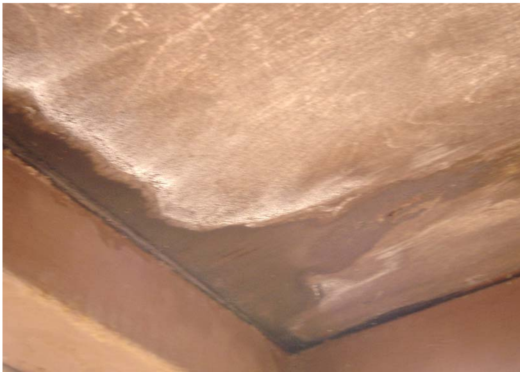
KUVA 108 Keittiön katoksen katto vuotaa
