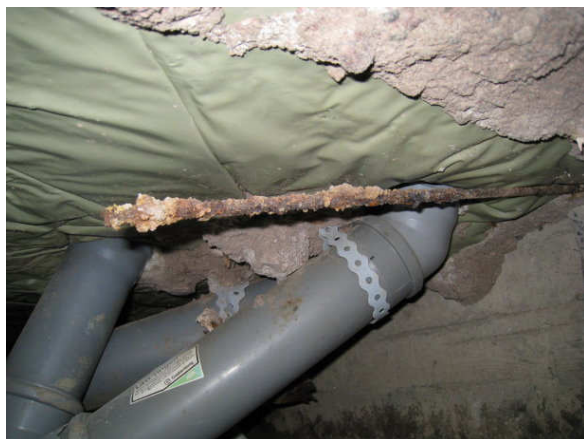
Kuva 11 Käytävän 007 alla olevia vanhoja viemärihaarotuksia. Teräs törröttää.
