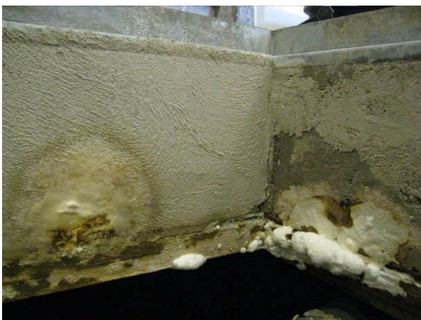
Kuva 23 B-osa/ Luukku B1 puinen muotti on purkamatta ja siinä on sienikasvustoa. Puu oli märkä.
