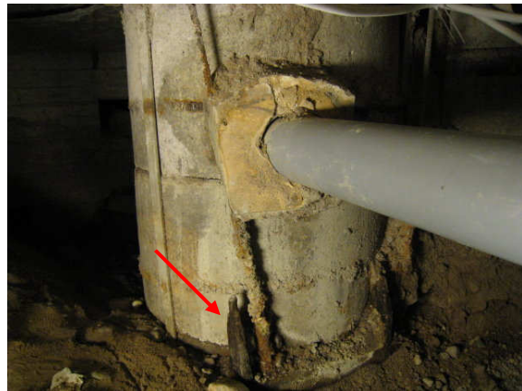
Kuva 4 Luukku A1 vieressä oleva betonikaivo, jonka juurella on lahoa puuta.
