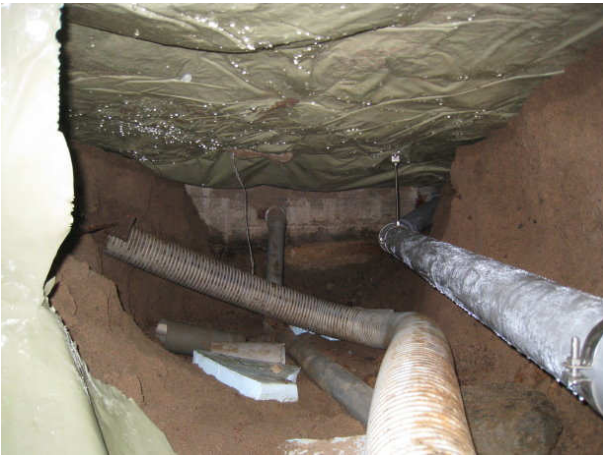
Kuva 21 A-osa/ Luukku A5 var. 009 vieressä kuva kohti vss/ pukuh 013, rojua, kondenssia sekä alkup. salaojaputki.
