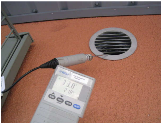
Kuva 39 B-osan alustatilasta tuleva poistoilma oli kosteaa, kun sulkupelti avattiin.
