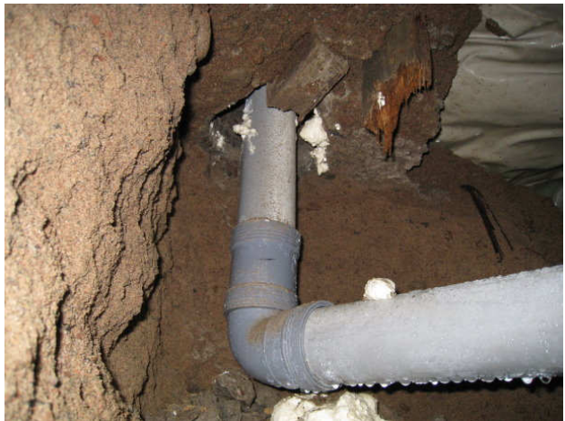
Kuva 28 B-osa/ Luukku B2 pesulan 049 alla tiivistämätön läpivienti ja lahoa puuta, kondenssia, viemäriä ei ole tuettu hyvin.
