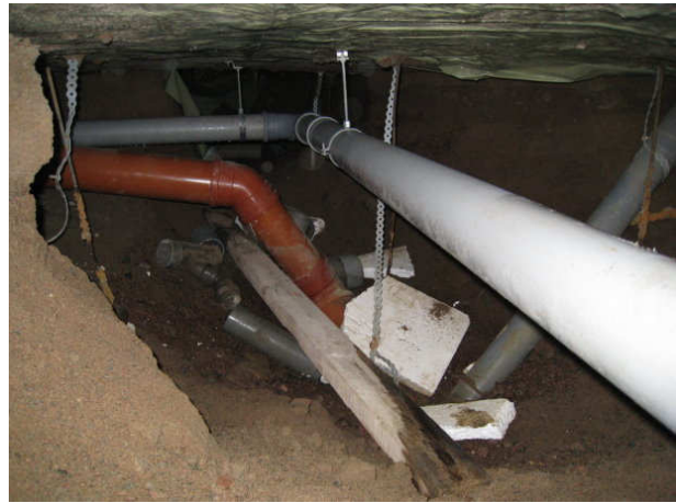
Kuva 20 A-osa/ Luukku A5, käytävän 007 alla varasto 009 vieressä. Puujätettä ja muuta roinaa, kondenssia pinoilla
