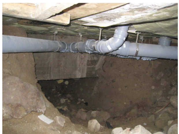
Kuva 30 B-osa/ LuukkuB3 pukuhuone M18 alla. Palkin ali on kaivanton, kondenssia viemäriputkissa, rakennusjätettä.
