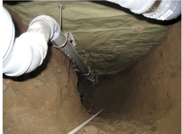
Kuva 32 B-osa/ Luukku B3 pukuh/ N 068 ja sh-wc -ryhmän alla, kondenssia. Kaivannoissa sortumariski, jos hiekka kuivuu.
