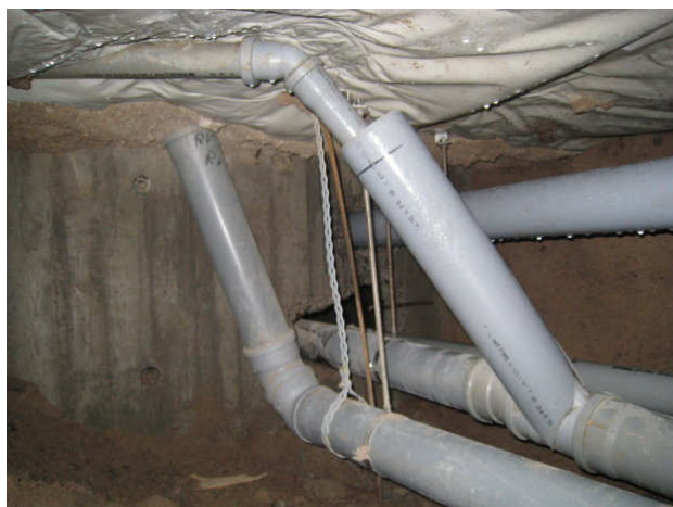
Kuva 29 B-osa/ Luukku B2, tavaravast.otto 056 alla kohti porrash 058, kondenssi. Epämääräinen viemäriiliitos
