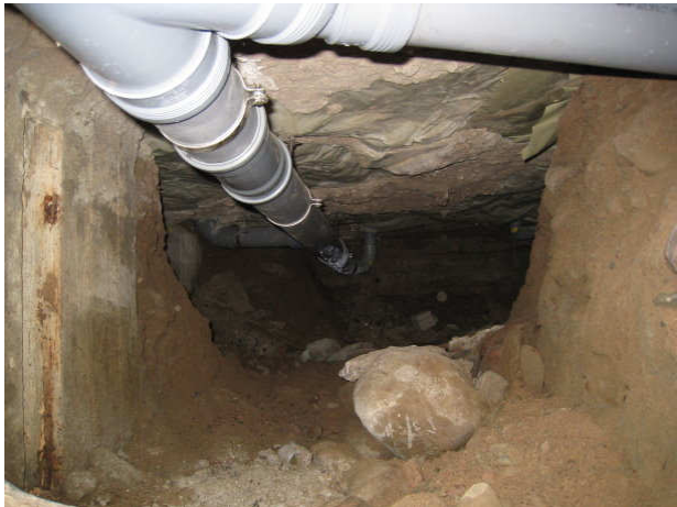
Kuva 15 A-osa/ Luukku A4 kahvion 033 alla, kuva kohti wc/N 030 alustatilaan. Täyttömaan kivi on sortunut, viemäriputkissa on pinnalla kondenssivettä. .
