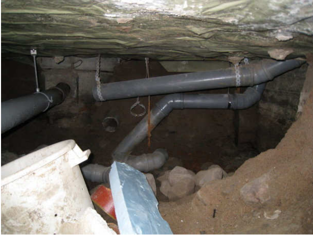
Kuva 19 A-osa/ Luukku A5 käytävän 007 alustila siiv.k 014 vieressä. Rakennusjätettä, ylimääräisiä viemäriosuoksia.
