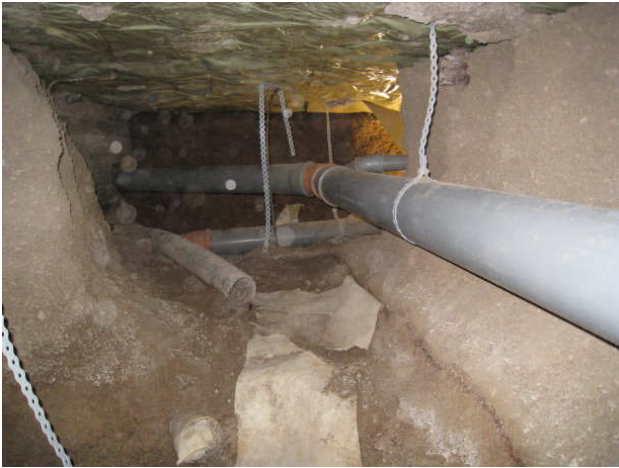
Kuva 13 A-osa/ Luukku 2, tilan 033 alla. Tältä kohdalta tuli viemärihajua. Hiekkaseinämät ovat jyrkkiä. On ylim. putkia.
