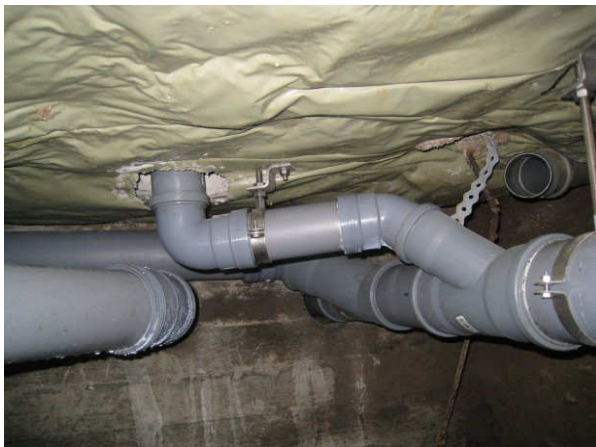
Kuva 35 B-osa/ Luukku B3 lähellä viemärihaaravaikuttaa padottavan hieman.
