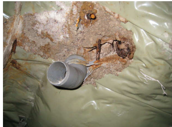
Kuva 34 B-osa/ Luukku B3 lähellä turha viemäriosa poistamatta ja alapäästä tiivistämättä, katossa teräviä teräksiä.
