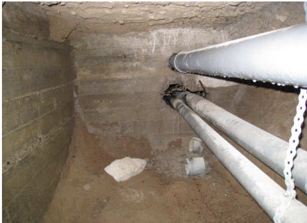
Kuva 22 B-osa/ Luukku B1 porrash 058 alla. viemäriputkissa on kondenssivettä. Pieni läpivientireikä tavarán vast.otto 056 alustatilaan.
