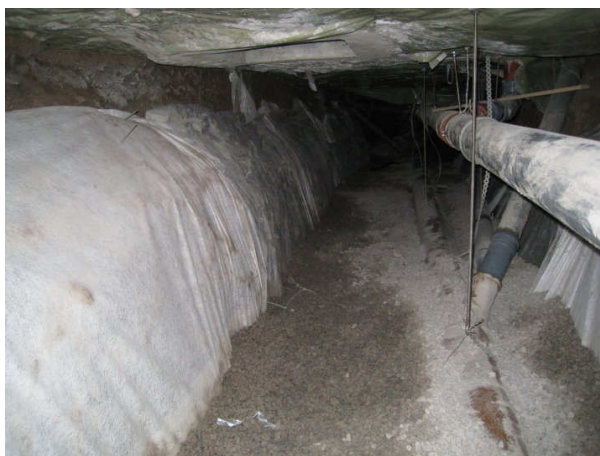
Kuva 5 Luukku A1 läheltä kuva käytävän 007 alle. Kaivanosassa on sepeli ja alla suodatinkangas. Sepeli on osin kostea.
