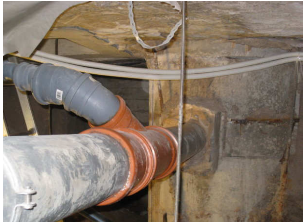
Kuva 12 Pohjaviemäriissä on vaakaosa/ notkelma lähellä Luokku A1 olevaa kaivoa.
