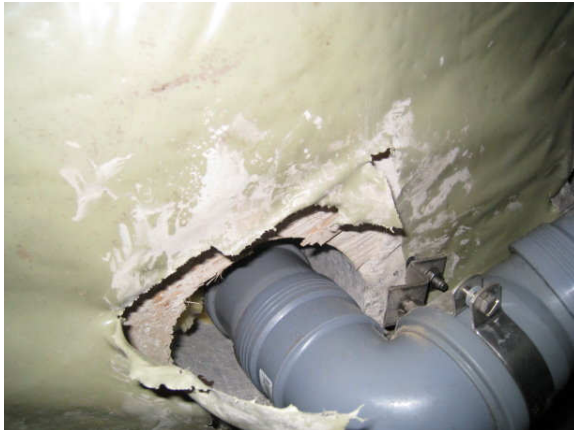
Kuva 33 B-osa/ Luukku B3 lähellä tiivistämätön läpivienti, jossa pohjalaatan reiän ylärajalla on lasivillaa.
