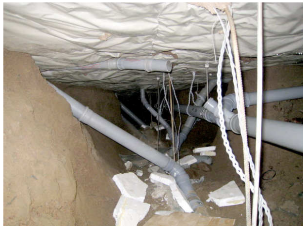
Kuva 24 B-osa/ Luukku A2 käytävällä 046 hilj. huone 044 vieressä. Rakennusjätettä, löysiä viemärikannatuksia, kosteaa.
