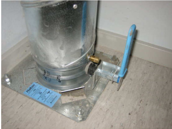
Kuva 37 B-osan alustatilasta tuleva poistoputki tilassa varasto 055, kahva oli painunut töytäisystä ja sulkenut ilmanpoistoton. Lisäksi kanavassa on palopelti. .
