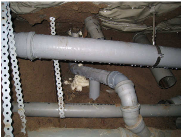
Kuva 27 B-osa/ Luukku B2 pesula 049 alla olevia viemäreitä. Ylimääräisiä viemäreitä, kondenssia, roinaa yms.
