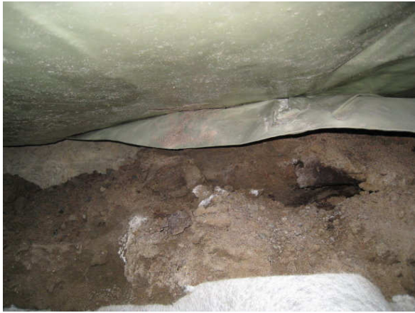
Kuva 7 Laatan alla on rakennusmuovi ja sen alla hiekkaa, mursketta ja seassa humusmaata. Maa on kostea.
