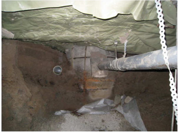
Kuva 8 Luokku A1 suunnasta kuvattu betoni-kaivo lähellä löylyhuone 016. Kaivon ohi tulee salaojaputki, ks. lisäksi kuva 19.
