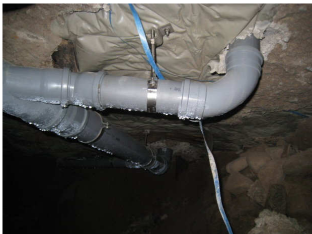
Kuva 18 A-osa/ Luukku A4, kuva kk 028 ja wc/M alustatilaan, jossa viemäriputkissa on kondenssivettä. Kaadot ovat väärin.
