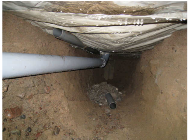
Kuva 26 B-osa/ Luukku B2 pesula 049 alta kuva käytäväseinän alustatilaan. Katossa ja lattialla ylim. viemäreitä, kondenssia.
