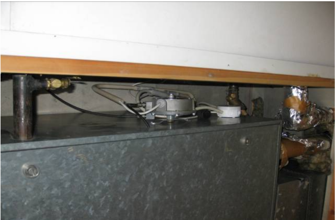
LVI-kuva 4. Yleiskuva tuloilmakoneesta.
