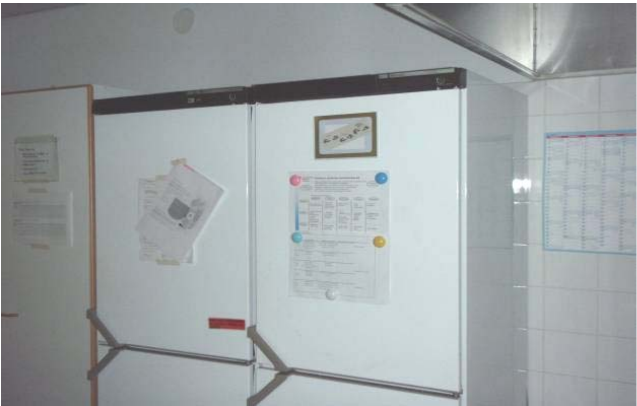
S-KUVA 10. Keittiön kylmälaitteet
