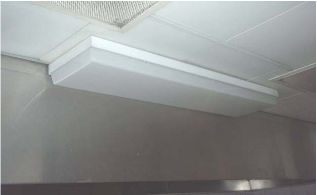
S-KUVA 8. Keittiön valaistus
