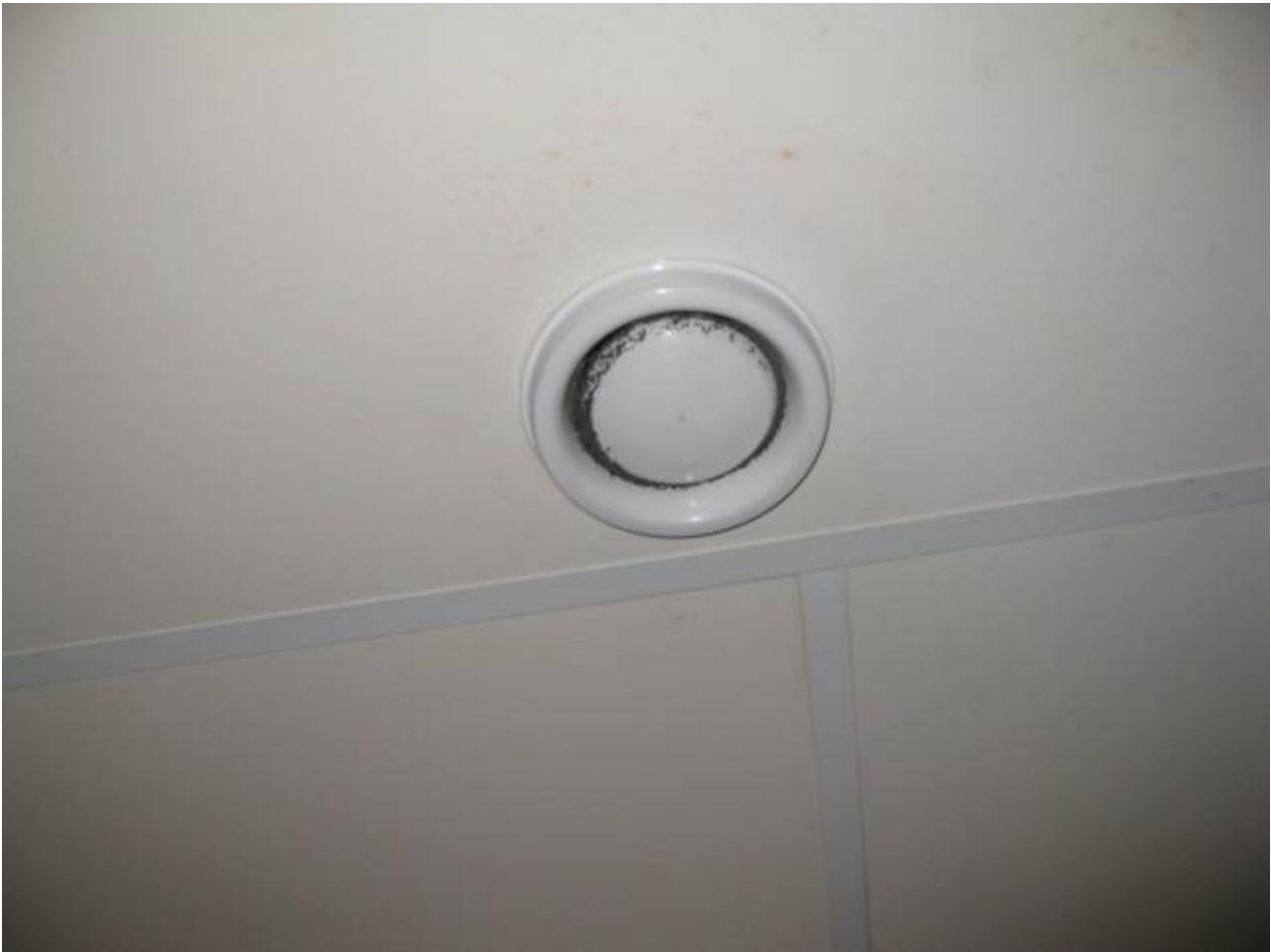
LVI-kuva 5. Pääte-elimet ovat paikoin likaisia.
