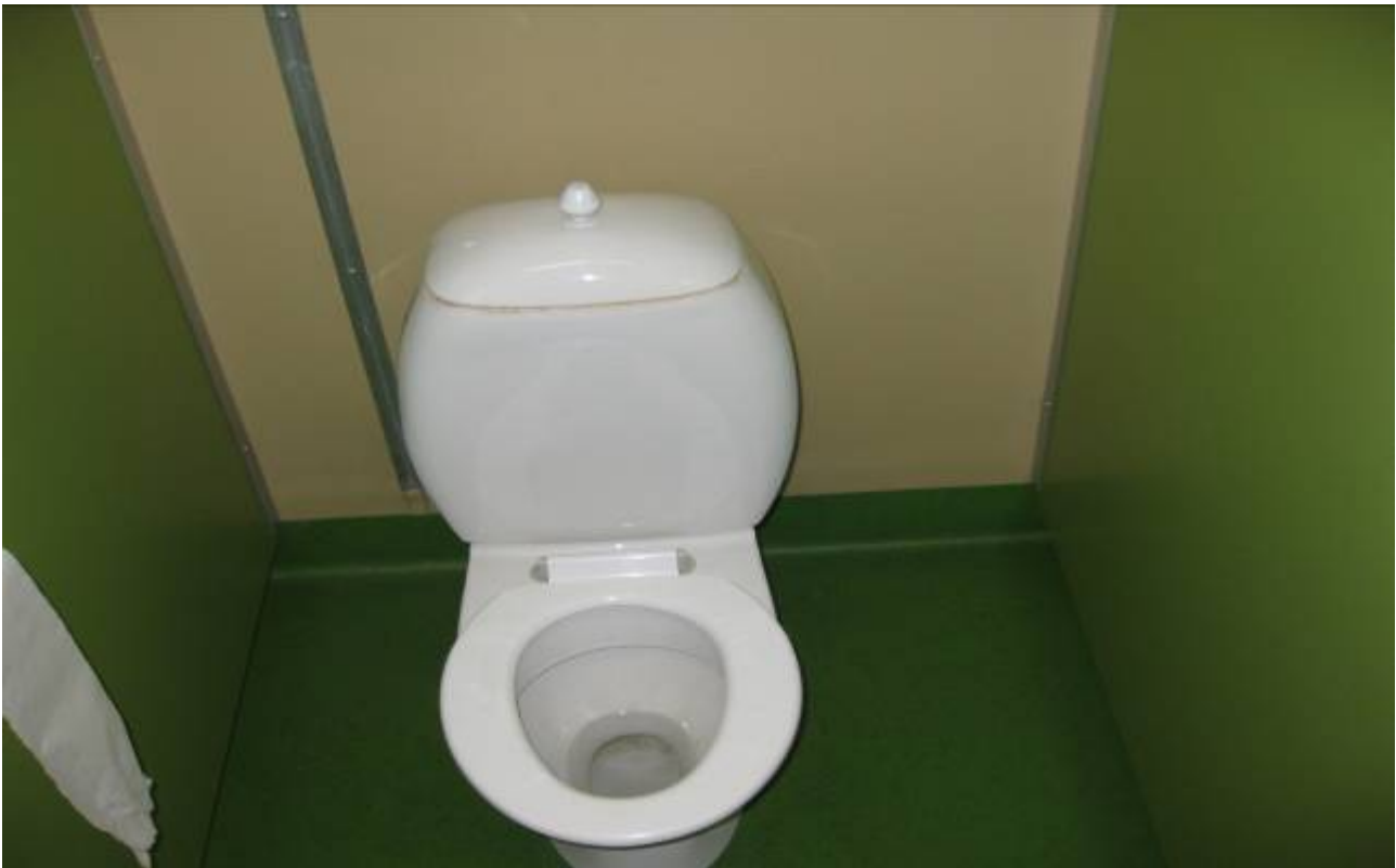
LVI-kuva 3. Yleiskuva wc-isutimista.
