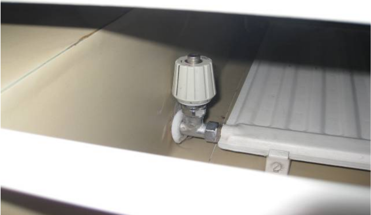
LVI-kuva 1. Alkuperäinen patteriventtiili.
