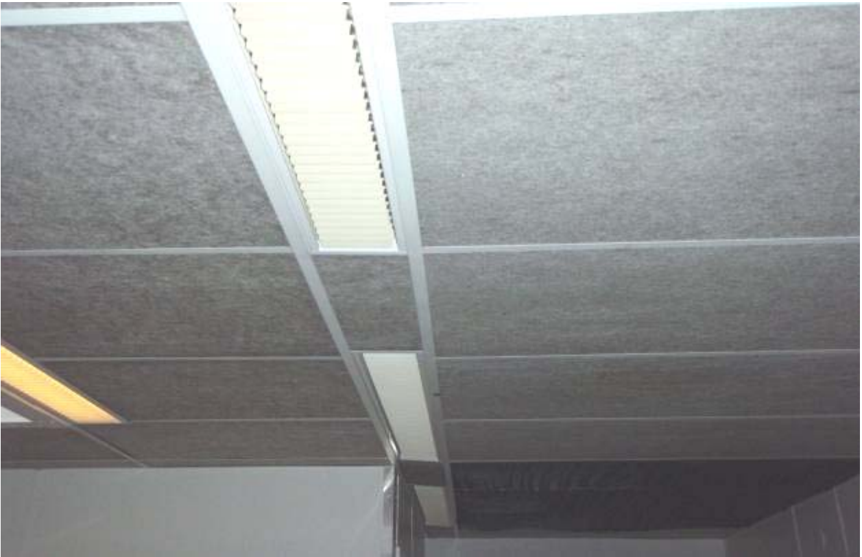
S-KUVA 5. Käytävän valaistus
