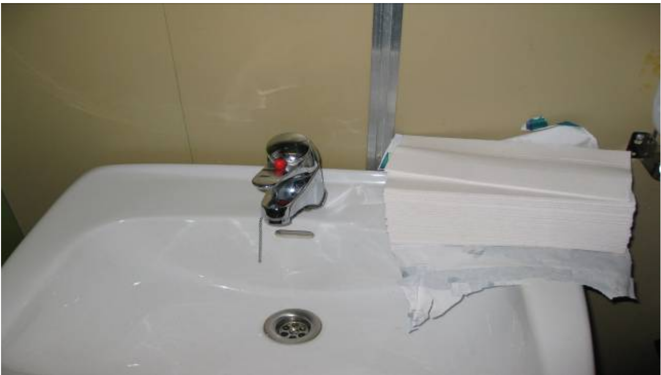
LVI-kuva 2. Yleiskuva vesikalusteista.
