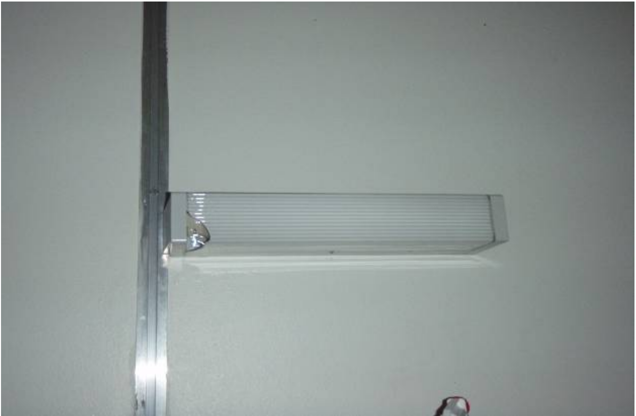
S-KUVA 7. WC- tilojen valaistus, valaisimen kupu on rikki
