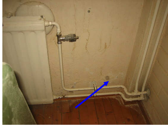
Kuva 16 Konehuoneen 114 kohdalla ulkoseinän alaosan pintakosteus on normaalia korkeampi.
