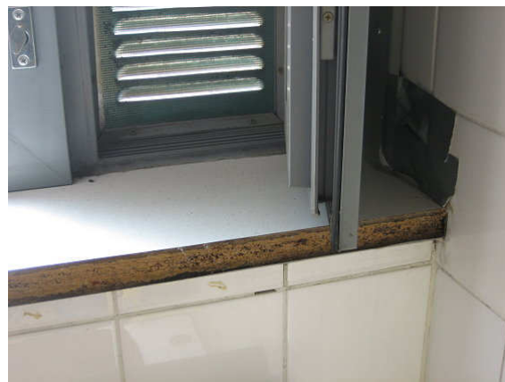
Kuva 2 Keittiön sos.tilan ikkunalauta on kosteus- ja mikrobivaurioitunut.
