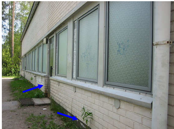
Kuva 14 Julkisivutiilimuuraukset ovat monin paikoin kastuneet. Sokkelirakenteissa on kalkkisaostumia.
