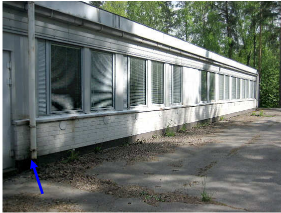
Kuva 17 Konehuoneen 114 kohdalta ulkoseinää. Kosteusvaurioituneella kohdalla on syöksytorvi.
