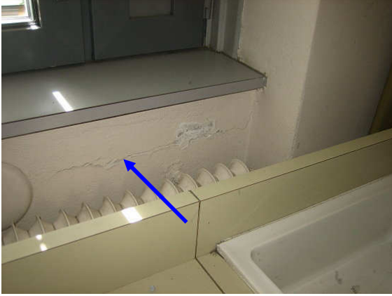
Kuva 9 Betonirakenteessa on halkeama ja vanha kosteusjälki.
