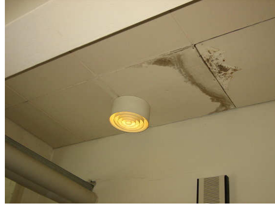
Kuva 4 B-osan hallin 149 katossa on kosteus- ja mikrobivaurio.
