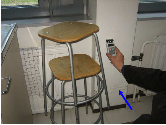
Kuva 3 Opetuskeittiön 104 ulkoseinän teräsbetonipilareissa on kosteusvaurioita.
