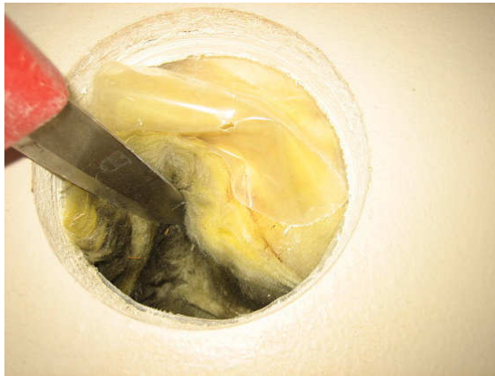
Kuva 6 Em. kohdalla on lastulevyn alla kipsilevy + muovi. Syvemmillä on tummunutta mineraalivillaaeristettä.
