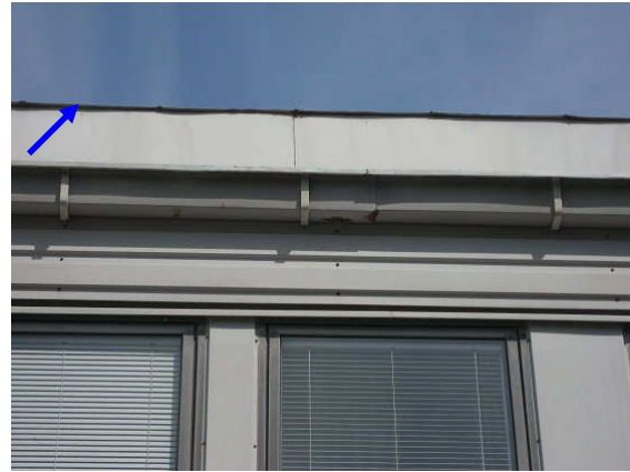
Kuva 18 Konesaumattun peltikatteen ja otsapellitöksen väli vaikutti epätiiviyiltä.
