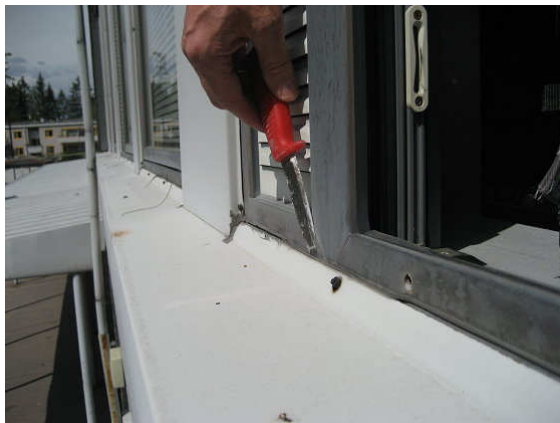
Kuva 8 Vesipellin ja ikkunan välissä on rakoja, joista sadevesi pääsee rakenteen sisään.
