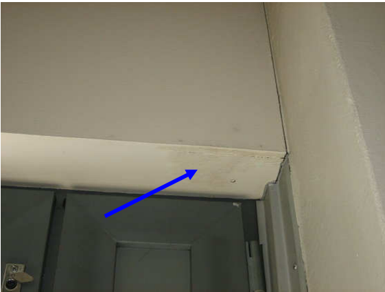
Kuva 5 C-osan 2.kerroksen luokahuoneessa 210 on ulkoseinän levyrakenteisessa kotelossa kosteusvaurio.
