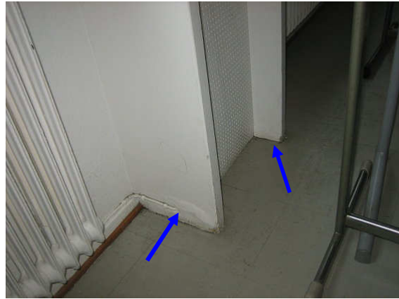
Kuva 12 Teräsbetonipilarin sivuilla olevien lastulevyjen alaosat ovat kosteusvaurioituneet.
