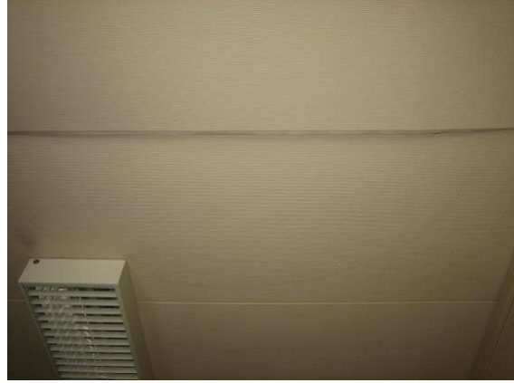
Kuva 10 Vanha heikosti havaittava ympyrän muotoinen kosteusjälki kattoverhouslevyssä tilassa 212.
