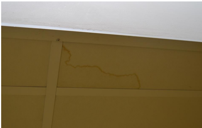
Kuva 1. Käytävän 106 kattoikkunan reunasta on päässyt vesi kastelemaan alapuolisia rakenteita.
