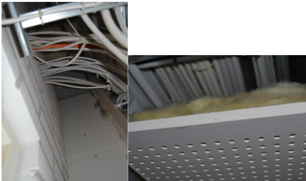
Kuva 7. Erityisopettajan tilan viereisen sähkökaapin sähköjohdot oli vedetty käytävän alaslasketun katon yläpuolelle. Alaslasketun katon yläpuolella oli avointa mineraalivillaa, mikä suositellaan poistettavan.
