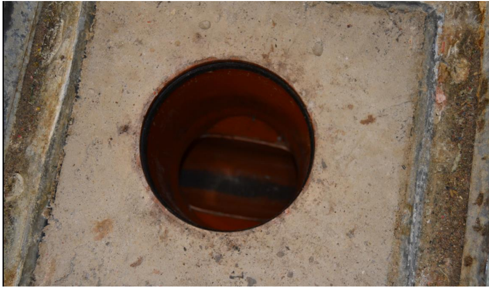
Kuva 4. Vegan luokassa 153 oli luukku lattiassa. Luukku avattiin ja havaittiin todennäköisesti viemäriputken tarkastusluukku. Kun tila alipaineistettiin, tarkastusluukusta tuli luokkatilaan voimakas viemärinhaju. Normaali ilmanvaihdon toimintatilassa luukusta ei havaittu ilmavirtausta luokkatilaan päin, eikä poikkeavaa hajua.
