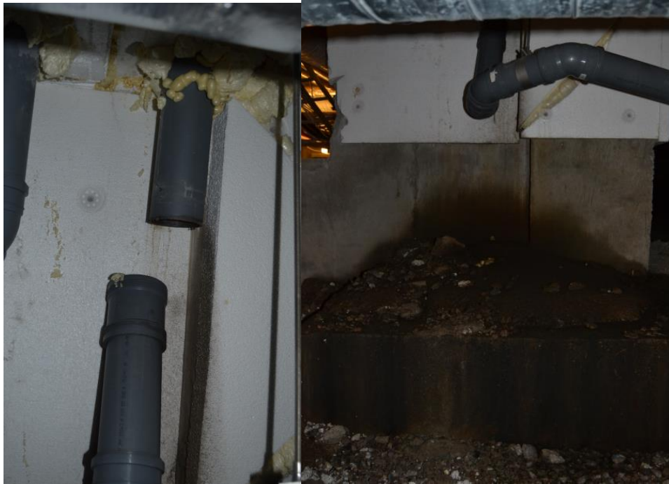
Kuva 9. Ryömintätilassa havaittiin avoin viemäriiitos, josta jätteet olivat pääseet suoraan ryömintätilaan. Kiinteistöhoitaja tilasi välittömästi loka-auton puhdistamaan kohdan sekä paikkaamaan putken.
