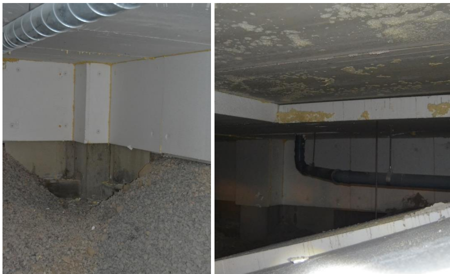
Kuva 10. Muualla ryömintätila oli siisti, soraa on riittävästi, eikä tilassa havaittu kosteuden aiheuttamia jälkiä. Ontelolaattavälipohja on eristetty alapuolelta EPS-levyillä. Muutama levy oli pudonnut pois paikoiltaan. Suositellaan eristelevyjen kiinnittämistä paikoilleen.
