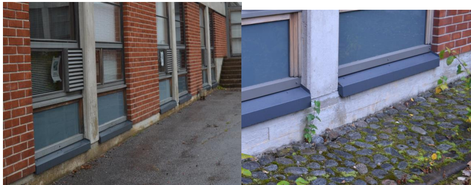
Kuva 5. Vegan kantava alapohjalaatan yläpinta on paikoin lähellä ulkopuolisen maanpinnan tasoa. Sokkelin vierustat ovat siistit asfaltti tai sorapintaiset, sisäpihoilla mukulakivipintaiset. Luokissa ei havaittu kohonneita kosteuspitoisuuksia lattiapinnoitteen alapuolella.
