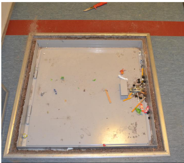
Kuva 8. Luukku ryömintätilaan oli musiikkiluokan ulkopuolella käytävällä. Ryömintätilan luukun kautta havaittiin ilmavirtaus huonetilaan päin (paine-ero 10 Pa). Luukku tulee tiivistää ilmatiiviiksi. Ryömintätilan ilmanvaihto suositellaan tasapainotettavan siten, että tila on alipaineinen yläpuolisiin huonetiloihin nähden.
