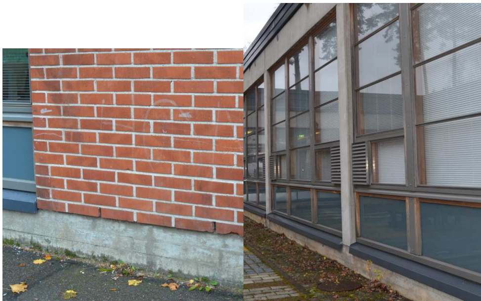
Kuva 2. Merkkikaasu laskettiin Vegan ulkoseinän eristetilaan tiilivuorauksen tuuletusaukkojen kautta luokissa 101, 130, 171 sekä liikuntasalissa. Sisäpihalle rajoittuvissa luokissa 153, 208 ja 211 merkkikaasu laskettiin ikkunapellitusten alle.
