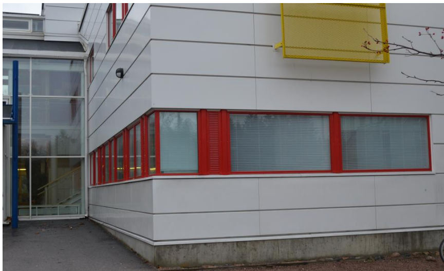
Kuva 6. Lyyran musiikkiluokan ulkoseinärakenteessa havaittiin merkittäviä ilmavuotoja
