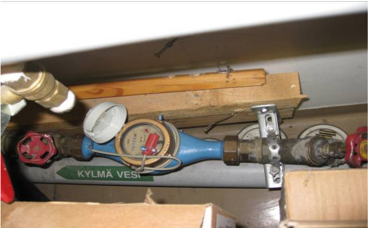
LVI-kuva 2. Yleiskuva vesimittarista ja pääsuluista.
