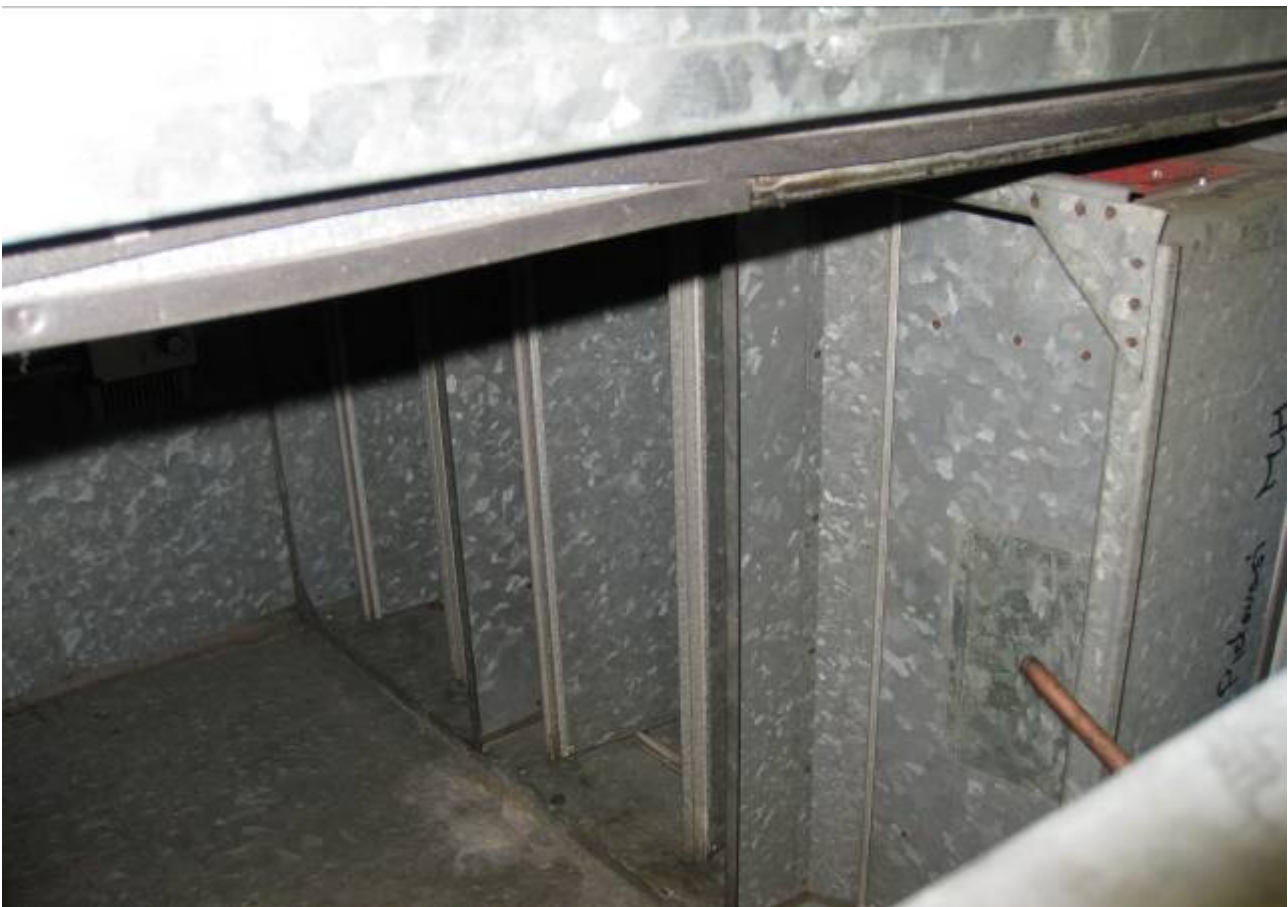
LVI-kuva 5. Ilmastointikone on huollettu ja puhdas.
