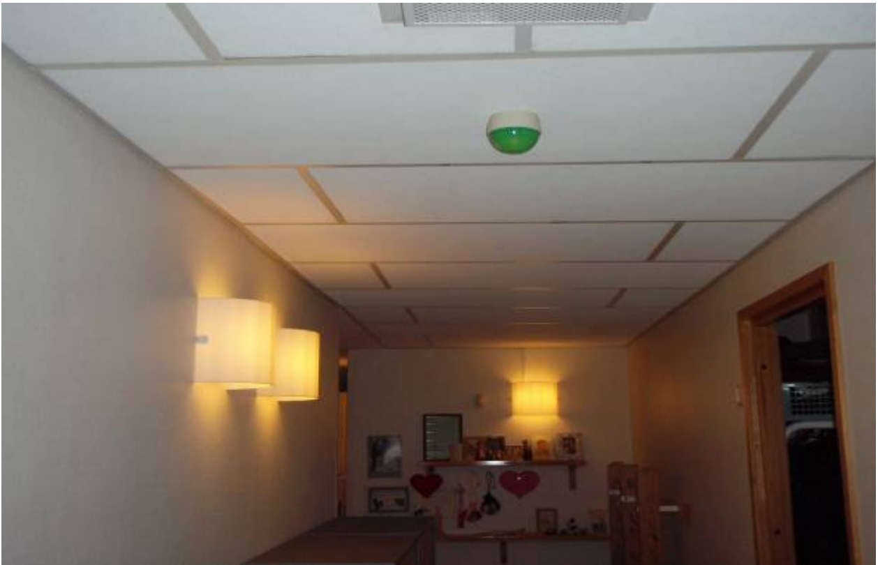
S-KUVA 5. Käytävän valaistus
