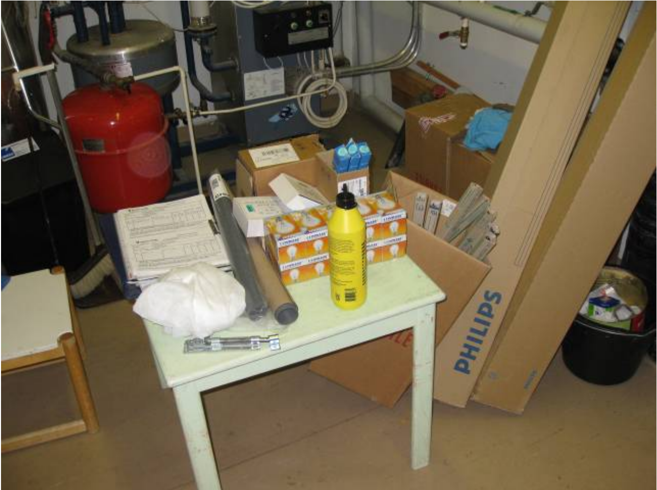
LVI-kuva 1. Yleiskuva lämmönjakuhuoneesta.
