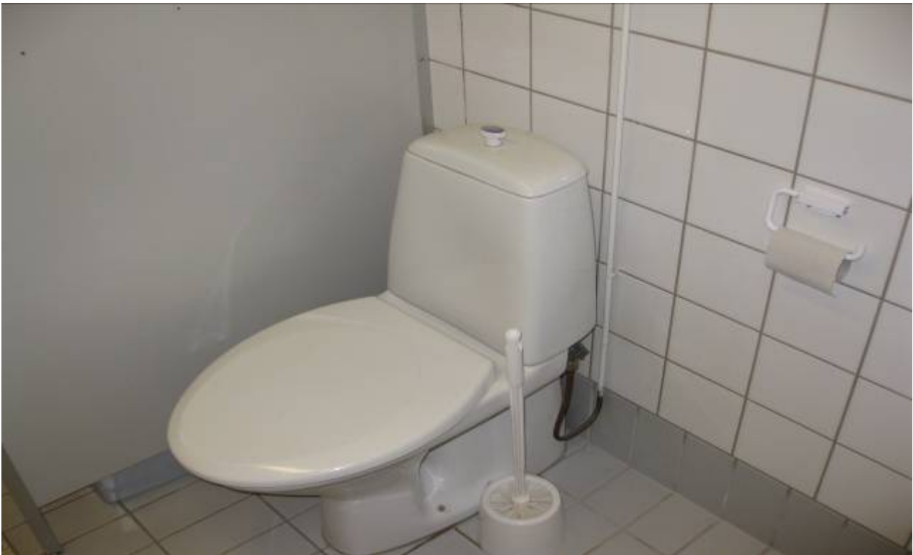
LVI-kuva 4. Yleiskuva vesikalusteista.
