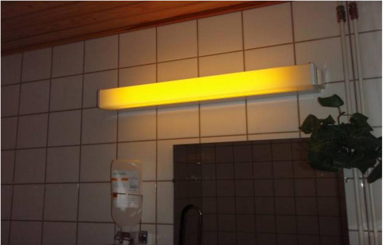
S-KUVA 7. WC- tilojen valaistus
