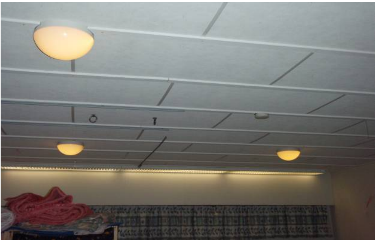
S-KUVA 4. Huoneiden valaisimet
