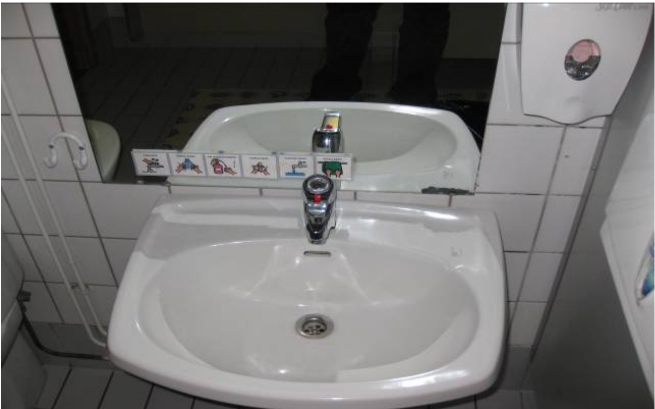
LVI-kuva 3. Yleiskuva vesikalusteista.
