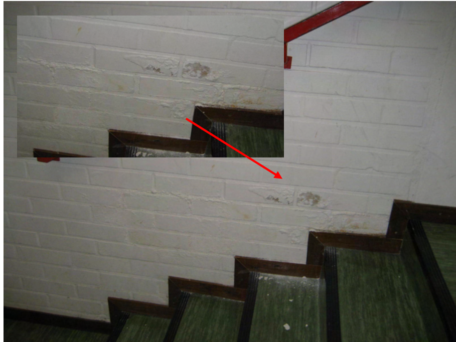
Kuva 60. Liikuntasalista kahvioon johtavien portaiden kohdalla oleva kosteusvaurio.
