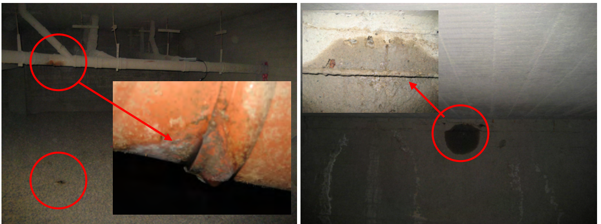
Kuvat 30 ja 31. Vasemmalla kuva viemäriputken liitoksen vuotokohdasta alustatilassa 5. Oikealla kuva saman alustatilan ulkoseinän yläosan selvästi muuta aluetta kosteammasta kohdasta.
