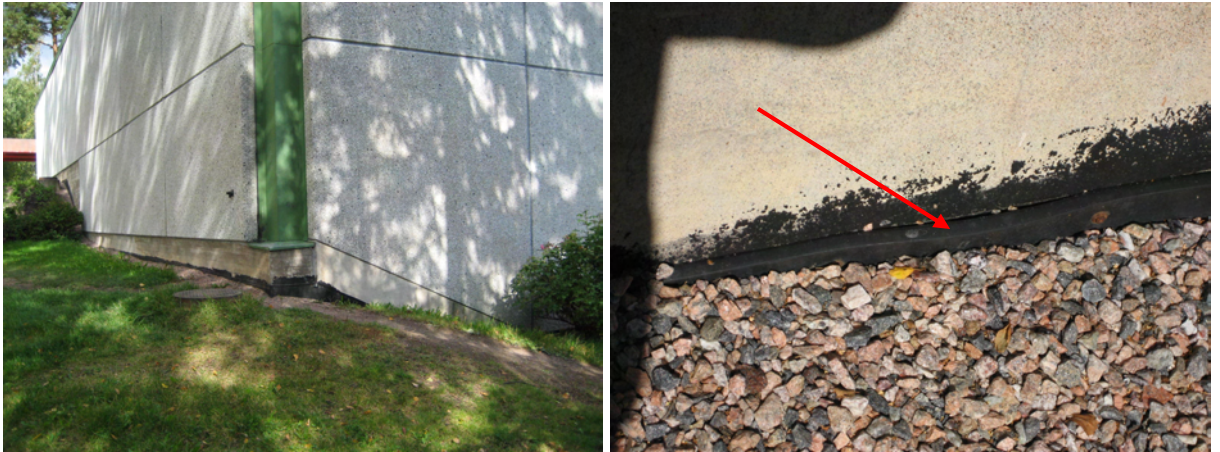
Kuvat 61 ja 62. Vasemmalla kuva maanvastaisen seinän ulkopuolisesta vedeneristeestä Auditorion kohdalla ja oikealla vedeneristeen ja seinään väliin jäävästä raosta.
