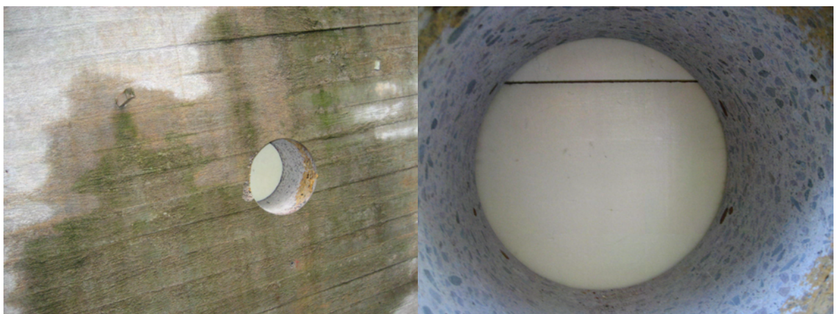
Kuvat 70 ja 71. Kuvat tilan Ma2 ulkoseinään ulkopuolelta tehdystä reiästä. Oikeanpuoleisessa kuvassa näkyvän polyuretaanilevyn edessä oli toinen, reikään mahtuva, noin 50 mm paksuinen polyuretaanilevy.
