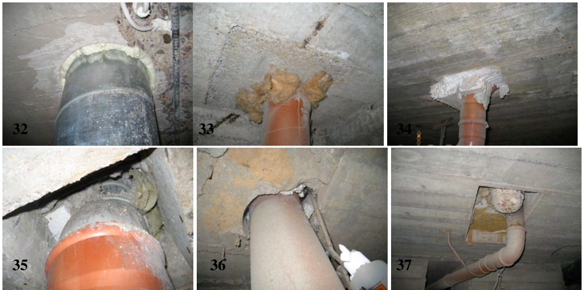
Kuvat 32–37. Alustatilojen läpivienneistä otettuja kuvia. Ylhäällä vasemmalla on alustatilan 1, ylhäällä keskellä ja oikealla sekä alhaalla vasemmalla on alustatilan 2 ja alhaalla keskellä ja oikealla on alustatilan 5 läpivienneistä otettuja kuvia.
