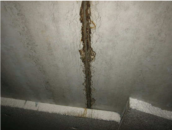
Kuva 15 A-osalla ontelolaattojen välissä on tummaa valumajälkeä.
