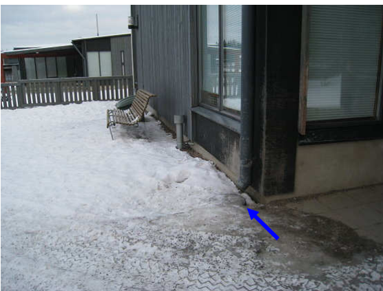
Kuva 17 B-osan lounaan puoleisen sisäänkäynnin viereinen sadevesikaivo oli jäässä
