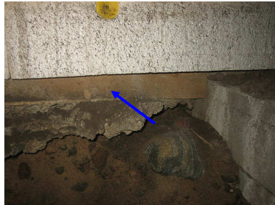
Kuva 12 B-osalla havaittiin lisäksi muottina käytettyä puukuitulevyä.
