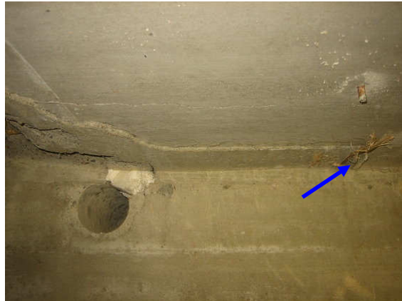
Kuva 4 Betonipinnoilla on jonkin verran puunsäilää.
