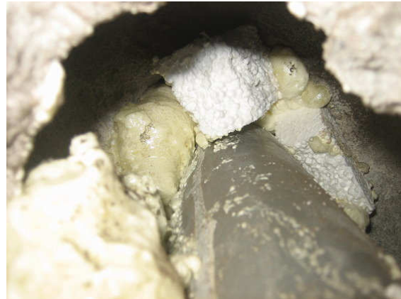
Kuva 16 Tyypillinen viemärin läpivienti.
