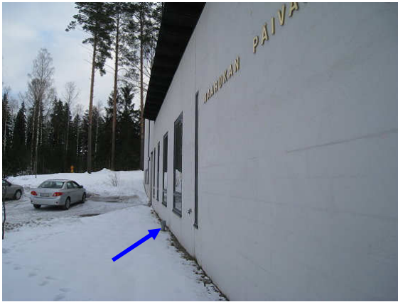
Kuva 19 Pohjoisen puoleisella sivustalla olevat tuuletusputket eivät ulotu riittävän ylös.
