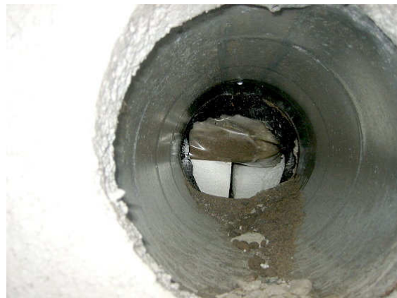
Kuva 6 B-osan terassin puoleisen sivustan tukossa oleva tuuletusreitti.
