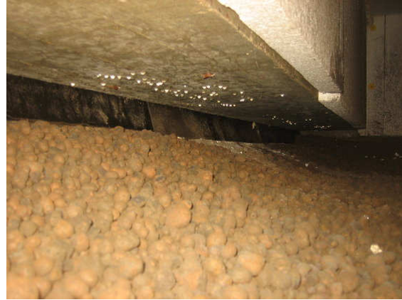
Kuva 14 Sokkelipalkin alapinnassa helmeilee vesipisaroita. Taustalla bitumihuopaa. Vastatäyttö puuttuu.
