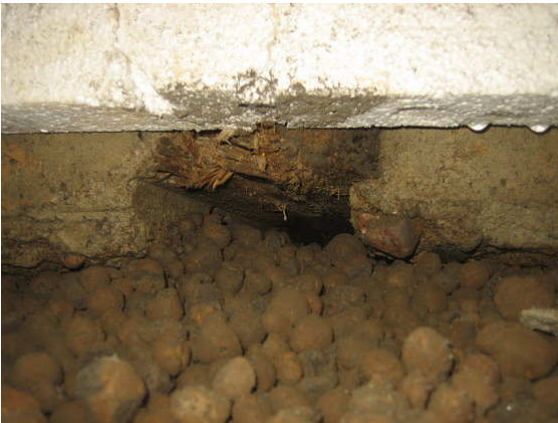
Kuva 11 Valumuottien alasidepuut on jätetty paikoilleen ja päät ovat mikrobivaurioituneet. Polystyreenilevyn ja betonin välissä vesipisaroita. Kastelee täyttökerrosta.
