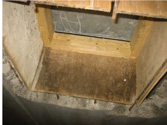
Kuva 2 Sisäänkäyntiluukkujen kehysvanerien pinnoissa on paikoin mikrobikasvustoon viittaavaa kasvustoa.
