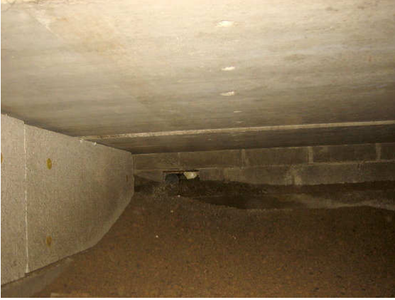
Kuva 7 B-osan liikuntasalin viereinen kulmaus. Pinta kostea.
