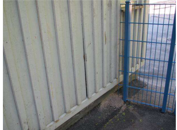
Paikoin julkisivuverhoiluissa rimojen irtoamista ja maalipintojen kulumaa
