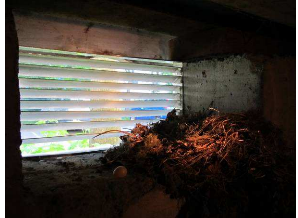
Linnunpesä alapohjatilassa ritilän vieressä, lintu pääsee alapohjatilaan ritilän yläpuolelta
