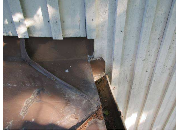
Puutteita julkisivun ja katteen liittymäkohdassa
