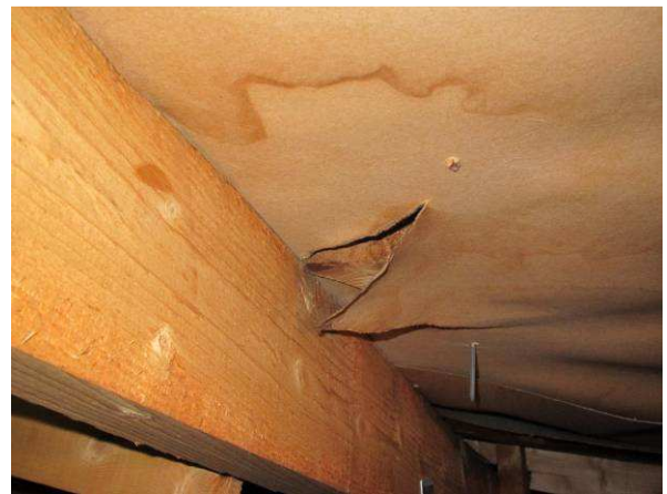
Aluskate rikki ja kosteusjälkiä aluskatteessa
