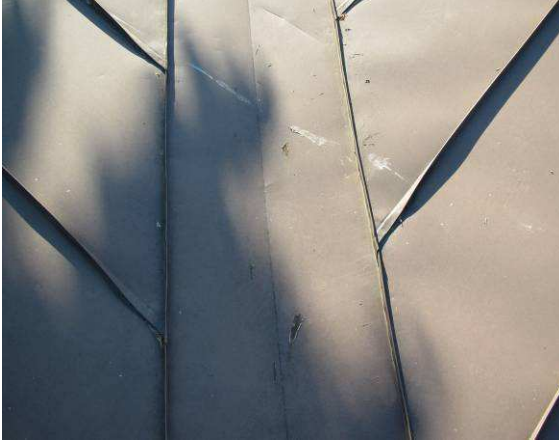
Jiirissä todennäköisesti lumenpudotuksen aiheuttamia kolhuja
