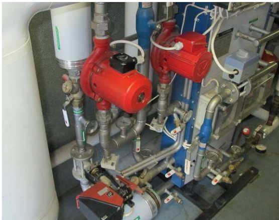
Siirripaketin pumppuja ja säätölaitteita on jo uusittu tarpeen mukaan.
