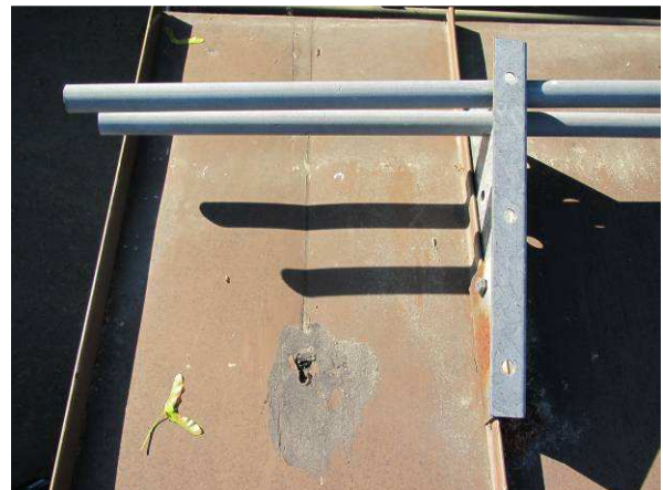
Vanha lumieseen kiinnitysreikä avoinna katteessa
