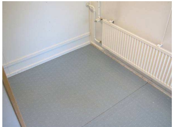
Patteriventtiilit ovat alkuperäisiä vuodelta 1989.
