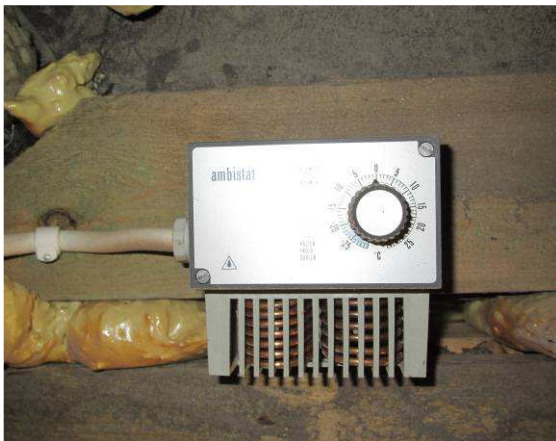
Alapohjan tuuletusta ohjaa termostaatti.
