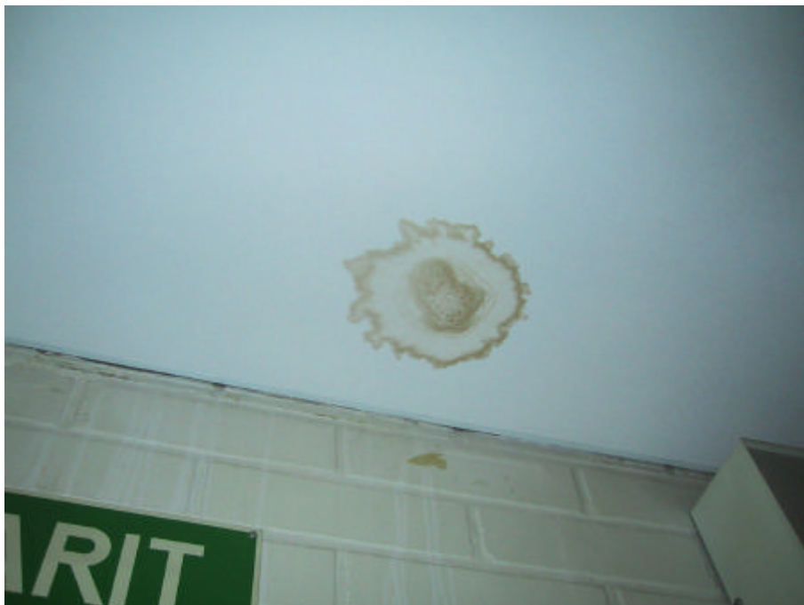
Kuva 3 Tuore kosteusjälki alakaton Akusto-villalevyssä.
