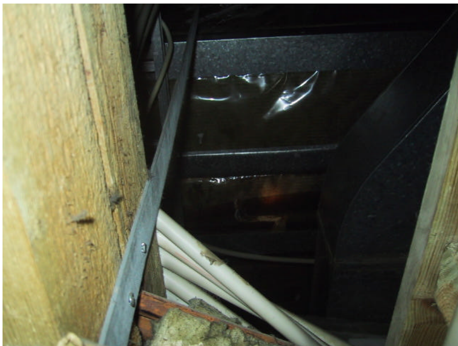
Kuva 5 Vesipussi junarataa ja laituritasoja kannattavaan betonirakenteeseen liittyvässä muovikelmussa.
