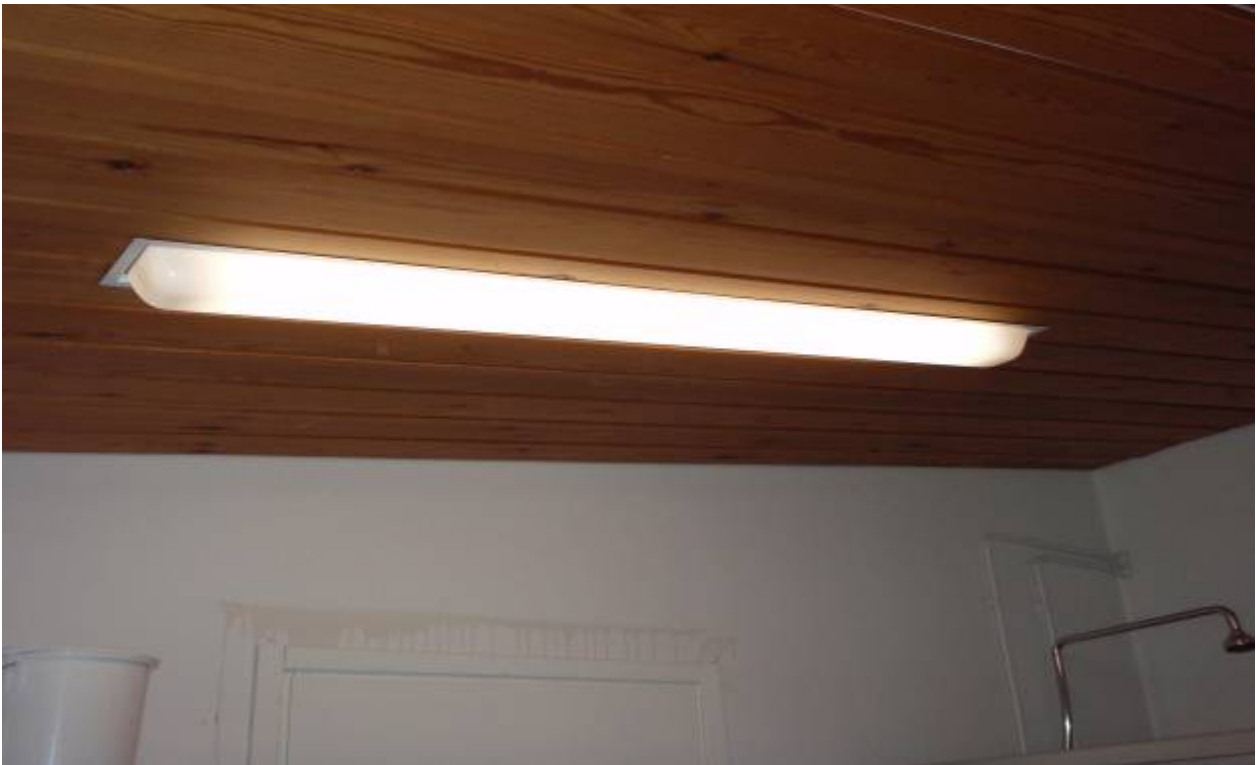
S-KUVA 9. WC- tilojen valaistus
