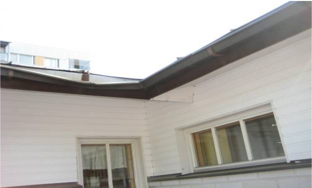
RAK-KUVA 11. Räystäskoururakenteissa esiintyy kunnostustarvetta.
