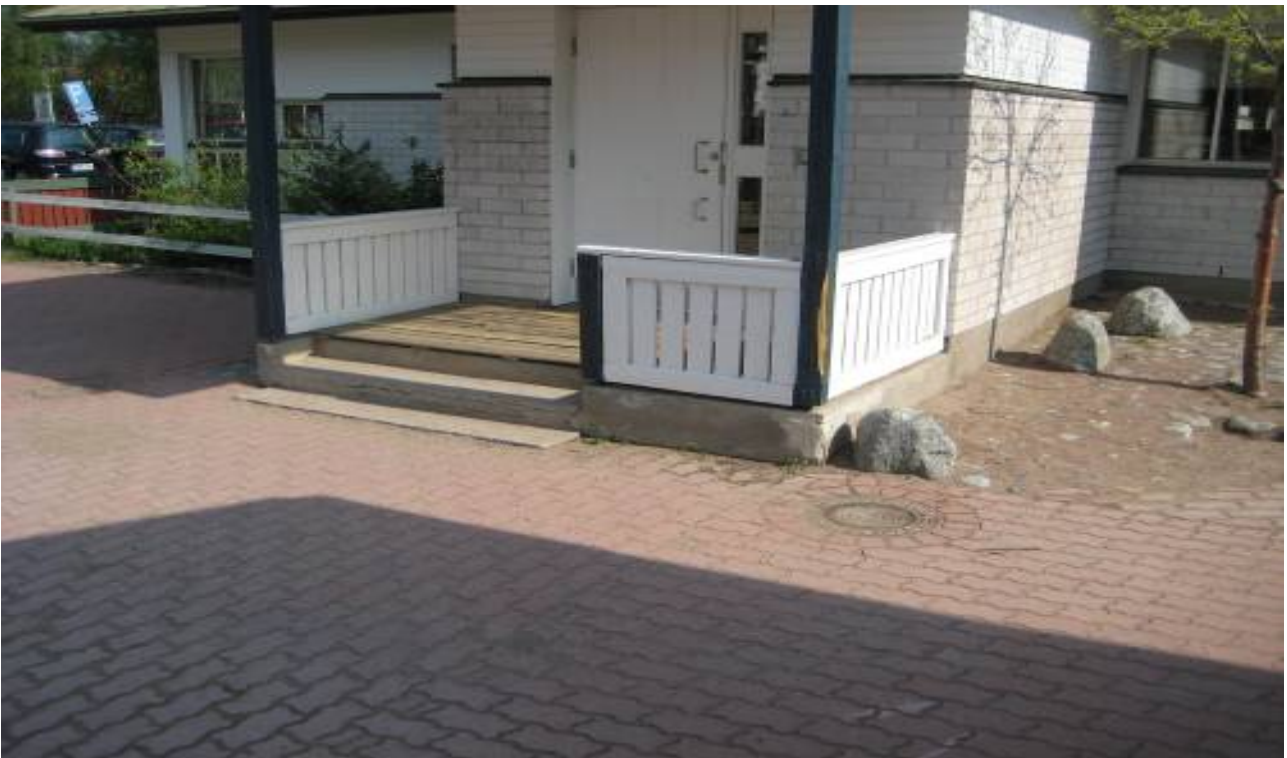
RAK-KUVA 8. Ulko-ovien sisääntulokatosten puuosissa esiintyy vaurioita. Kunnostustöiden suorittaminen julkisivujen huoltokäsittelyn yhteydessä (julkisivupinnat joita ei ole kunnostettu lähivuosina).
