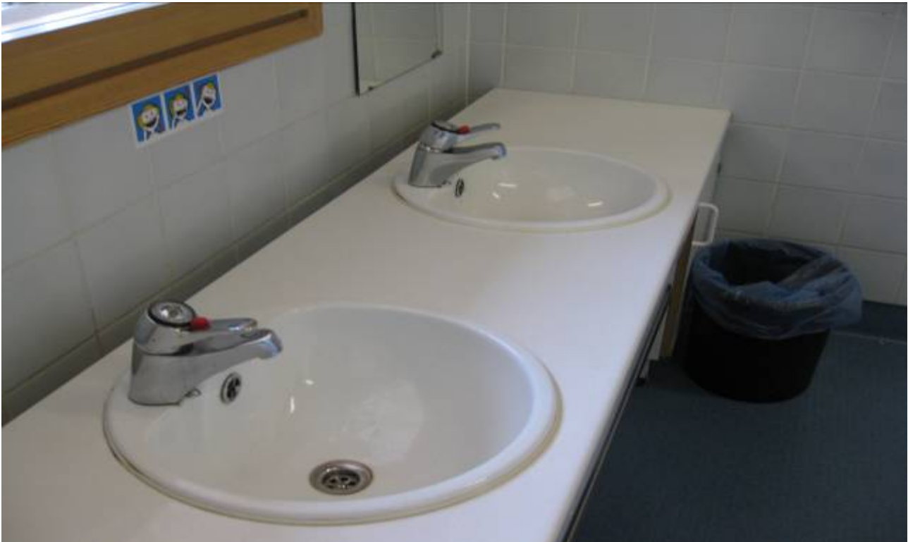
LVI-kuva 4. Yleiskuva vesikalusteista.
