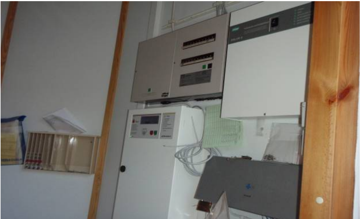
S-KUVA 13. Ovimerkkivalaistuksen keskus, paloilmoitinkeskus ja LVI- hälytyskeskus.
