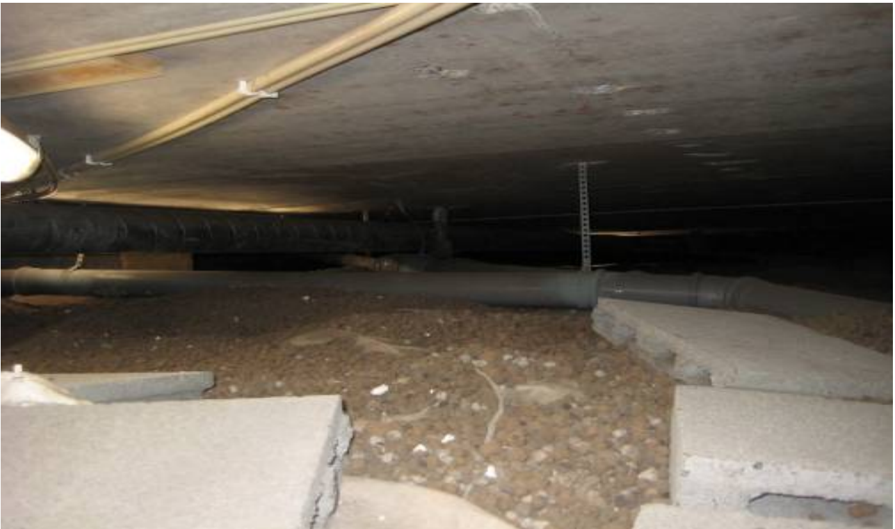
RAK-KUVA 7. Tuulettuva alapohjarakenne kunnostettu 2000 –luvun alussa.
