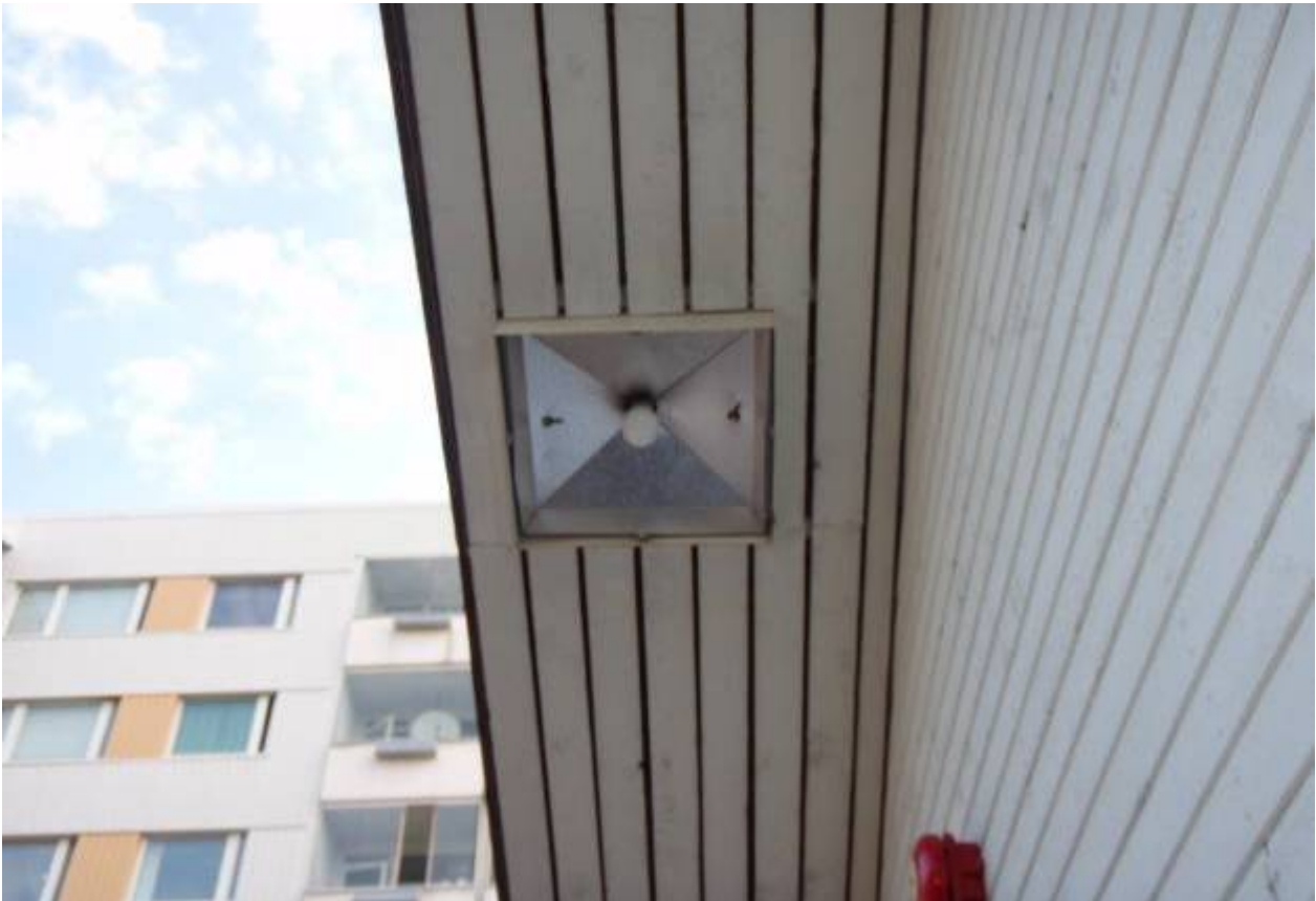
S-KUVA 1. Sisäänkäynnin valaistus, valaisimesta puuttuu kupu.
