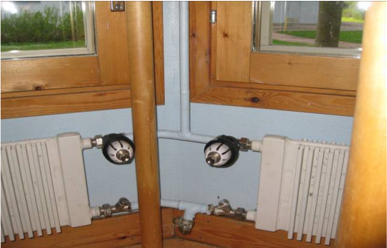
LVI-kuva 2. Yleiskuva patteriventtiileistä.
