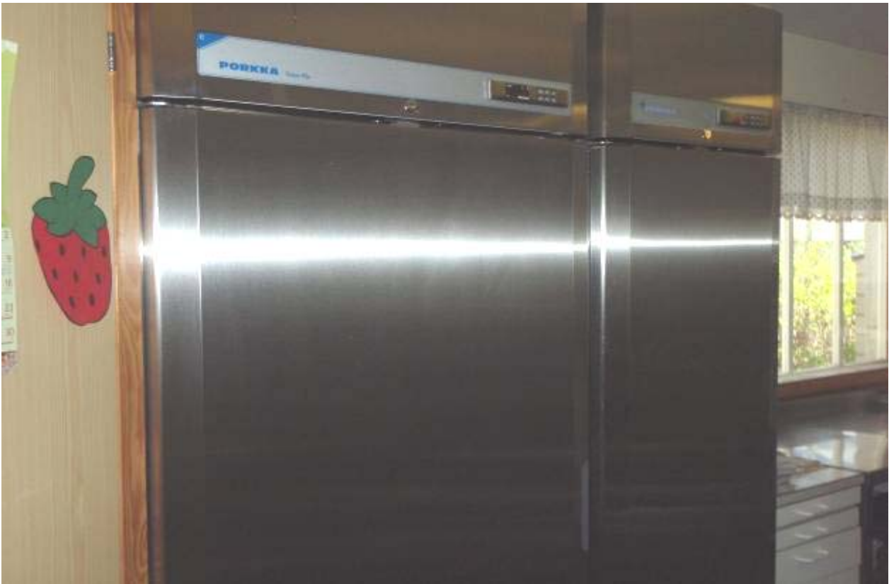
S-KUVA 11. Keittiön kylmälaitteet
