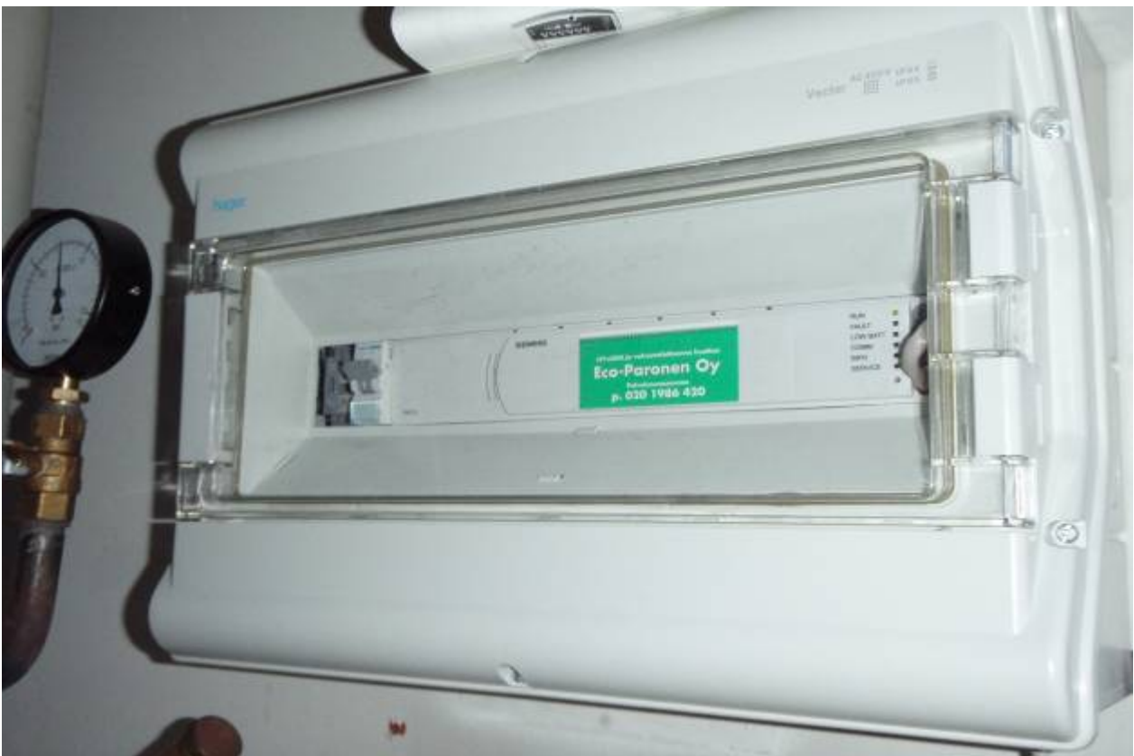
S-KUVA 14. Lämmönjaon rakennusautomaatiojärjestelmä
