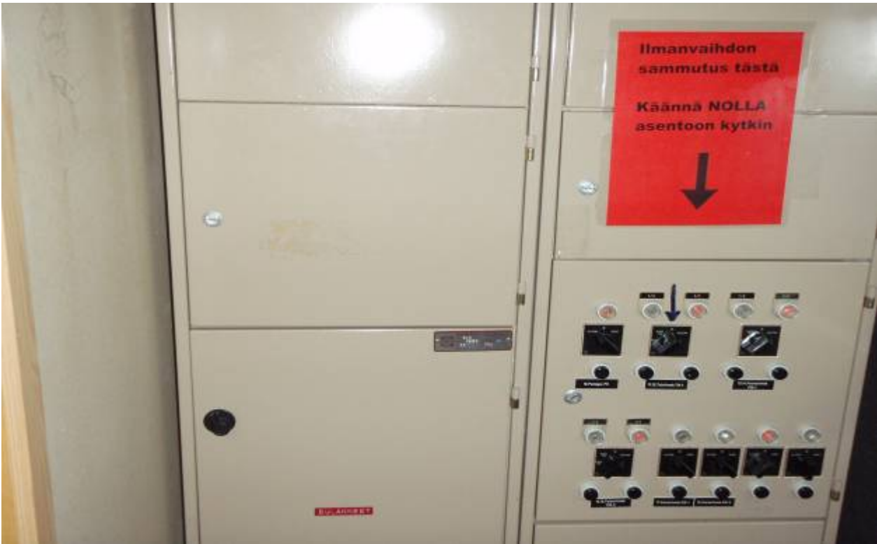
S-KUVA 5. IV- konehuoneen keskus
