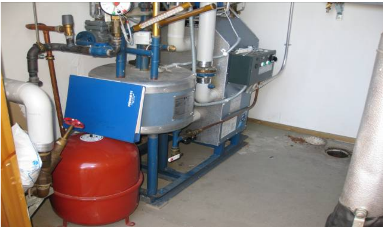
LVI-kuva 1. Yleiskuva lämmönjakohuoneesta.
