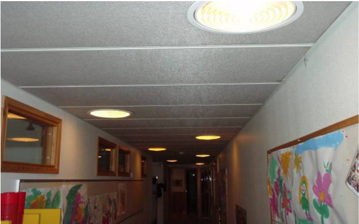
S-KUVA 7. Käytävän valaistus
