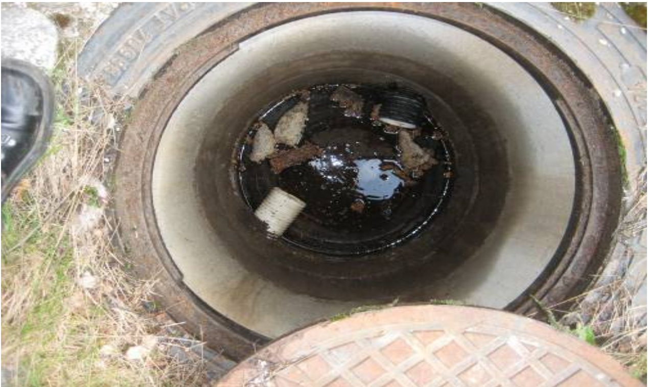
RAK-KUVA 6. Alueen putkirakenteet arvioitiin olevan kokonaisuudessaan tyydyttävässä kunnossa. Yksittäisessä salaojan tarkastuskaivossa epäpuhtauksia, jotka tulee poistaa kaivosta.
