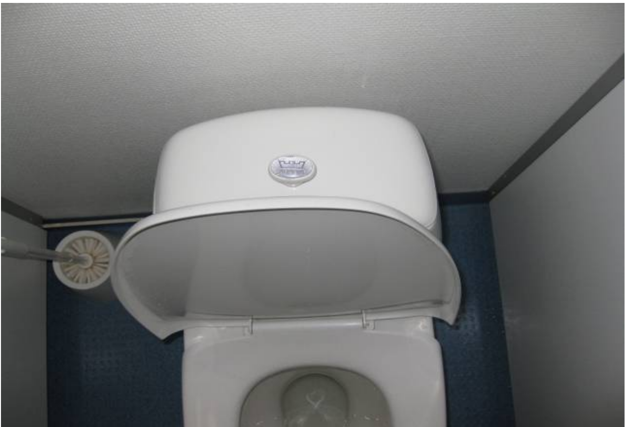
LVI-kuva 5. Yleiskuva wc-istuimista.
