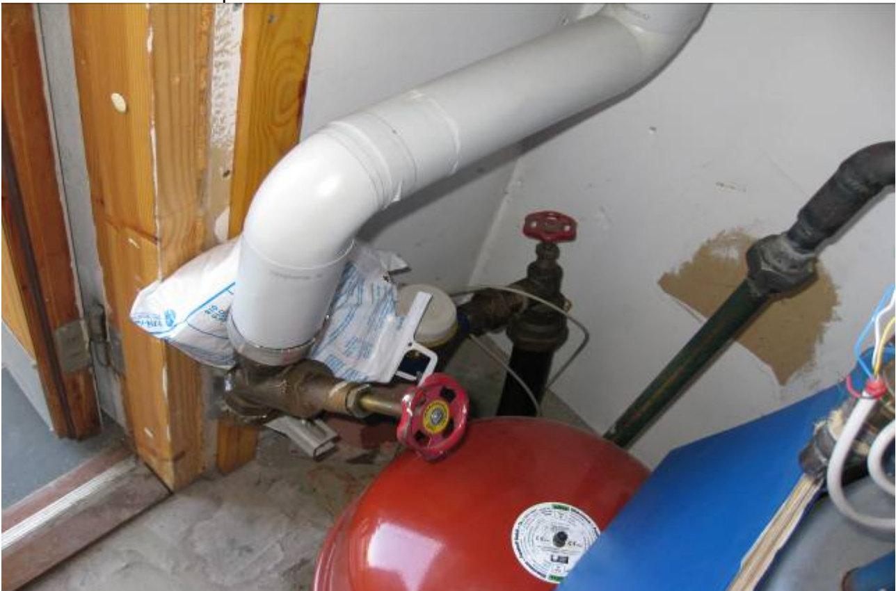
LVI-kuva 3. Yleiskuva vesimittarista ja pääsuluista.
