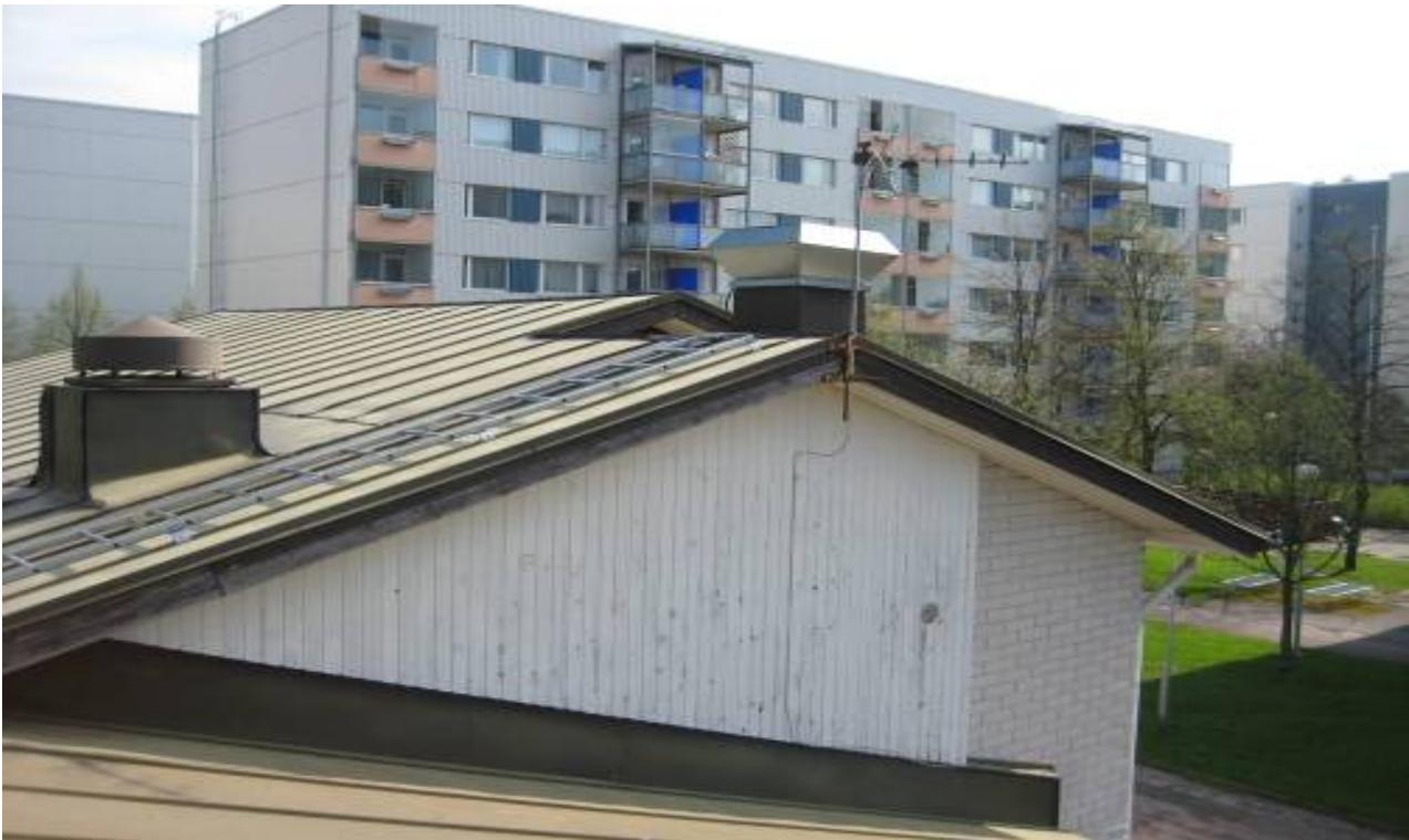
RAK-KUVA 9. Osa julkisivujen maalatuista puupinnoista on huoltokäsitelty viimevuosien aikana, osittain maalipintoja ei ole kunnostettu.
