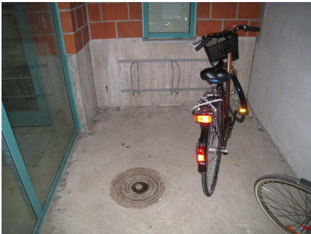
Kuva 33 1.krs/ salaojan tarkastuskaivo sulkutilan kulmalla varasto 105 edustalla.
