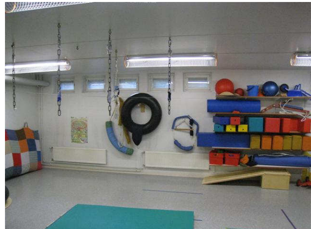
Kuva 12 Yleiskuva terapiatila/ var. 022 päädyssä, jossa maanpaineeseinien lähellä lattian pk- arvot olivat koholla.
