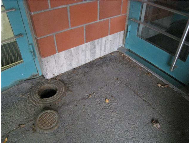
Kuva 25 Salaojan tarkastuskaivo 1.krs/ tilojen 122 ja 124 kulmalla.
