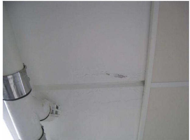
Kuva 10 Vuotovaurioita katon maalipinnassa tilan 021 kohdalla. Katon viemärit liittyvät 133 ja 134 tiloihin ja keittiön 135 lavuaariin.
