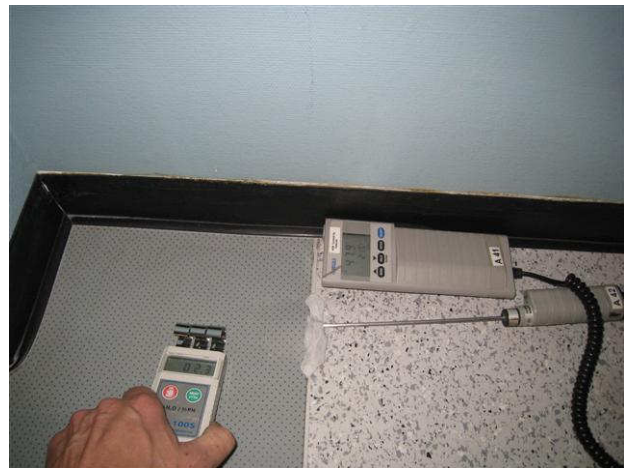
Kuva 22 Ulkoseinän lähellä käytävän 124 maton alta mitattu kosteusarvo osoitti 48 % RH, eli kuivaa arvoa, samoin pk-osoitin. Viereessä kirjavan maton alueella pintakosteusarvot olivat selvästi koholla.
