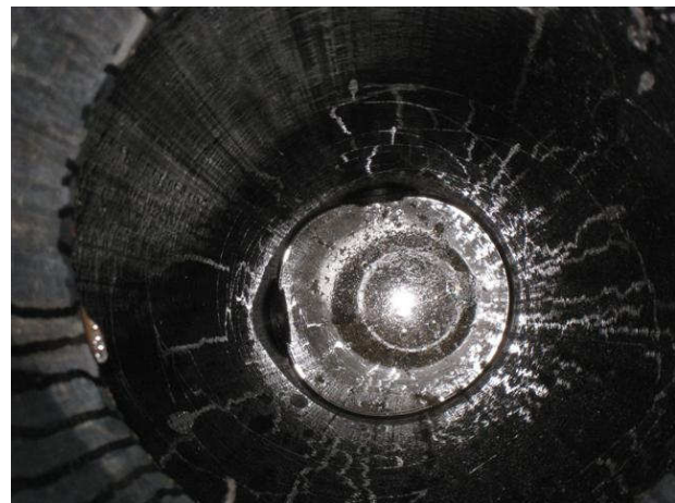
Kuva 34 1. krs/ sulkutila- var. 105 so-kaivon pohja, jonne on matkaa n. 3,3 metriä kannesta. Vasemmalla putki sulkutilaan päin ja "ylös" on yksi putki. Pohjalla vettä jptasolla
