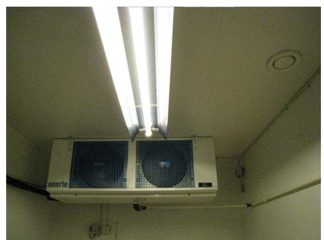
Kuva 18 Kylmiötilan 133/ vainajat lauhdutin. Tilan ilma-arvot oli 4,3 °C, 64 % RH ja 4,3 g/m 3 katossa on poistoventtiili, tila on vahvasti alipaineinen.
