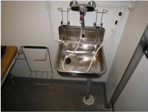
Kuva 13 Kylmiötilan 133/ vainajat, 1.krs lavuaari ja lauhdevedenpoistojärjestely.
