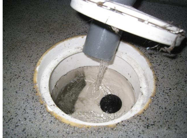
Kuva 14 133/ vainajat vesivalutuskoel. Lattiakaivon korokerenkaan tiivistys voi olla vika.
