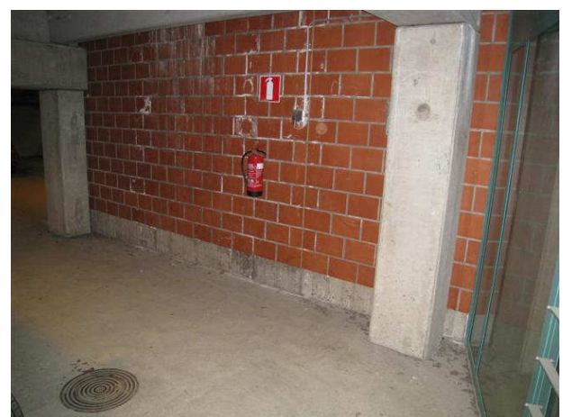
Kuva 30 1. krs/ vuotojälkiä tilan 117 ulko. autohal- lin puolella. Lattian kaivo on salaojien tarkastuskaivo, ks. kuva 31
