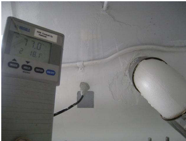
Kuva 9 Neuv./ var. 021/ 0-krs katon tb-laatan kosteus oli koholla KPR7 kohdalla, 18,1 °C 77%RH (betoni on viileä).
