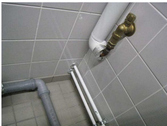
Kuva 23 Siivous.k/ 119 nurkassa oli kopoja laattoja lattiassa, vesip. ulkos. läpi autoh.
