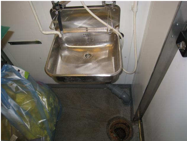
Kuva 15 Kylmiötilan 134/ ong.jäte lavuaari ja lauhdevedenpoisto suoraan viemäriin.
