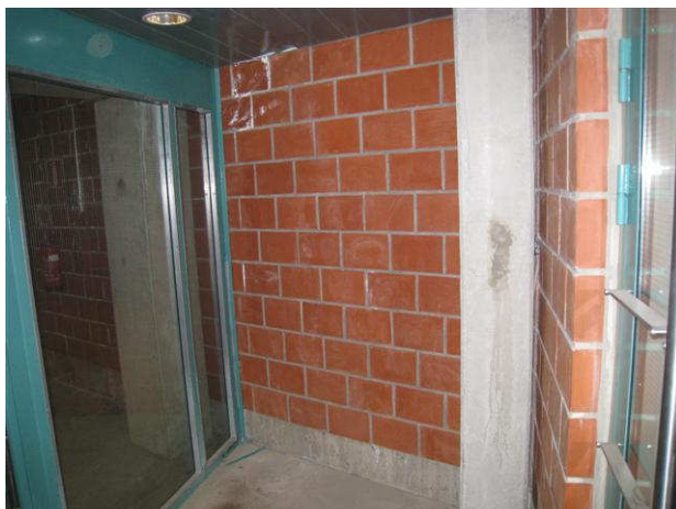
Kuva 29 1. krs/ sulkutilan ja var. 116 välinen ulkoseinäosa, jossa on vuotojälkiä tiillis- sä yläosalla.
