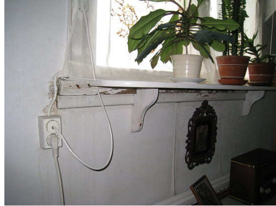
Kuva 18 Vesivuotokohtia 2.kerrosen länsipäädyn ikkunaliitoksessa.
