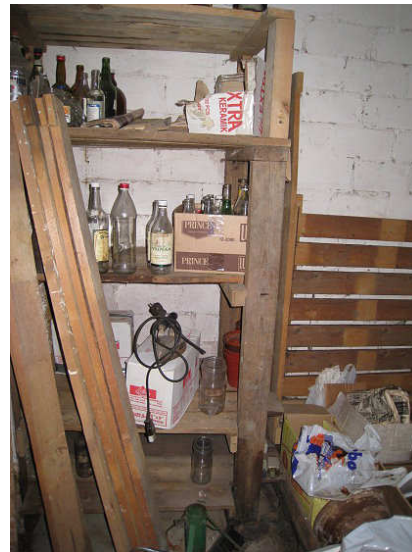
Kuva 4 Puurakenteet kosteusvaurioituneet alaosistaan.
