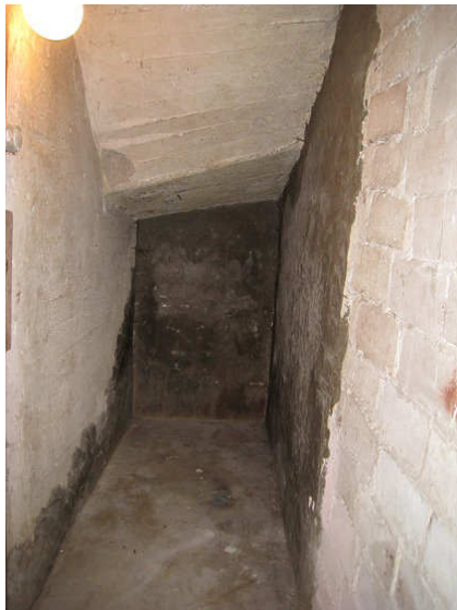
Kuva 3 Kellarikerroksen lattiassa ja maanvastaisissa seinissä on pintakosteus korkea.
