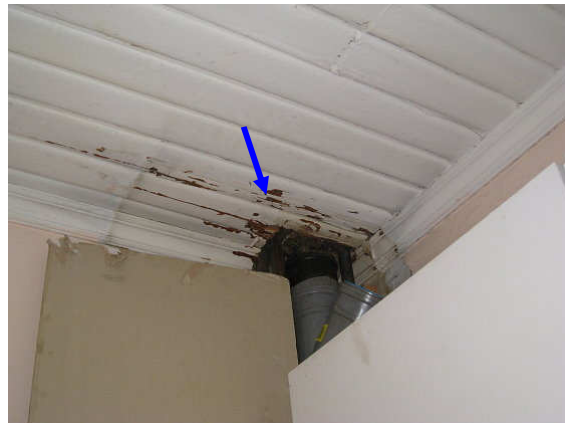
Kuva 14 Vesivuotojälkiä myös KHH-tilan puolella.
