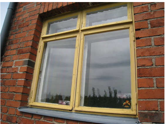
Kuva 16 Ikkunapuitteiden maalipinnat ovat ulkopuolella kuluneet. Sovituksissa lisäksi puitteita.
