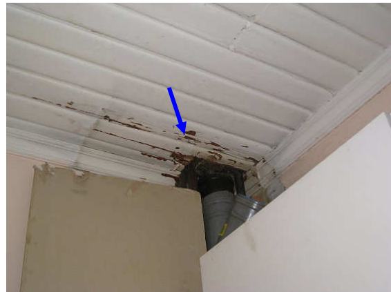
Kuva 14 Vesivuotojälkiä myös KHH-tilan puolella.
