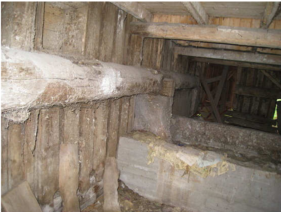
Kuva 25 Rungossa on pahoja kosteus- ja mikrobivaurioita.
