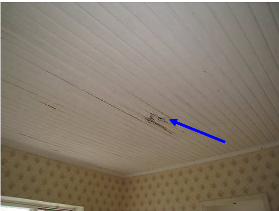
Kuva 13 Rakenneavauskohdan lähellä 1.kerrosen asunhuoneen katto-paneelissa vesivuotojälkiä.
