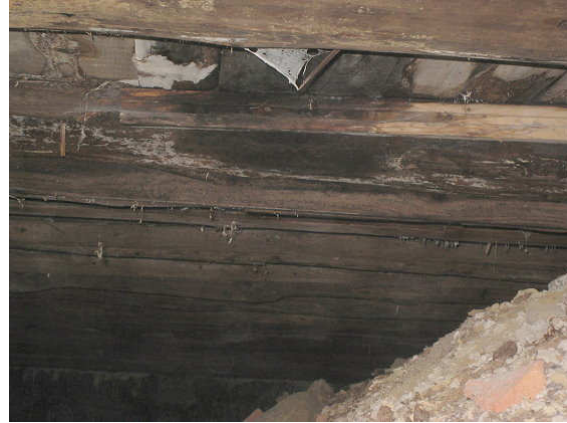
Kuva 6 Puurakenteinen alapohja on kosteus- ja mikrobivaurioitunut.
