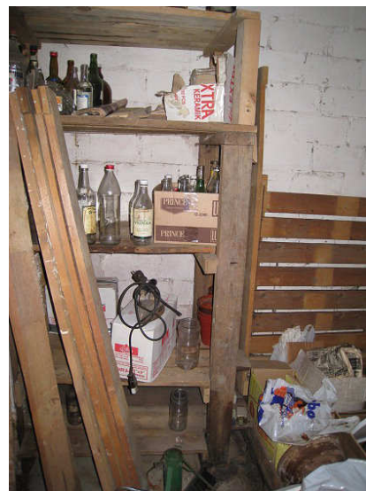
Kuva 4 Puurakenteet kosteusvaurioituneet alaosistaan.
