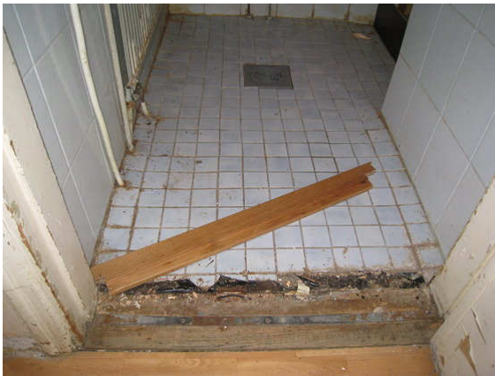
Kuva 19 1.kerrosen suihkutila. Laatoituksen asennus epämääräinen. Lattia on märkä, samoin seinä vasemmalla.
