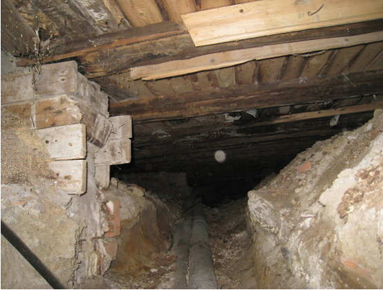
Kuva 5 Maapohja on mikrobivaurioitunut.
