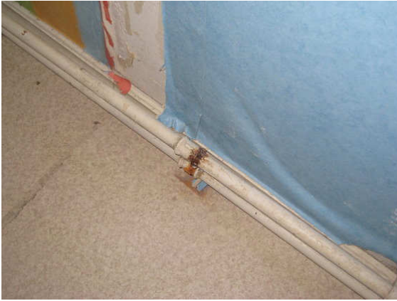
Kuva 23 Lämpöputkien liitoksissa on ruostejälkiä.
