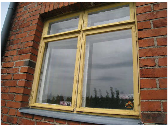
Kuva 16 Ikkunapuitteiden maalipinnat ovat ulkopuolella kuluneet. Sovituksissa lisäksi puutteita.
