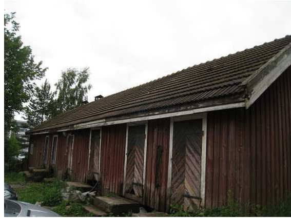
Kuva 24 Talousrakennus on huonokuntoinen ja vesikattorakenne on painunut pohjoispäädystä.
