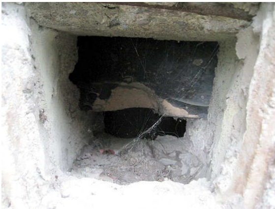
Kuva 7 Tuuletusaukon kohdalla tulitiilen omainen rakennusmateriaali, jossa kreosoottia sisältävä pikieristys.
