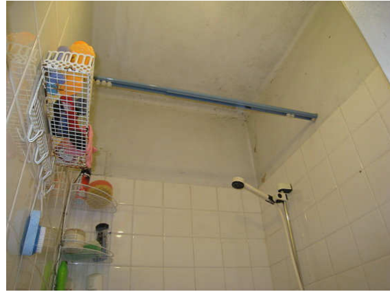
Kuva 20 Puutteellisesta ilmanvaihdsta johtuen katossa on alkavaa mikrobikasvustoa.
