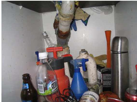
Kuva 22 Viemärit ovat käyttökänsä loppupuolella.
