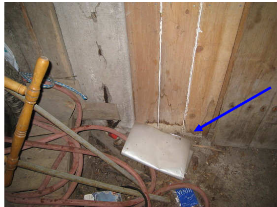
Kuva 4 Betonia vasten olevat puupinnat ovat kellarikerroksessa kosteus- ja mikrobivaurioituneet.
