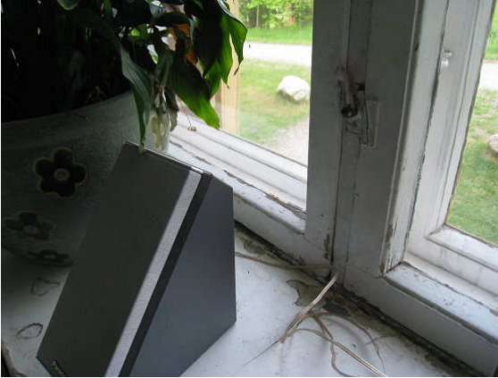
Kuva 13 Ikkunapuitteiden alaosilla on kosteuden aiheuttamia vaurioita.
