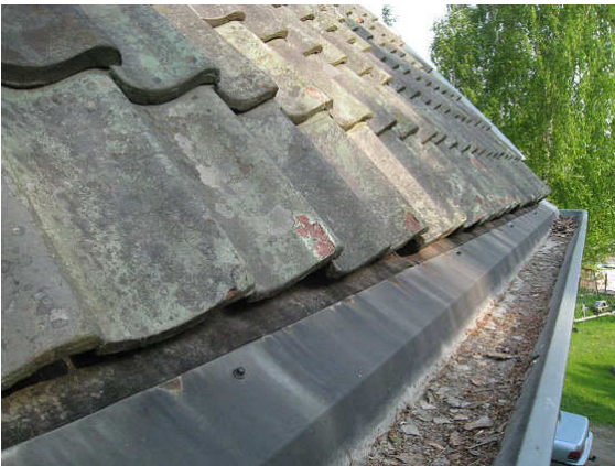
Kuva 3 Räystäskouruissa runsaasti puunlehtiä yms.
