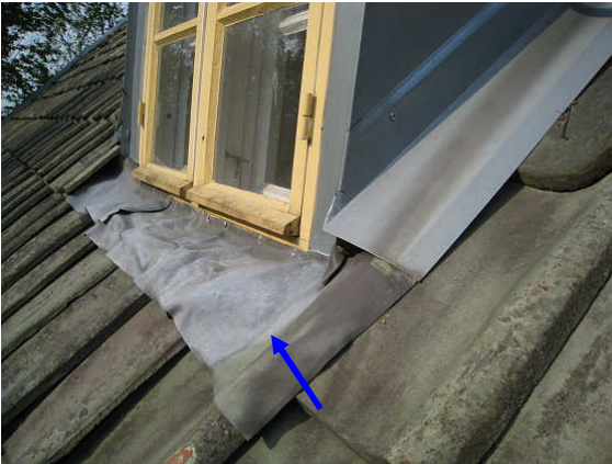
Kuva 15 Lyijypelin naulakiinnitys karmirakenteeseen on epävarman olinen.
