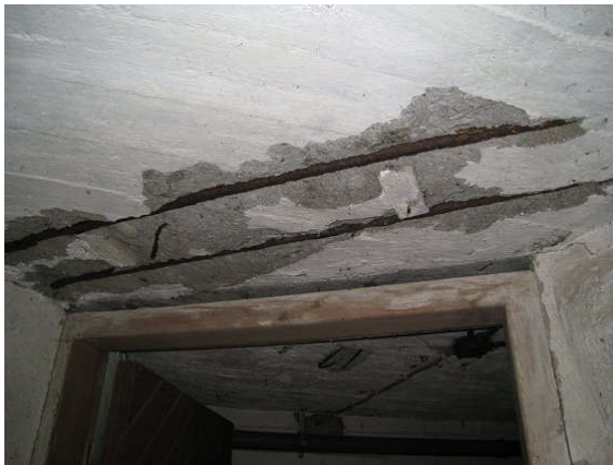
Kuva 9 Kellarikerroksen katossa näkyvillä ruostunutta raudoitusta.
