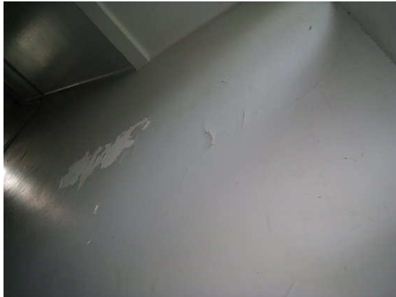
Kuva 8 Porrashuoneen maalipinta hilseilee.
