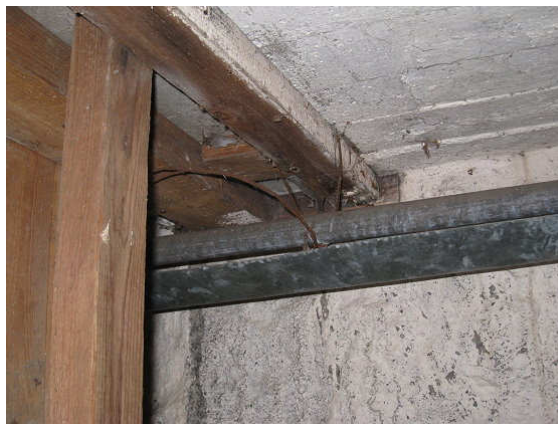
Kuva 5 Myös muissa kiviaineisia pintoja vasten olevissa puurakenteissa on kosteuden aiheuttamia jälkiä.
