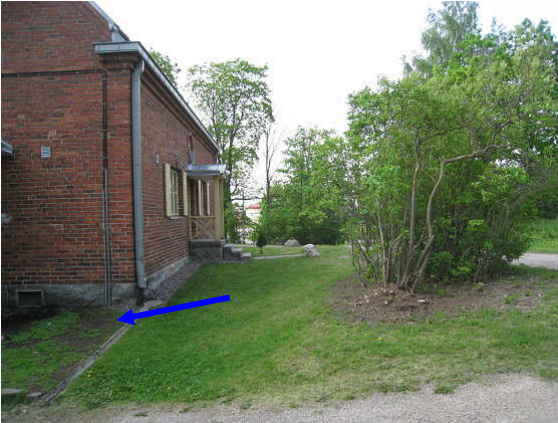
Kuva 1 Sade- ja sulamisvesiä pääsee kerääntymään perusrakenteisiin.
