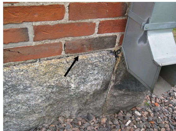
Kuva 6 Kreosoottia sisältävää pikieristettä.
