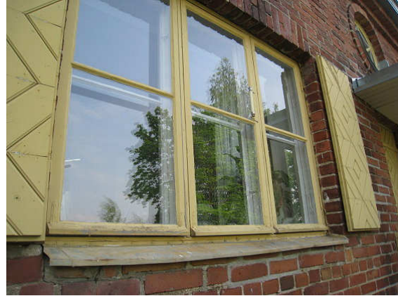
Kuva 14 Vesipeltien maalipinnat ovat huonokuntoiset.
