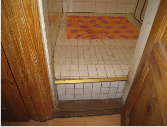
Kuva 19 Eteläpuolen asunnon sh-tilan lattia on korotettu. Lattiarajan saumat tummentuneet.
