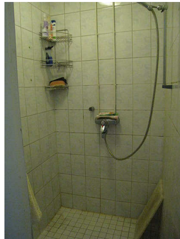
Kuva 16 Pohjoispuolen asunnon sh-tilan laatoituksen silikonisaumojen ja saumalaastien pinnoilla on tummentumia.
