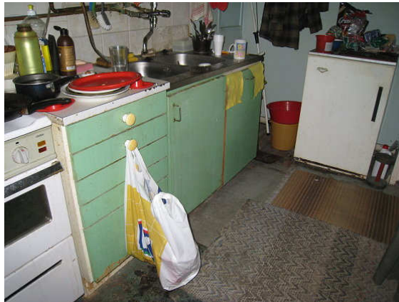
Kuva 21 Pohjoispuolen 2.krs:n asunnon pintamateriaalit ja kalusteet ovat kuluneet.
