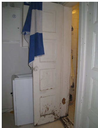
Kuva 17 Kynnys on kosteusvaurioitunut, sa-moin ovi alaosastaan.
