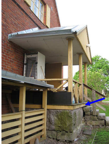
Kuva 7 Kuistien puurakenteissa on alkavaa lahoa. Maali ei ole pysynyt höylätävän pinnassa.
