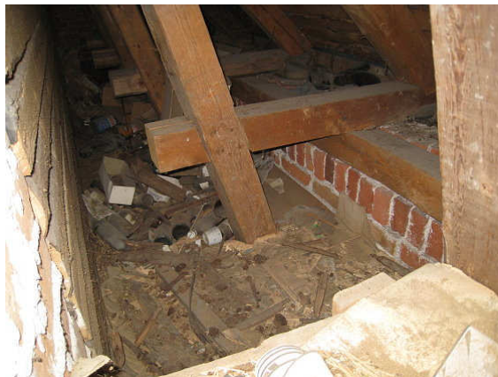
Kuva 12 Sivuonkaloihin on heitetty monenlaista roinaa. Tila ei tuuletetu.
