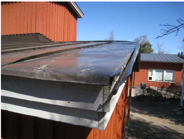
Kuva 3 Tornirakennuksen vesikaton reuna- peltivika.
