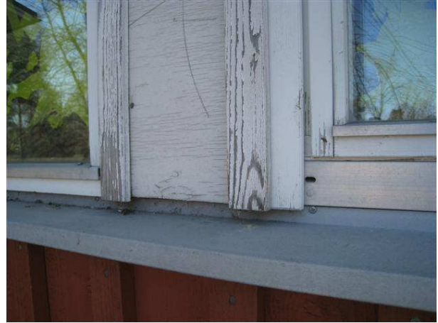
Kuva 22 Vesipellit ovat loivia, ikkunoiden ulkopinnat ja välinen levy ovat kuluneet.
