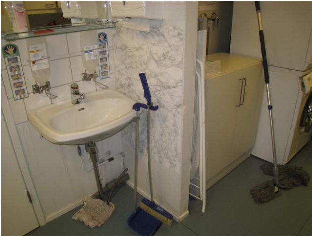
Kuva 45 Henkilökunnan sosiaalitila lavuaarin alla lattiakaivo tulvii pesukoneen takia ajoittain.
