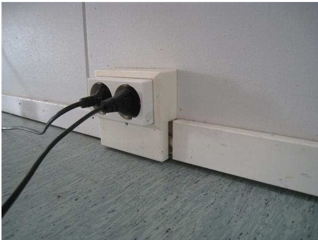
Kuva 47 Sähköpistorasioita on lattiarajassa, sähköjohtoja muovilistoituksissa. Osa pistorasioista on huonosti kiinni.
