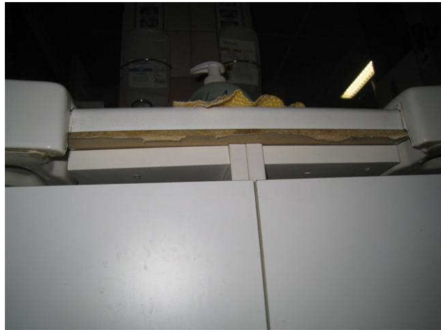
Kuva 46 Lasten käsienvesualtaiden laminaattitasojen levyt ovat kärsineet vaurioita.
