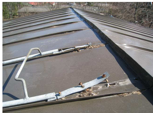
Kuva 30 Lapetikkaat ovat irronneet lumen painosta, reiät on paikattava, lapetikkaat on kiinnitettävä saumoista.
