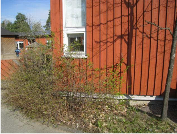
Kuva 7 Eteläpäädyssä istutukset rasittavat puista ulkoseinää.
