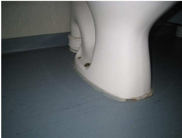
Kuva 39 Kulunut wc-pytyn silikonikittaus, vuotoriski pytyn kiinnitysten kautta.
