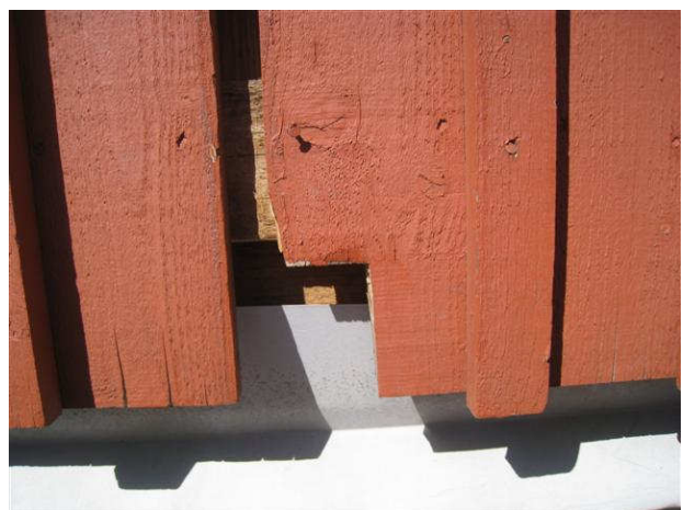
Kuva 18 Eteläsivulla joitain lautoja on rikki ja sokkelinrajan vesipelti on irti.
