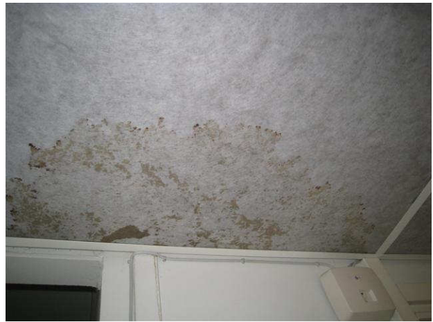
Kuva 34 Vesivuotojen takia akustiikkalevyn vuotojälkiä.
