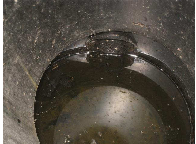
Kuva 10 Pohjoissivulla salaojan tarkastuskaivo.
