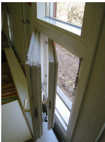
Kuva 23 Tuuletusikkunan aukkipitolaite on huono, sitä on parannettu ketjulla.
