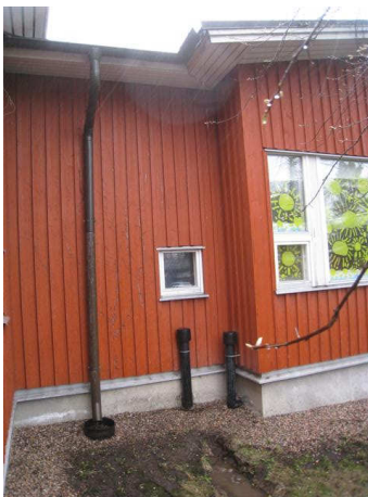
Kuva 11 Itäisivulla rännivesiä valuu suoraan maahan.
