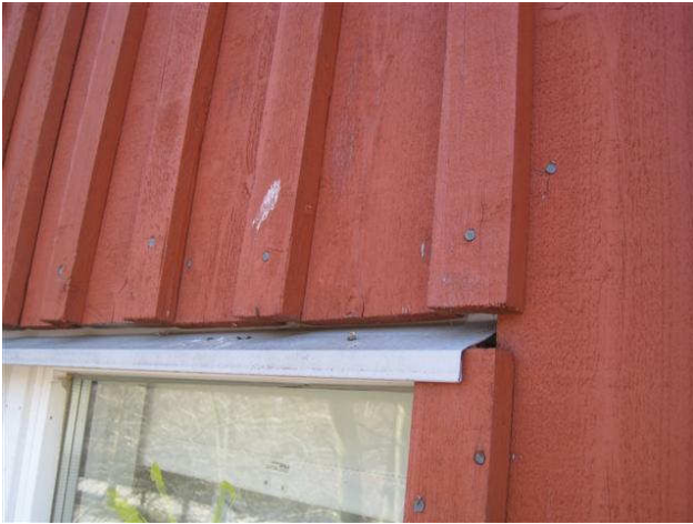
Kuva 19 Ikkunan yläpielen peltiratkaisua tulee parantaa ainakin päätyseinillä.
