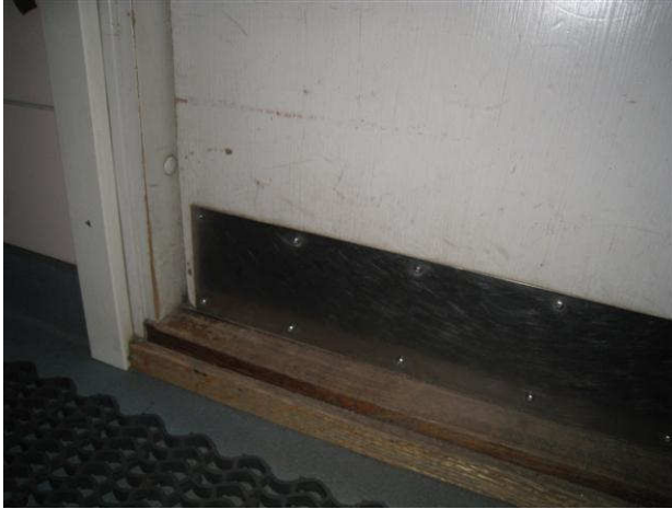
Kuva 25 Ovet ovat kuluneet.
