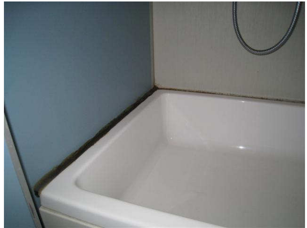
Kuva 40 Homeinen silikonitiivistys henkilökunnan suihkutilassa.
