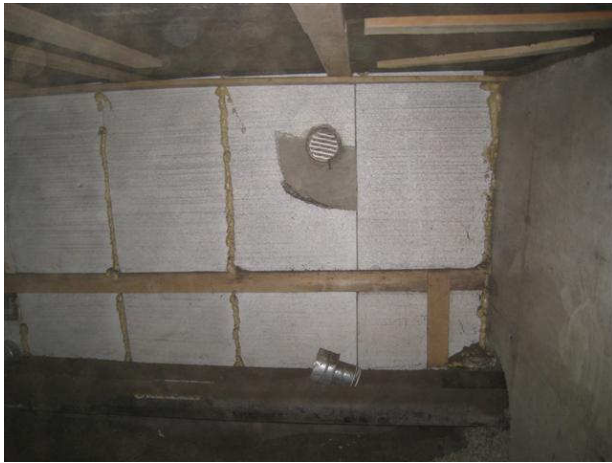
Kuva 15 Alustatilan sokkelin läpi vietyjen korvausilmaventtiilien sisäpuolisia säätöventtiileitä on osin irti.
