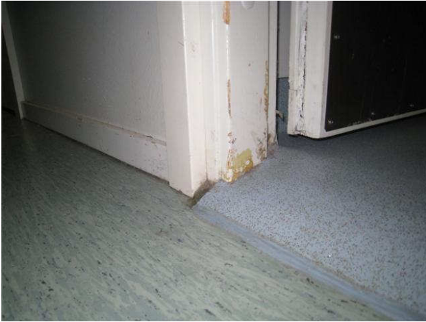
Kuva 43 Keittiön salin puoleisen oven kynnyks tulee parantaa. Ovi ja listat kuluneet.
