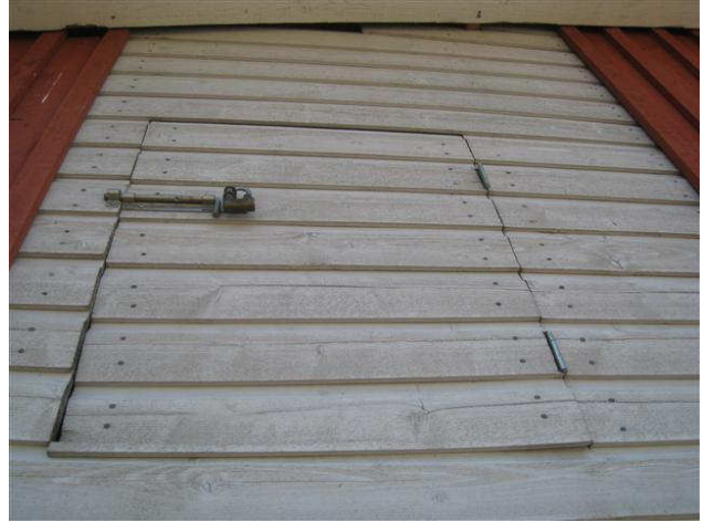
Kuva 20 Heikkorakenteinen yläpohjaontelon kulkuluukku, maalipinta on ohut.
