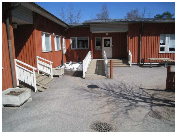
Kuva 12 Sisäpihan kallistukset ovat hyvät. Puuportaat ja luiska ovat kuluneet.
