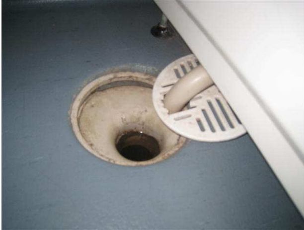
Kuva 37 Lattiakaivon liittymä on vielä tiivis.
