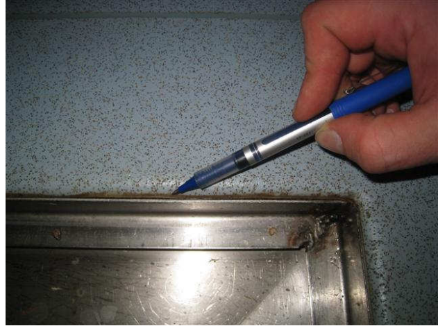
Kuva 44 Keittiön lattiakaivon liittymän vesitiiveys tulee tarkistaa.
