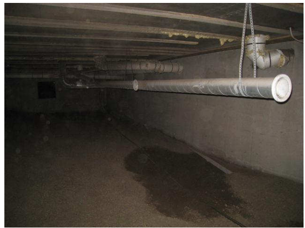
Kuva 14 Yleiskuva alustatiloihin, johon on lisätty koneellinen ilmanpoisto.
