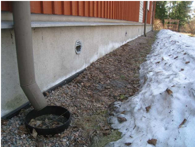
Kuva 9 Pohjoissivulla rännikaivo, alapohjan tuuletussäleikköjä on rikki.
