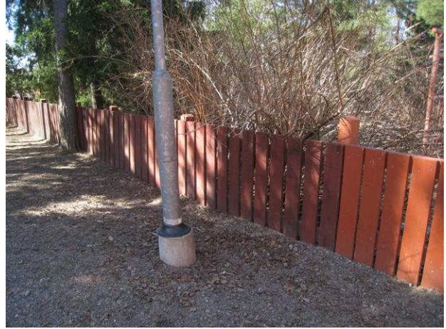
Kuva 2 Raja-aita on kulunut ja matala, puu on hiekassa.
