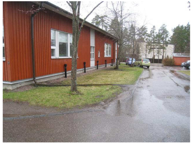
Kuva 8 Kattovesiä on ohjattu loiskekouruihin itäisivulla, pintakallistukset ovat hyvät. Asfalttimakkara on paikoin rikki.
