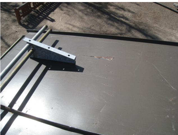
Kuva 29 Katepeltipinnan naarmuja, lumiesteidenn kiinnitys on tehty katteen läpi, mutta ulkoseinän ulkopuolella.
